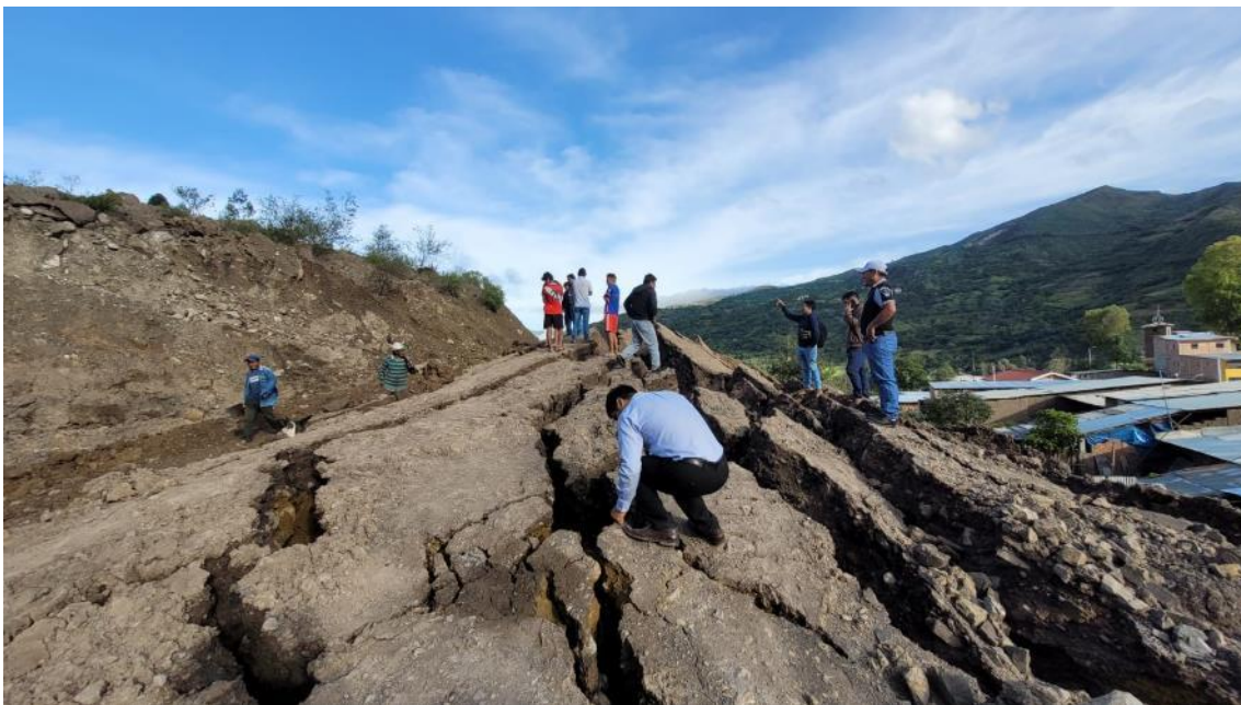
Fotografía 4. Plataforma de la trocha carrozable de ingreso a la localidad de Sallique, totalmente destruida e intransitable, 09 de abril del 2023. Coordenadas UTM WS-84 -17S, Norte: 9374265 – Este: 686459. Fuente: Defensa Civil Municipalidad Distrital de Sallique
