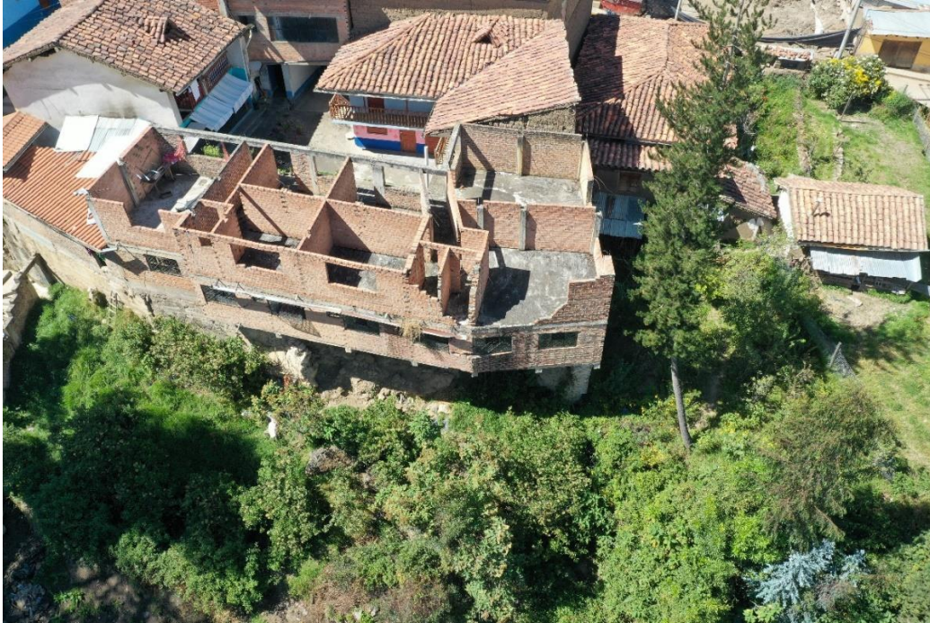
Fotografía 13. Vista aérea donde se observa la erosión de ladera que socavó las cimentaciones de una vivienda de 2 pisos. Este hecho demandó evacuarlos de forma inmediata por el inminente peligro al que se exponen los ocupantes de dicho inmueble.
