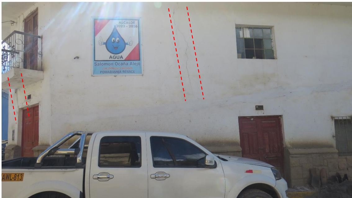
Fotografía 14. Vista que evidencia el agrietamiento de las viviendas próximas a la quebrada Cañari y el río Pomabamba.
