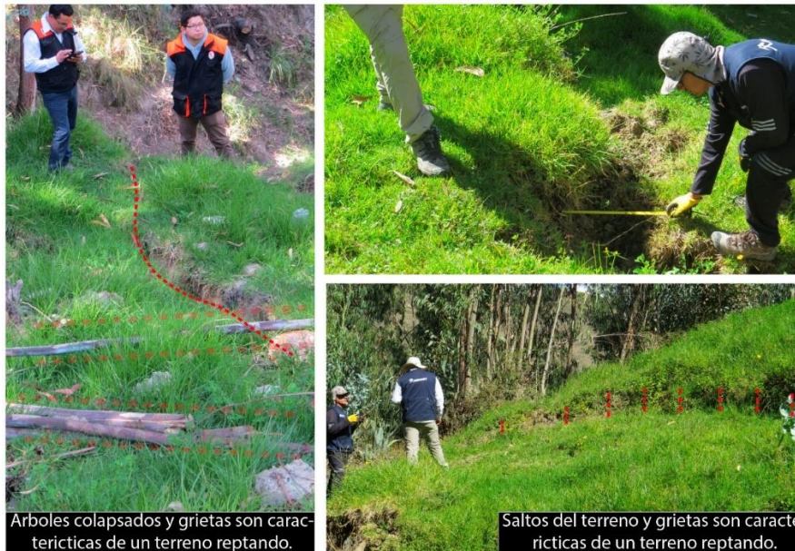
Fotografía 10. Agrietamientos transversales de hasta 4 m de longitud, ubicada a 5 m del deslizamiento rotacional, con dirección NW-SE, con saltos de 0.30 cm.
