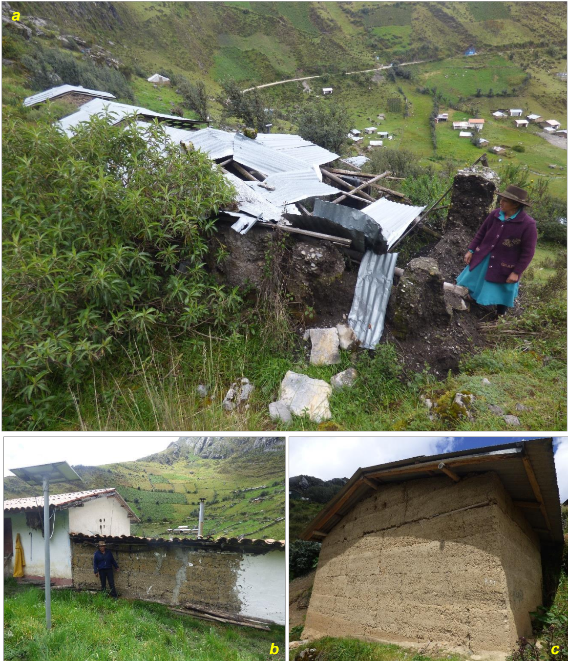
Figura 12. a) Vista de viviendas afectadas por caída de rocas de la ladera suroeste. b y c) Viviendas con paredes agrietadas del sector Chipta.
