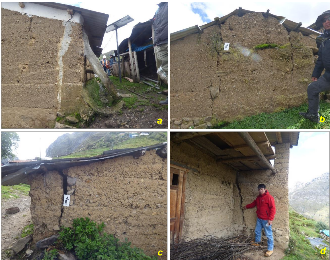
Figura 11. a, b, c y d) Viviendas de Jatun Piruro con paredes agrietadas, en dirección suroeste.
