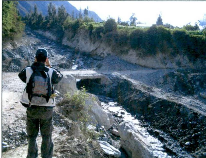
Foto 11: Puente carrozable que cruza la quebrada Runtumayo, con daños de erosión y cubrimiento por material aluviónico del 12 de octubre del 2005.
