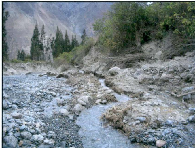
Foto 13: Margen derecha del río Runtumayo mostrando canales provisionales ya que las obras de captación fueron destruidas.
