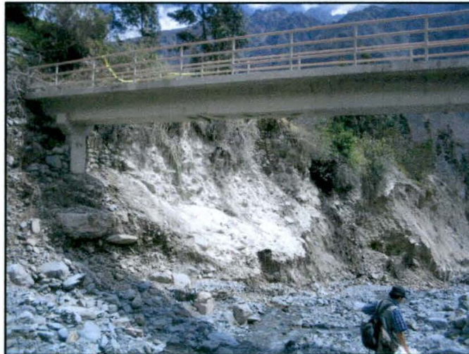
Foto 12: Puente peatonal Tiaparo-Palomar inhabilitado debido a la destrucción de sus pilares.
