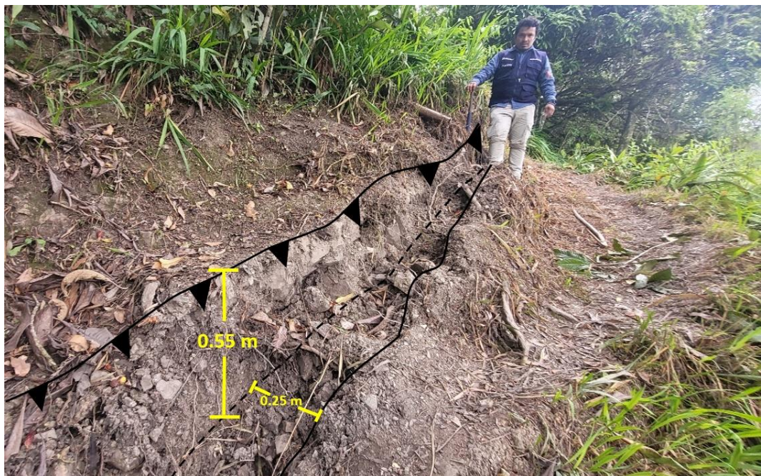
Figura 8. Se observa el escarpe principal con salto vertical de 0.55 m. Coordenadas UTM WS-84 -17S, Norte: 9309136 – Este: 737430.
