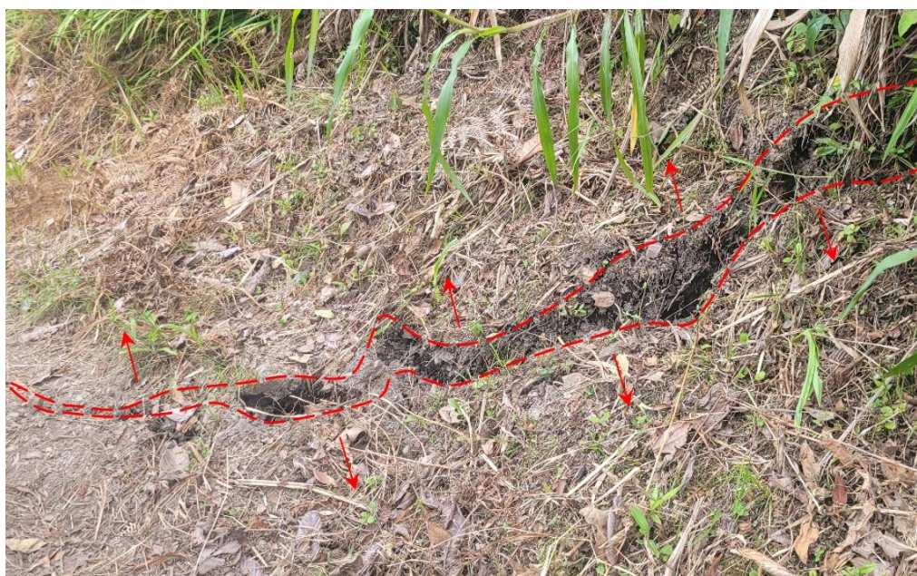
Figura 10. Se observa agrietamiento de 39 m de longitud y ancho de 5 a 15 cm. Coordenadas UTM WS-84 -17S, Norte: 9309138 – Este: 737437.
