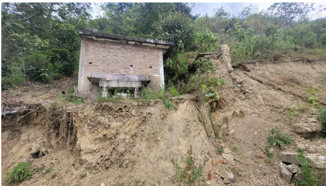
Fotografía 5. Vivienda inhabitable, ubicada en la parte sobre escarpe secundario. Coordenadas UTM WS-84 -17S, Norte: 9309130– Este: 737431.
