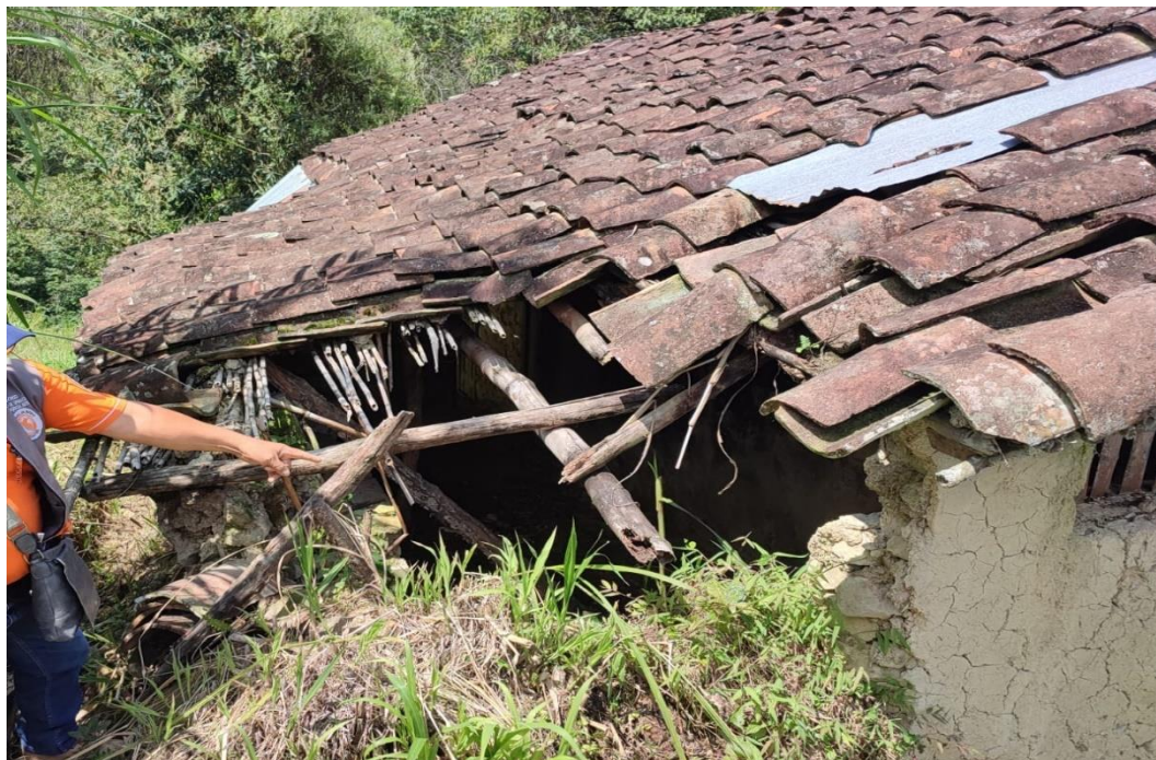
Fotografía 4. Vivienda inhabitable, ubicada en el cuerpo de deslizamiento. Coordenadas UTM WS-84 -17S, Norte: 9309119 – Este: 737411.
