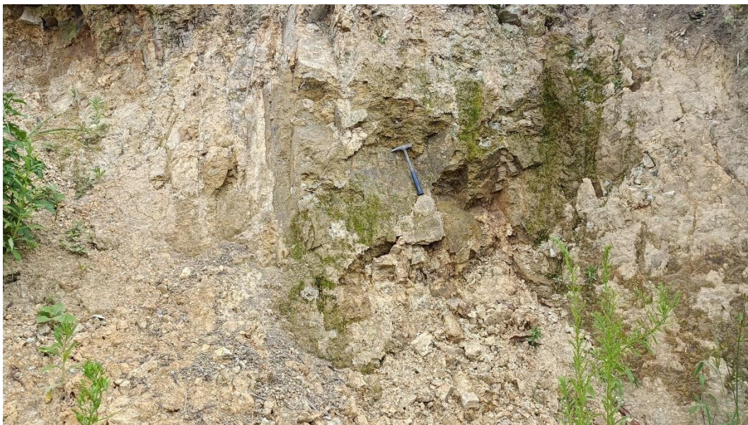
Fotografía 2: Talud donde se observa la filtración de agua hacia el macizo rocoso, lo que acelera el proceso de meteorización. Coordenada UTM WGS-84, 17S: E: 737413; N: 9309111.
