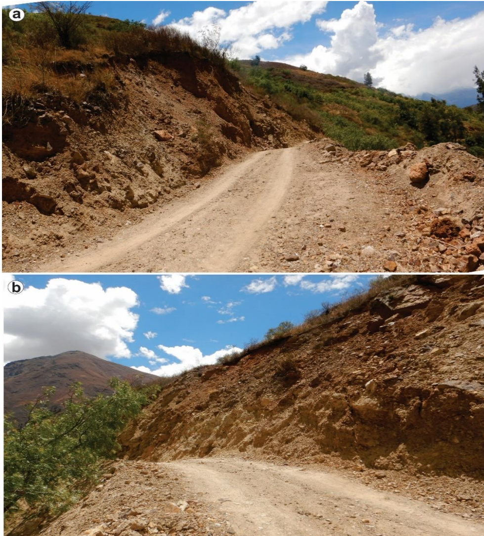
Figura 13. Vista de la trocha carrozable que permite el acceso de los centros poblados de Punya hacia Maya, se puede observar la acumulación de material en una de las márgenes.
