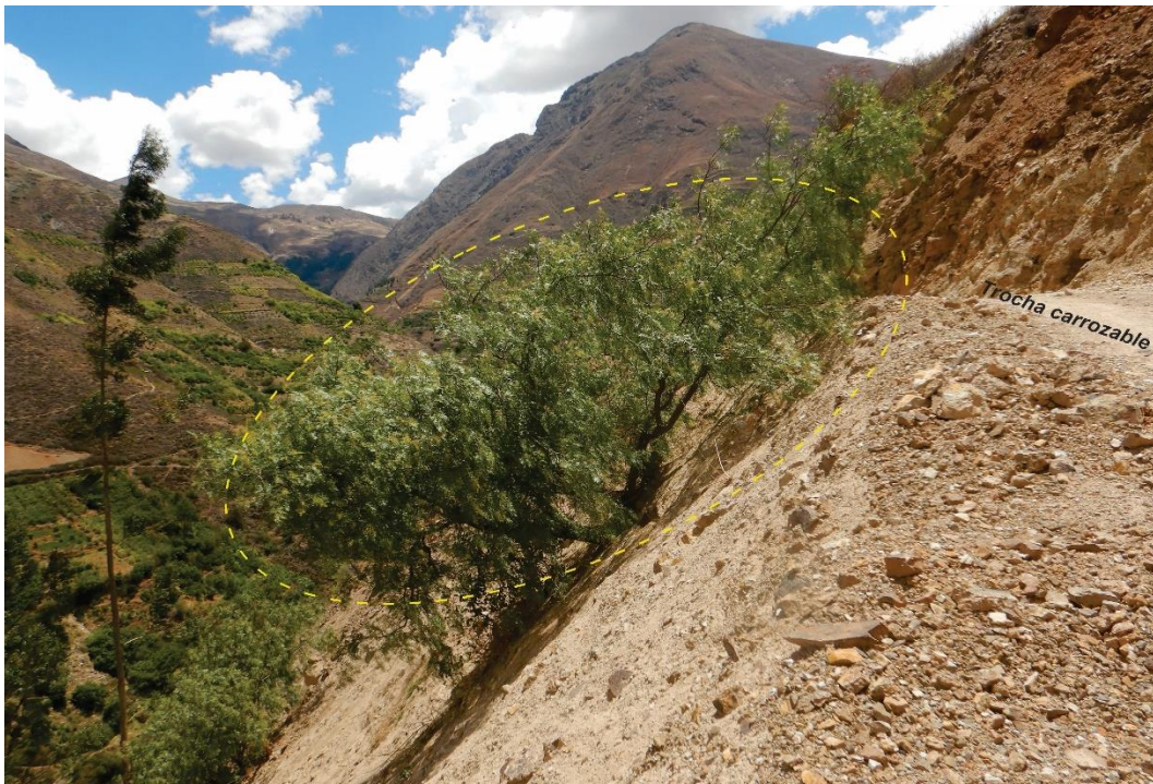
Figura 15. Vista donde se observa árboles inclinados, se ubican en la parte baja de la trocha carrozable de acceso C.P. Puna hacia C.P. Maya.
