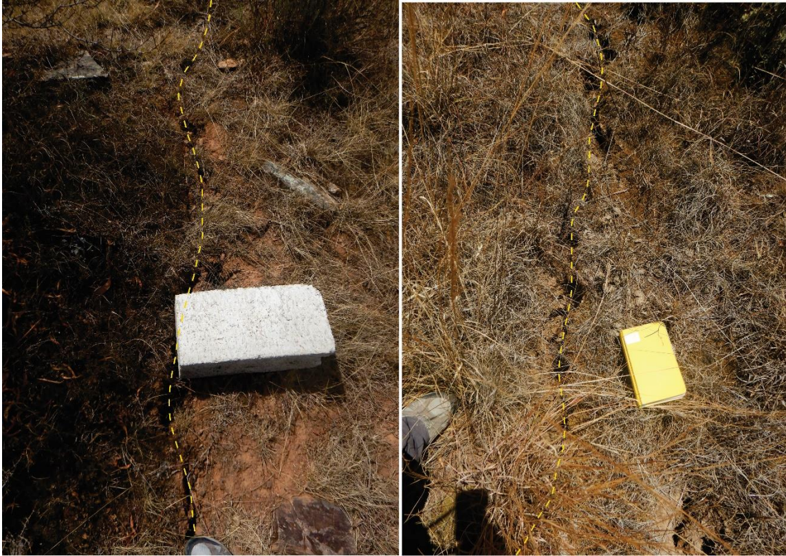
Figura 14. Agrietamientos longitudinales identificados en el cuerpo del deslizamiento, los mismos que llegan a tener longitudes de hasta 1 m, con aberturas de 0.02 a 0.18 m.
