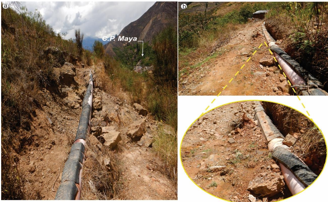
Figura 17. Se observa tubería de agua potable, que pasa por el cuerpo del deslizamiento, el cual presenta fugas en varios puntos, cabe mencionar que la tubería instalada se encuentra expuesta.
