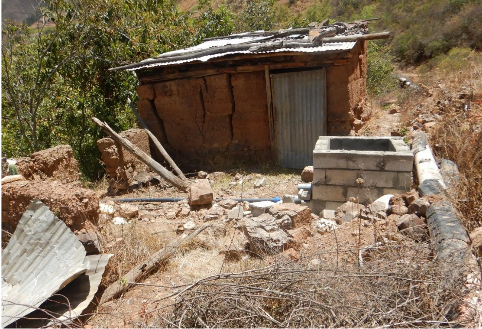
Figura 16. Vivienda de adobe, con agrietamientos longitudinales, con aberturas de hasta 0.12 cm; actualmente la vivienda se encuentra deshabitada.
