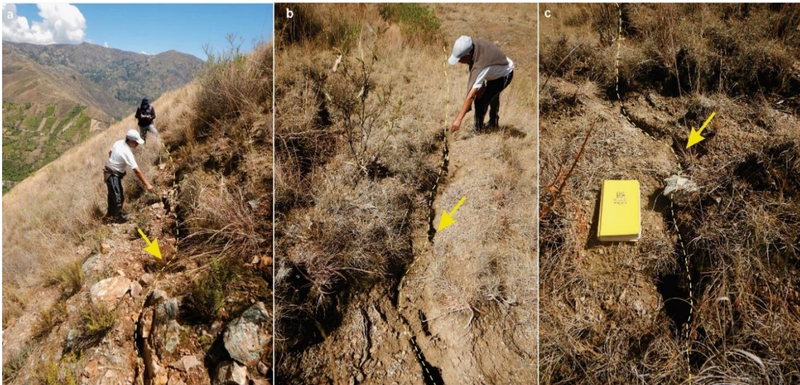
Figura 24. Vista de agrietamientos transversales identificados al noroeste del deslizamiento entre las coordenadas UTM 8972741 N, 206510 E, con una altura de 2879 m s.n.m. las mismas que llegan a tener longitudes de hasta 20 m, con aberturas entre 0.05 m a 0.45 m y profundidades visibles de hasta 0.40 m.
