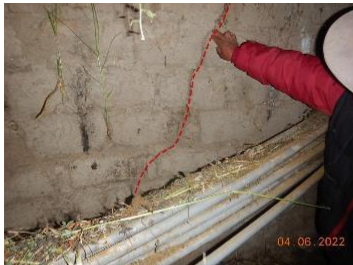
Figura 8: Muros agrietados por efectos del empuje del deslizamiento.
