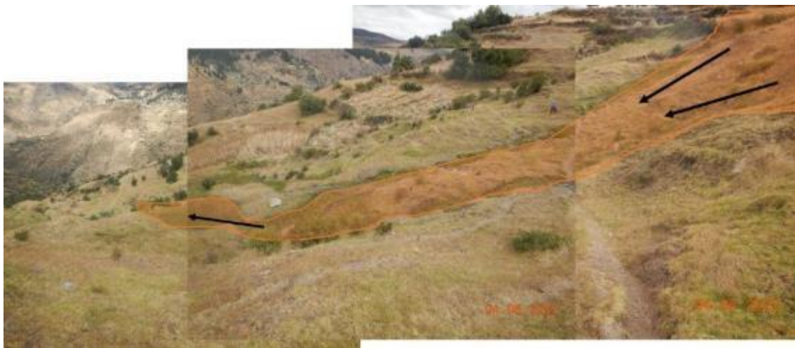
Figura 10: Se aprecia que todos los materiales deslizados llegan hasta una torrentera, luego las aguas discurren hacia la quebrada principal Challajoran.
