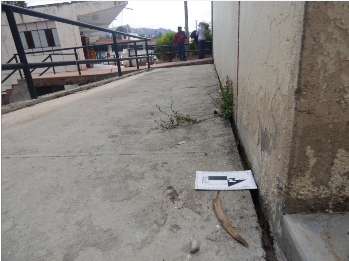
Fotografía 4. Denlazamiento de aproximadamente 3 cm, en la infraestructura del Pabellón de Ciencias Agrarias, a favor de la pendiente.
