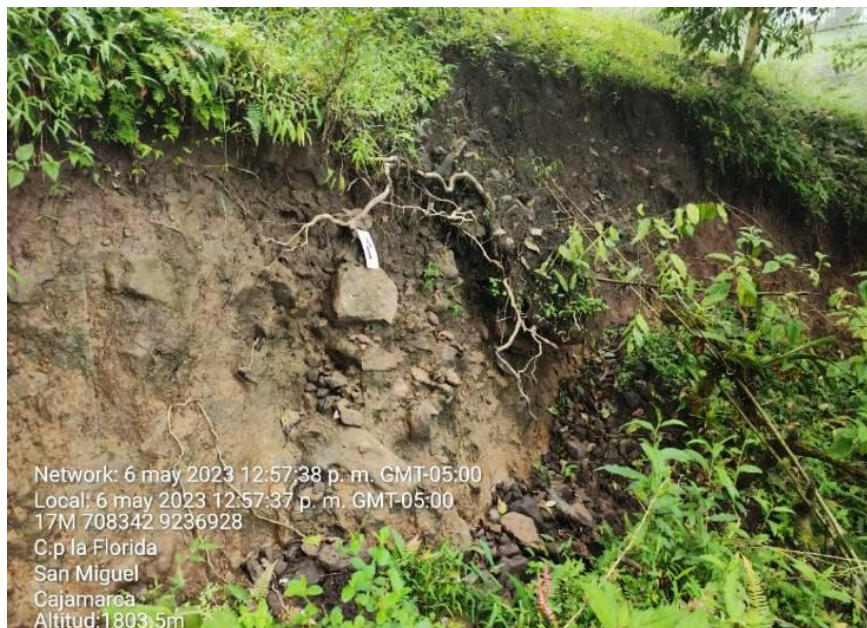
Fotografía 5. Escarpe principal del deslizamiento DRA2. Se aprecian bloques de formas angulosas en matriz de limos de baja plasticidad, como también restos de raíces de plantas.
