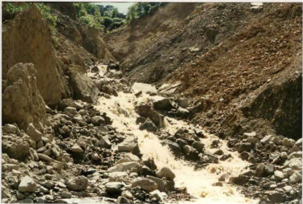
Foto N°8: Tomada de aguas abajo a aguas arriba. Muestra el proceso erosivo de las aguas del torrente en su cauce estrechado por los derrumbes de sus márgenes.
