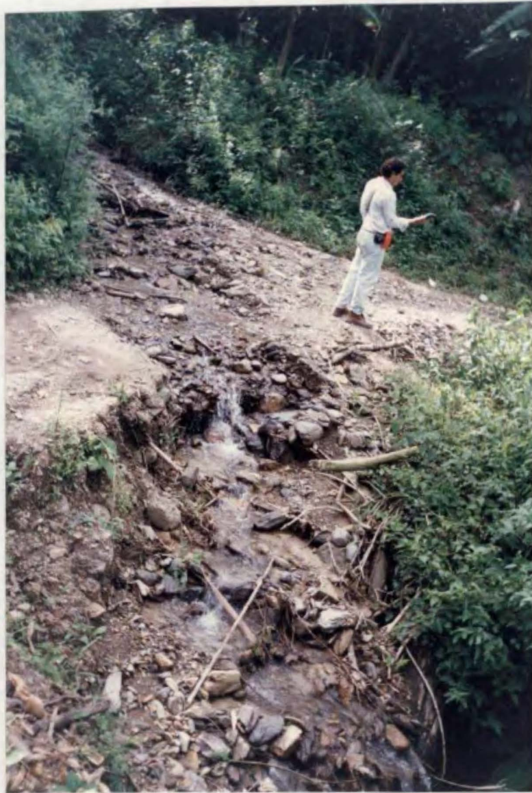
Foto N°3: Quebrada tributaria con un caudal de 100 a 150 l/s, que afecta a la carretera que va al colegio de Hatumpampa, carece de obras de drenaje.
