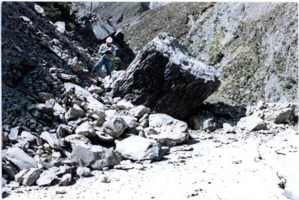
Fotos N° 11 y 12: Derrumbes en rocas volcánicas muy fracturadas y depósitos coluviales poco consolidados, que afectan la carretera de acceso a Charcani. Se observan grietas tensionales en la plataforma de la carretera. Zona Crítica.
