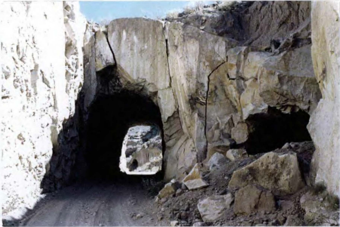
Foto N° 1: Estado y aspectos estructurales del túnel en tobas fracturadas (ingreso a Charcani I). Caída de bloques y derrumbes de los depósitos coluviales ubicados sobre las tobas.
