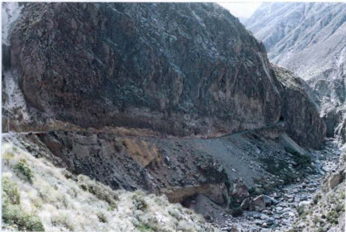
Foto N° 13: Aspecto de un sector de la carretera afirmada del Km 13+000 hacia Charcani V. Se observan derrumbes y desprendimiento de rocas de poca magnitud en depósitos proluviales y coluviales.
