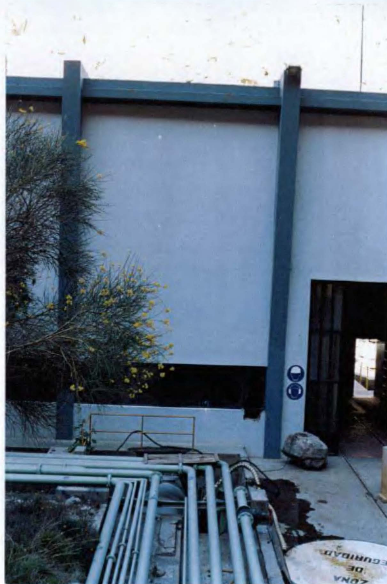
Foto N° 6: Caída de rocas que han afectado las instalaciones de Charcáni IV (A).
