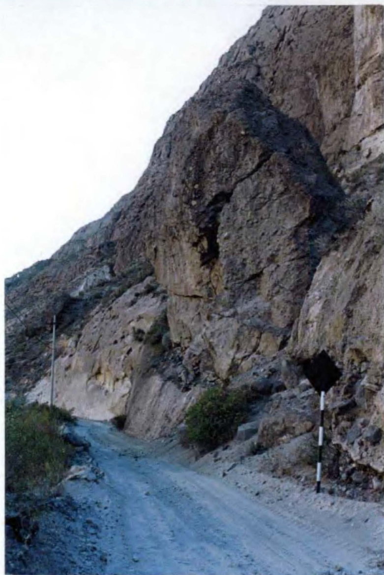
Foto N° 5: Bloque suelto de aglomerado volcánico muy fracturado situado sobre la carretera y la línea de alta tensión. Desquinchar sin explosivos.
