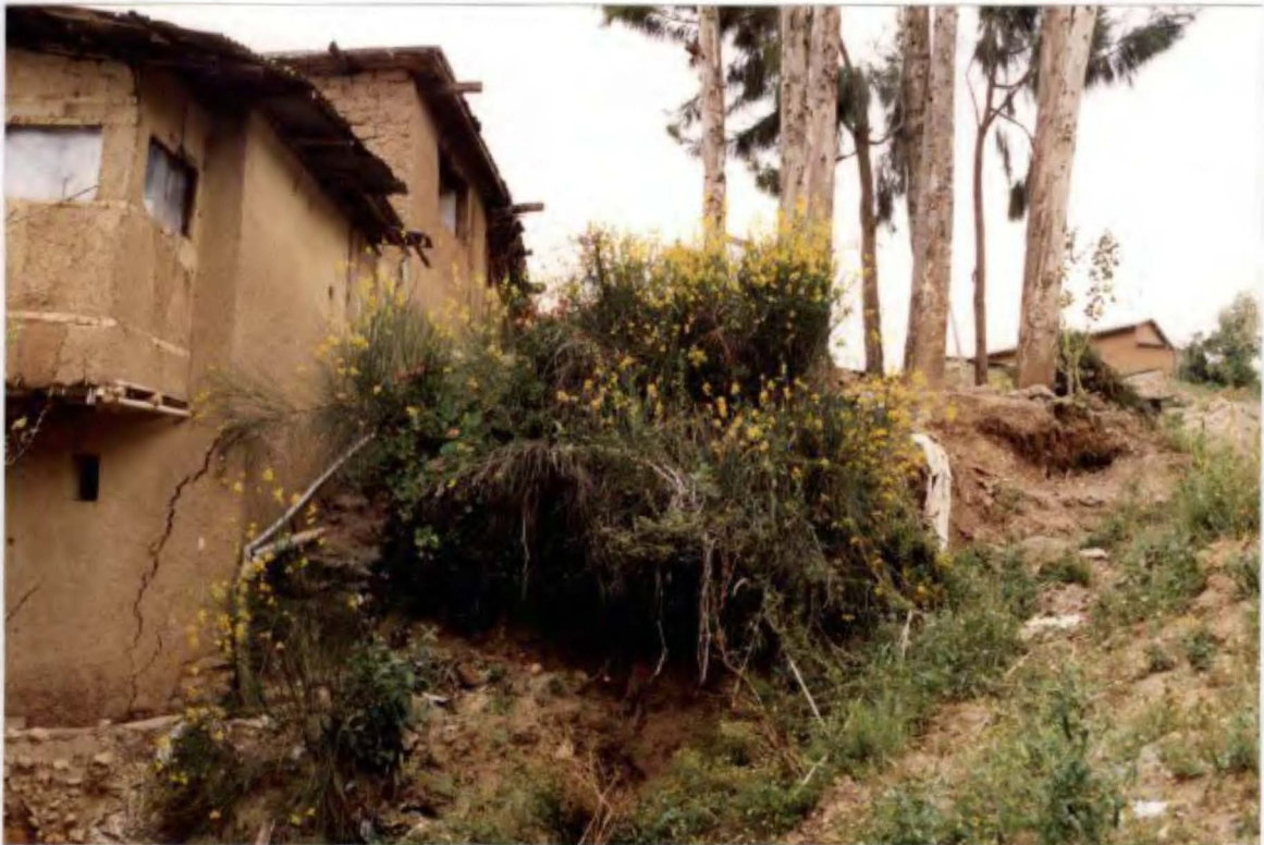
FOTO N° 5-6 Efectos del deslizamiento que dejó fuertes agrietamientos en las viviendas que fueron abandonadas. En la parte cenral de la fotografia N° 5 aparecen ojos de agua (A), que deben ser drenados .
