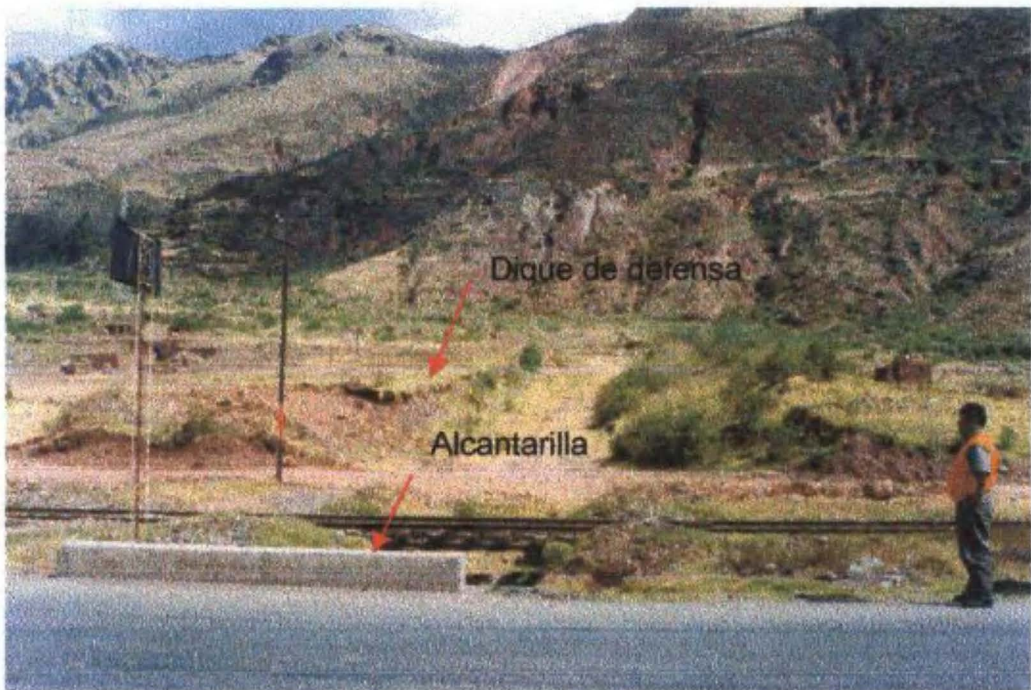
FOTO N°10 .- Vista aguas abajo de la quebrada Hatum Waiq'o, obsérvese los diques de defensa construidos con material arrimado con maquinaria y las alcantarillas de poco diámetro que quedarían obstruidas ante un huayco de regulares dimensiones.
