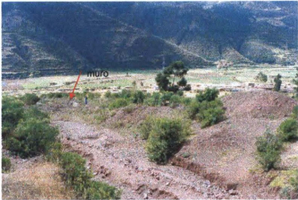
FOTO N° 9.- Vista aguas abajo de la quebrada Hatum Waiq'o, en la margen derecha se observa el material acumulado por el huayco de 1999-2000 que rebasó el cauce y cubrió la defensa ribereña ( muro de 120 m de longitud).
