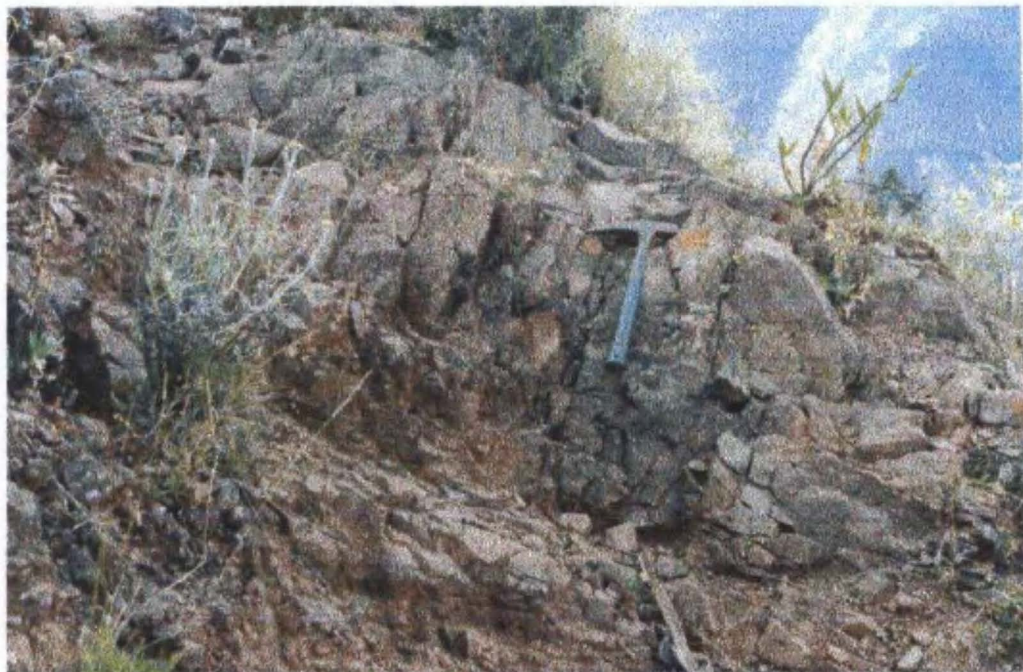
FOTO N° 6 Afloramiento de roca arenisca muy fracturada y alterada por acción de los agentes de la meteorización cerca de la zona de arranque del derrumbe del 4 de junio del 2001.
