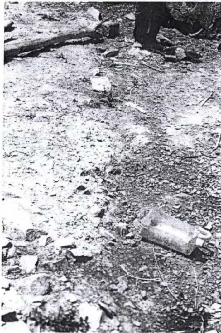
Foto N° 6 Dos vistas del suelo superficial del área de La Laja, coluvial-deluvial, con clastos angulosos en matriz limosa se distingue un leve hundimiento del terreno (vista inferior) y una zona de agrietamiento en el suelo (vista superior)
