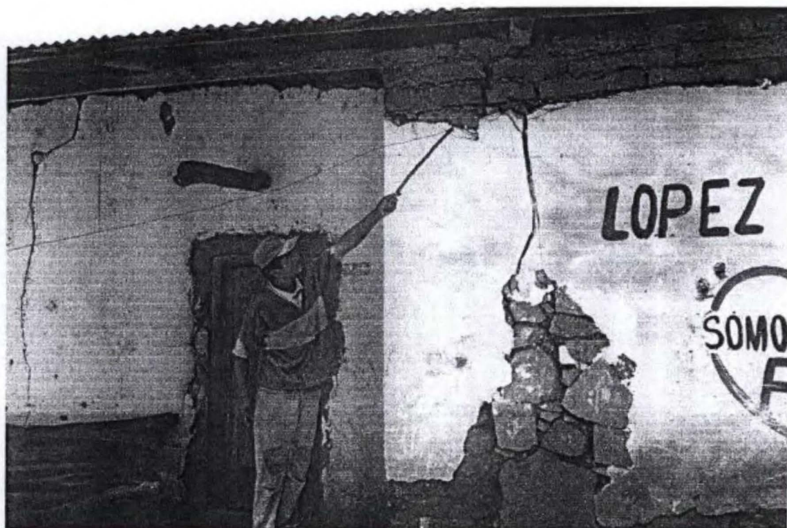
Foto N° 5 Dos vistas del tipo de viviendas existentes en el sector de La Laja (adobe con cemento de piedra), que presentan agrietamientos en las paredes en dos viviendas del sector.
