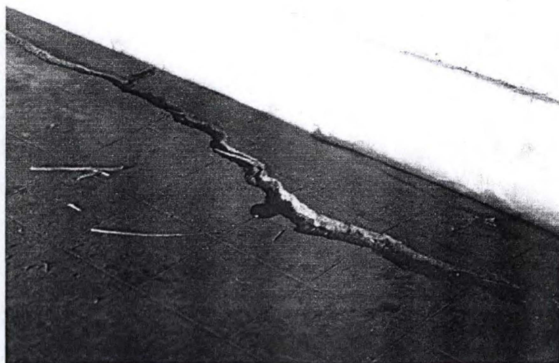
Foto N° 4 Dos vistas de agrietamientos en el piso de una vivienda en el sector de La Laja, del orden de centímetros. Probable ocurrencia de deslizamiento.
