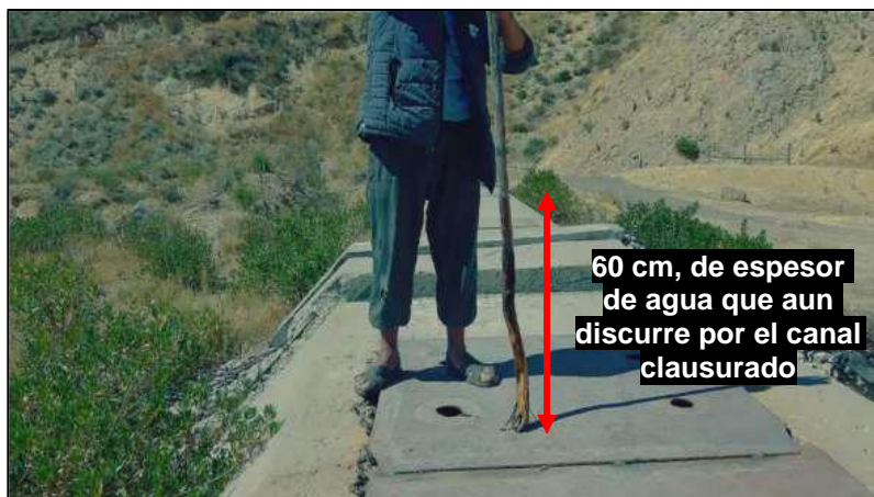
Figura 10. Canal Majes Sigvas, presencia de agua en tramos clausurados de canal. Informe técnico N° A7115. INGEMMET (2021).
