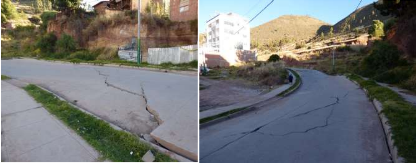
Figura 5.4 Vistas de múltiples agrietamientos, asentamientos y enduzamientos en la plataforma de carretera.
