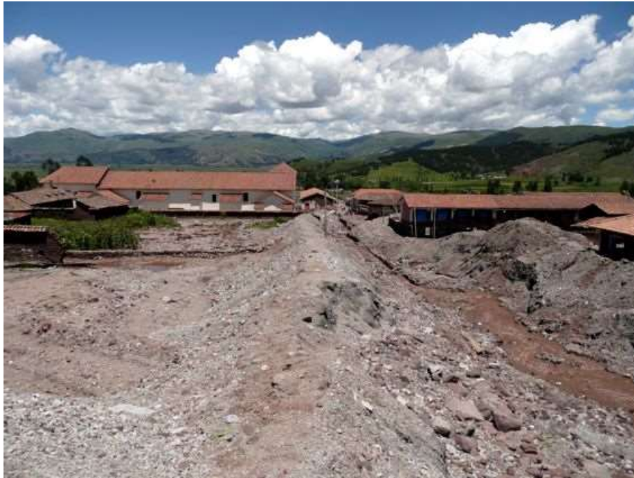
Fotografía 5.29. Cauce colmatado de la quebrada Qenqo, el material transportado superó la capacidad de carga del canal produciéndose desbordes y la formación de albardones. El flujo de detritos afectó viviendas y calles de Zurite.
