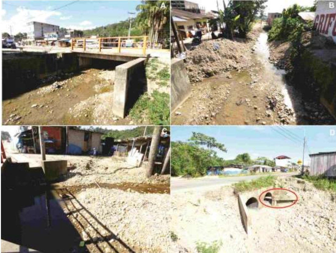
Figura 8.13 Tramo de carretera Interoceánica es cortado por quebradas por las que discurren huaicos a consecuencia de lluvias intensas. En enero del 2014 se desbordó y afectó viviendas que se encuentran en ambas márgenes del Jr. Masuko del poblado del mismo nombre. Los colectores de drenaje pluvial también desembocan en estas quebradas (A, B y C). En el km 261-863 se ha colocado dos alcantarillas por donde pasa la tubería de agua potable, marcado por el círculo de color rojo (D).
