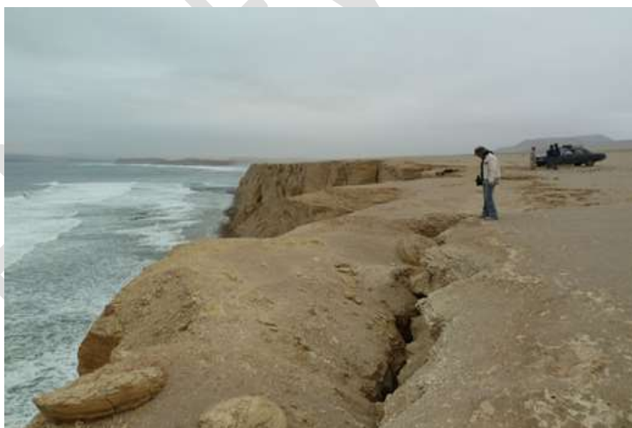
Fotografía 7.7 Asentamientos y agrietamientos en el acantilado de la Playa Las Salinas, en el extremo sur de la playa Yumaque
