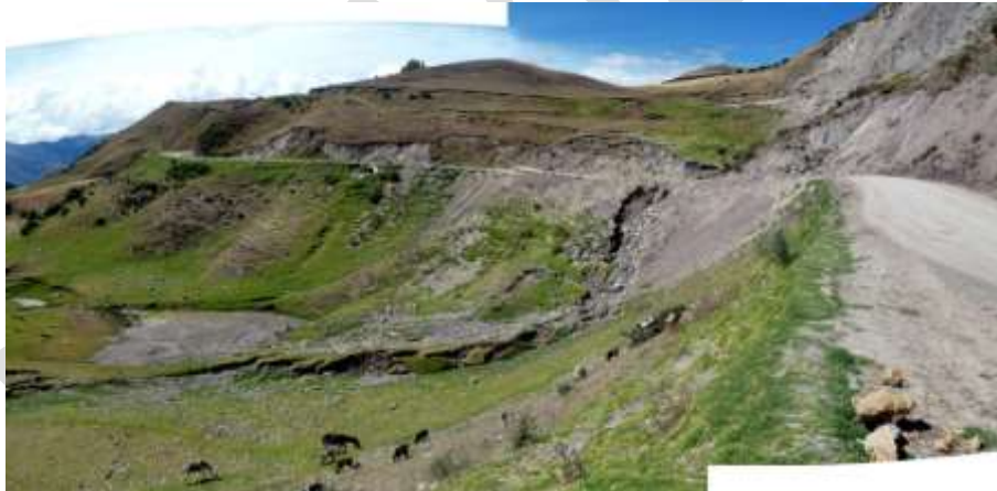
Fotografía 6.9 Deslizamiento en el sector de Vista Alegre, produce asentamientos en la carretera Churcampa-Colcabamba.
