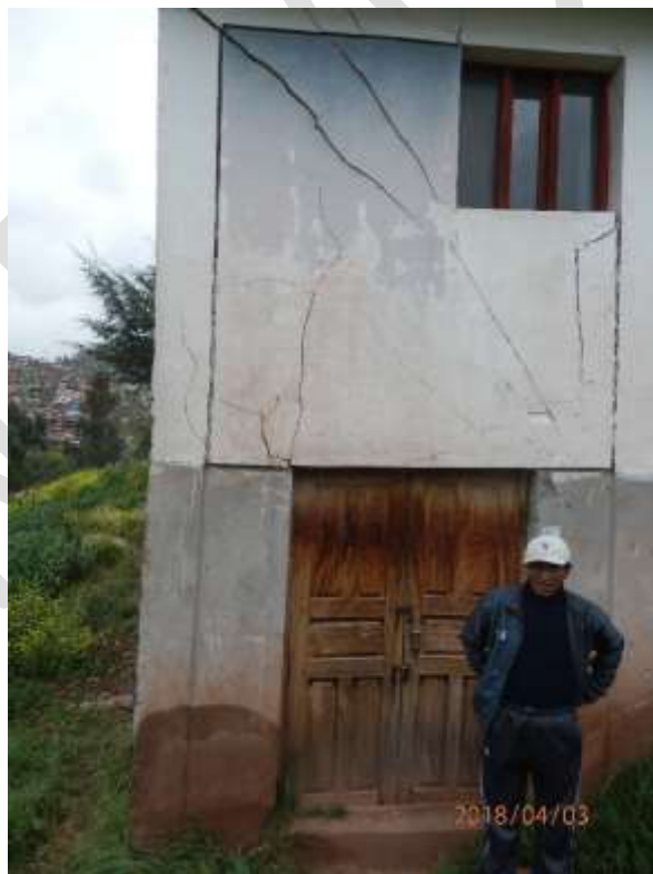
Fotografía 5.13 Vivienda afectada en el lado derecho del deslizamiento; se observa fisuras en las paredes.
