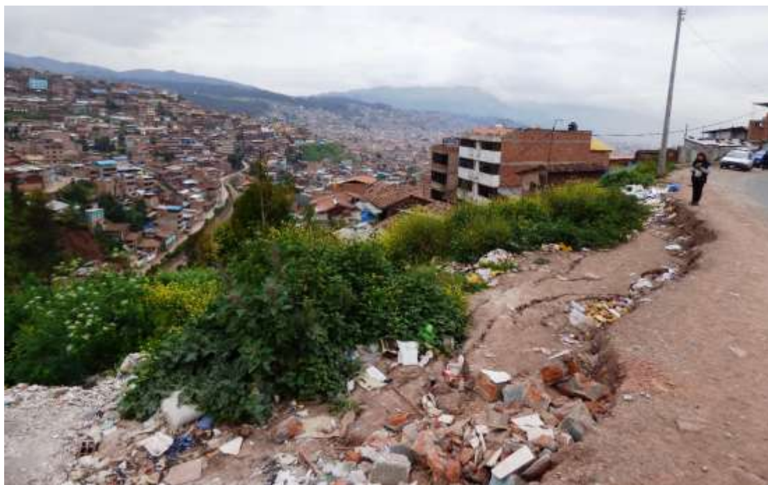
Fotografía 5.18 Talud inferior de la carretera de la avenida Antonio Lorena donde se observa escarpa de deslizamiento.
