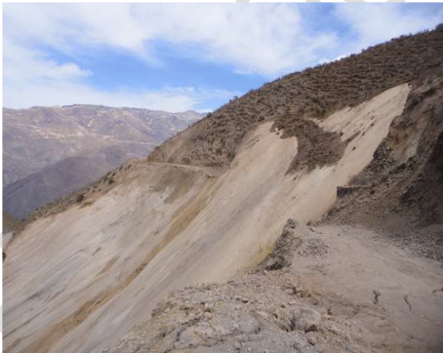
Fotografía 6.12 Vista del deslizamiento en las progresivas 39+450- 44+200 / Cerro Jayana, se observa el plano de deslizamiento (2011).
