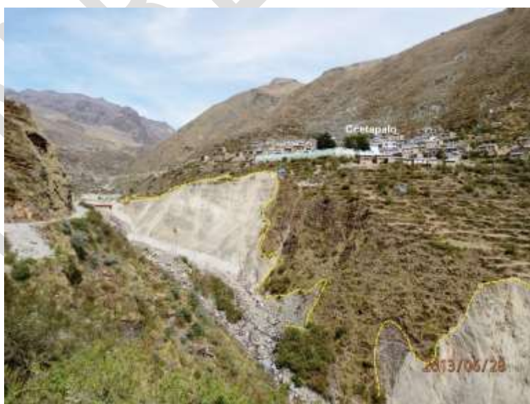
Figura 10.4 Sector Ccetapalo – quebrada Cancapunca, susceptible a derrumbes. Detonadas por las intensas lluvias. Afectaría viviendas que se encuentran al borde de la quebrada.
