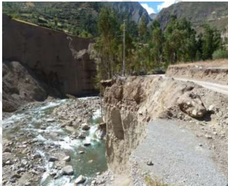
Fotografía 6.3. Erosión fluvial, derrumbes-flujos en la carretera que une los sectores de Acoria y Mariscal Cáceres.
