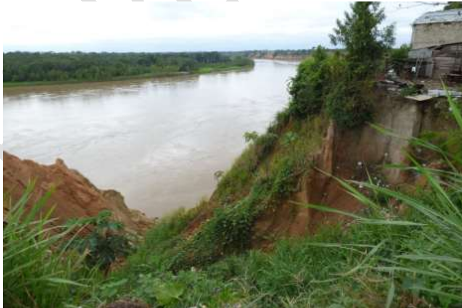
Fotografía 8.1 Erosión en cárcavas formadas en la margen derecha del río Madre de Dios, en el cruce de la Av. Circunvalación y Andrés Avelino Cáceres
