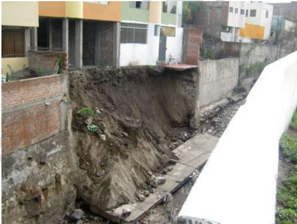
Fotografía 3.3 Vivienda afectada y colapso de muro de contención en la margen derecha de la quebrada San Lázaro debido al incremento del caudal por efecto de las lluvias excepcionales del 08/02/2013.
