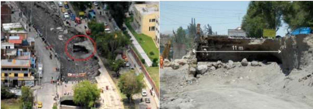
Figura 3.18 Erosión fluvial en la margen derecha de la torrentera Venezuela se llevó parte plataforma de la vía de la Av. Venezuela hasta la berma central, de aprox. 135 m de longitud y un ancho de 11 m.
