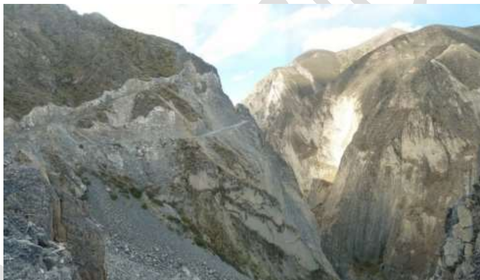
Fotografía 4.10 Talud de carretera Pomabamba-Sarhua-Huancasancos, intensamente fracturado. Se producen derrumbes y caída de rocas.
