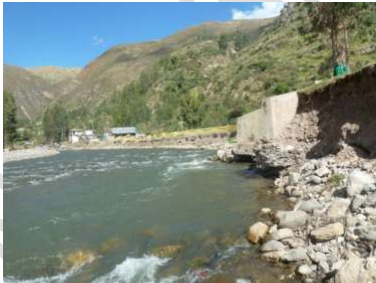
Fotografía 6.17 Vista de las bases socavadas de los estribos del puente Alambrijo y erosión en la plataforma de la carretera.
