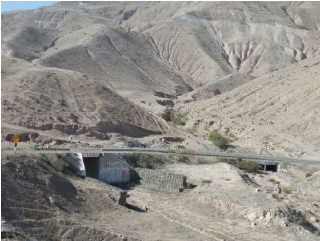
Fotografía 9.4 Flujos de detritos cortan la carretera Binacional km 37+530, se observa intensa erosión en cárcavas en la cabecera de las quebradas también pueden generar huacos.
