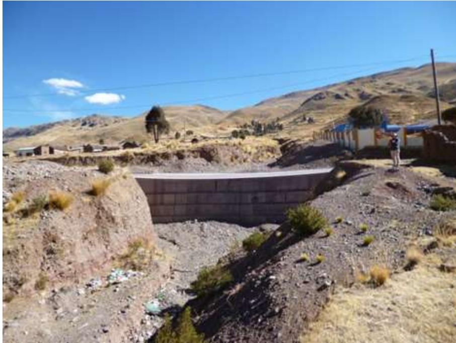
Fotografía 5.35 Flujo de detritos en el sector de Porvenir, Km. 19 de la carretera Sicuani-Espinar.
