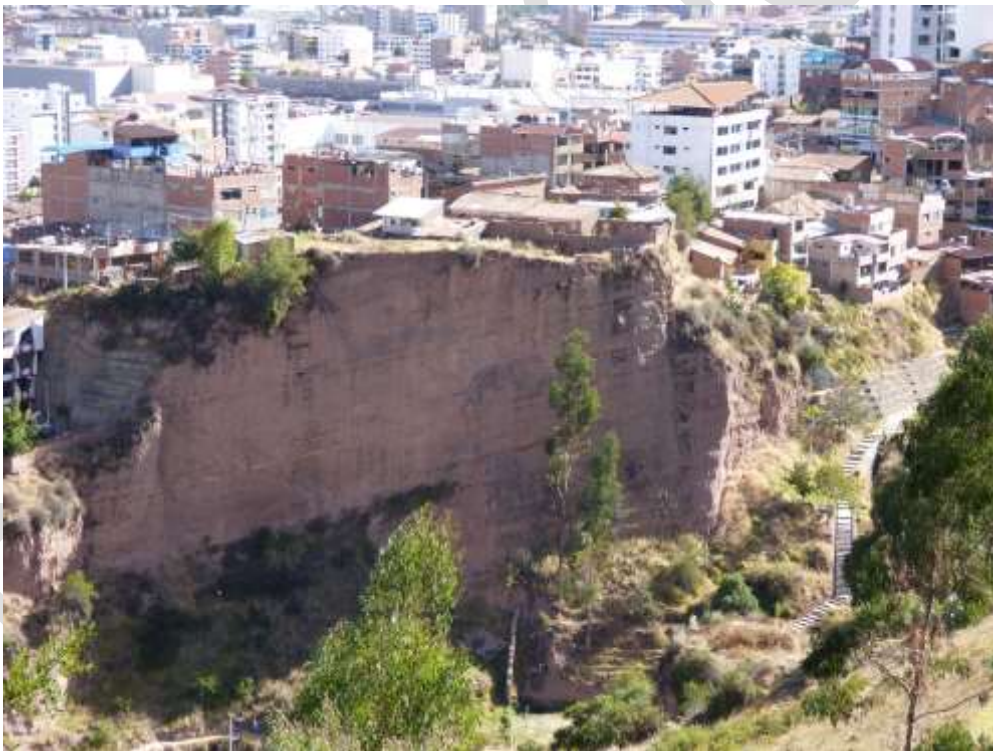
Fotografía 5.9 Acantilado vertical en la margen izquierda de la quebrada Shihuila; se observan viviendas construidas en el borde del acantilado.
