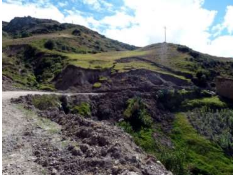
Fotografía 6.8 Deslizamiento en el talud superior de la carretera, localizado encima del poblado de Churcampa.
