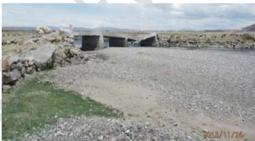
Fotografía 10.4 Vista del puente Caturay, se observa daños a la base del puente, ocasionado por peligros geohidrológicos de tipo erosión fluvial.
