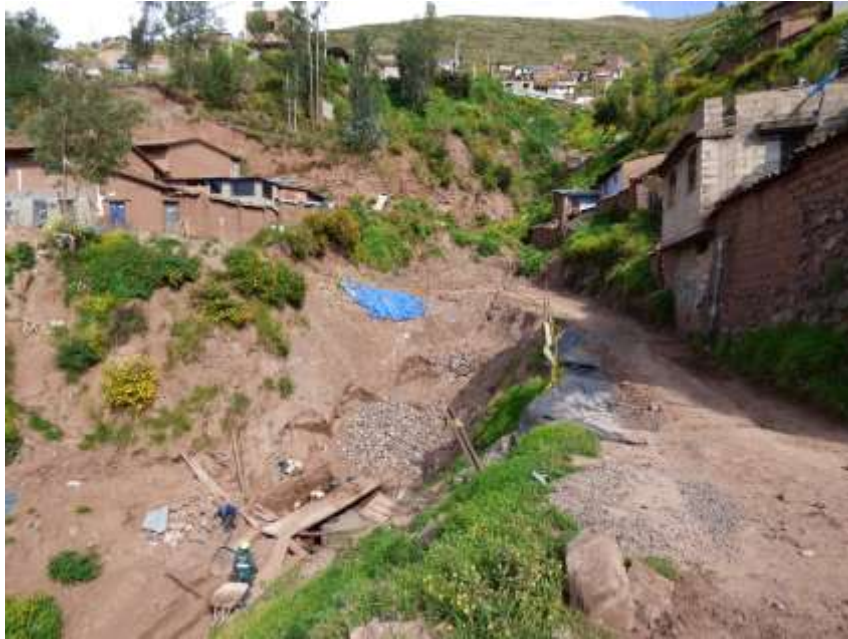
Fotografía 5.20 Proceso de erosión en cárcava en desarrollo ubicado en el sector de Tinco.
