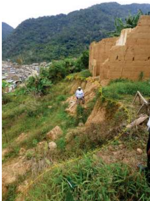
Figura 10.10 Escarpa de deslizamiento que ocasionó daños en algunas viviendas de Putina Punco.
