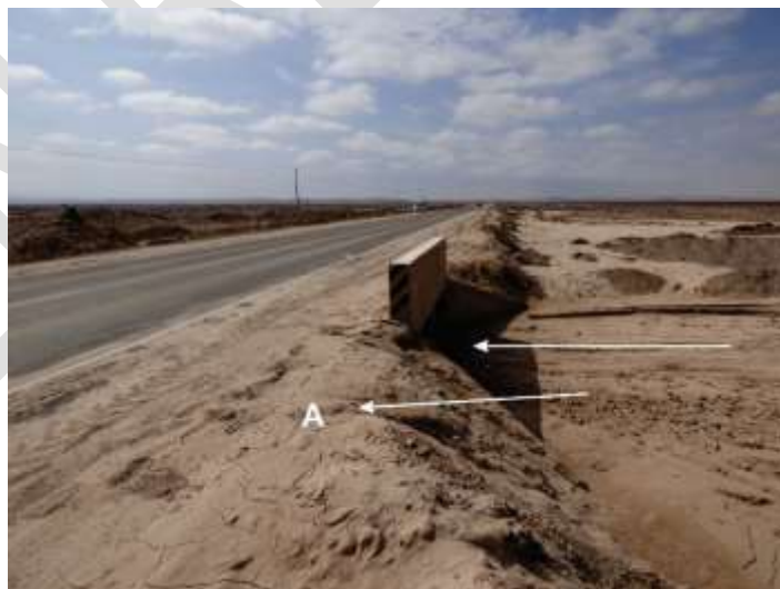
Figura 11.12 Flujo de lodo del 26 de marzo de 2015 afectó tramo de la carretera Panamericana Sur, km 1274+140.
