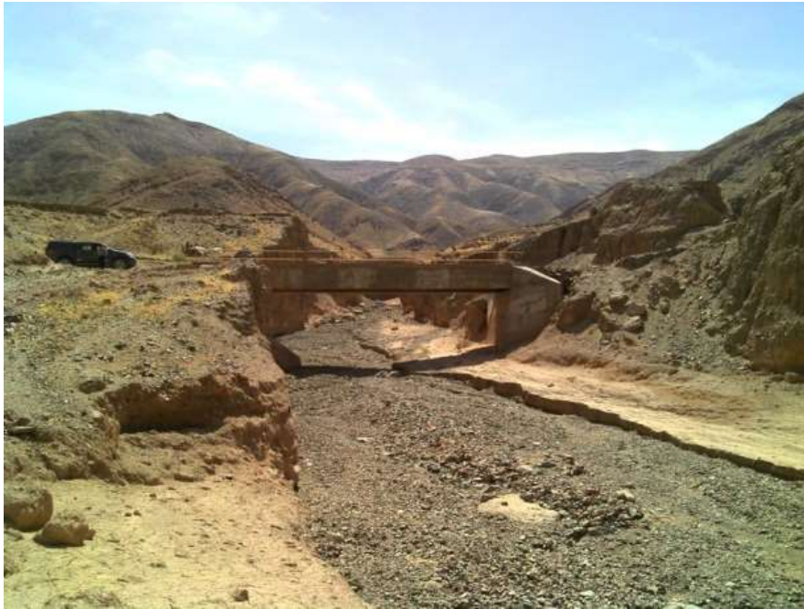
Fotografía 7.5 Quebrada Aparpo, carretera a Tibillo, que se activa excepcionalmente.
