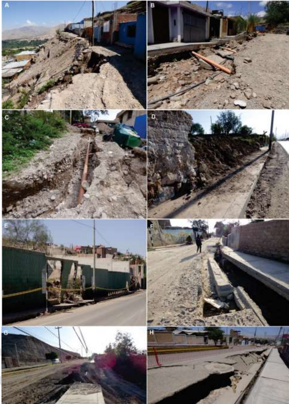
Figura 9.18 Daños ocasionado por el flujo de detritos del 26/02/2020. A) En la parte alta de Samegua cerca del mirador, se generaron huaicos que discurrieron a través de cárcavas afectando viviendas que se encontraban asentadas sobre ladera inestables. B) Socavación de la calle Los Ángeles producto del recorrido del flujo del 26/02/2020. C) Las redes de agua potable colapsaron por el paso del flujo que discurrió por una margen del estadio Maracaná. D) Muro perimétrico del Fundo Los Ribero colapsado por el empuje del huaico. E) Muro del cuartel Los Ángeles colapsado desde la Av. Andrés A. Cáceres. F) Flujo socavó las veredas de la calle Antigua Samegua. G) Huaico socavó 28 m de vereda y carpeta asfáltica de la Av. Andrés A. Cáceres. H) Socavamiento de cuneta y 275 m de carpeta asfáltica de la Av. Andrés A. Cáceres, dejando buzones de desagüe descubiertos.
