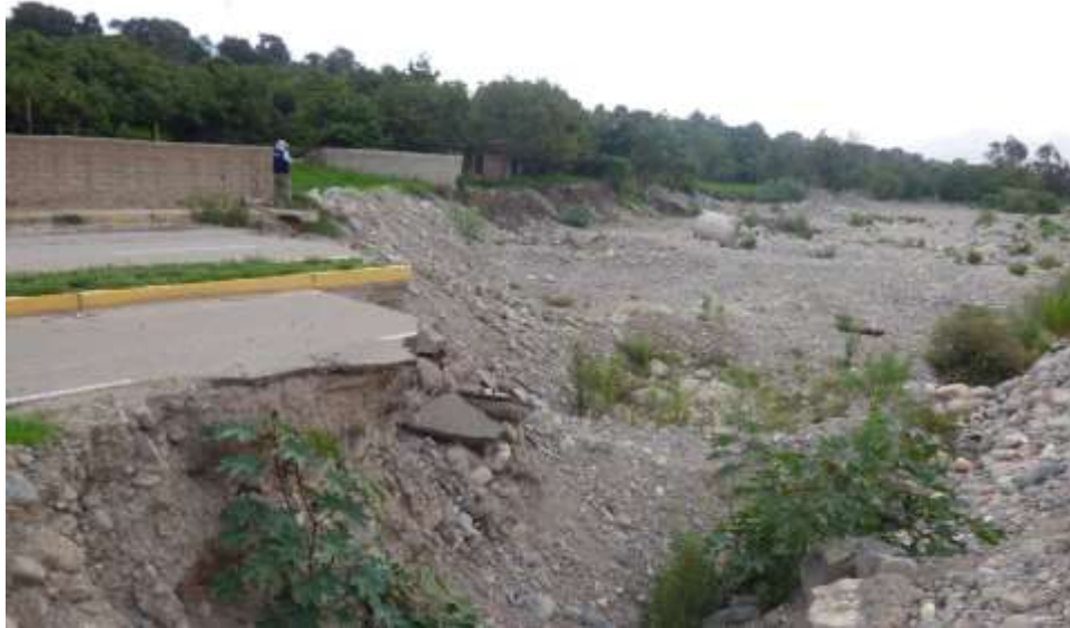
Fotografía 9.6 Erosión fluvial en la margen izquierda del río Tumilaca, sector Samegua, puente Tucumán, de ocurrencia frecuente en los años 1997, 2015, 2016, 2019 y 2020, el cauce principal del río Tumilaca es de 45 a 51 m de ancho. En el año 2015, el incremento del caudal del río Tumilaca produjo erosión en ambas márgenes en una longitud de 310 m, destruyendo parte del muro de encauzamiento, los bloques de roca colocados como protección fueron removidos y el arrimado de material fue erosionado. Se llevó un tramo de la plataforma del Malecón ribereño cerca del puente de 53 m, callejón San Juan, así como la pérdida de terrenos de cultivo.
