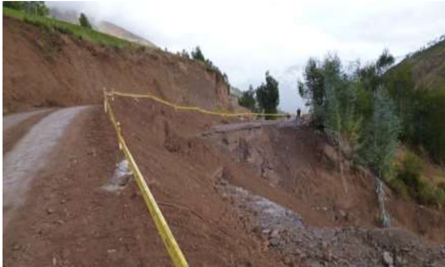
Fotografía 5.26 Deslizamiento que cortó toda la plataforma de la carretera en el Km. 3+630 de la carretera Calca-Yanatile, substrato de areniscas, limolita roja e ignimbritas.
