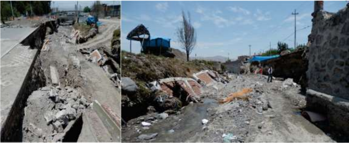
Figura 3.20 Presenta erosión de la vía asfaltada en la Av. Venezuela, debido al socavamiento de los cimientos de muros de sillar del mercado que generó el colapso de los mismos en el mercado Mariscal Castilla.
