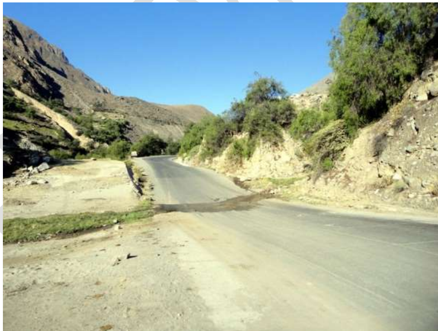
Fotografía 6.23 Quebrada a la altura del poblado de Capana por donde discurren flujos de detritos; se ha colocado badén en carretera.
