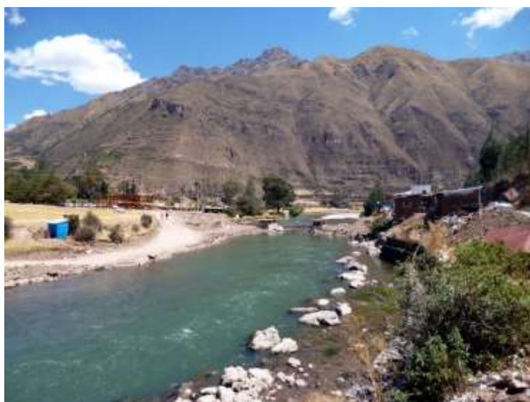
Fotografía 5.22 Sector de Chuquicahuana, puente sobre el río Vilcanota que permite el paso de vehículos hacia Acomayo, destruido por efectos de la erosión fluvial.
