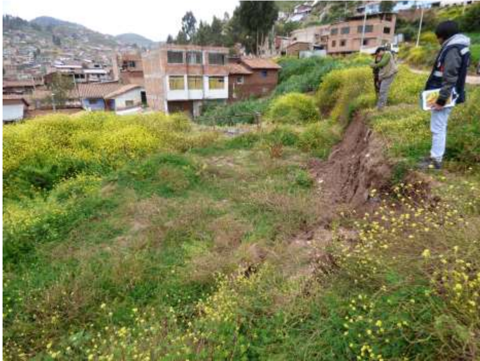
Fotografía 5.12 Escarpa de deslizamiento rotacional activo ubicado en la Asociación Provienda Camino Real.
