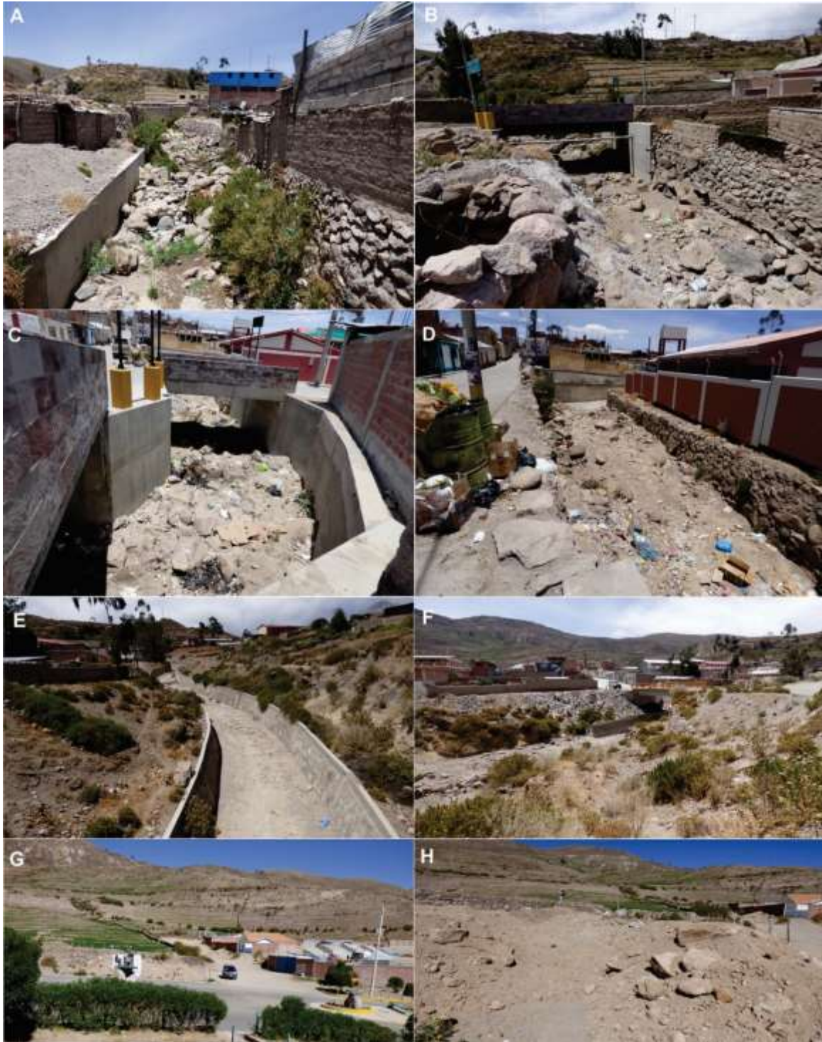
Figura 11.6 A) Cauce colmatado del río Candarave, aguas arriba del puente 2 de Mayo. B) Cauce estrangulado y colmatado aguas arriba del Puente El Triunfo. C y D) Cauce canalizado por partes se encuentra colmatado, aguas abajo del puente Dos de Mayo. E y F) Tramo canalizado del río hasta el puente Candarave, en la parte alta, el cauce se encuentra colmatado y reducido entre 5 a 6 m; G y H) depósito del último huaico acarreado por la quebrada Jucuturi.
