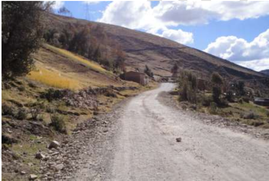
Fotografía 6.10 Vista de perfil de los asentamientos y agrietamientos en la plataforma de la carretera por efectos de un deslizamiento en el sector de Huaribambilla.
