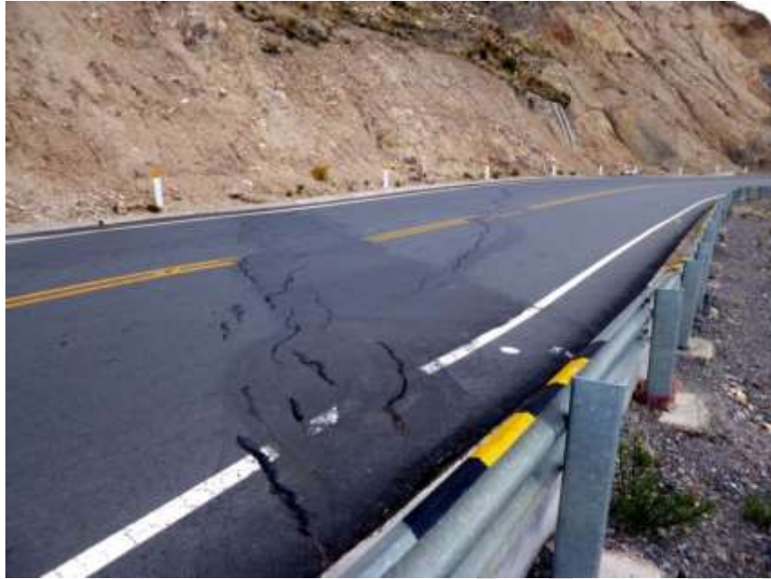
Fotografía 5.28 Plataforma de carretera asfaltada agrietada y con asentamientos.
