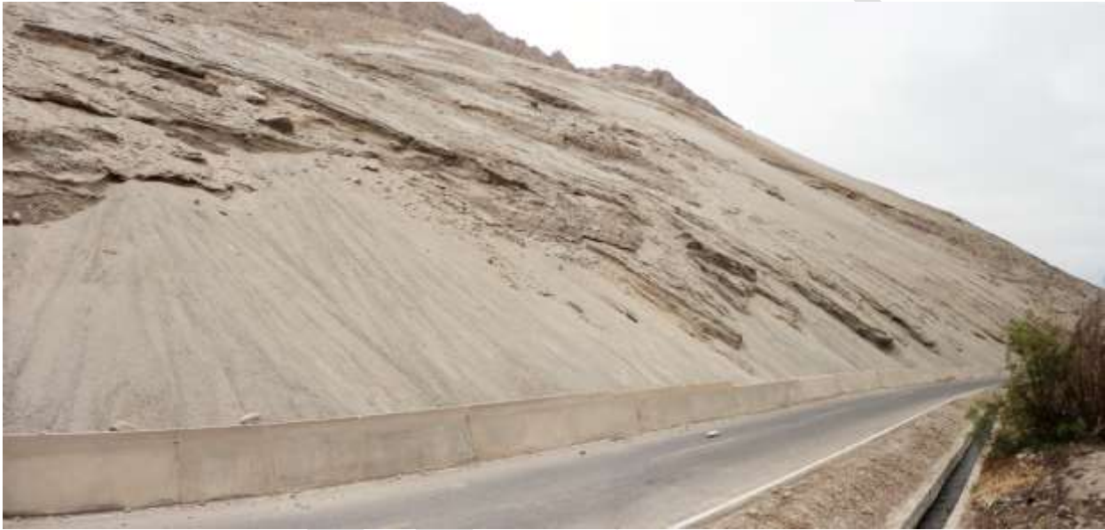
Fotografía 9.2 Derrumbe en talud superior de la carretera asfaltada Ilo-El Algarrobal, se han colocado muros de contención de 1 m x 60 m, en km 8+050, en el sector El Higueral.
