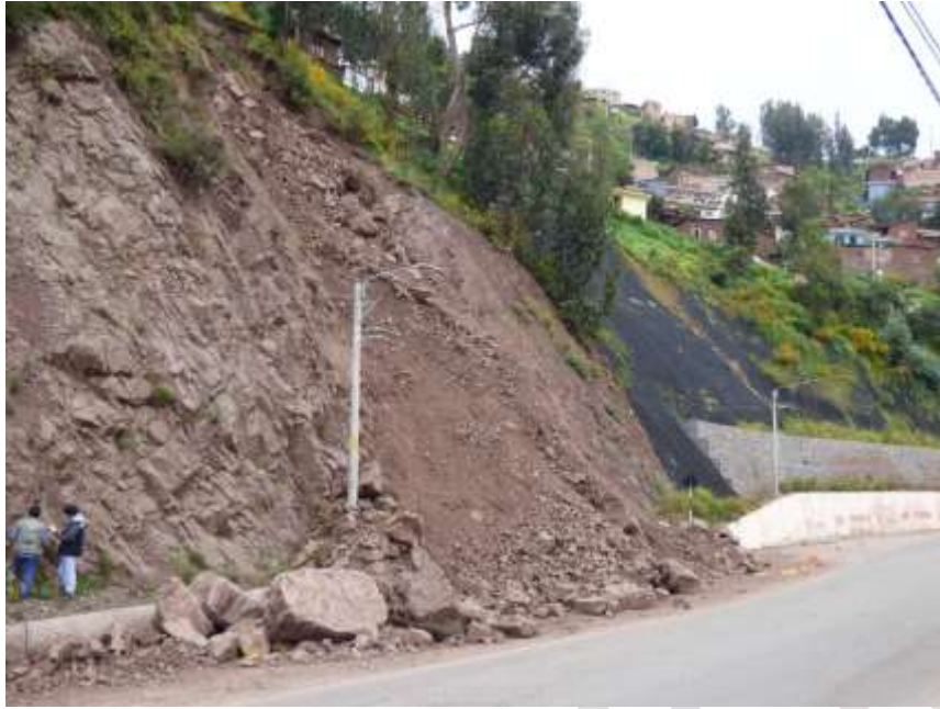
Fotografía 5.16 Caída de rocas y derrumbe en talud de la carretera de la avenida Antonio Lorena. También, se observa muros de contención construidos en base a gaviones y talud cubierto con geomalla.
