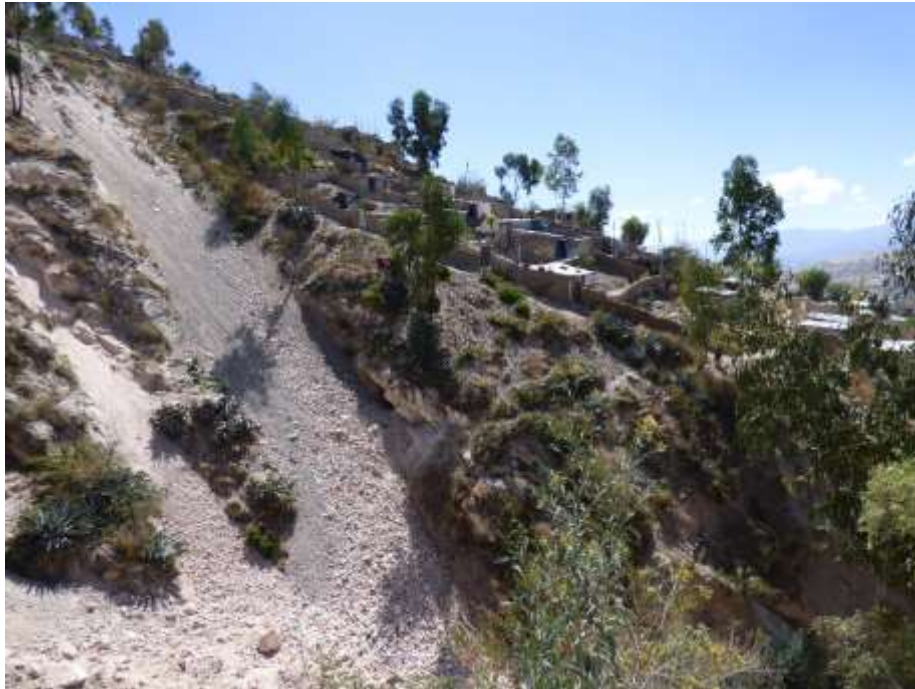
Fotografía 4.4 Viviendas asentadas cerca a la ladera afectada por cárcava y susceptibles a la ocurrencia de derrumbes Sector Asentamiento humano Silvio Forestal
