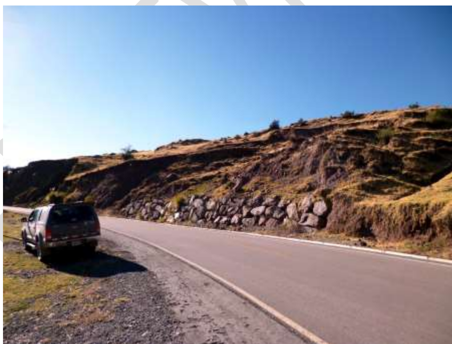
Fotografía 5.34 Carretera Acomayo-Pitumarca, zona donde se presenta asentamiento en el talud superior de la carretera por efectos de un deslizamiento activo
