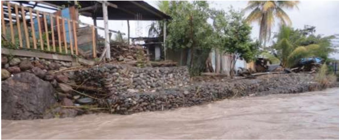
Fotografía 4.15 Defensas ribereñas conformadas por enrocado y gavión, afectada por el socavamiento del río Apurímac
