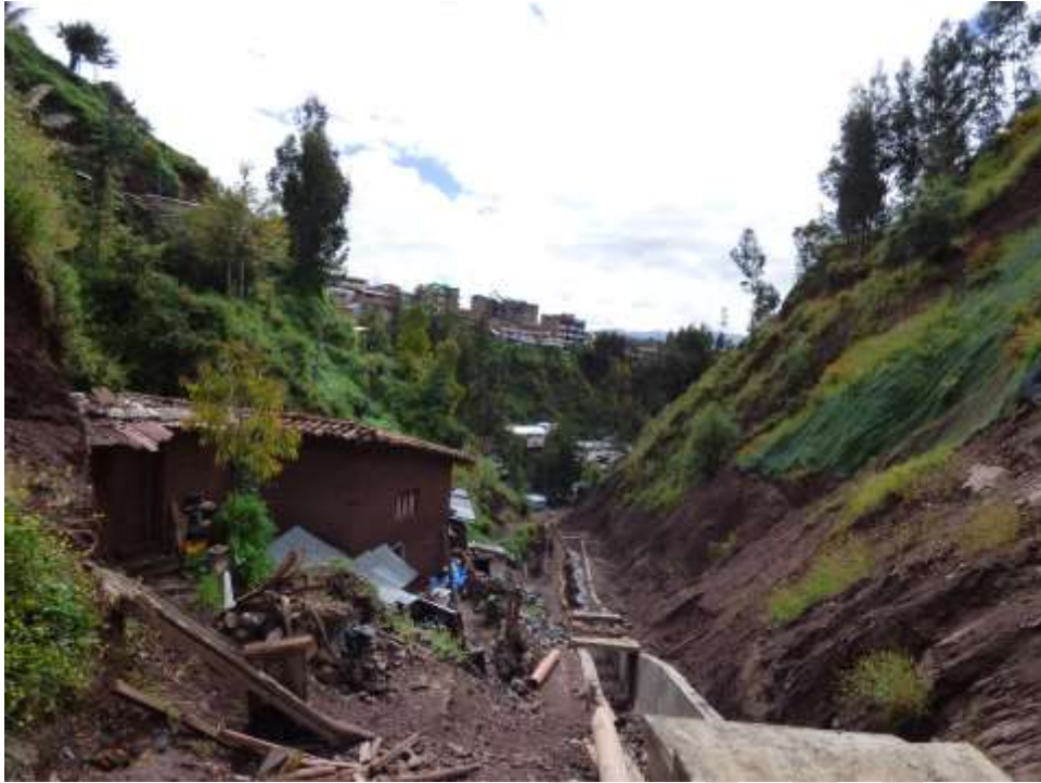
Fotografía 5.14 Laderas inestables ubicadas en la quebrada Ayahuayco.
