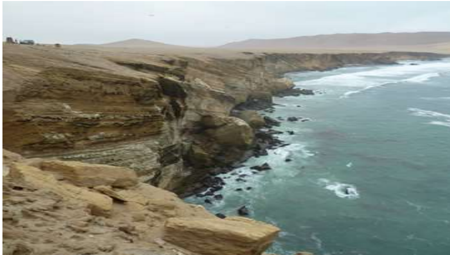
Fotografía 7.8 Sector Punta Arquillo, desde donde se produjo la caída de rocas que afectó la zona de descanso de lobos marinos.
