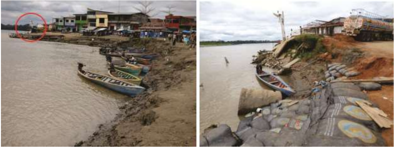
Figura 8.10 Vistas del Puerto Laberinto debido a la erosión fluvial de 200 m de longitud. Colapsó un grifo, se colocó costales de arena a fin de mitigar dicho proceso.
