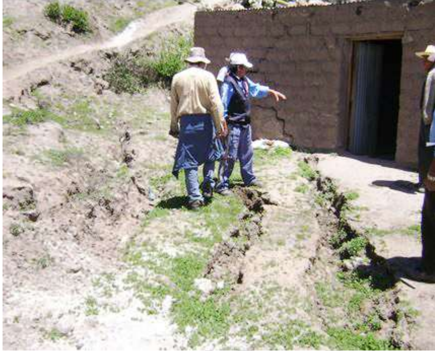
Fotografía 9.1 Vista de agrietamientos en el terreno, también se presenta en viviendas de Amata.
