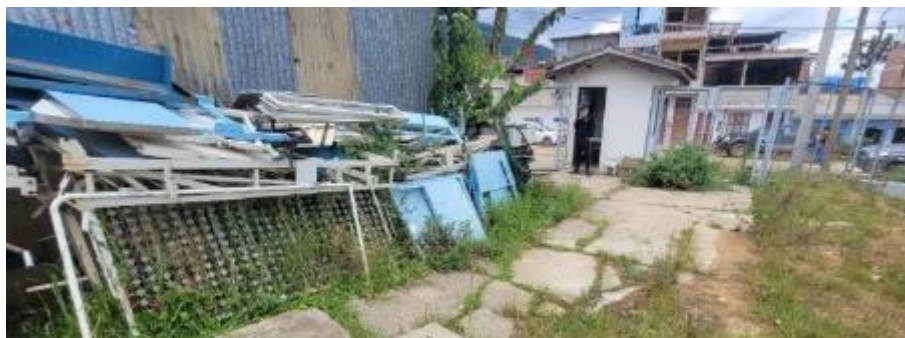
Fotografía 9. Estado de las instalaciones del establecimiento de salud afectado por reptación de suelos. Coordenada: E: 182791; N: 93309746; Z: 2367.
