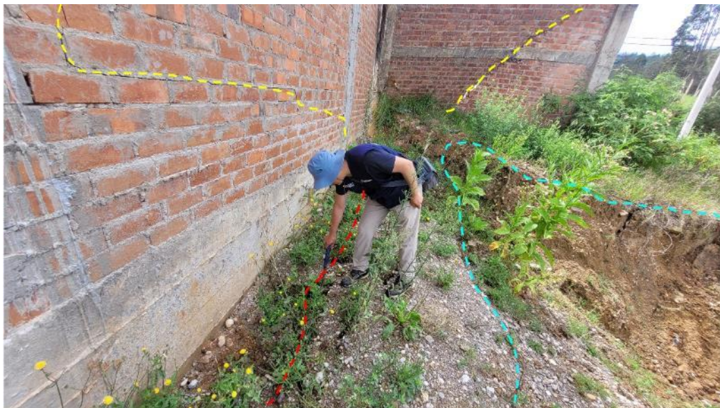
Figura 11. Agrietamiento de tracción en la parte posterior de la corona del deslizamiento DRA2 (en línea roja) que ha afectado una vivienda (fracturas estructurales en amarillo), además un sector de erosión demarcado en línea celeste. Coordenadas: E: 181979; N: 9309265; Z: 2293.
