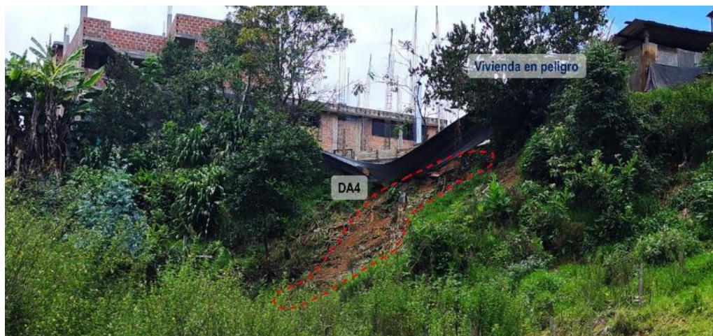
Figura 27. Vista del derrumbe activo 4. Coordenadas: E: 182838; N: 9310007; Z: 2391.
