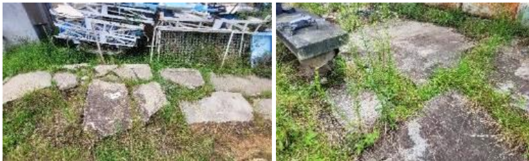
Fotografía 11. Muestra de agrietamientos en veredas del establecimiento de salud afectado por reptación de suelos.
