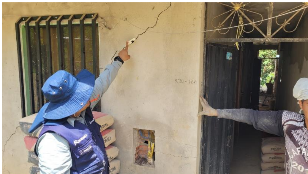
Fotografía 13. Fractura en una pared de una vivienda aledaña a los derrumbes activos. Coordenadas: E: 182827; N: 9309936; Z: 2379.
