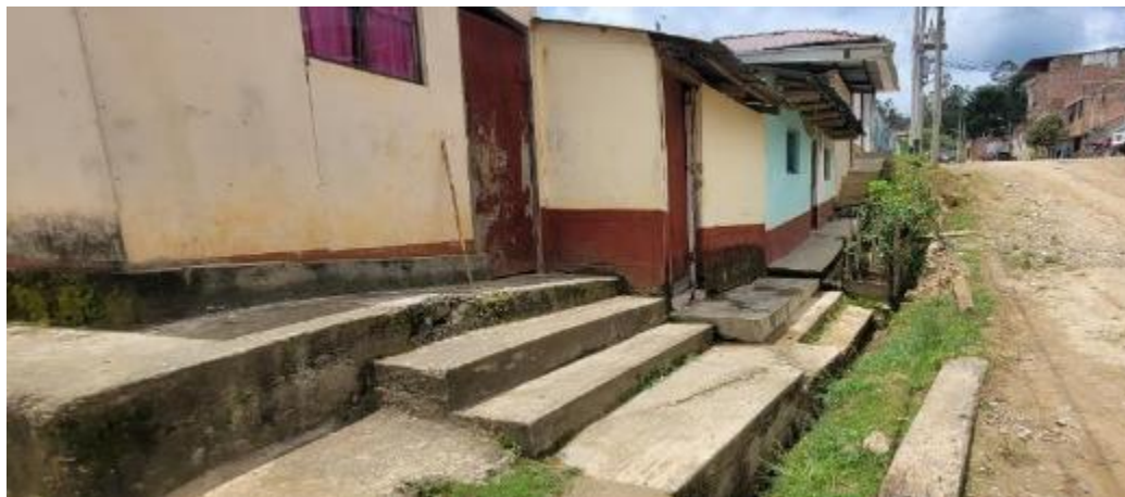
Fotografía 12. Viviendas afectadas por hundimiento debido al proceso de reptación de suelos. Coordenadas: E: 182727; N: 9309770; Z: 2360.
