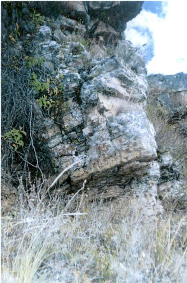
FOTO N°3 : Estratos de areniscas de la Fm. Farrat muy fracturada que favorece a filtración de aguas meteóricas.
