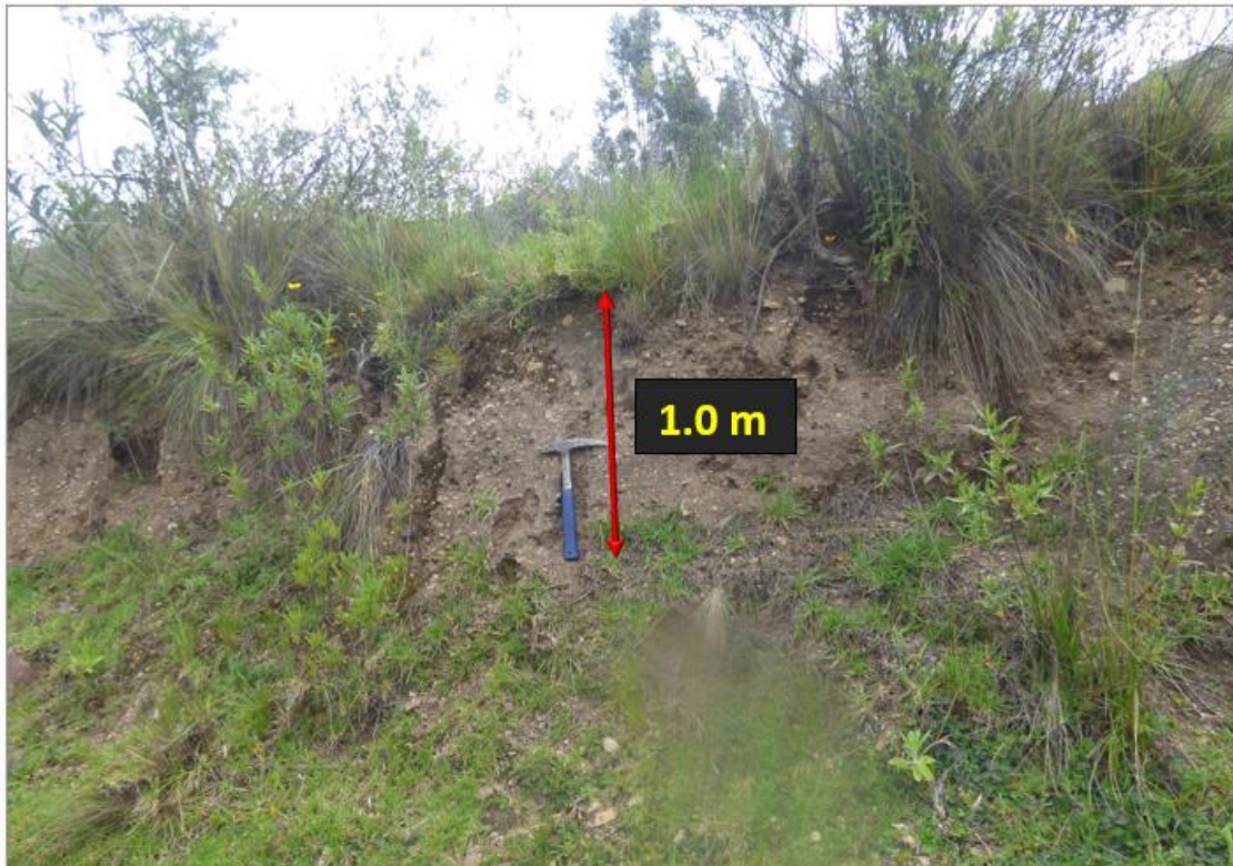
Figura 3: Se resalta un desnivel del terreno (saltos verticales de deslizamientos) de 1 m aproximadamente, conformado por material inconsolidado. Esta característica indica reactivaciones del deslizamiento antiguo.
