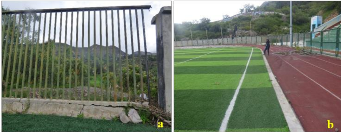
Figura 5: a) Vista de las rejas del estadio inclinadas a favor del movimiento. b) Piso ondulado del estadio Municipal de Chavín de Huántar.
