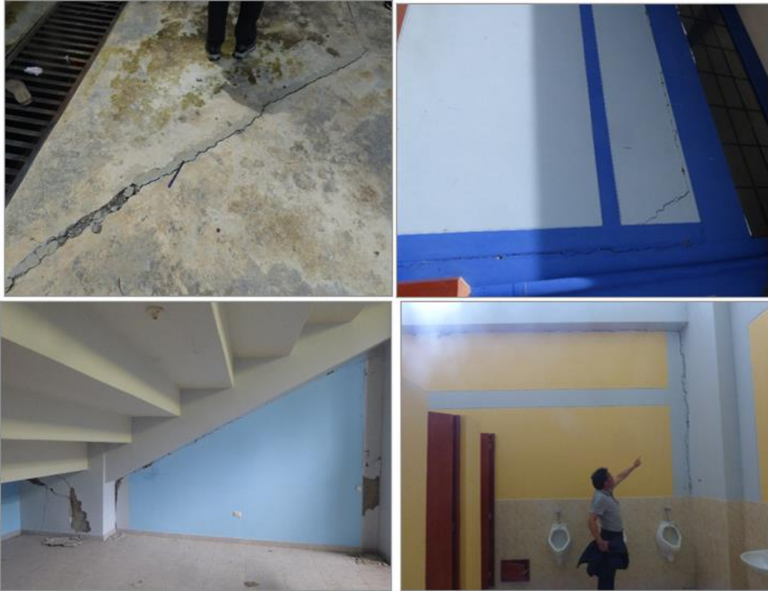
Figura 4: Vista de las rajaduras en el piso y paredes del interior de la tribuna del estadio Municipal de Chavín de Huántar.
