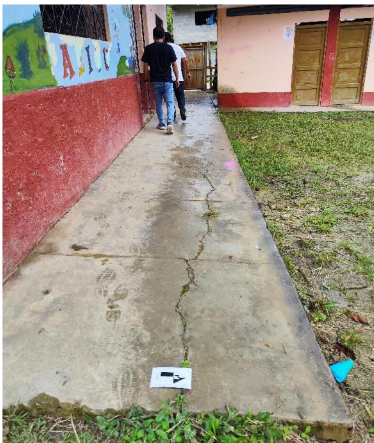
Fotografía 8. Vereda de la IE 16283 afectada por agrietamientos debido a asentamiento diferencial. Ubicación: E: 787860, N: 9378288, Z: 1322.
