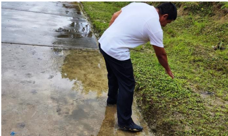
Fotografía 7. Drenaje en mal estado en la parte central de la IE 16283. Ubicación: E: 787832, N: 9378285, Z: 1317.
