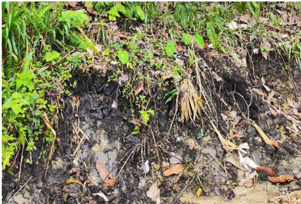
Fotografía 2. Suelos coluvio deluviales compuestos por arcillas de alta plasticidad ubicadas en el tramo afectado por deslizamiento de la vía AM-534. Ubicación: E: 787820, N: 9378046, Z: 1309.
