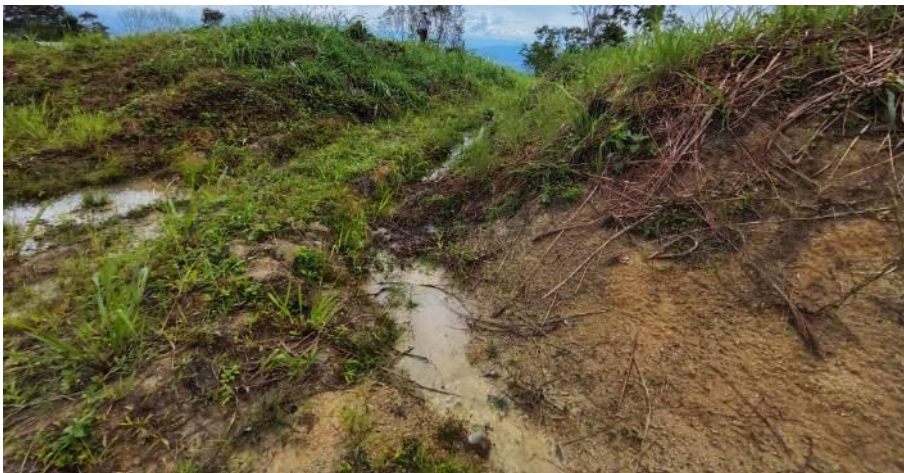
Fotografía 6. Drenaje en mal estado en la parte alta de la IE 16283. Ubicación: E: 787825, N: 9378315, Z: 1321.
