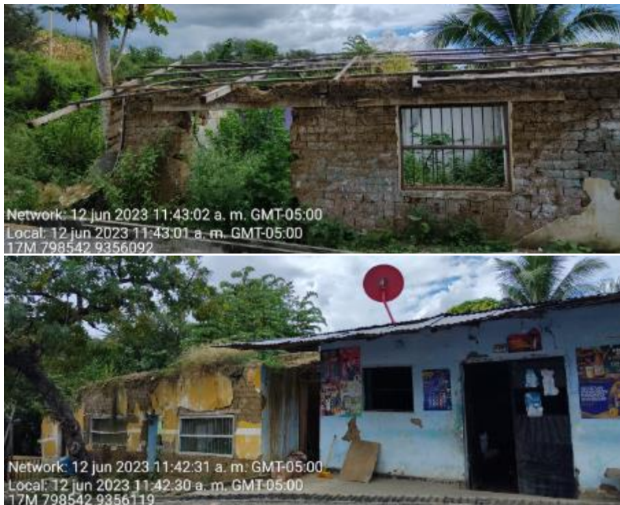
Fotografía 5. Viviendas inhabitables del caserío Ñunya Temple ubicadas en la parte inferior del deslizamiento.
