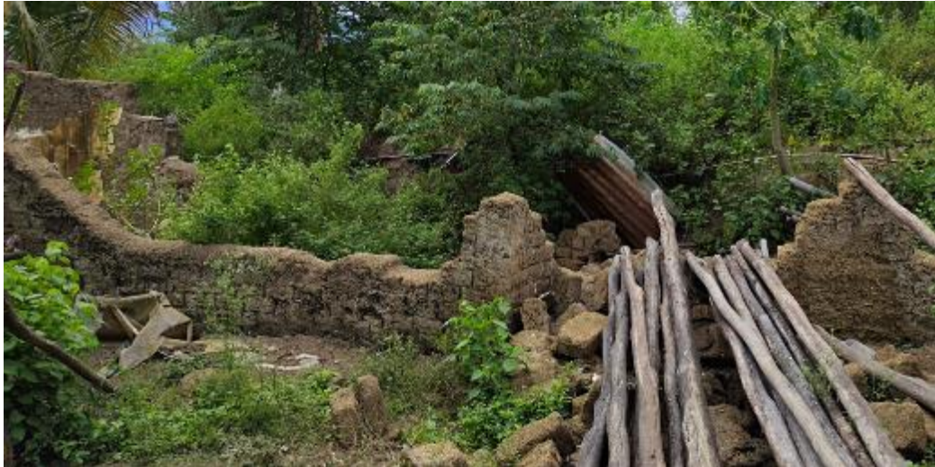
Fotografía 3. Vivienda destruida en el flanco derecho del deslizamiento Ñunya Temple. Coordenadas: E: 798034; N: 9355690
