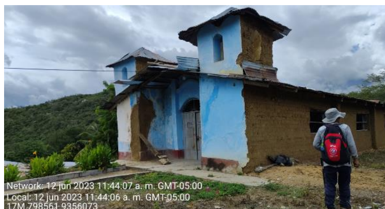
Fotografía 6. Iglesia del caserío Ñunya Temple afectada por el deslizamiento.
