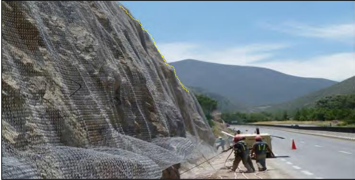
Figura 37. Mallas de protección con anclajes para caída de rocas o derrumbes tanto en detritos como roca alterada, (Vilchez, 2021)
