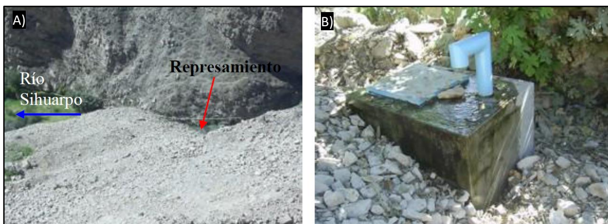
Figura 24. A) Material del segundo derrumbe, que originó un pequeño represamiento en el cauce del río Sihuarpó. B) Reservorio de agua en mal estado, donde existen fugas de agua que se infiltran en el terreno. Vilchez; M. (2008).
