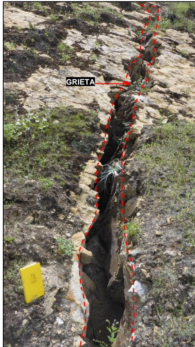
Figura 17. Agrietamientos en el deslizamiento Dt5, sector “El Sauce” parte alta.
