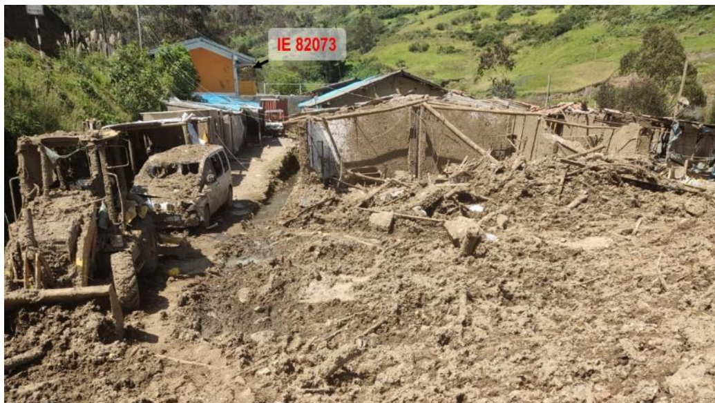
Figura 12. Daños en la localidad de La Victoria en marzo del 2023, se aprecia la IE 82073 en la parte posterior.
