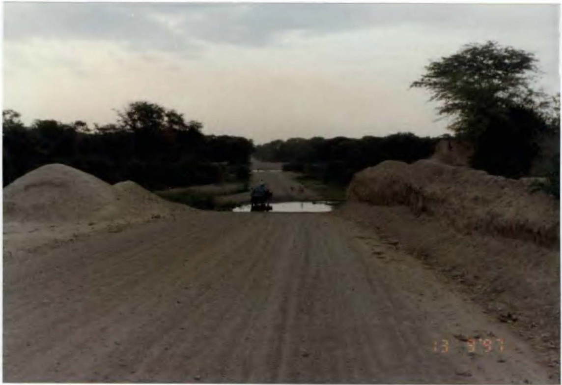
Foto N° 6. Paso de la vía Chulucanas - Tambogrande sobre el lecho del río San Francisco, que en época de lluvias se vuelve intransitable.
