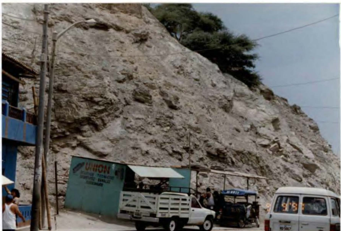
Foto N° 96. Estado del talud en la vía de acceso al Terminal Pesquero de Paita.
