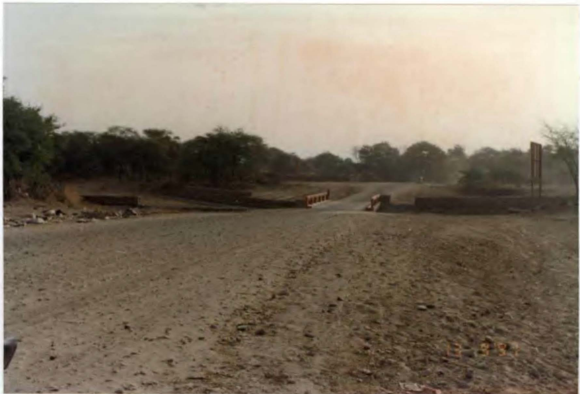
Foto N° 7. Puente Cameros en la entrada a Tambogrande de concreto armado con gaviones tanto aguas arriba como aguas abajo.
