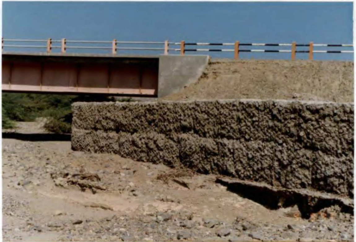
Foto N° 28. Estado del muro de gaviones que protege el estribo izquierdo aguas arriba del Puente Pariñas Norte.
