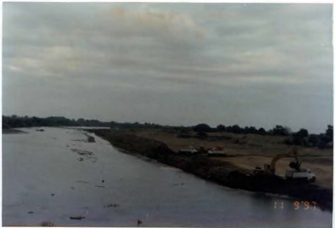
Foto N° 45. Trabajos de limpieza de material sedimentado en la margen derecha aguas abajo del Puente Tumbes.
