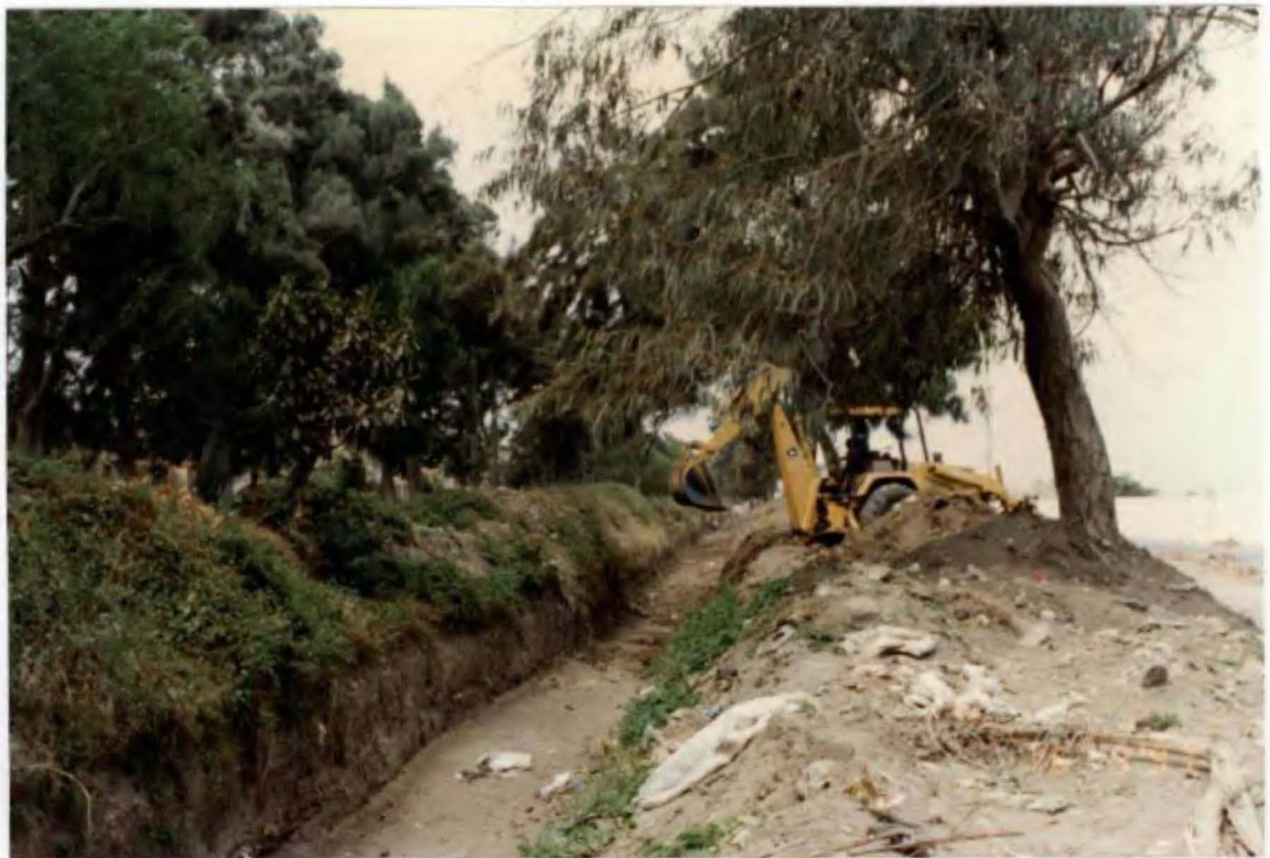
Foto N° 60. Dren en proceso de descolmatación en Prolongación Chinchaysuyo, Barrio Villarreal - Sector La Victoria - Chiclayo.
