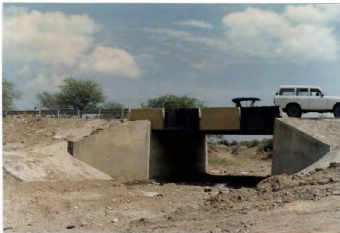
Foto N° 53. Estado del Puente Piedritas, donde se observa aguas arriba unos muros de mampostería adosados a los aleros del Puente.
