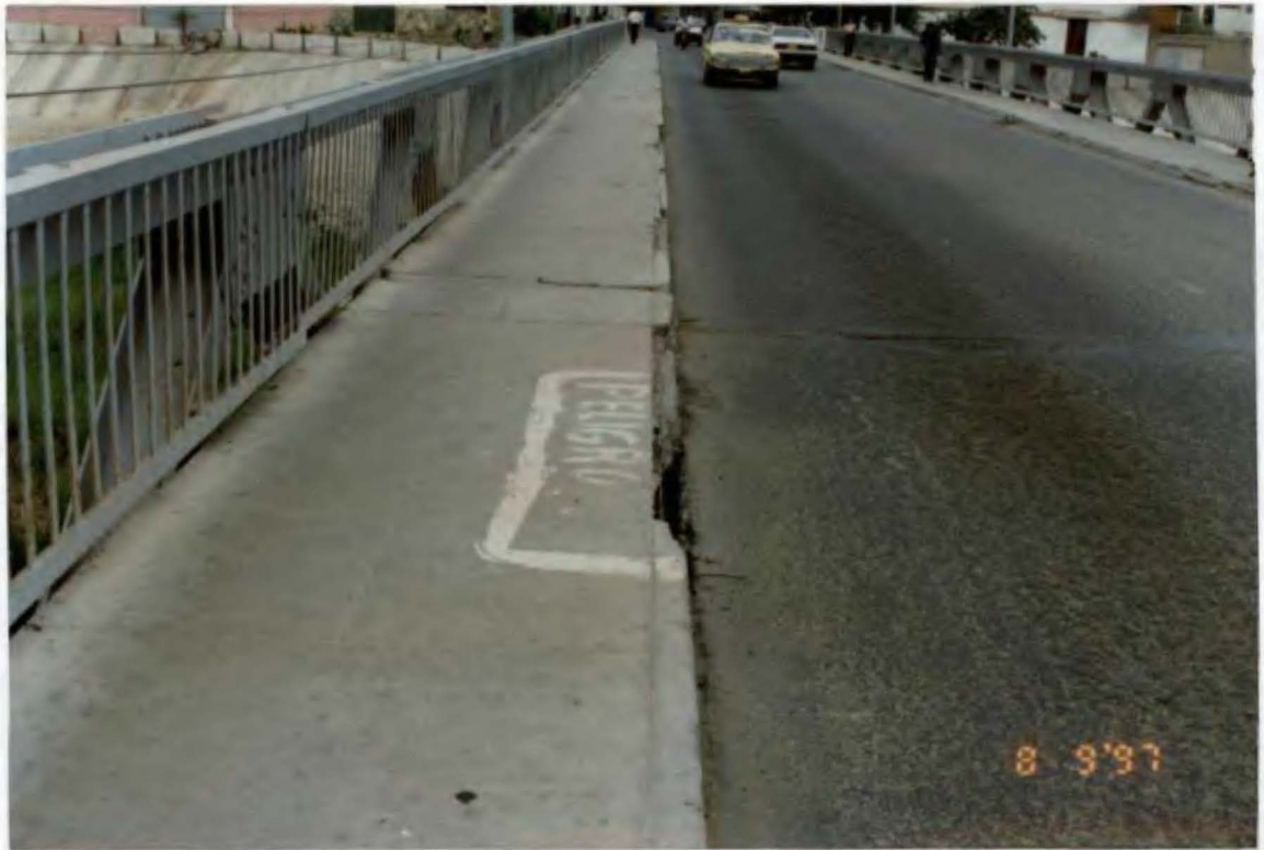
Foto N° 13. Estado del cauce a la altura del Puente Sánchez Cerro en Piura y de la loza del puente.
