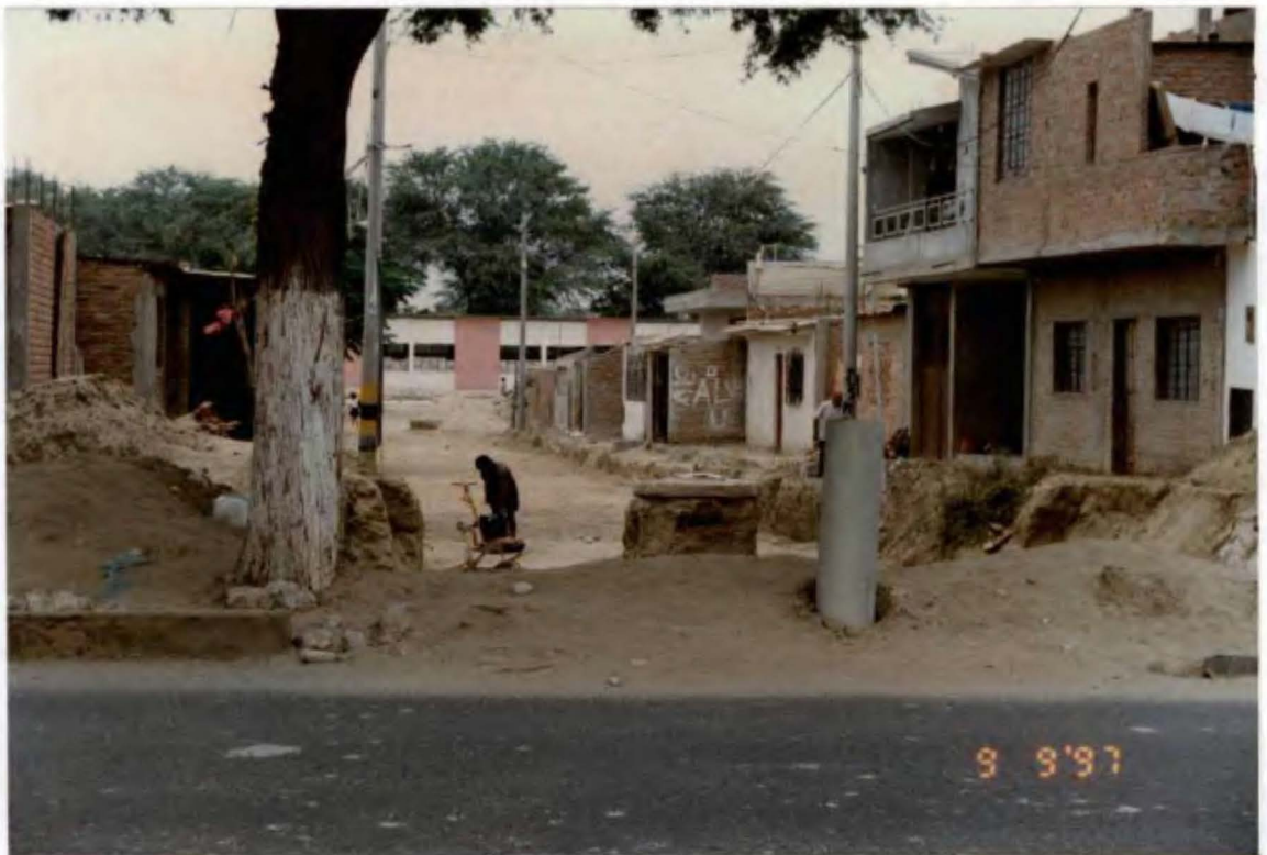
Foto N° 65. Estado de avance de los trabajos de construcción del Dren Pluvial Petroperú - Nueva Esperanza al 9/9/97. Tramo Av. Sánchez Cerro - Av. J.C. Mariategui.
