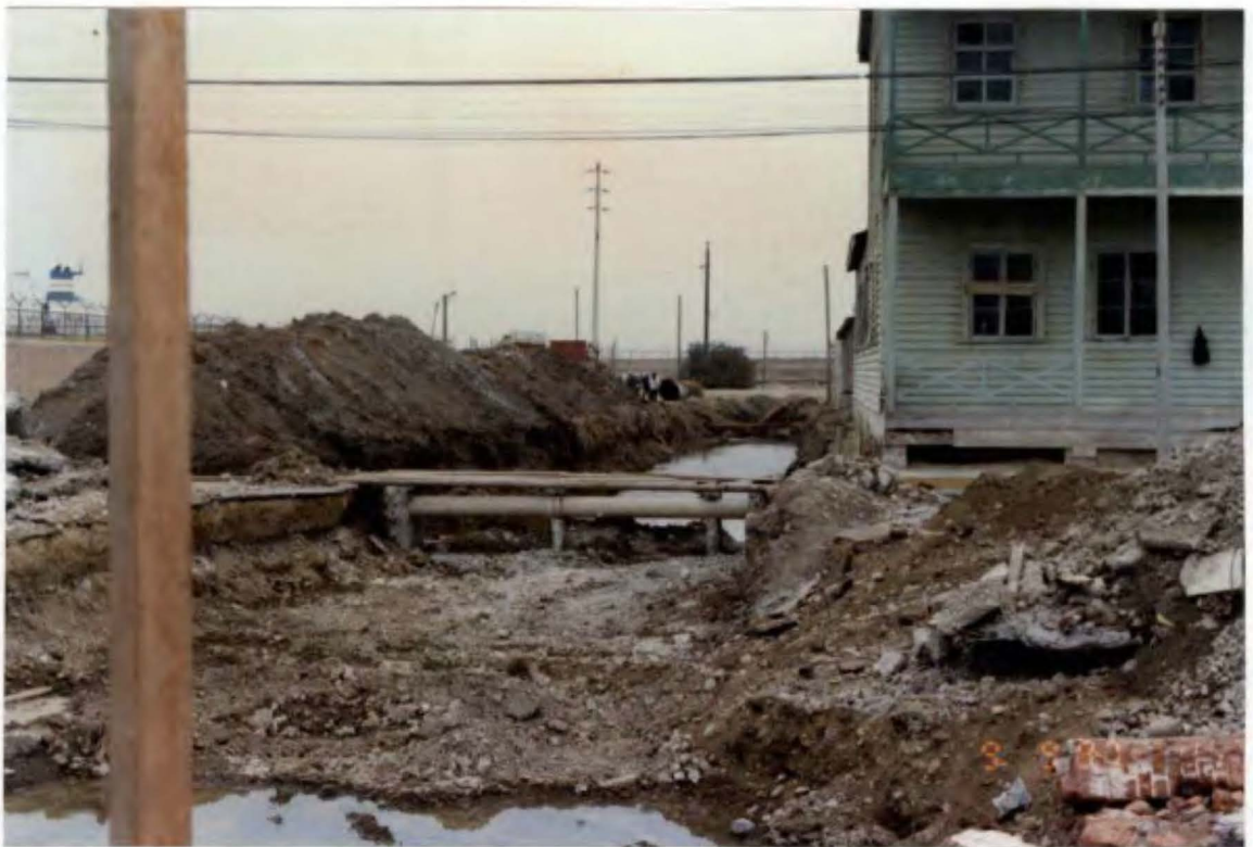
Foto N° 99. Estado de los trabajos del dren de desagüe de Talara en el sector del ex-Hotel Royal; el nivel freático es alto.
