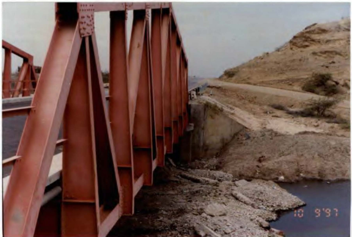
Foto N° 37. Puente Canoas (km 1201.000 Panamericana Norte), carece de defensas en las márgenes.
