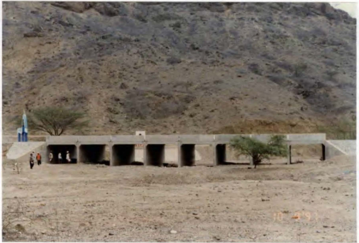
Foto N° 34. Puente Punta Sal (km 1187.000 Panamericana Norte). Necesita proteger el acceso por el lado derecho yendo a Tumbes.
