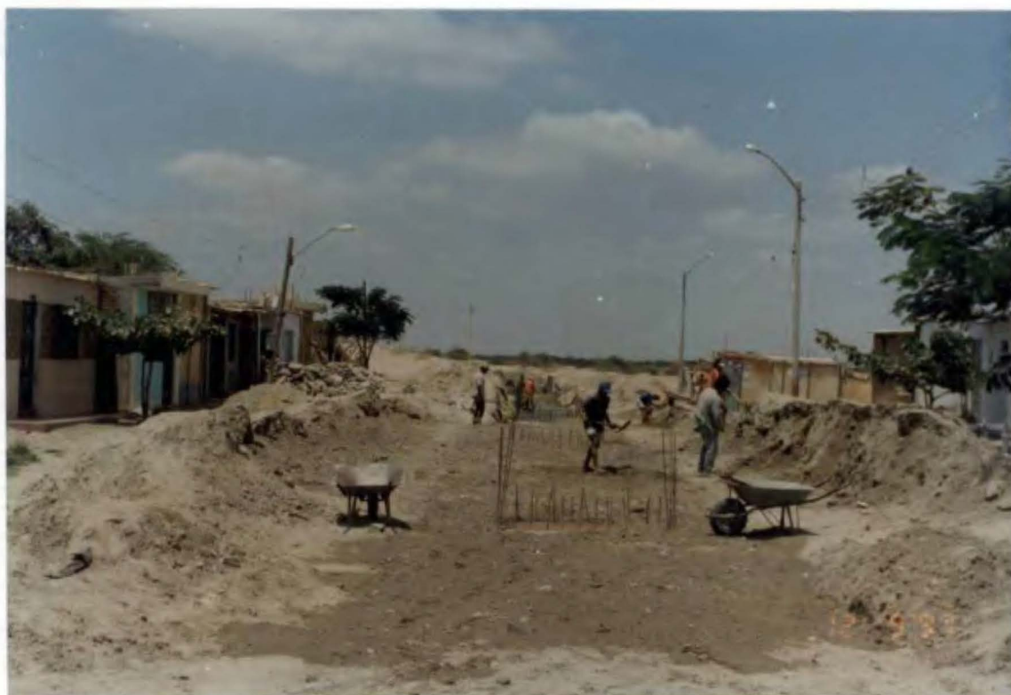
Foto N° 75. Dren César Vallejo con loza de concreto y rejillas para drenaje de aguas en Calle Japón, Barrio López Albújar - Piura.
