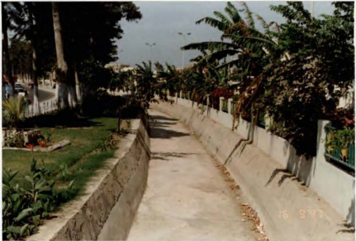
Foto N° 59. Dren revestido en Av. Garcilazo de La Vega - Chiclayo, el que necesita prolongarse hasta la Av. Grau.
