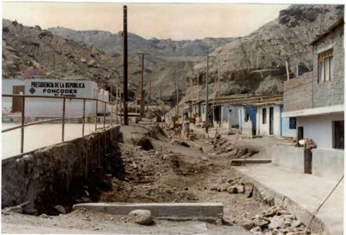
Foto N° 29. Vista que muestra el estado de la Quebrada Barrio Norte en Cabo Blanco y que necesita limpiarse.
