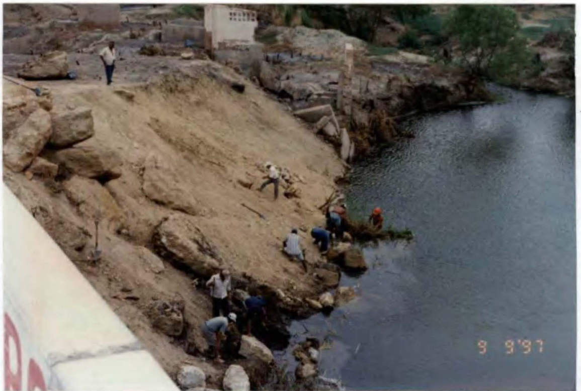
Foto N° 17. Puente Simón Rodríguez entre el Arenal y Amotape en el Bajo Chira, donde es necesario colocar defensas en el estribo de la margen derecha.
