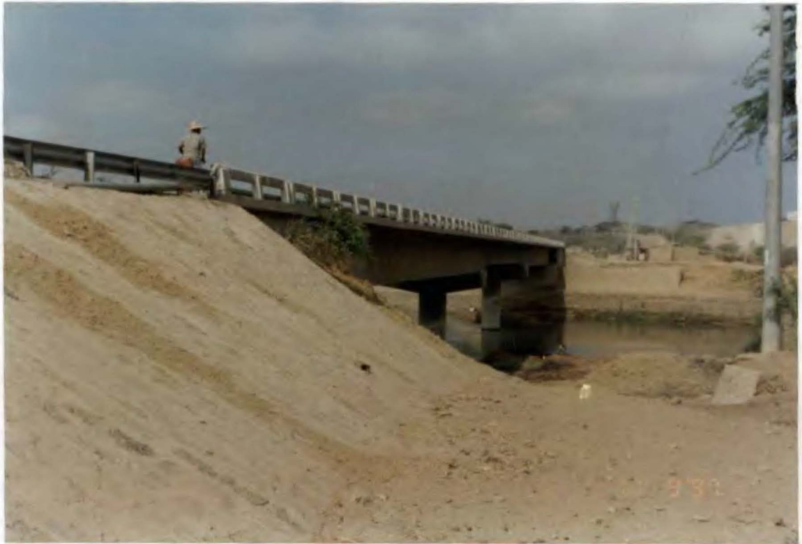
Foto N° 21. Vista tomada de aguas abajo a aguas arriba al Puente Samán donde se estaban efectuando obras de limpieza de cauce y reforzamiento de la margen derecha.
