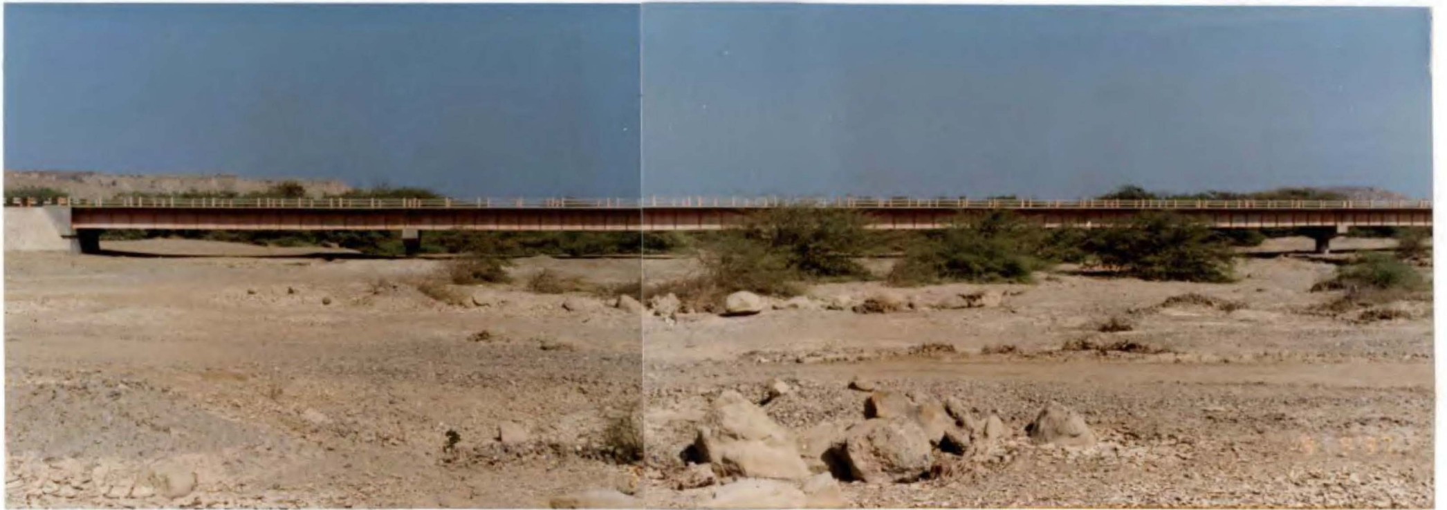
Foto N° 26. Vista de aguas arriba a aguas abajo de la estructura Sur del Puente Paríñas inaugurado en Setiembre de 1993; sería necesario reforzar las defensas del estribo izquierdo y limpiar el cauce.
