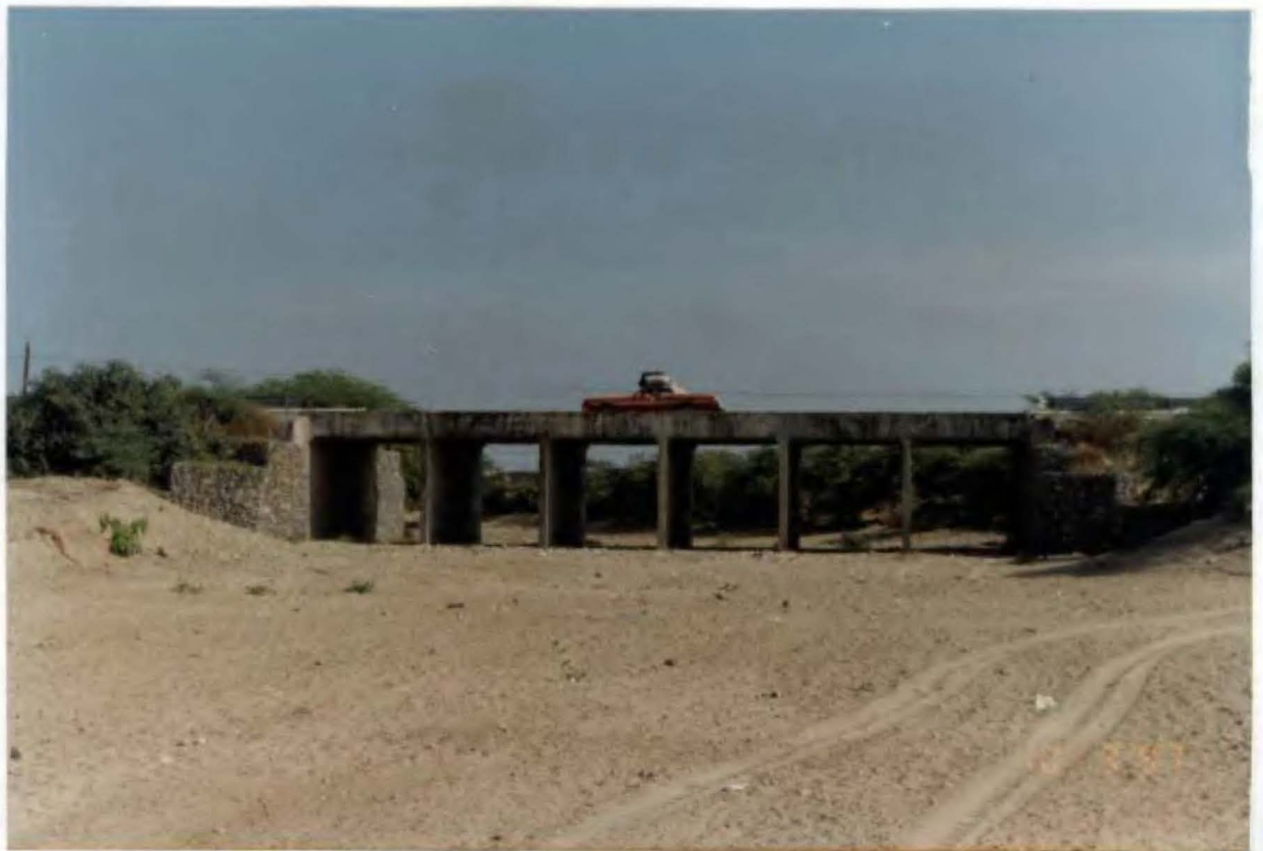
Foto N° 47. Estado del Puente Algarrobillo (km 1274.700 Panamericana Norte, donde se han colocado gaviones de protección aguas arriba y aguas abajo para proteger los estribos.
