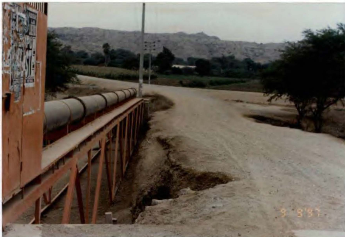
Foto N° 18. Estado de la salida del Puente Simón Rodríguez (Bajo Chira), sector hacia Amotape.
