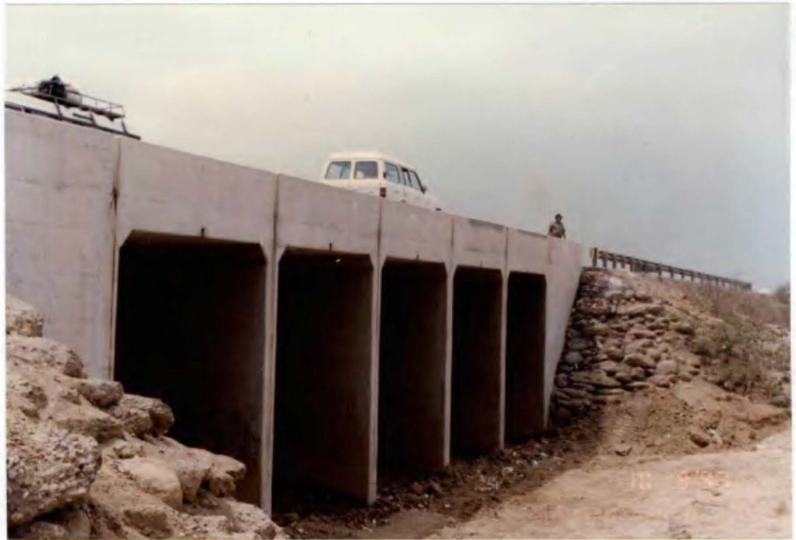
Foto N° 36. Puente Canchas II (km 1195.500 Panamericana Norte). Se ha limpiado el cauce pero habría que mejorar la protección de los estribos.
