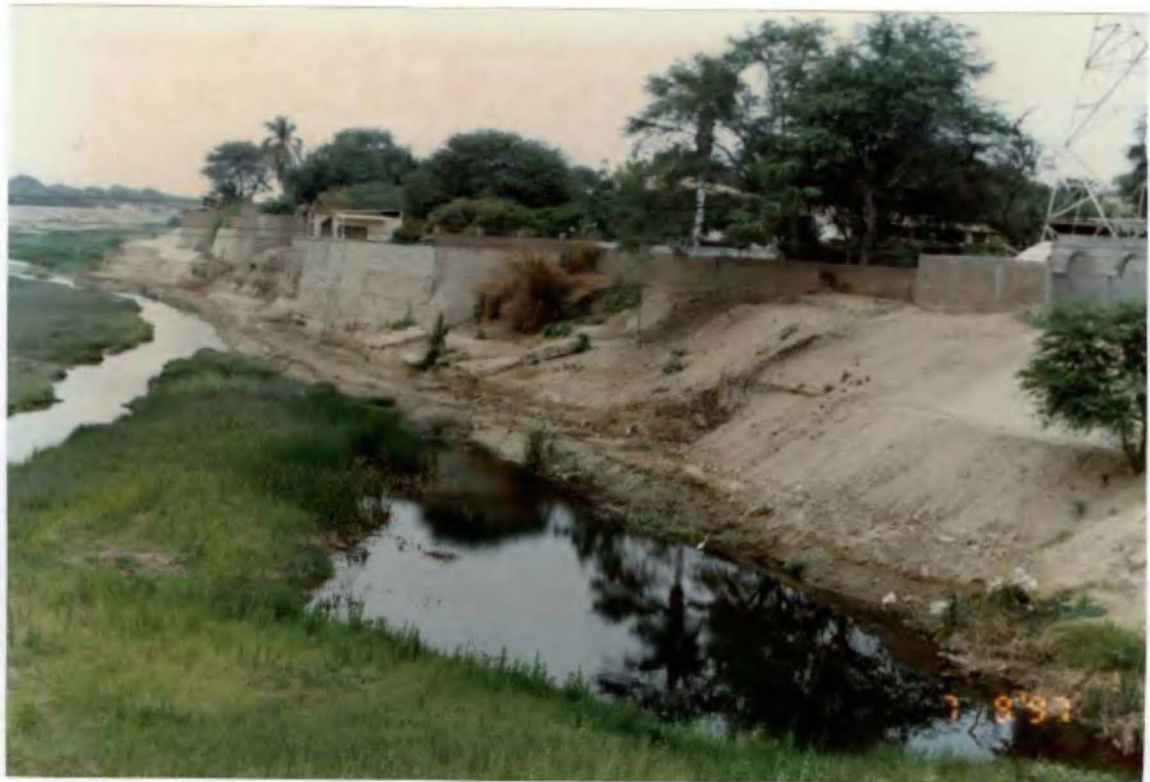
Foto N° 15. Estado del área ubicada en la margen derecha del río Piura en la zona de empalme del alero aguas abajo del Puente Mariscal Cáceres (A) y las obras de defensa (B).
