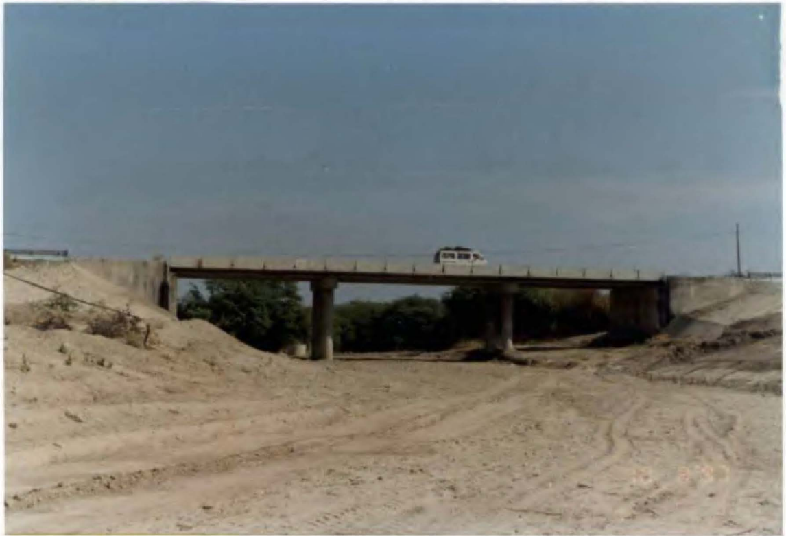
Foto N° 48. Estado de los trabajos ejecutados en el Puente Aeropuerto (km 1275.800 Panamericana Norte).
