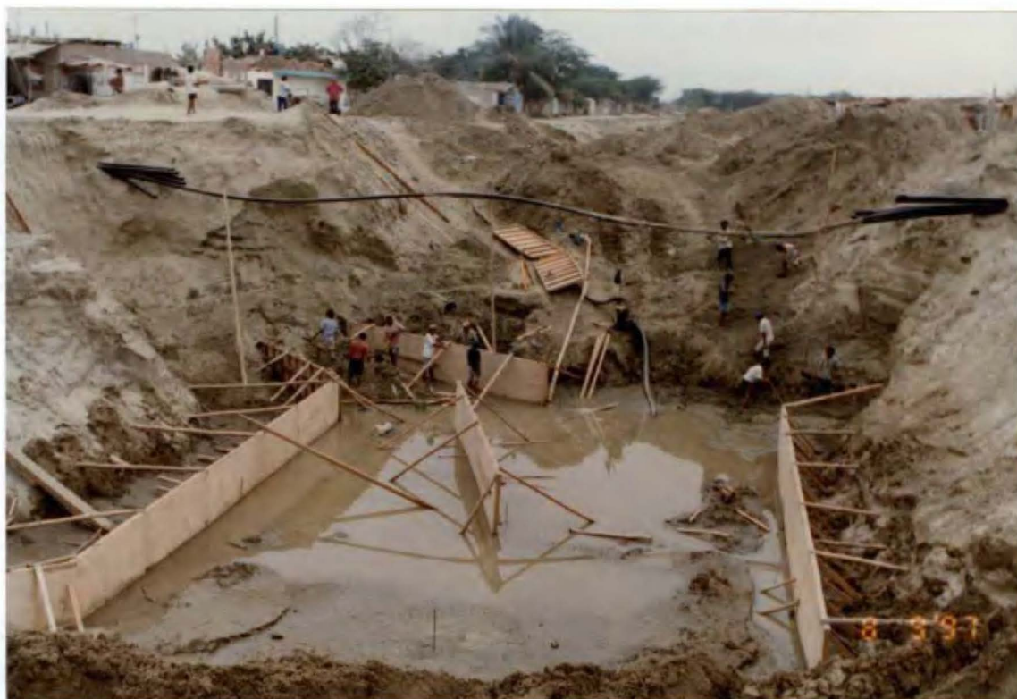
Foto N° 78. Portón en construcción en la carretera Panamericana para dar paso al dren La Legua.
