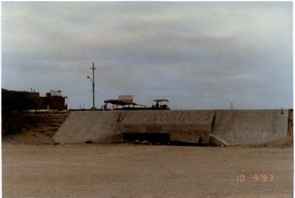
Foto N° 35. Puente Cancas I (km 1193.800 Panamericana Norte). Necesita efectuar limpieza de cauce.
