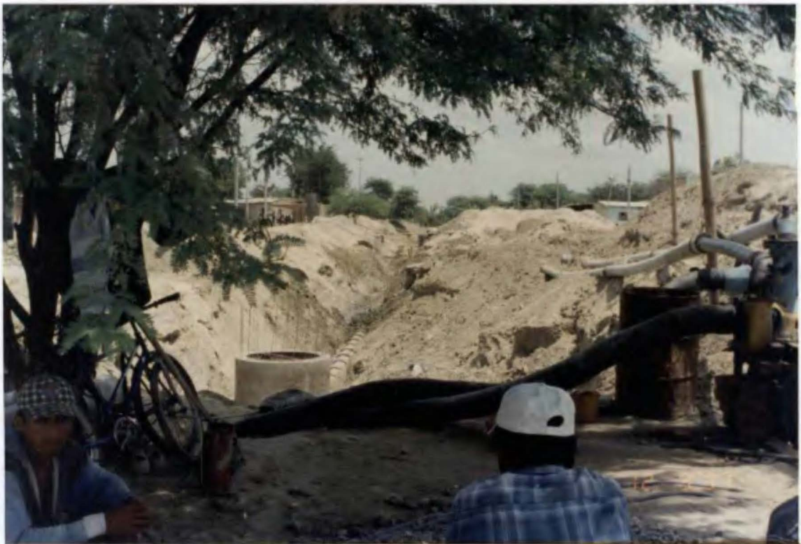
Foto N° 64. Vista a los trabajos de cambio de tubería de desagüe en la Av. Chulucanas-Piura. Obsérvese que todo el material que conforma las paredes es arena.
