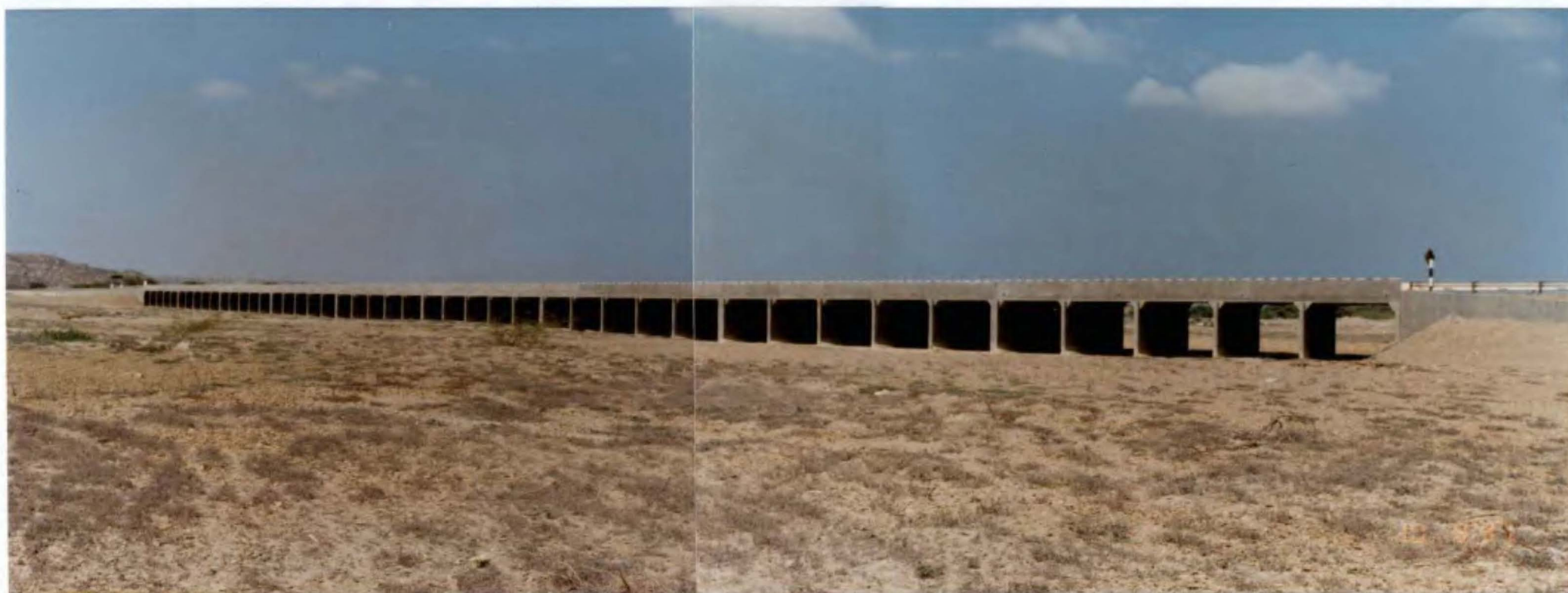
Foto N° 27. Estado del Puente Quebrada Honda en vía Panamericana Norte, pasando el Puente Pariñas.
