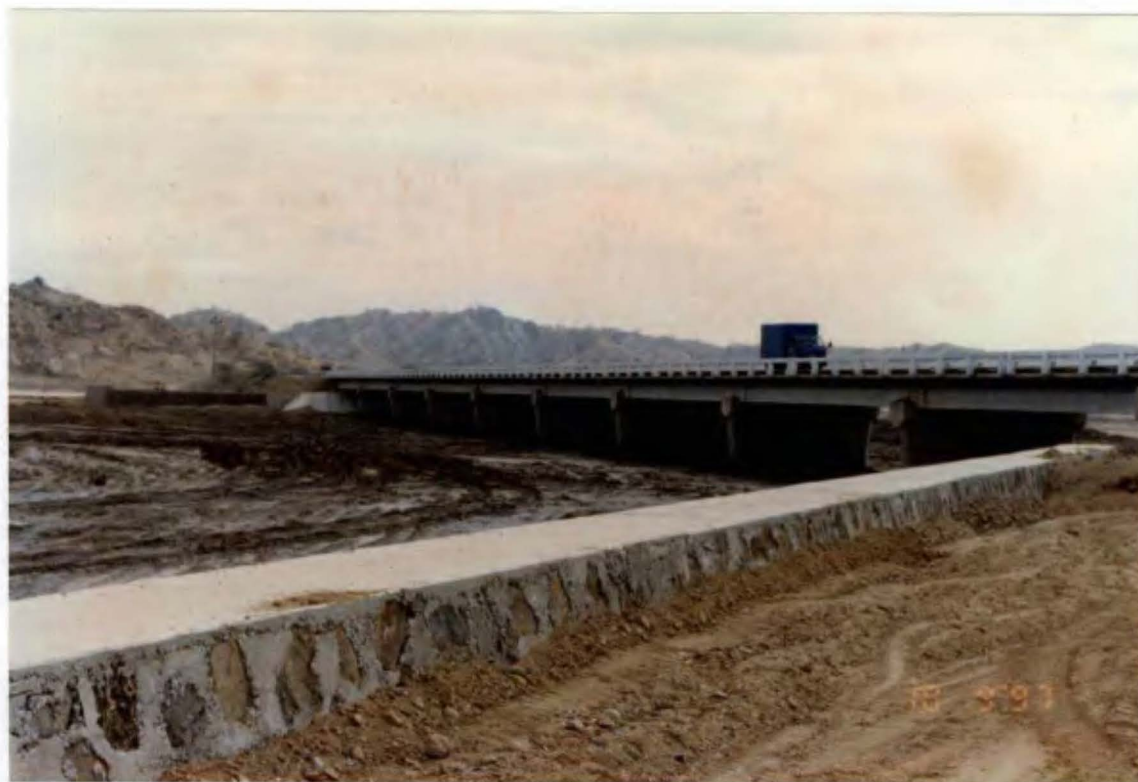
Foto N° 39. Puente La Cruz sobre la quebrada Colona. INDECI ha construido el muro de cemento ciclópeo sobre la margen derecha.
