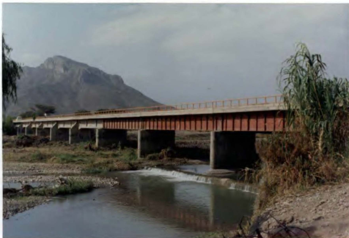
Foto N° 2. Desde aguas abajo a aguas arriba nos muestra el Puente Tablazos, donde se observa que no se había efectuado ningún trabajo en el lecho.
