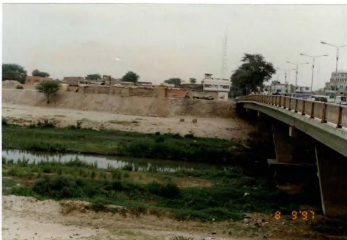
Foto N° 66. Viviendas precarias que se ubican en la margen derecha del río Piura, aguas abajo del Puente Bolognesi.
