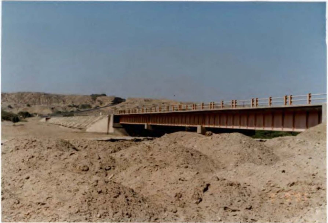
Foto N° 24. Bajada a la Quebrada Pariñas donde se localiza el nuevo puente que consta de dos estructuras separadas por una batería de alcantarillas.
