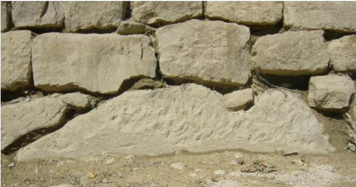
Figura 32. Ejemplo de un sistema de protección enrocado en el pie del deslizamiento.
