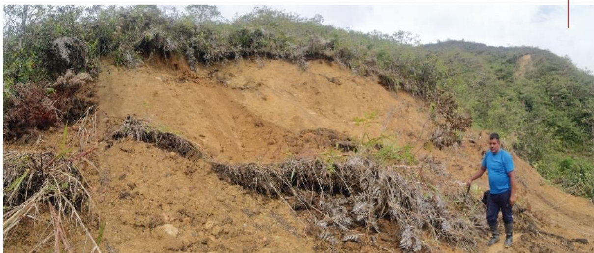
Figura 20. Perfil del deslizamiento activo Da-3.
