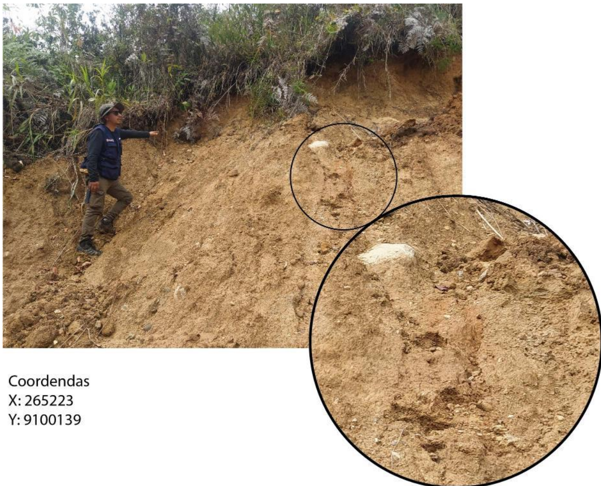
Figura 7. Obsérvese el depósito Qh-cd 3, de coloración rojiza, y desplazamiento reciente.
