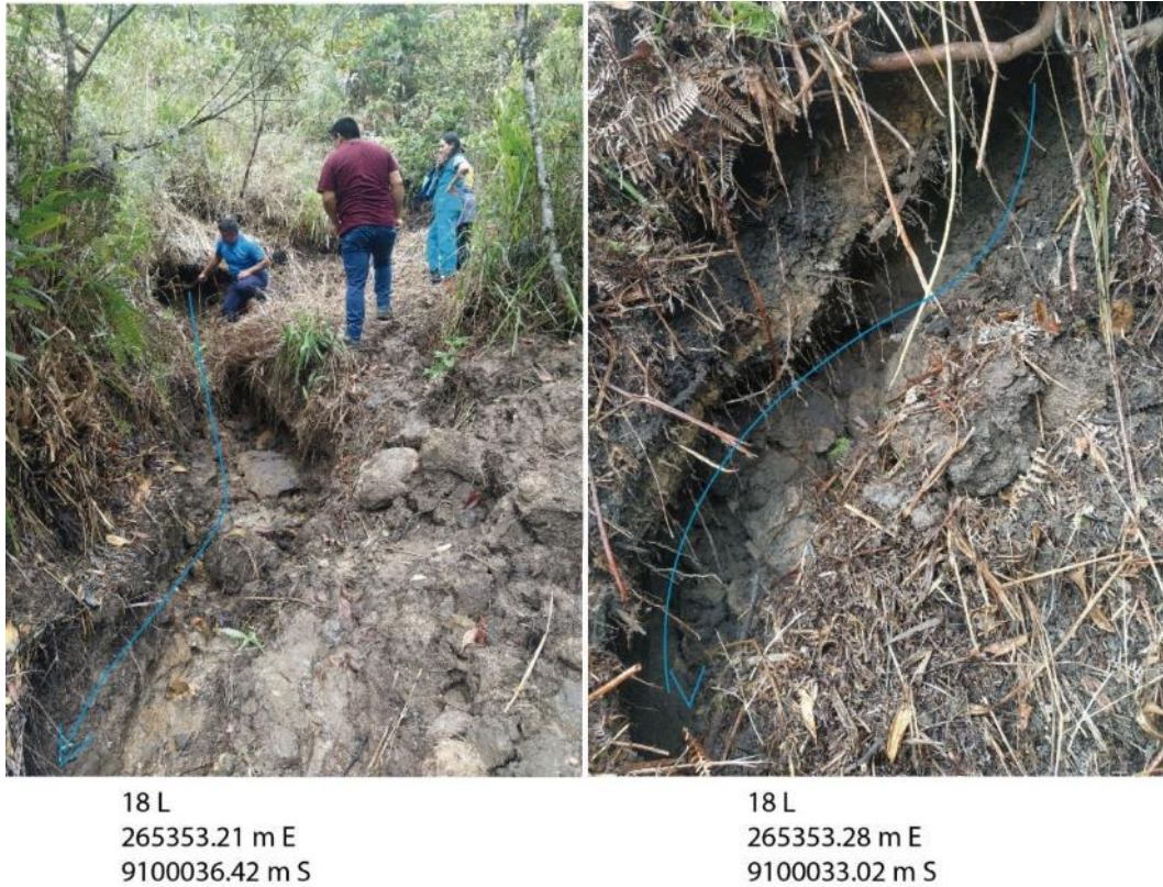
Figura 29. escorrentía de agua superficial proveniente del “bofedal” por entrapamiento de agua del deslizamiento Da-8”.
