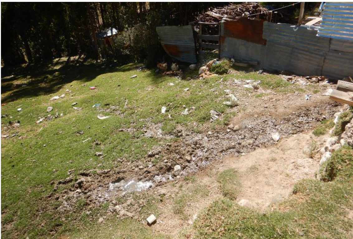
Fotografía 9. Producto de sistemas de desagüe inadecuados de viviendas que direccionan sus aguas servidas hacia la ladera, provoca la sobresaturación del terreno y lo inestabilizan.
