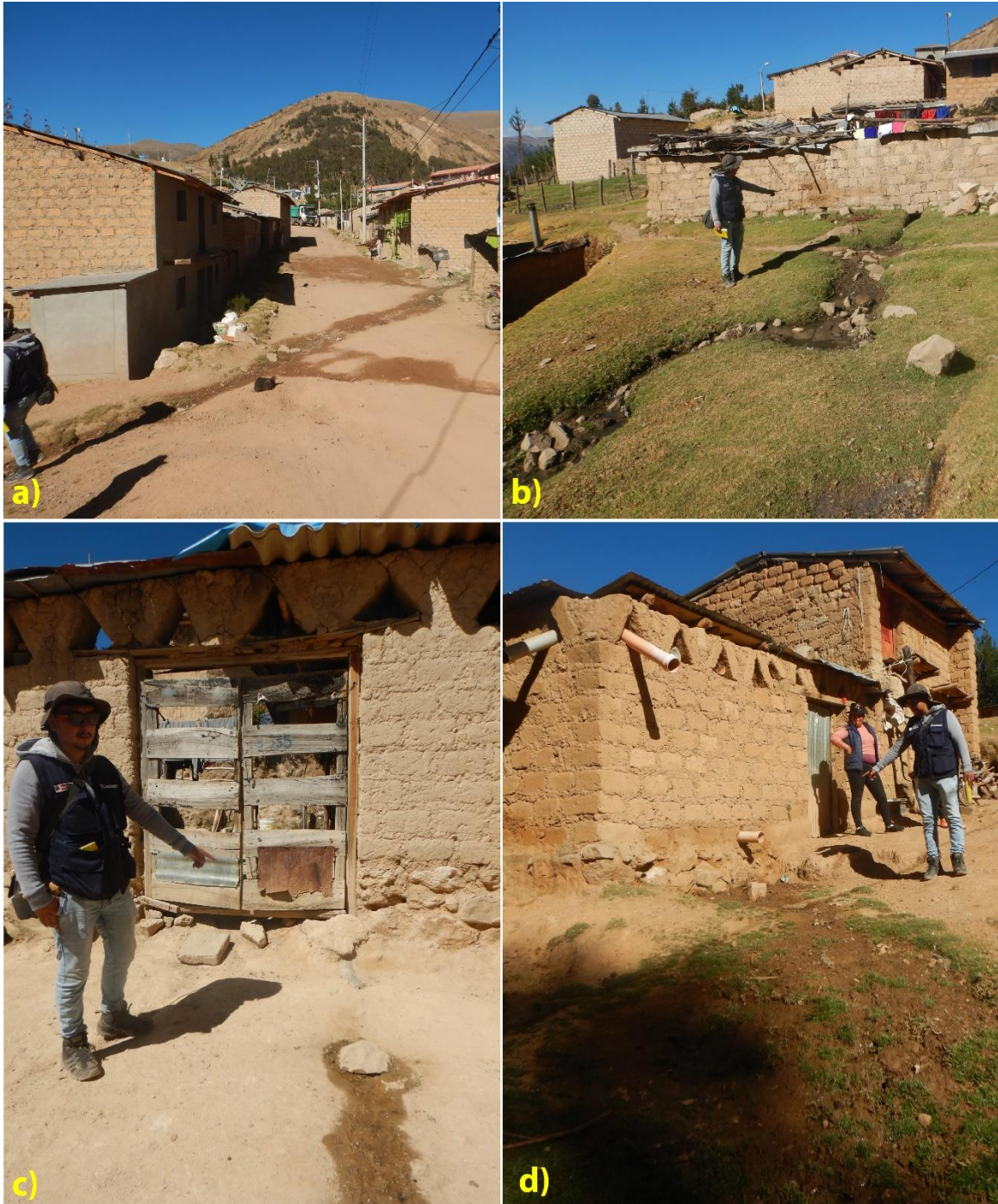
Figura 12. El manejo inadecuado del agua de escorrentía en el centro poblado de Potongo aumenta la ocurrencia de las cárcavas: a) Discurriramiento del agua hacia las calles y en dirección a la ladera, lo que muestra una capacidad insuficiente del drenaje superficial. b), c) y d) desagüe del agua de escorrentía hacia las laderas.
