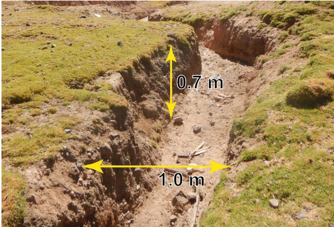
Figura 13. Canal sin revestimiento, construido por la población de Potongo, con la finalidad de desviar las aguas pluviales en temporada de avenida; así como, las aguas servidas provenientes de viviendas sin sistemas de desagües adecuados.
