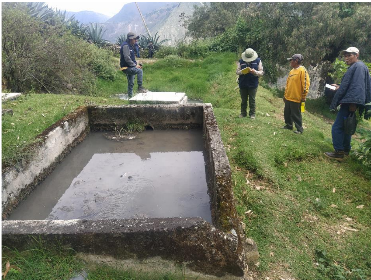
Fotografía 1. Pozo de oxidación ubicado en las coordenadas UTM, WGS 84, 18 s, siguientes X: 251799.41 & Y: 90642008.86.
