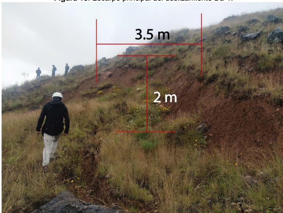
Figura 14. Escarpe principal del deslizamiento Da-1.
