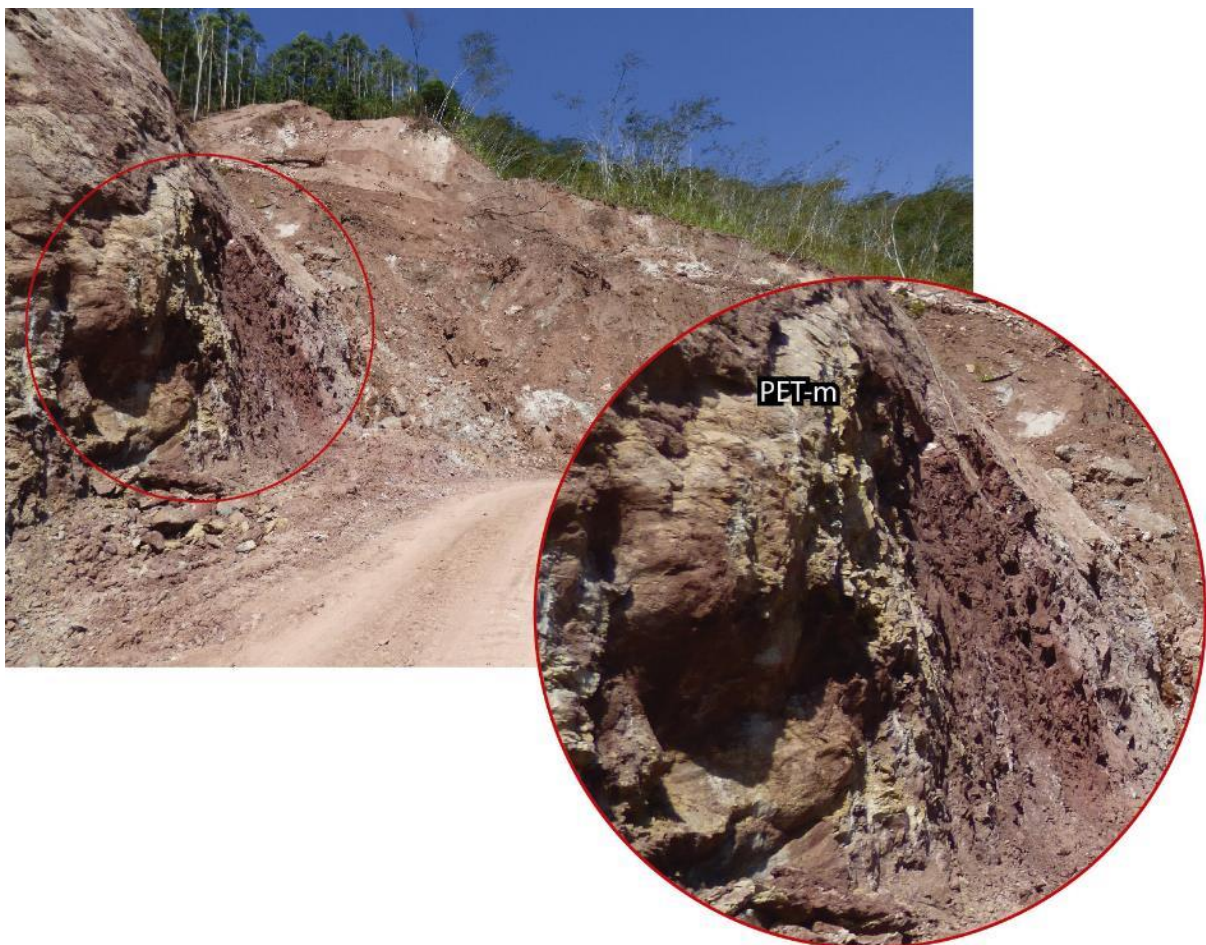
Figura 4. Afloramientos de areniscas y brechas volcánicas meteorizadas y alteradas ubicadas en el área de inspección, coordenadas UTM, WGS 84 18 s, X: 461578; Y: 8755718
