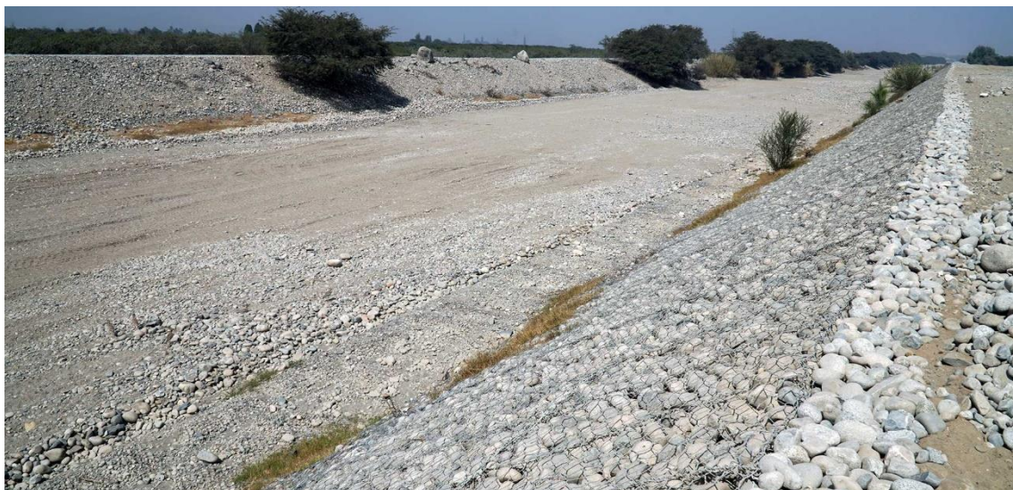
Fotografía 2. Ejemplo de una defensa ribereña con un pedraplén y geomallas.
