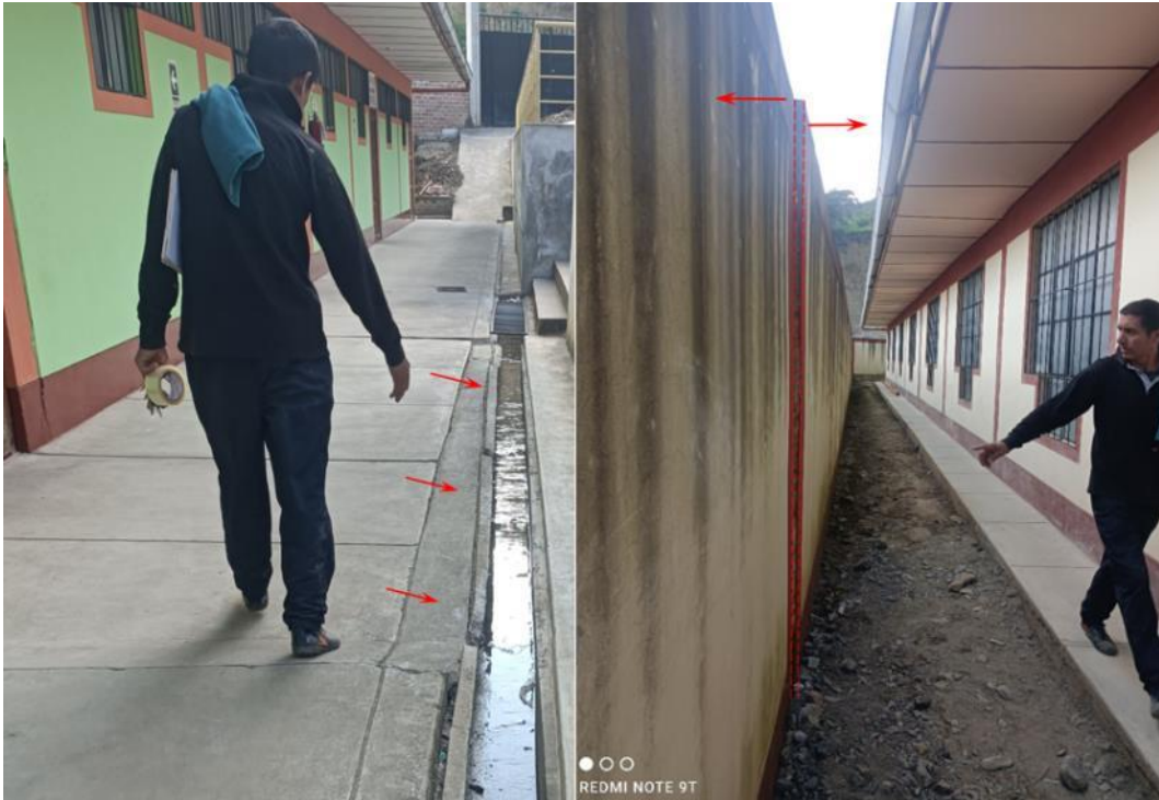
Figura 21. Desplazamiento horizontal de vereda y muro perimétrico posterior de Institución Educativa.
