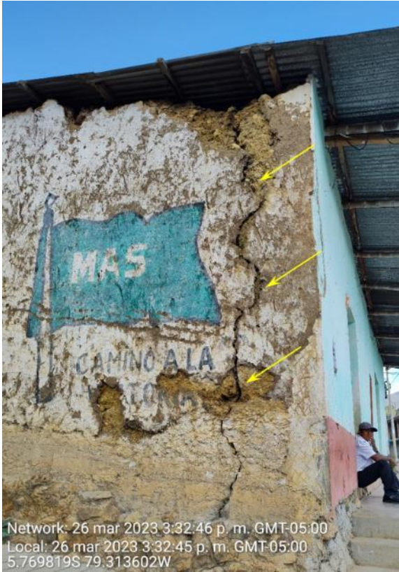
Figura 13. Afectación en viviendas Localidad San Felipe.
