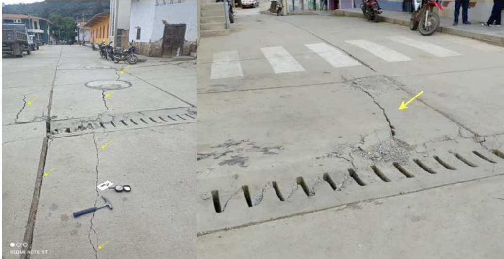
Figura 11. Agrietamiento en vía encementada y separación pronunciada de junta de dilatación. Ubicación: E: 686755; N: 9361900.
