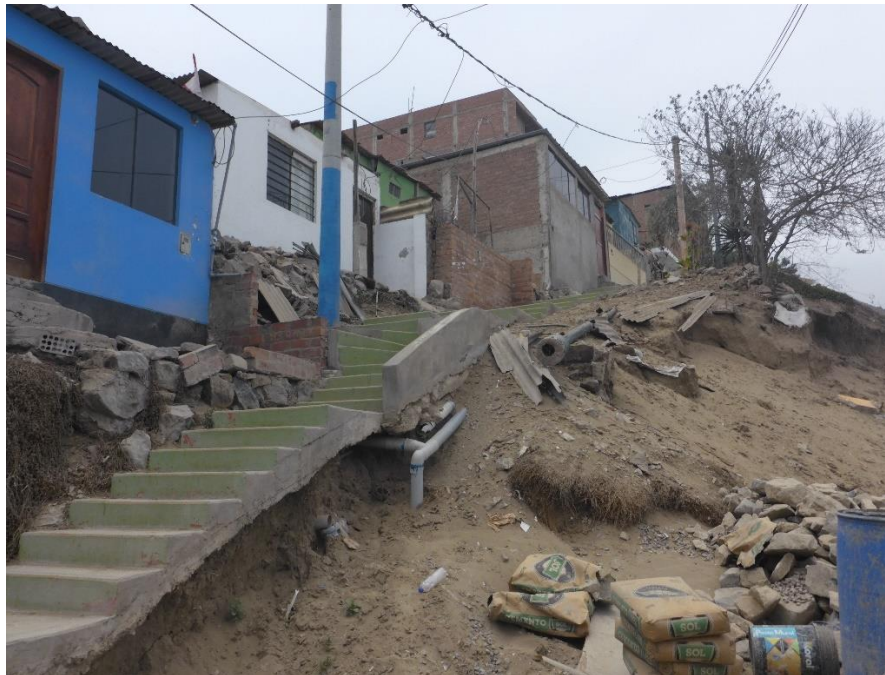
Fotografía 8. Viviendas asentadas sobre pircas ubicadas en depósitos de arenas inconsolidados. Coordenadas UTM (WGS 84): 275358 E, 8670785 N.
