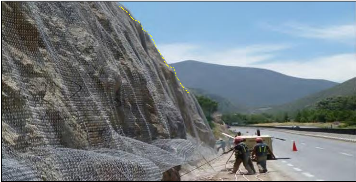
Figura 22. Mallas de protección con anclajes para caída de rocas o derrumbes tanto en detritos como roca alterada, (Vilchez, 2021)
