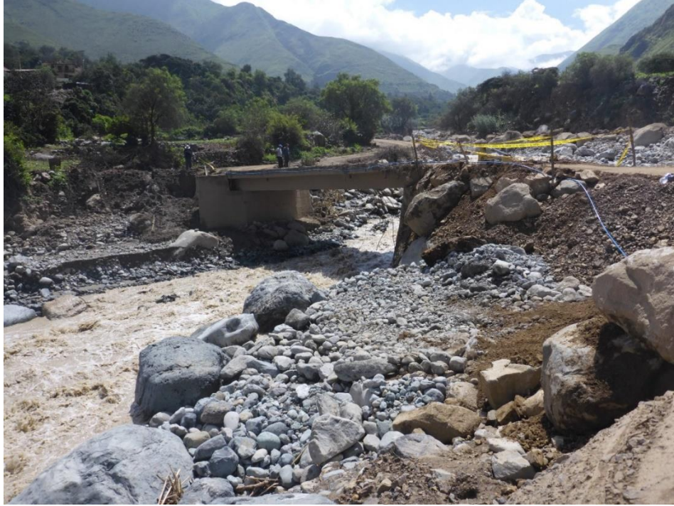
Fotografía 13. Puente Licahuasi afectado por el aluvión, se pueden observar los estribos afectados.
