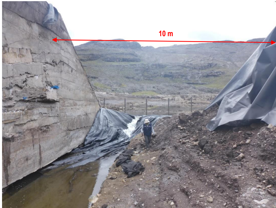
Figura 10. Destrucción parcial del dique, en 10 m aproximadamente, generada por la colmatación de la laguna Yarcán.
