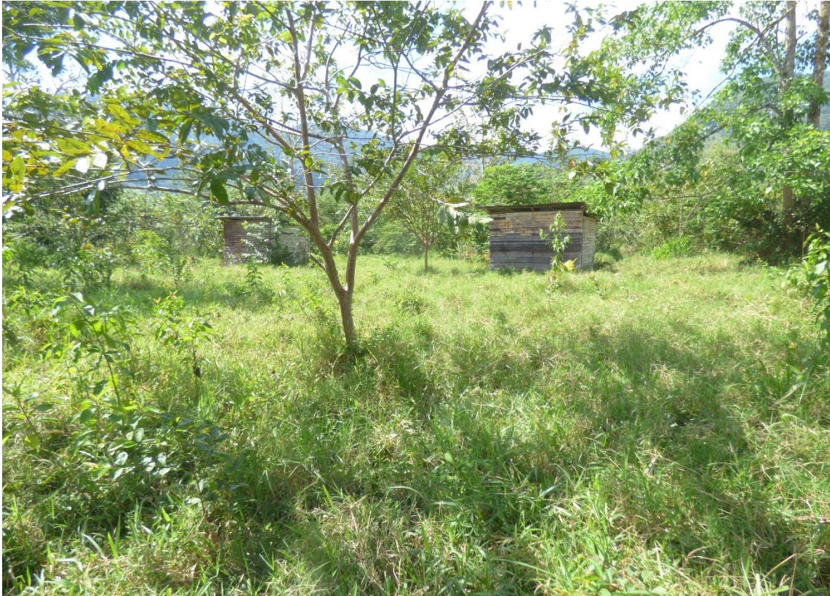
Fotografía 2: Viviendas afectadas por inundaciones los años 2014, 2016 y 2019, se desplazaron aproximadamente 5m de su posición inicial. Actualmente las casas se encuentran abandonadas.
