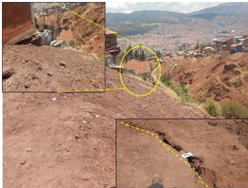
Figura 14. Vista tomada en coordenadas UTM: 175680 E, 8502241 S. Se aprecia grietas en el suelo y muros de viviendas que se encuentran inclinados y cayendo.
