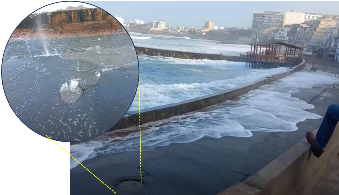
Figura 24 El fuerte oleaje ha socavado las bases de los muros de contención y ha provocado la aparición de grietas en la vereda y pista por donde filtra el agua.
