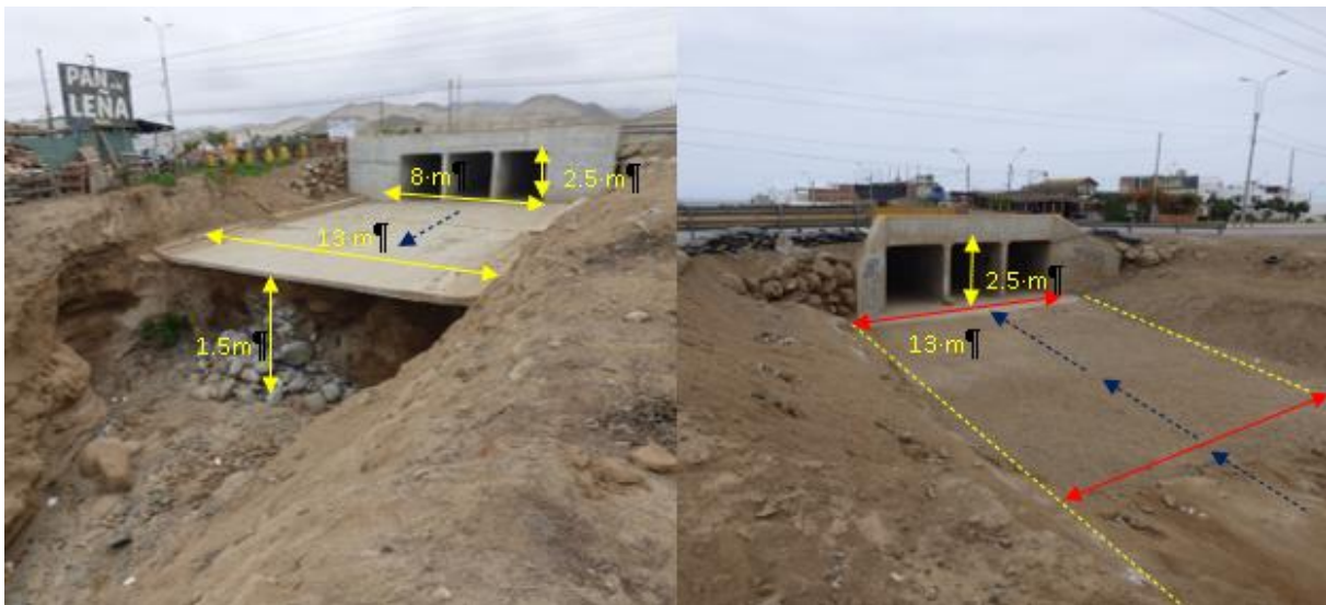
Figura 14. Ambos lados del Puente de la antigua Panamericana Sur, se observa socavación de 1.2 m de la base de la plataforma. Las 03 alcantarillas tipo cajón presentan un lado de 2.5 m en un ancho total de 13 m. En la margen derecha se puede observar viviendas a 2 m aprox. de dicha margen. Las flechas punteadas azules indican la dirección del flujo.
