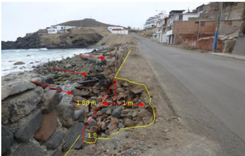
Figura 21. Playa Sur, se observa erosión marina, cuyo proceso, influenciado por el oleaje, ha generado desgaste, socavación y afectación del muro de contención.
