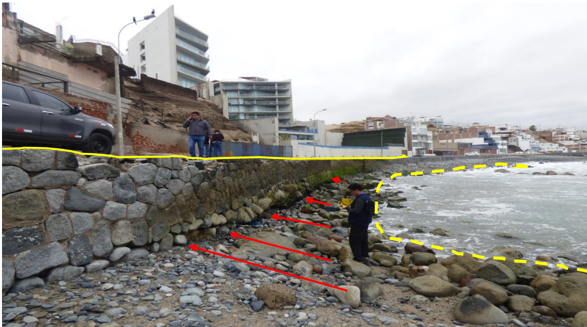
Figura 22 Playa Norte. el oleaje ha socavado la base del muro de protección como lo señalan las flechas rojas. La distancia de la línea de costa (líneas punteadas amarillas) hacia el muro es de 1 m a 3 m.
