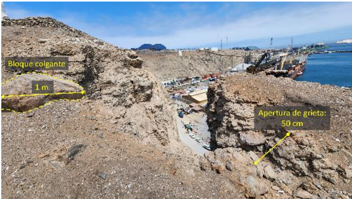
Figura 4. Parte alta del acantilado, se aprecia el bloque colgante, coordenadas UTM E: 808441, N: 8118661.
