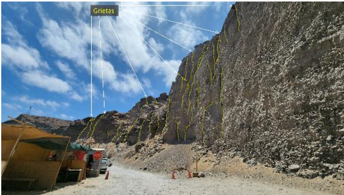
Figura 8. Sistema de grietas en dirección noroeste-sureste (líneas amarillas) en el sector Muelle Pesquero Matarani.
