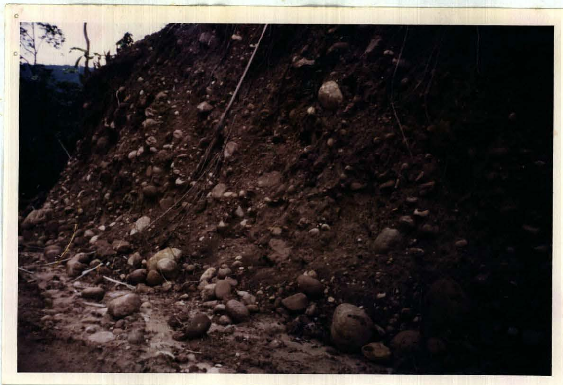
FOTO 4.18: DEPOSITOS FLUVIO-ALUVIALES, CONSTITUIDOS POR GRAVAS POLIMICTICAS INCONSOLIDADAS Y ARENAS, QUE SE OBSERVAN EN EL CORTE DE UNA CARRETERA PARCIALMENTE REALIZADA CERCA A SAN VICENTE. (CUADRANGULO DE BALSAPUERTO).
