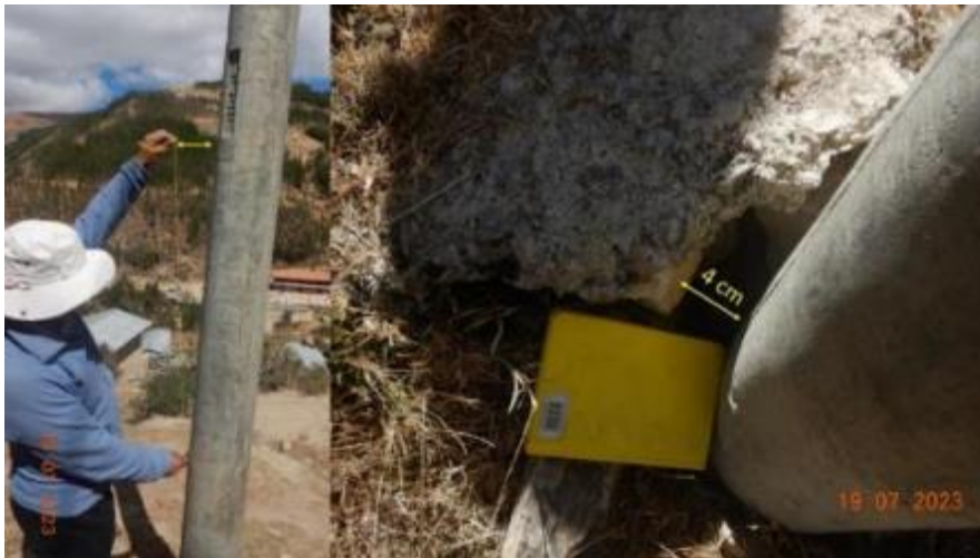
Figura 6. Los Postes de la comunidad Quisinsaya, se muestran inclinados por procesos lentos de empuje del terreno.
