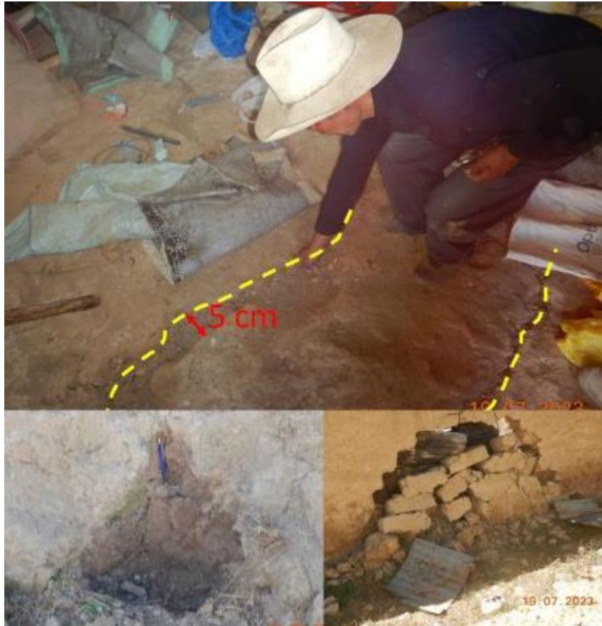
Figura 8: se aprecia dentro de una vivienda grietas tensionales del suelo con 5 cm de apertura y la presencia de humedad en el suelo de toda la comunidad.
