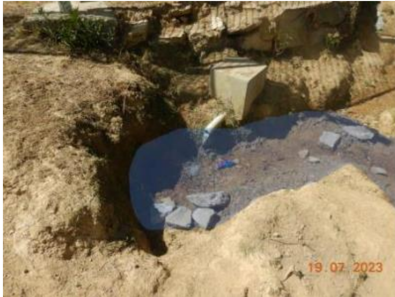
Figura 10. Se aprecia el reservorio de agua potable de la comunidad arrojando agua de rebose, ubicado en la parte alta de la ladera y sin revestimiento.
