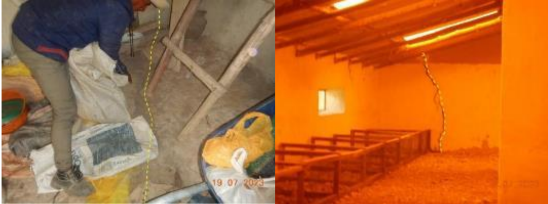
Figura 5. Las viviendas en la comunidad de Quisinsaya presentan rajaduras en muros y grietas en los pisos.
