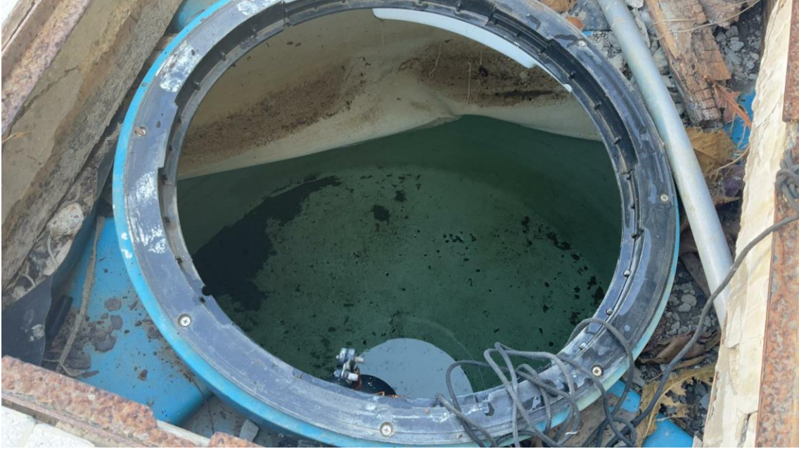
Foto g. Tanque de agua enterrado. Se puede observar los plieques del tanque, los cuales presentan grietas. Coordenadas UTM: 466090.76/9485377.57.
