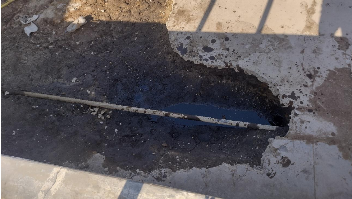
Foto 7. Afloramiento de hidrocarburo en la estación 40 y 60.0 de la sección L-02, ubicado debajo de la loza deportiva a la I.E.
