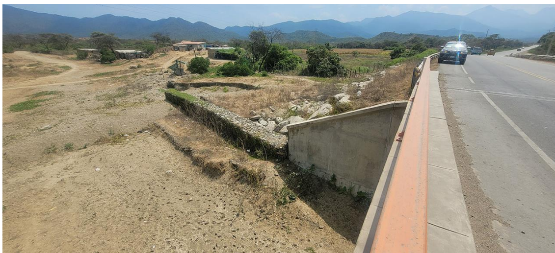
Fotografía 178. Zona crítica 14-147, flujo de detritos en la localidad de Santa Rosa que podría afectar 1 puente de la vía PE-1NJ y 3 viviendas. Coordenadas E: 645187; N:9330639. (11/09/23).
