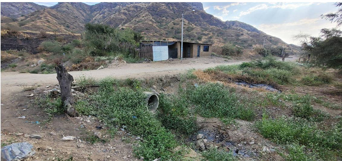
Fotografía 69. Zona crítica 14-038, flujo de detritos en la localidad de Culpón que podría afectar 1 alcantarilla y 2 viviendas. Coordenadas E: 676889; N:9238664. (22/09/23).
