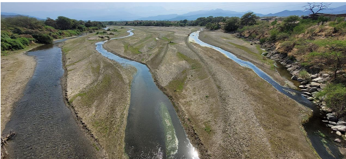
Fotografía 185. Zona crítica 14-154, erosión fluvial en la localidad de Puente Amarillo que podría afectar 1 puente de la vía PE-1NJ y 3 viviendas. Coordenadas E: 637125; N:9344209. (10/09/23).
