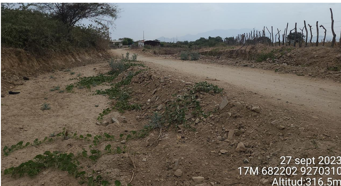
Fotografía 55. Zona crítica 14-024, flujo de detritos en la localidad de Magin que podría afectar 60 m de la vía LA-740 y 4 viviendas. Coordenadas E: 682230; N:9270358. (27/09/23).
