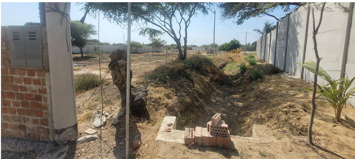
Fotografía 91. Zona crítica 14-060, inundación fluvial en la localidad de Los cocos que podría afectar 10 viviendas. Coordenadas E: 631410; N:9239421. (19/09/23).
