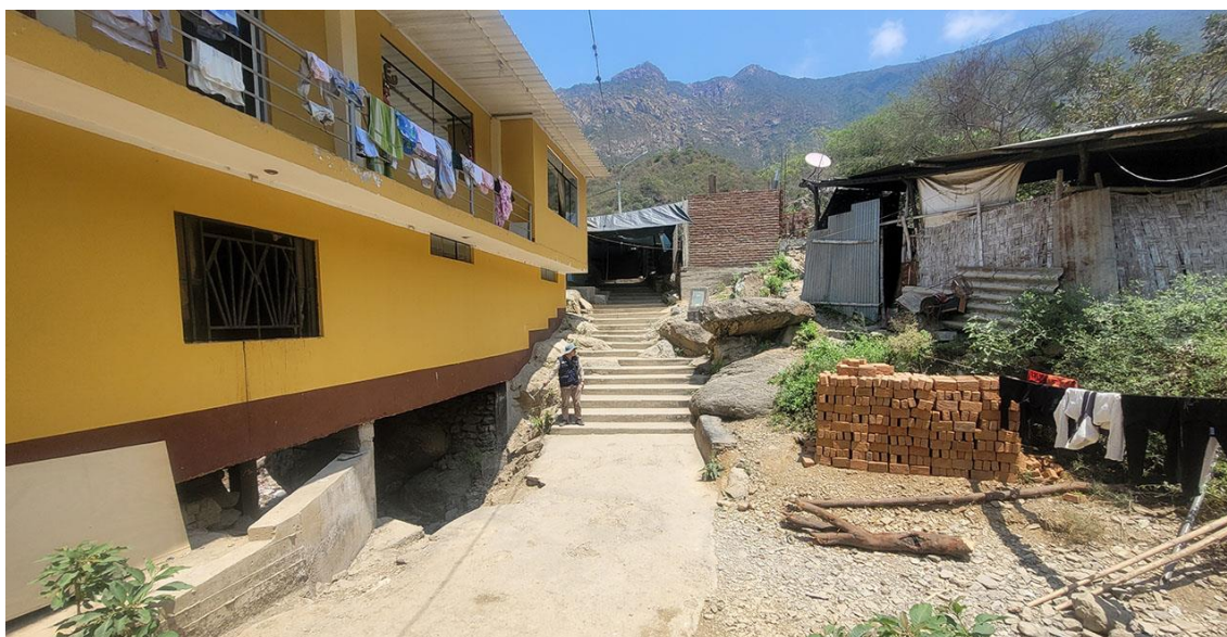
Fotografía 175. Zona crítica 14-144, flujo de detritos en la localidad de El Zapote que podría afectar 10 m de la vía a la Cruz de Motupe y 2 viviendas. Coordenadas E: 640190; N:9326407. (11/09/23).
