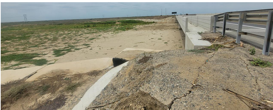
Fotografía 168. Zona crítica 14-137, inundación fluvial en la localidad de Sector la Pared que podría afectar 200 m de vía, 1 puente de la vía PE-1N y 5 viviendas. Coordenadas E: 602300; N:9281550. (08/09/23).
