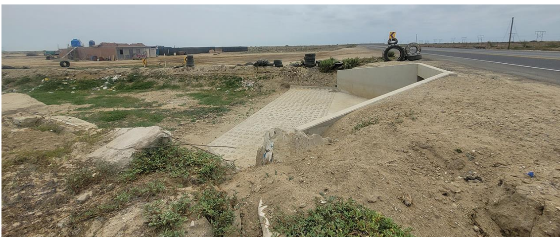
Fotografía 182. Zona crítica 14-151, inundación fluvial en la localidad de Vía Lambayeque- Piura que podría afectar 1 alcantarilla, 50 m de la vía PE-1N y 3 viviendas próxima. Coordenadas E: 583390; N:9302035. (08/09/23).
