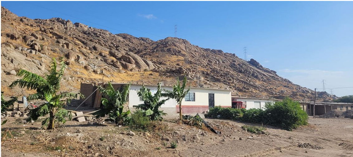
Fotografía 96. Zona crítica 14-065, Caída de rocas en la localidad de Nuevo Paraíso que podría afectar 2 viviendas. Coordenadas E: 634468; N:9243694. (19/09/23).
