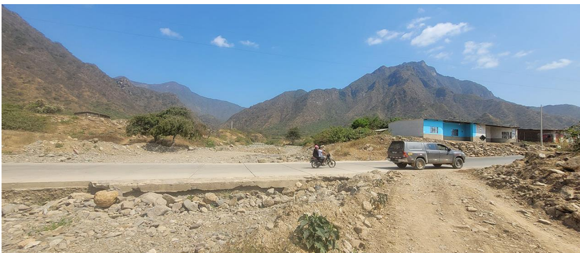
Fotografía 144. Zona crítica 14-113, flujo de detritos en la localidad de Panamericana que podría afectar 25 m de la vía LA-103, 1 badén y 3 viviendas. Coordenadas E: 660586; N:9290941. (13/09/23).
