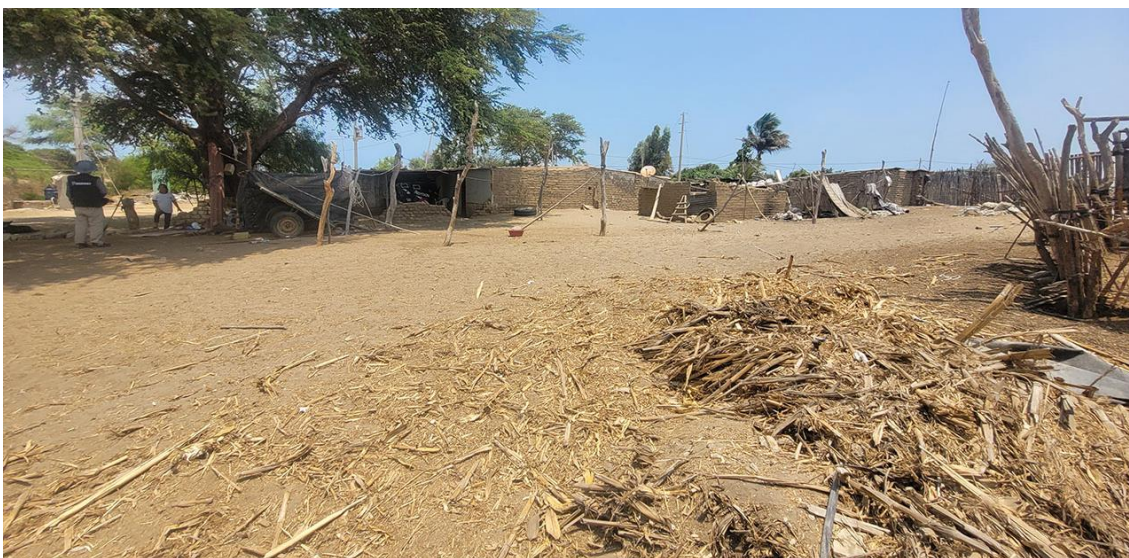
Fotografía 64. Zona crítica 14-033, inundación fluvial en la localidad de Pozo 1 que podría afectar 10 viviendas. Coordenadas E: 646040; N:9221184. (20/09/23).
