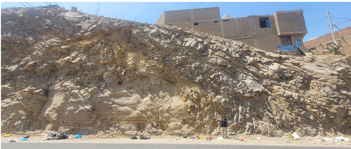
Fotografía 90. Zona crítica 14-059, Caída de rocas en la localidad de Nueva Jerusalén que podría afectar 100 m de la vía PE-1N y 5 viviendas ubicadas en la parte alta del talud. Coordenadas E: 624533; N:9251708. (18/09/23).
