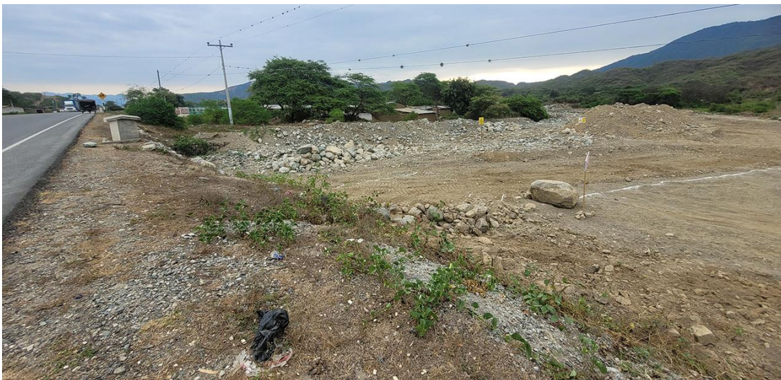
Fotografía 190. Zona crítica 14-159, flujo de detritos en la localidad de Nueva Esperanza que podría afectar 50 m y un pontón de la vía PE-04B y 2 viviendas. Coordenadas E: 647720; N:9341972. (09/09/23).
