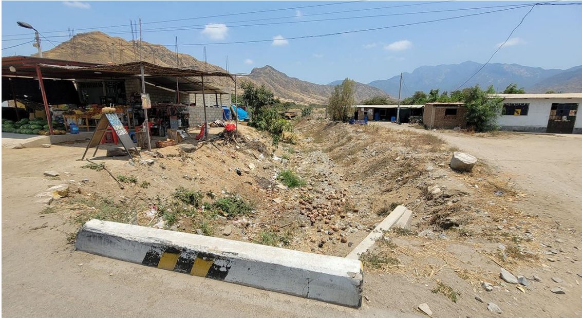
Fotografía 118. Zona crítica 14-087, flujo de detritos en la localidad de Desaguadero que podría afectar 1 alcantarilla de la vía PE-06A y 3 viviendas. Coordenadas E: 663740; N:9254472. (27/09/23).
