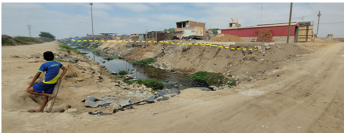
Figura 31. Erosión fluvial en la localidad de Demetrio Acosta Chuez, Lambayeque, donde los depósitos antrópicos son erosionados por el flujo constante del en el canal.
