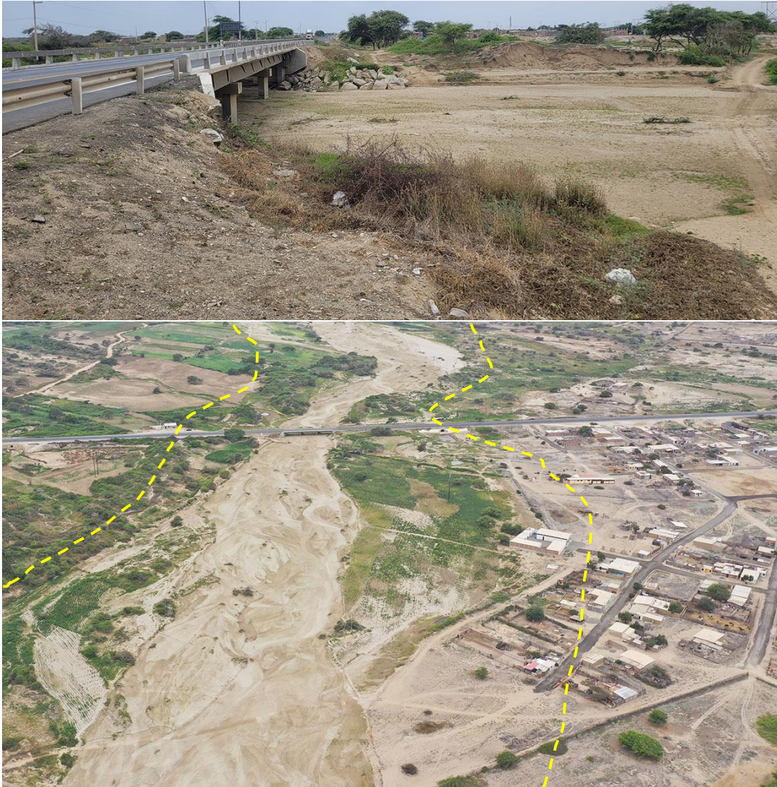
Fotografía 169. Zona crítica 14-138, inundación fluvial en la localidad de Puente Motupe II y III, El Angulo II; y Puente Inche que podría afectar 150 m de vía, 1 puente de la vía PE-1N y 30 viviendas. Coordenadas E: 605650; N:9279001. (08/09/23).
