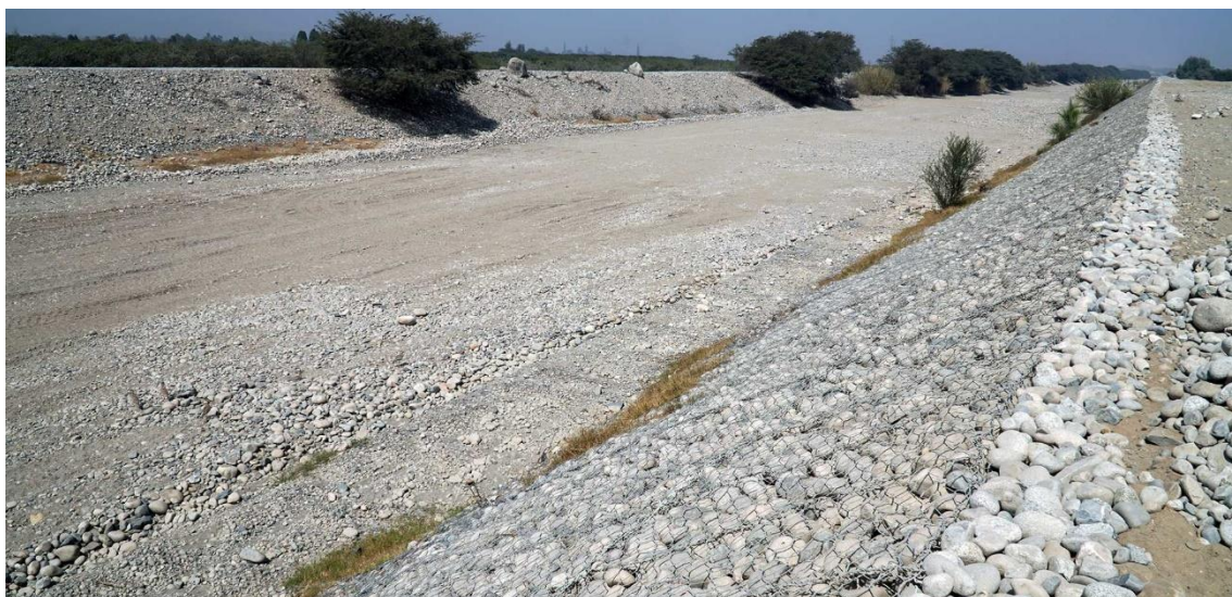
Fotografía 206. Ejemplo de una defensa ribereña con un pedraplén y geomallas.
