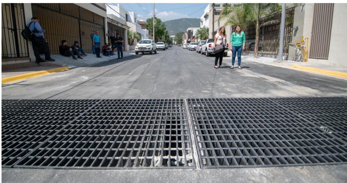
Fotografía 208. Sistema de drenaje pluvial por medio de alcantarillas en un sector urbano.
