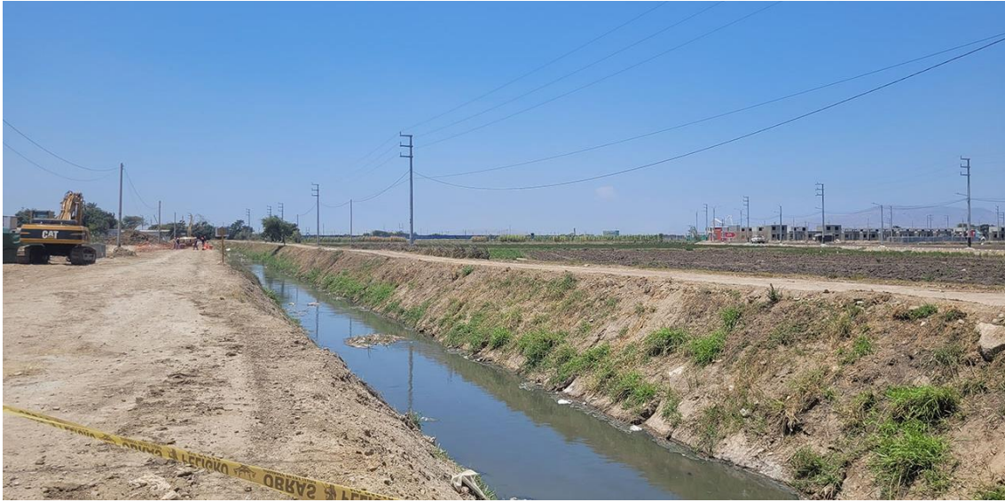
Fotografía 87. Zona crítica 14-056, inundación fluvial en la localidad de La Nueva que podría afectar 3 viviendas y 3 ha de terrenos de cultivos. Coordenadas E: 623700; N:9247650. (18/09/23).
