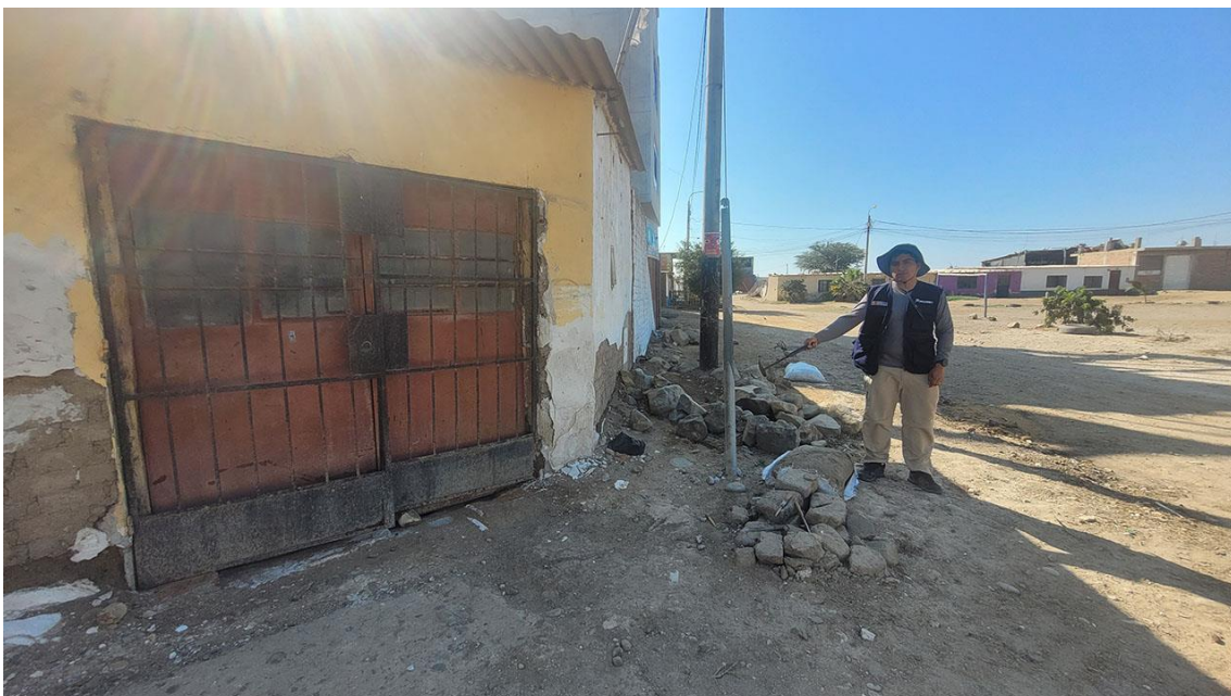
Fotografía 86. Zona crítica 14-055, inundación pluvial en la localidad de La Bahía de Pimentel que podría afectar 30 viviendas. Coordenadas E: 619313; N:9245651. (18/09/23).
