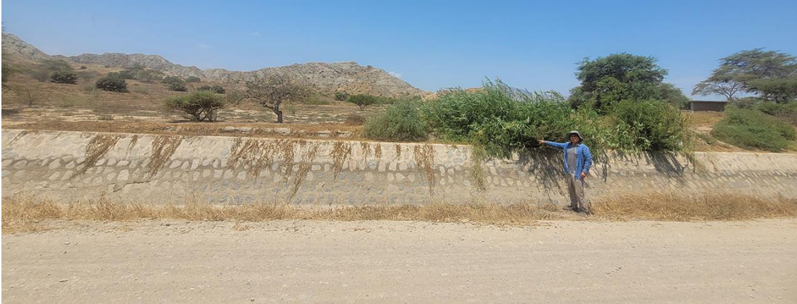
Fotografía 126. Zona crítica 14-095, flujo de detritos en la localidad de Luya que podría afectar 110 m del canal Taymi y 4 viviendas. Coordenadas E: 643212; N:9260669. (17/09/23).
