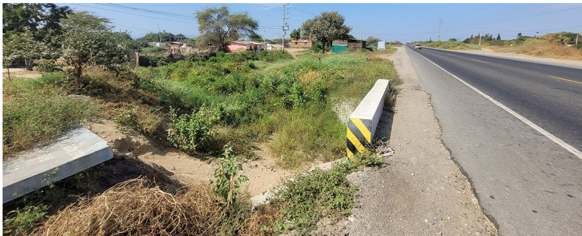
Fotografía 173. Zona crítica 14-142, flujo de detritos en la localidad de Apurlec que podría afectar 1 alcantarilla de la vía PE-1NJ y 2 viviendas. Coordenadas E: 640343; N:9307964. (15/09/23).
