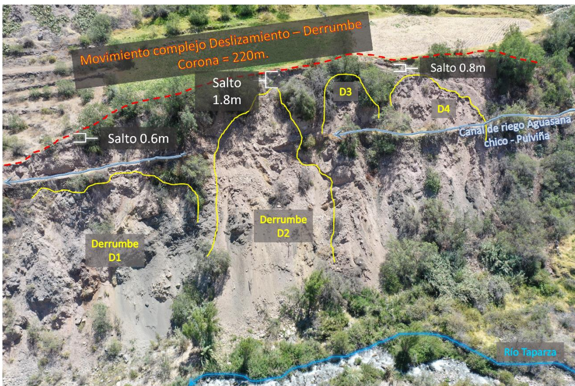
Figura 23. Se observa las características del movimiento complejo de tipo Deslizamiento – Derrumbe que compromete una longitud de 212 metros del canal de riego Aguasana Chico - Pulviña.
