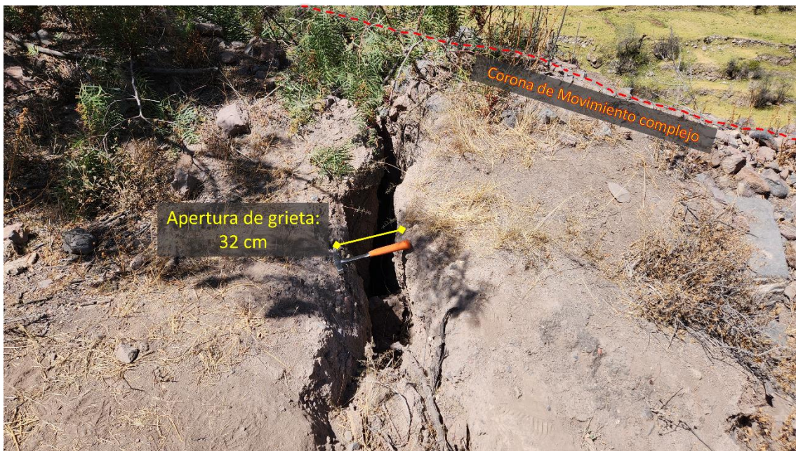
Figura 18. Vista de la grieta del deslizamiento con apertura de 32 centímetros en el sector de Aguasana Chico. Coordenadas UTM E: 769157, N: 8263716.
