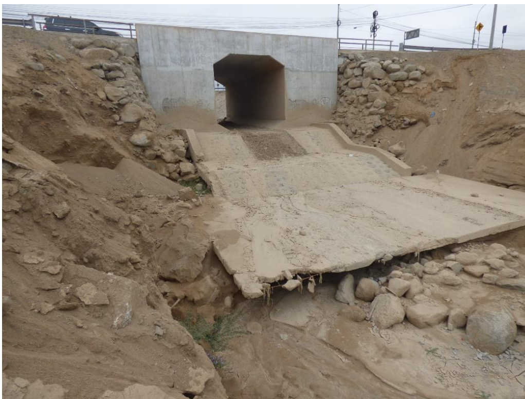
Fotografía 195. Zona crítica 15-067. Pontón en el km 40 de la Carretera Panamericana Sur antigua, el flujo del 14/03/2023 socavó plataforma. Coordenadas UTM 18S E302055; N8635821 (Tomada el 17/08/2023).
