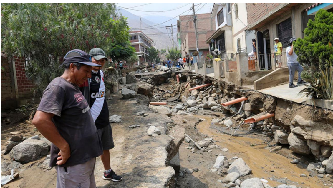
Fotografía 71. Zona crítica 15-014. Tuberías de agua y desagüe, veredas y vías destruidas por el paso del flujo de detritos del 16/03/2023, en la calle B de la Asoc. De Vivienda El Huascarán. Coordenadas UTM 18S E3069725; N8674608 (Fuente: Infobae 2023).
