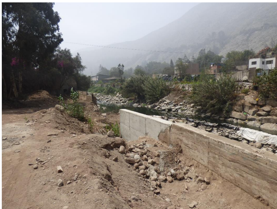
Fotografía 55. Zona crítica 15-009. Erosión fluvial en margen derecha del río Rímac, afectó muro de contención de 75 m que se encuentra en reconstrucción y protege estribo de puente Los Ángeles. Coordenadas UTM 18S E310004; N8676451 (Tomada el 11/09/2023).
