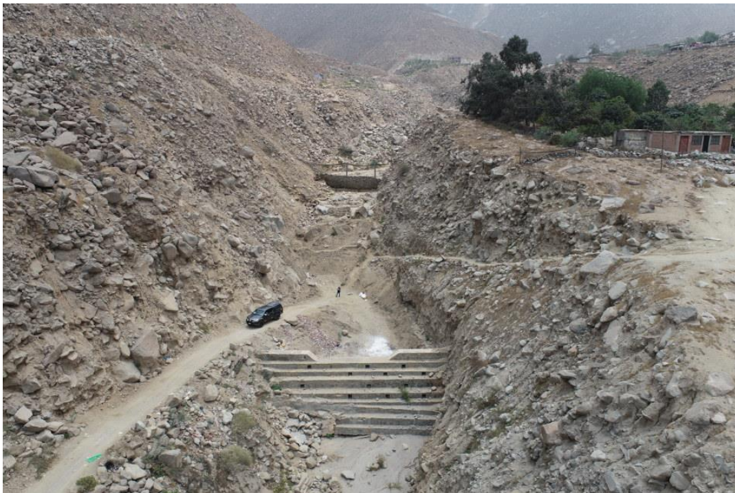
Fotografía 138. Zona crítica 15-042. Vista con dron de los diques disipadores de energía en la quebrada Pedregal, con la base socavada por el flujo de detritos del 14/03/2023. Coordenadas UTM 18S E314487; N8681643 (tomada el 05/10/2023).
