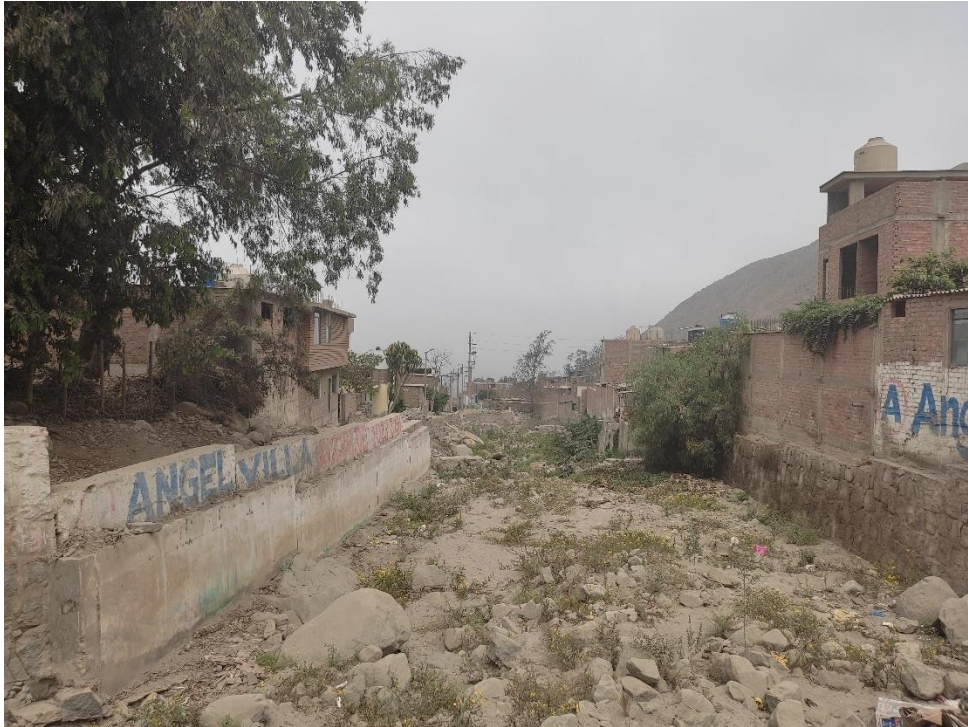
Fotografía 135. Zona crítica 15-041. Cauce colmatado de la quebrada Quirio y falta de mantenimiento en los muros laterales que protegen viviendas de la Urb. Nicolás de Piérola. Coordenadas UTM 18S E313051; N8680056 (tomada el 20/09/2023).
