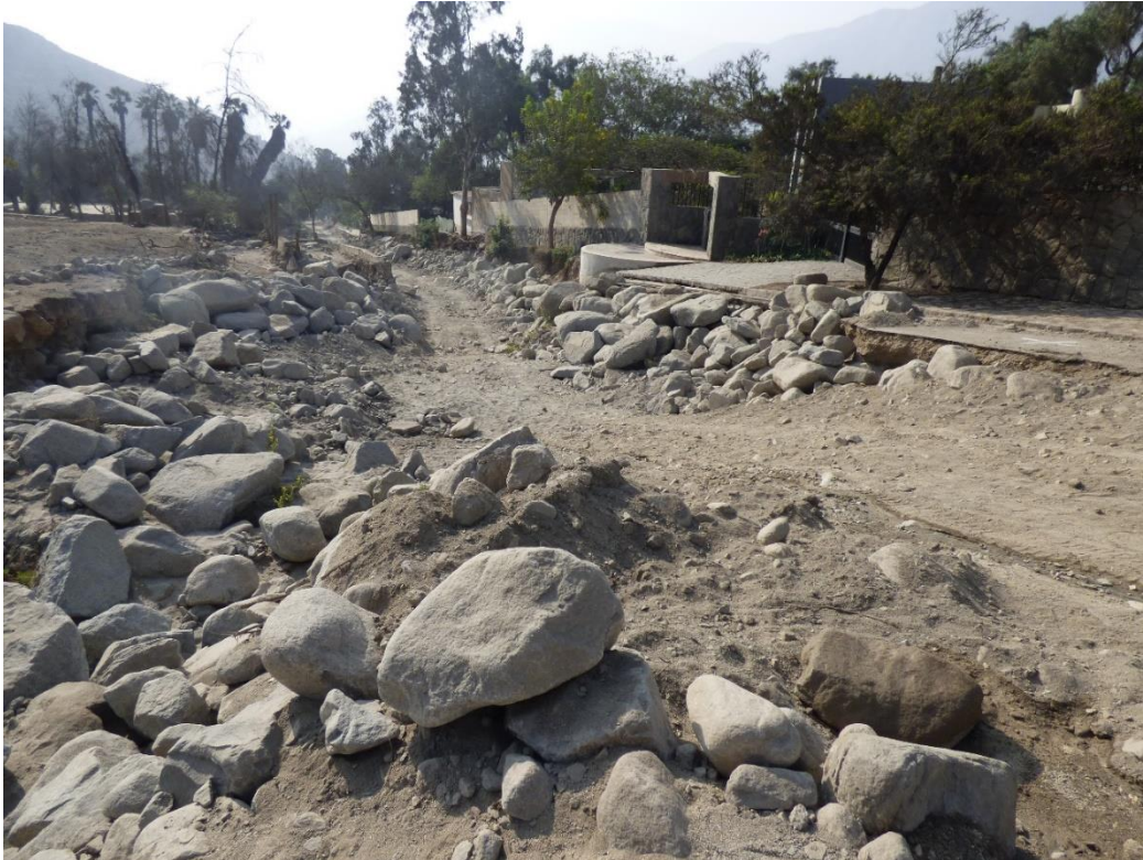
Fotografía 64. Zona crítica 15-013. Instalaciones de La Controlaría afectada en Av. Las Terrazas de la Urb. Cusipata, margen derecha de la quebrada. Coordenadas UTM 18S E306972; N8674608 (Tomada el 11/09/2023).
