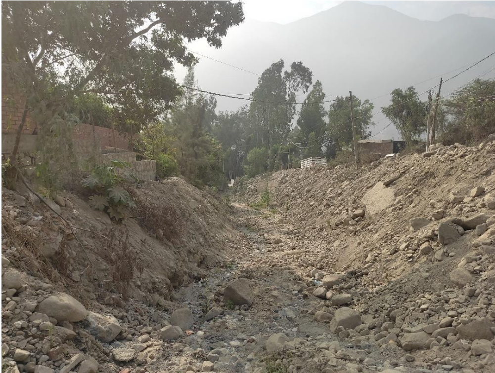
Fotografía 154. Zona crítica 15-047. Viviendas muy cerca del cauce de quebrada La Ronda, el cual se encuentra colmatado. Coordenadas UTM 18S E317236; N8680704 (tomada el 20/09/2023).
