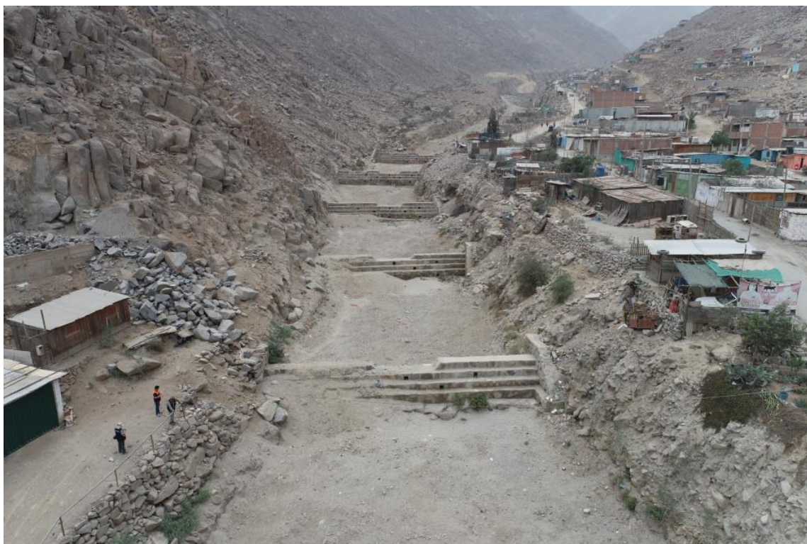
Fotografía 152. Zona crítica 15-047. Diques disipadores de energía se encuentran colmatados tras el paso del flujo de detritos del 14/03/2023 en la quebrada La Ronda. Coordenadas UTM 18S E317236; N8680704 (tomada el 05/10/2023).
