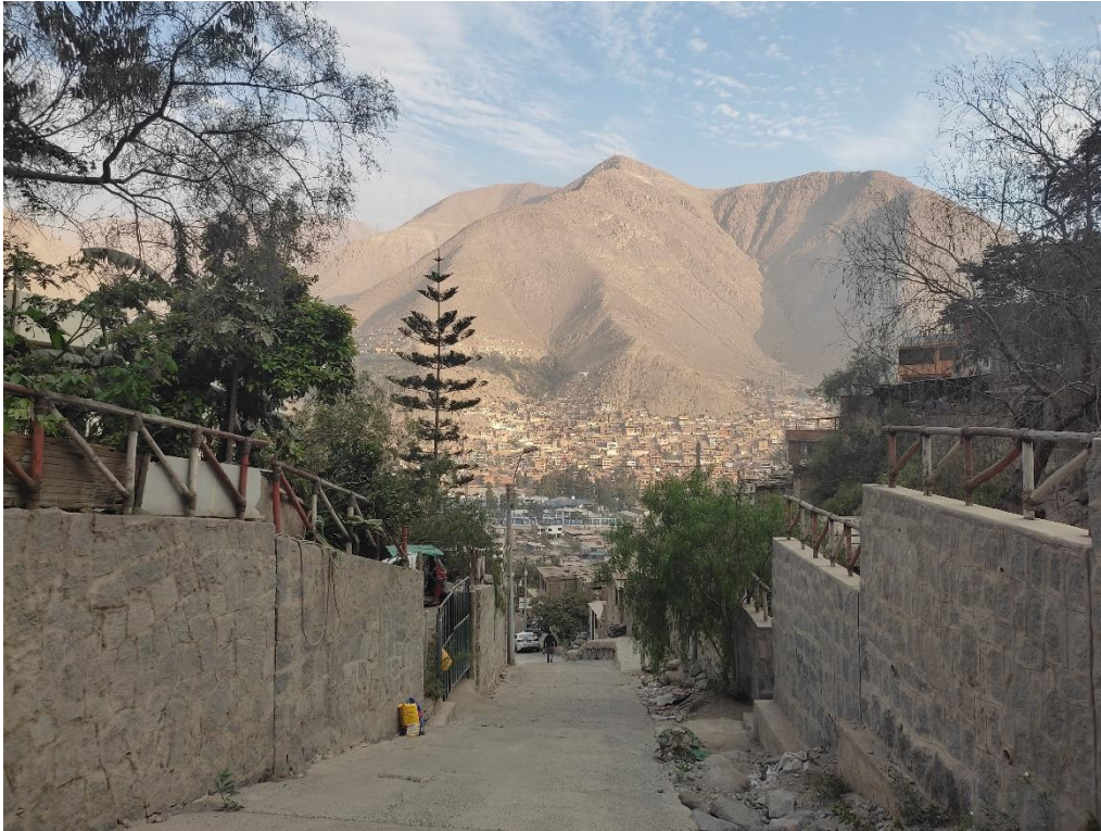
Fotografía 144. Zona crítica 15-045. Muros de contención en ambas márgenes de la quebrada Carossio. Coordenadas UTM 18S E316210; N8681288 (tomada el 20/09/2023).
