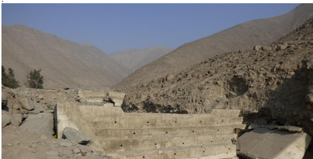
Fotografía 18. Relieve montañoso en roca intrusiva en la quebrada Cusipata en el distrito de Chaclacayo. Se observa un dique destruido por un flujo de detritos producido en 2023 a causa de las lluvias por el ciclón Yaku.
