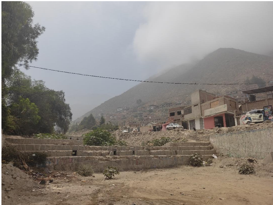
Fotografía 134. Zona crítica 15-041. Dique disipador de energía en la quebrada Quirio. Se observa material y vegetación en el cauce. Coordenadas UTM 18S E313051; N8680056 (tomada el 20/09/2023).
