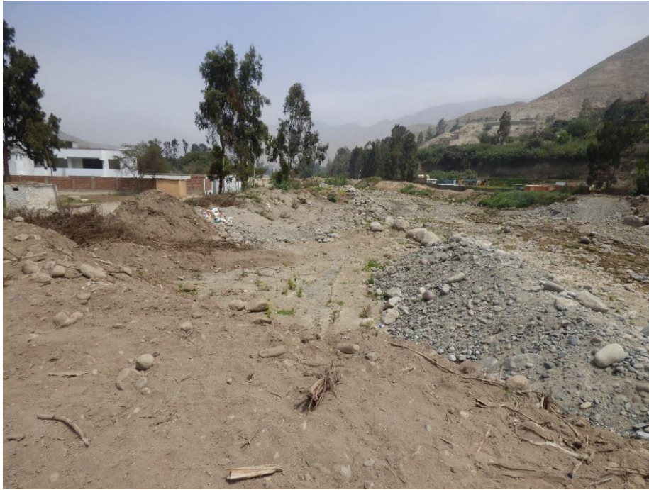
Fotografía 82. Zona crítica 15-019. Se ha colocado depósitos de desmonte y rocas en la ribera para protegerse de la erosión fluvial en la margen izquierda del río Lurín, sector Carricillo. Con las lluvias originadas por el ciclón Yaku, este sector fue afectado por erosión fluvial luego se desbordó el río hasta colapsar el muro perimétrico de las viviendas aguas abajo. Coordenadas UTM 18S E308263; N8665230 (tomada el 07/09/2023).
