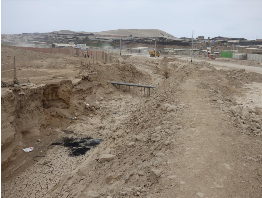
Fotografía 197. Zona crítica 15-068. Vista del gasoducto de Calidda afectado en el flujo de detritos del 14/03/2023, que socavó el cauce de la quebrada. Coordenadas UTM 18S E305142; N8638712 (Tomada el 04/09/2023).
