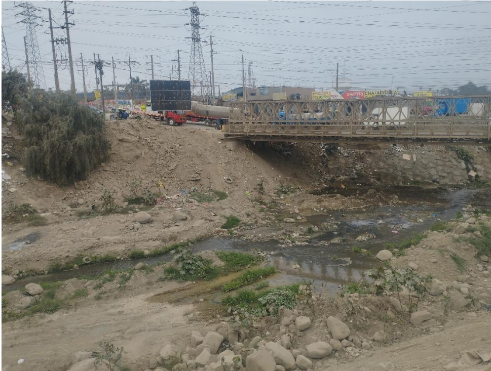
Fotografía 114. Zona crítica 15-029. Puente Las Torres, se encuentra con las bases debilitadas, el cauce de la quebrada Huaycoloro está colmatado, Urb. Brisas de Huachipa. Coordenadas UTM 18S E291372; N8672835 (tomada el 06/10/2023).
