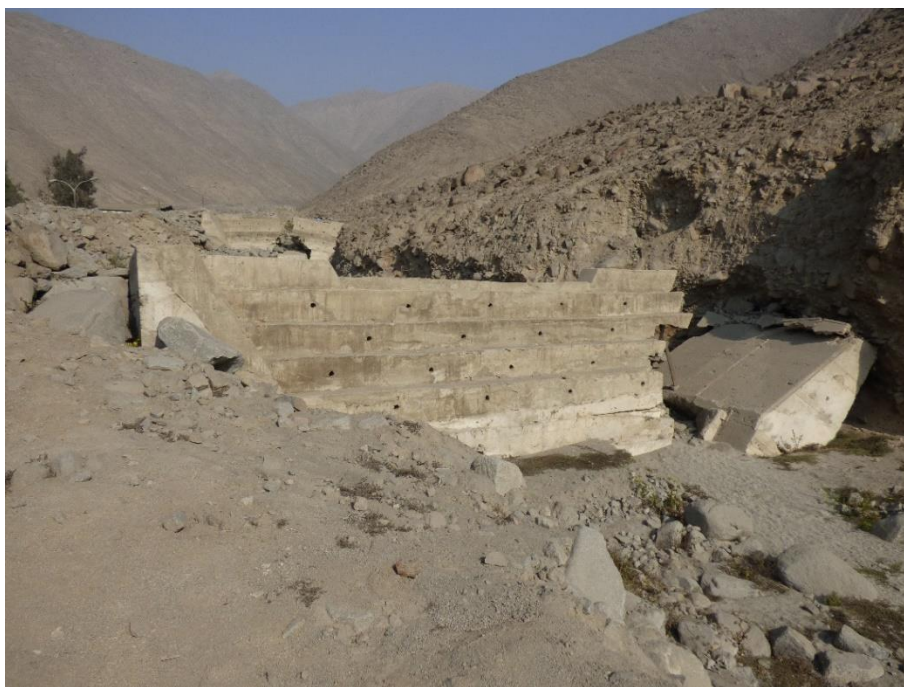
Fotografía 62. Zona crítica 15-013. Quebrada Cusipata, se aprecian diques destruidos por flujo de detritos por las lluvias originadas por el ciclón Yaku. Coordenadas UTM 18S E307015; N8674561 (Tomada el 11/09/2023).
