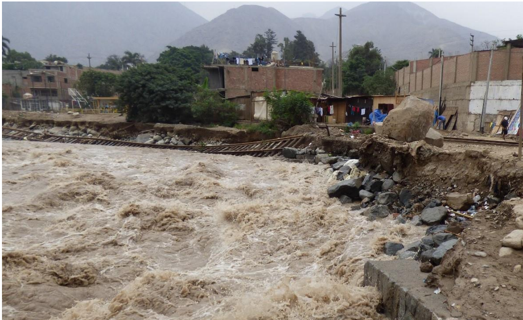
Fotografía 175. Zona crítica 15-054. Vía del Ferrocarril Central- altura de Puente Caracol -Sector Los Cañaverales afectado por erosión fluvial. Coordenadas UTM 18S E313831; N8678693 (Fuente: Ochoa et al., 2017).
