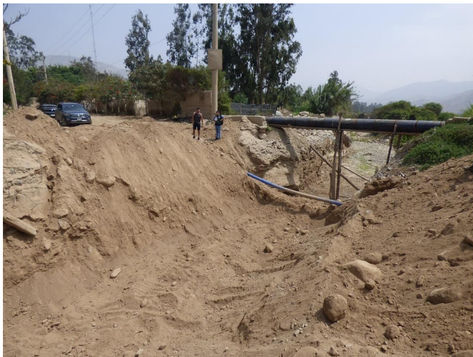
Fotografía 95. Zona crítica 15-025. Cauce de la quebrada Tinajas socavado por el flujo de lodo en la Av. Tulipanes, tras su paso destruyó tuberías de riego, agua potable y vía que conecta a Pachacamac. Coordenadas UTM 18S E302117; N8656988 (tomada el 08/09/2023).
