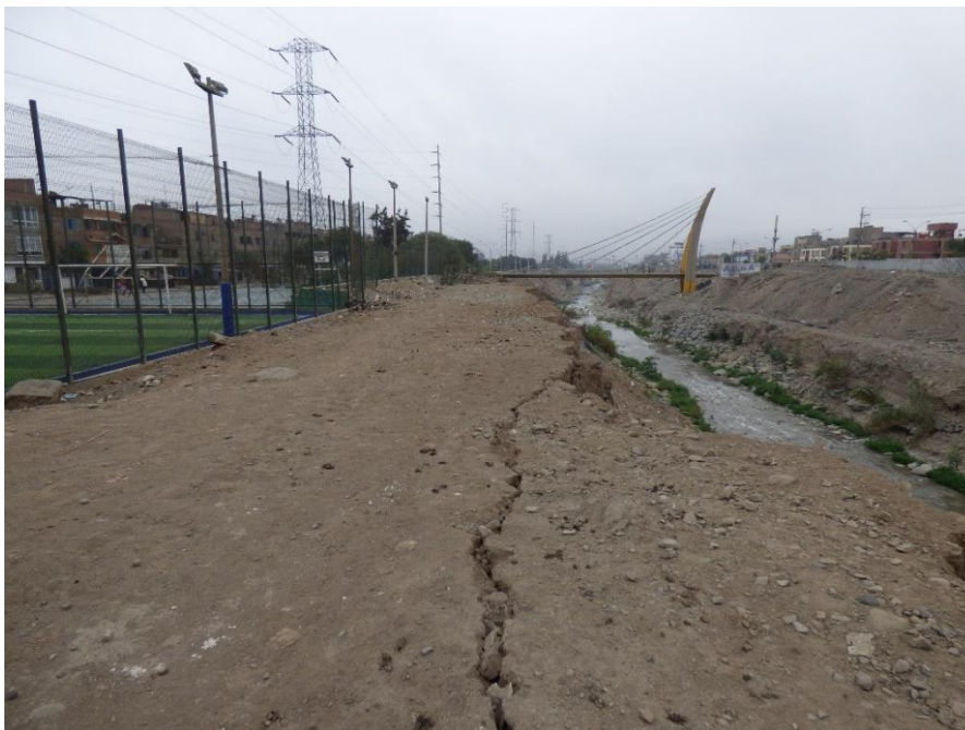
Fotografía 101. Zona crítica 15-026. Presencia de grietas debido a la erosión fluvial en la margen izquierda del río Rímac, se ha colocado depósitos de desmonte para recuperar el terreno que colapsó en el año 2017, no cuenta con defensa ribereña. El parque y complejo deportivo de la Cooperativa Talavera La Reyna se encuentra en alto peligro. Coordenadas UTM 18S E308974; N8657792 (tomada el 13/09/2023).
