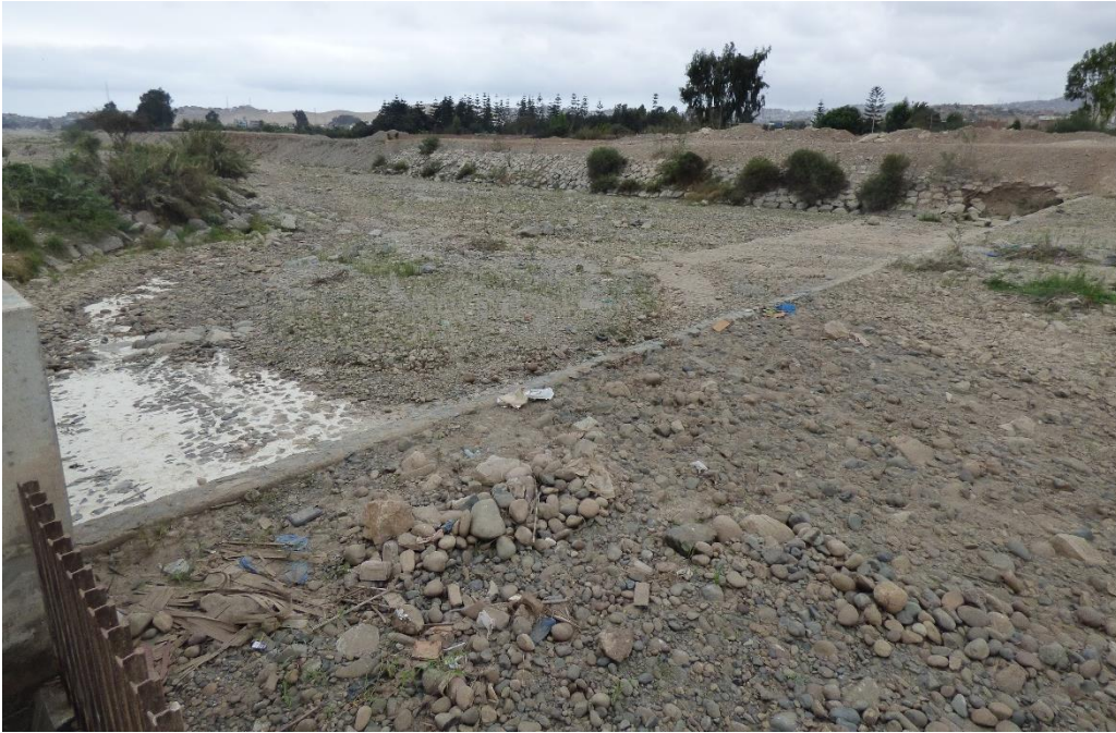
Fotografía 185. Zona crítica 15-062. Erosión fluvial en ambas márgenes del río Lurín, la base de la plataforma se encuentra debilitada por la erosión en la Ex Bocatoma. Coordenadas UTM 18S E295609; N8647449 (tomada el 05/09/2023).
