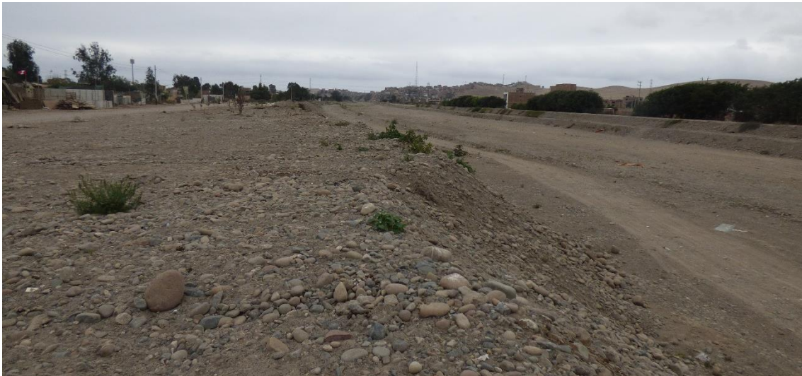
Fotografía 184. Zona crítica 15-061. Erosión fluvial en ambas márgenes del río Lurín, sector San Pedro de Chañac; se ha realizado limpieza del cauce y se ha colocado plataformas del material extraído, el sector requiere enrocado. Coordenadas UTM 18S E295127; N8646728 (tomada el 05/09/2023).
