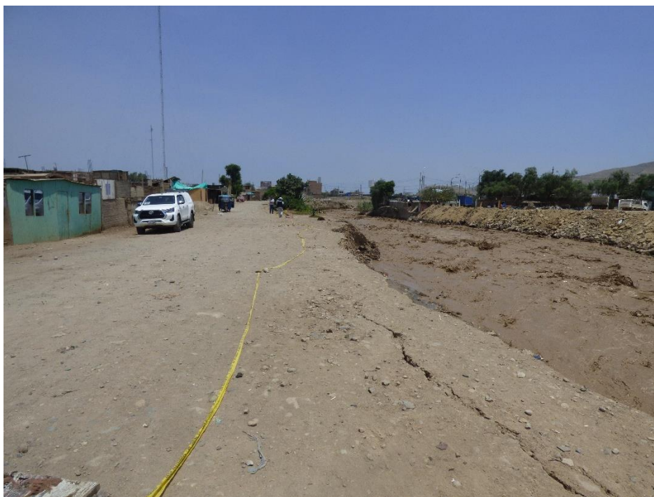
Fotografía 54. Zona crítica 15-008. Erosión fluvial en la margen izquierda del río Chillón, durante las lluvias por el Ciclón Yaku socavó la base de terraza donde se ubican viviendas del sector Huacoy, se observa presencia de agrietamientos. Coordenadas UTM 18S E279899; N8688809 (Tomada el 20 /03/2023).
