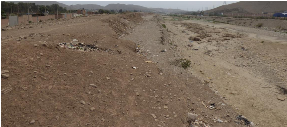
Fotografía 34. Terrazas en ambas márgenes del río Chillón, sobre estas se han arrojado desmonte para incrementar la altura de la terraza y crear una barrera protectora ante crecidas. Sector de Lomas de Chillón en el distrito de San Martín de Porres.
