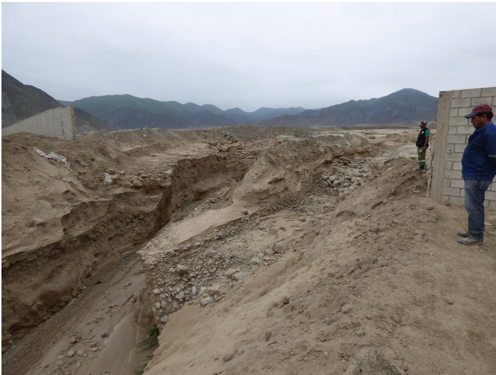
Fotografía 202. Zona crítica 15-070. Muro perimétrico de Granja Avícola Malanche obstruía cauce de la quebrada Malanche, en el flujo de detritos de 2017 destruyó muro, desviando el flujo por los costados afectando viviendas del sector Santa Rosa de Olleros. Coordenadas UTM 18S E308664; N8640228 (Tomada el 04/09/2023).
