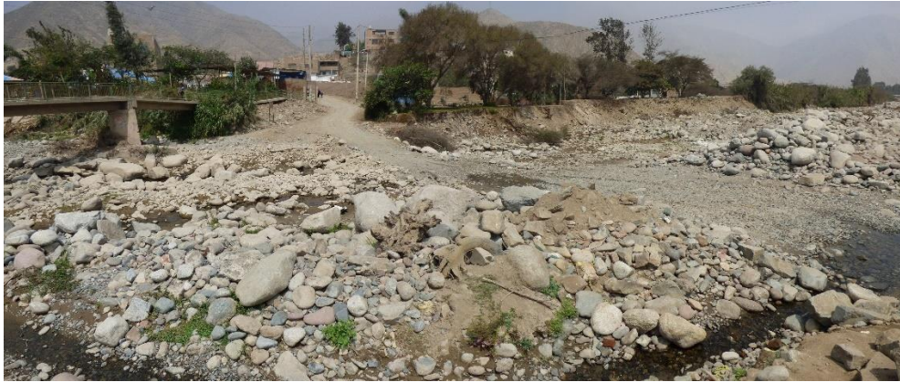
Fotografía 86. Zona crítica 15-021. Erosión en margen izquierda el río Lurín, pilares del puente peatonal se encuentra debilitado y cauce del río colmatado. Coordenadas UTM 18S E307293; N8663797 (tomada el 07/09/2023).
