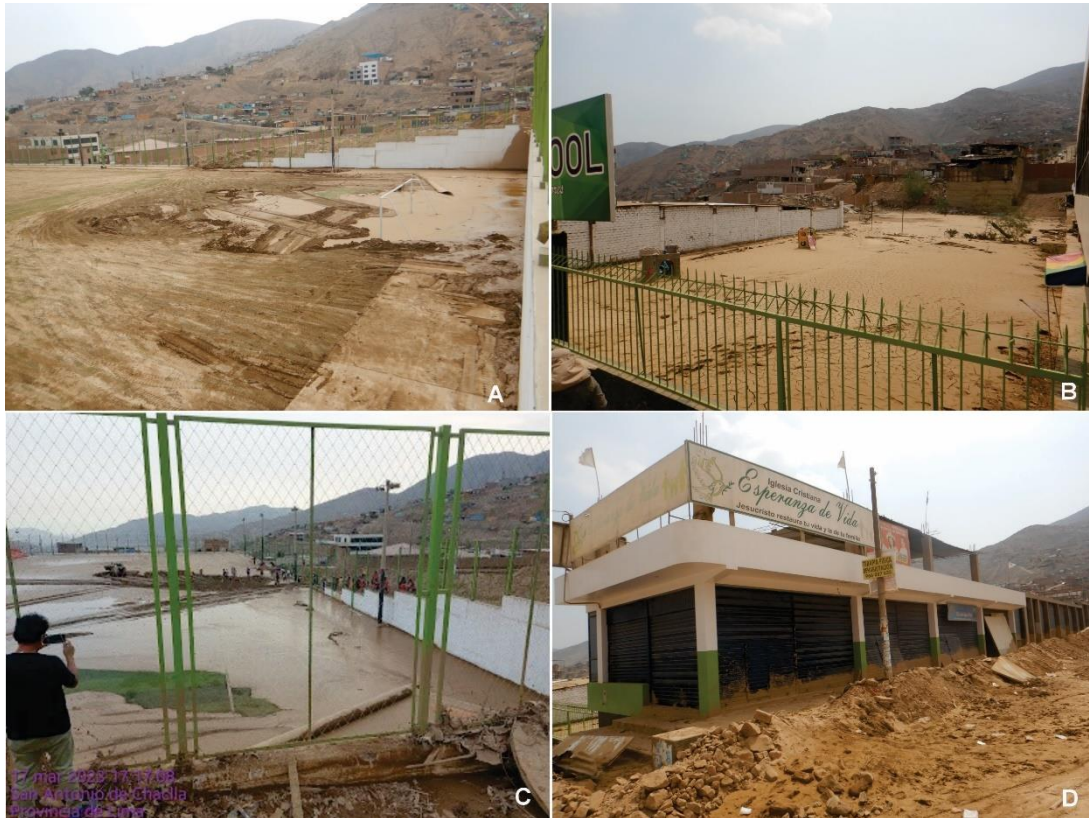
Figura 18. Zona crítica 15-076. A) Instalaciones del Complejo Deportivo del sector El Valle afectado por flujo de lodo, B y C) Instalaciones del colegio Hope School afectado por flujo de lodo D) Viviendas de la Av. Andrés Avelino Cáceres afectado por el flujo del 14/03/2023. Coordenadas UTM 18S E290045; N8630964. (Tomada el 20/03/2023).
