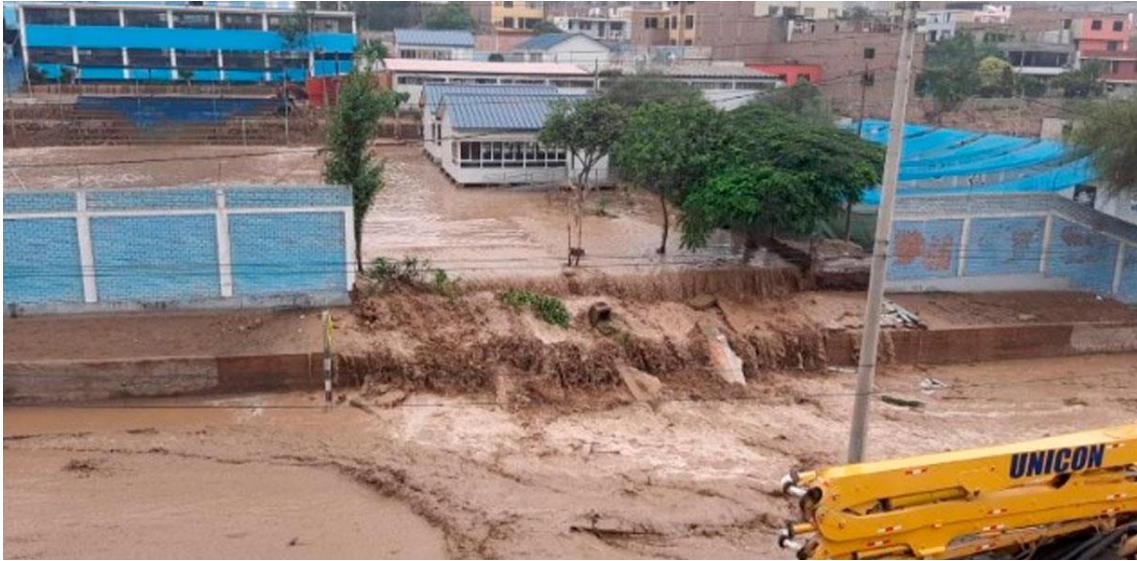
Fotografía 72. Zona crítica 15-014. Muro perimétrico colapsado e instalaciones afectadas del I.E. Felipe Santiago Estenos por el paso del flujo de detritos, en la Prolong. Av. Los Olivos con la calle Riscos, Urb. Los Halcones y Av. Nicolás Ayllón. Coordenadas UTM 18S E306315; N8675263 (tomada el 12/09/2023).
