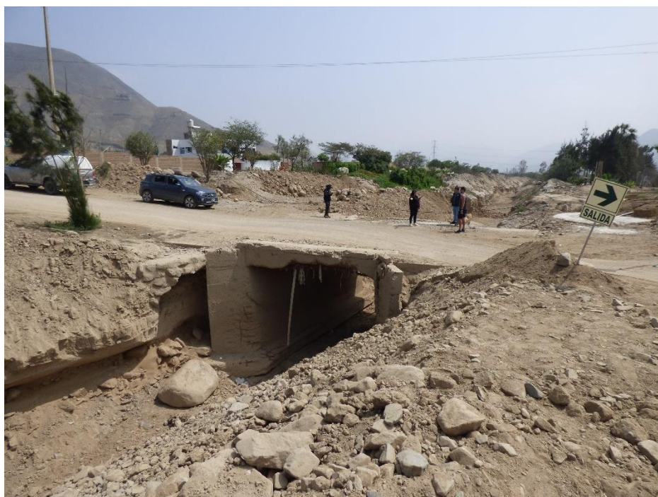
Fotografía 96. Zona crítica 15-025. Puente que conecta con el Condominio La Raya (Pachacamac) quedó debilitado debido a la reducida luz del puente se obstruyó y se desbordó afectando viviendas y medios de vida de la Cooperativa de Salud y Pampa Tinajas. Coordenadas UTM 18S E302987; N8657168 (tomada el 08/09/2023).
