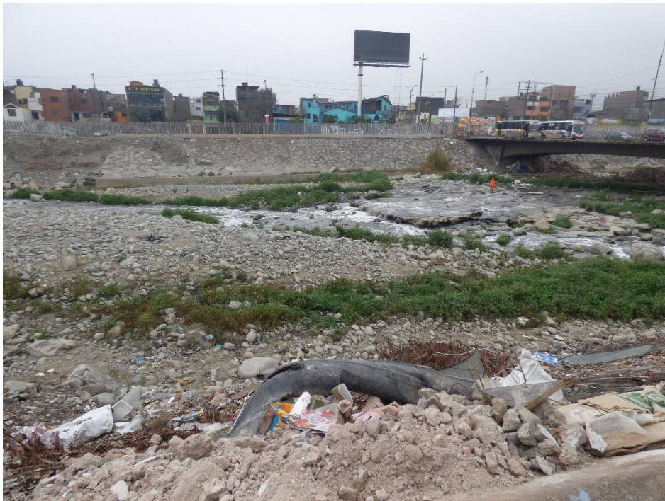
Fotografía 109. Zona crítica 15-028. Cauce colmatado del río Rímac en Puente Nuevo, aguas abajo enrocado destruido por tramos debido a la erosión fluvial. Coordenadas UTM 18S E282054; N8669533 (tomada el 14/09/2023).
