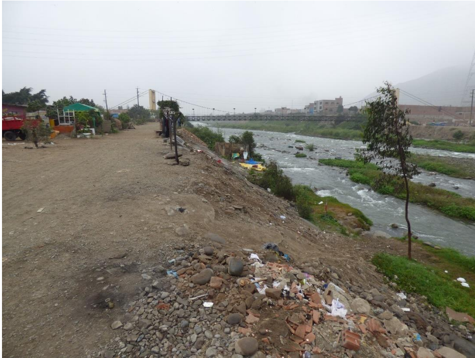
Fotografía 118. Zona crítica 15-032. Erosión fluvial en margen derecha del río Rímac, viviendas de la Asociación Nuevo Carrizales de Carapongo se encuentran cerca del borde. Coordenadas UTM 18S E296907; N8672040 (tomada el 13/09/2023).
