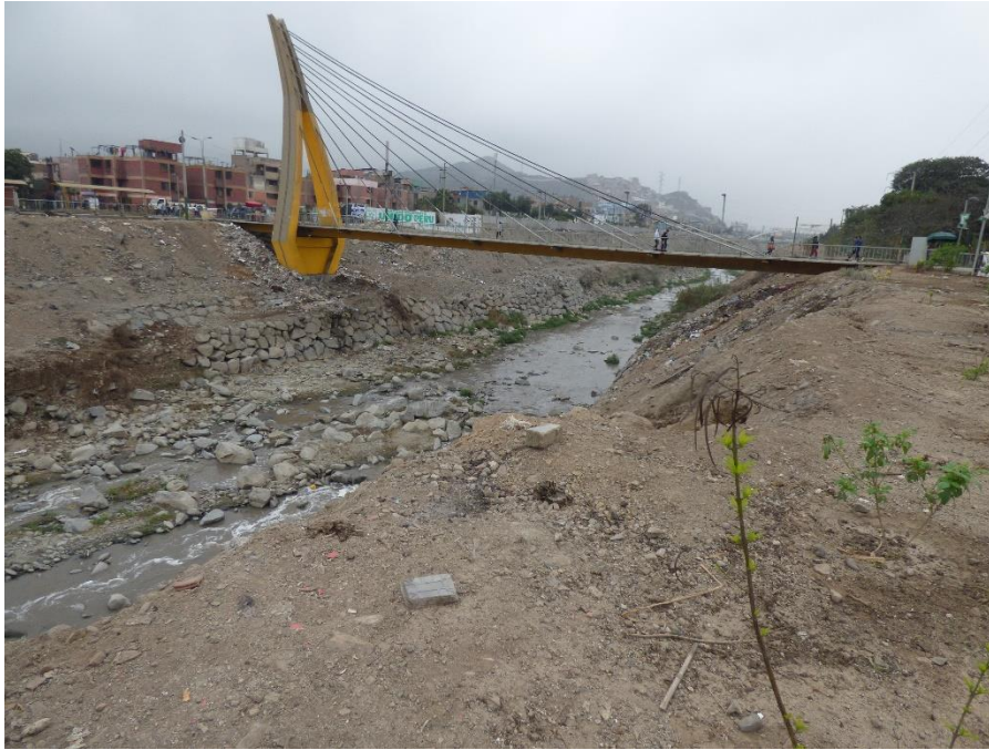
Fotografía 100. Zona crítica 15-026. Puente Los Libertadores, se observa cauce colmatado del río Rímac, bases y enrocado para proteger el puente se encuentran debilitados del puente, se ha colocado depósitos de desmonte en la margen izquierda del río. Coordenadas UTM 18S E283467; N8669653 (tomada el 13/09/2023).
