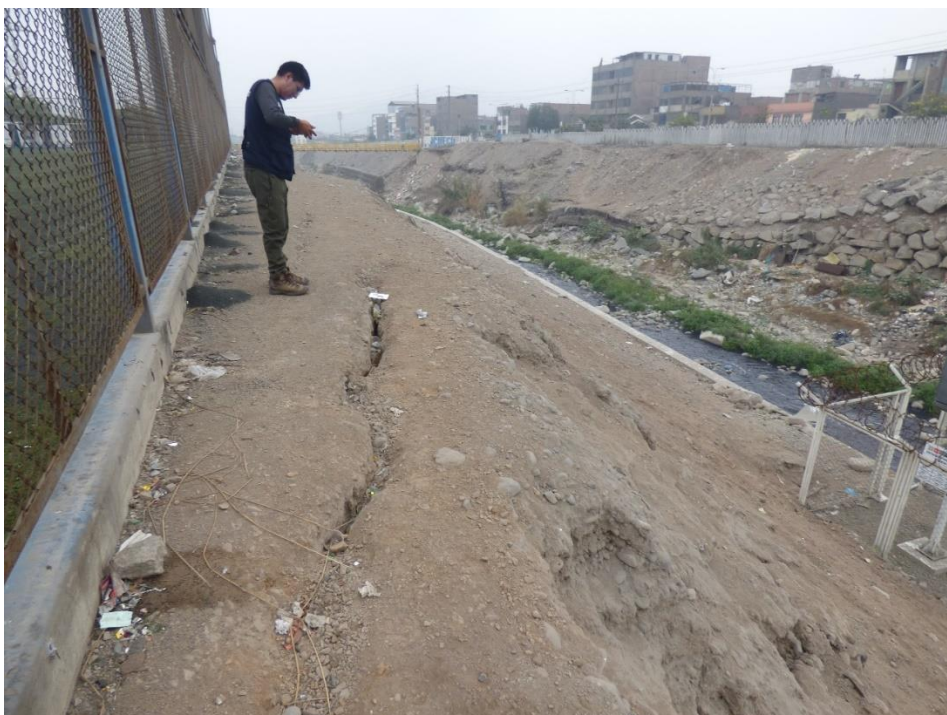
Fotografía 105. Zona crítica 15-027. Grietas de 15 cm de separación, en la margen derecha también presenta erosión fluvial que afectó muro de gaviones y enrocado. Coordenadas UTM 18S E283144; N8669667 (tomada el 15/09/2023).
