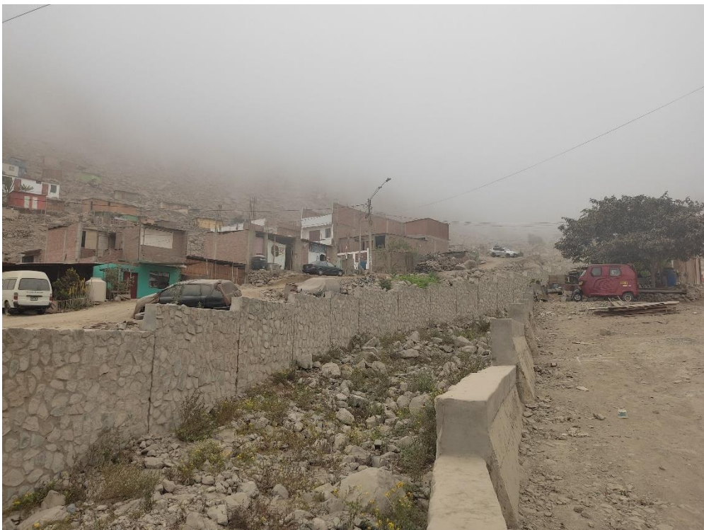
Fotografía 130. Zona crítica 15-039. Muros laterales en la quebrada Chacrasana, cauce colmatado. Coordenadas UTM 18S E309711; N8678061 (tomada el 20/09/2023).
