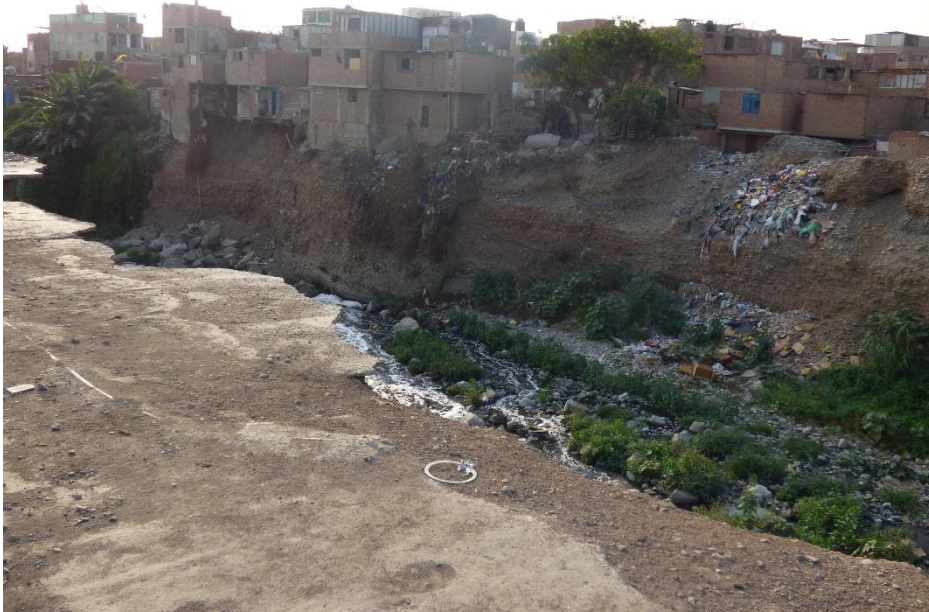
Fotografía 222. Zona crítica 15-079. Viviendas del Malecón Rímac se encuentran al borde del acantilado en la margen derecha del río Rímac, algunas bases de las viviendas se encuentran expuestas a punto de colapsar. En la margen derecha también presenta erosión fluvial, con presencia de grietas en el terreno Coordenadas UTM 18S E273625; N8668630. (Tomada el 20/03/2023).
