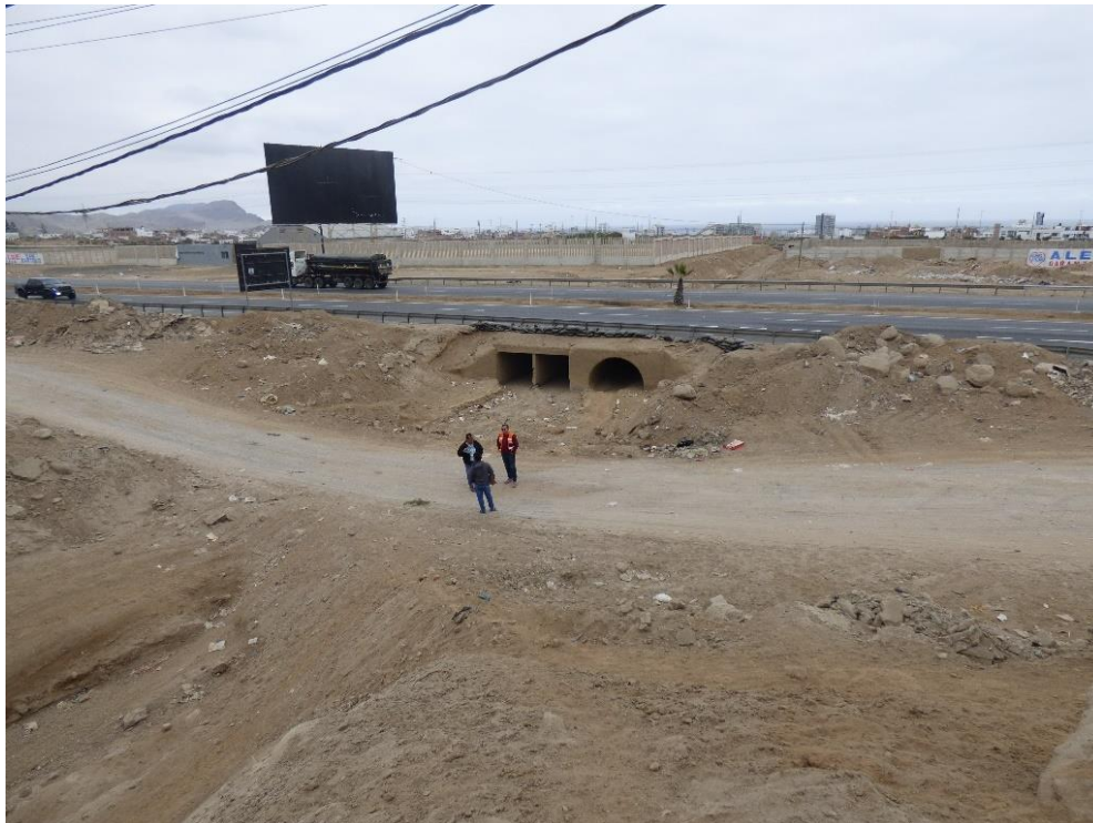
Fotografía 206. Zona crítica 15-072. Alcantarillas en la carretera Panamericana antigua y vía alterna informal que obstruyen el cauce de la quebrada Cruz de Hueso. Coordenadas UTM 18S E306368; N8630964. (Tomada el 17/08/2023).
