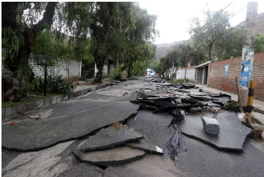
Fotografía 59. Zona crítica 15-011. Carretera asfaltada destruida de la Av. Los Laureles entre las calles San José y Tupac Amaru, afectado por flujo de detritos que discurrió de quebrada tributaria de Los Cóndores. Coordenadas UTM 18S E309459; N8675728 (Fuente: Infobae, 2023).
