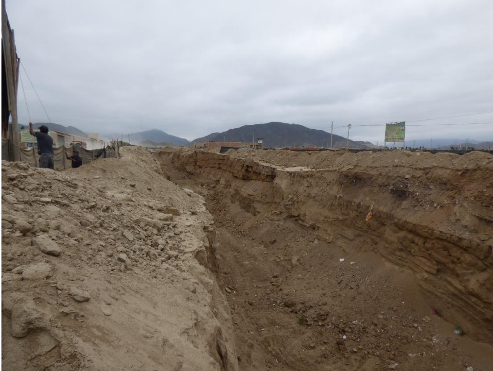
Fotografía 199. Zona crítica 15-069. Vista aguas arriba de la quebrada Malanche, viviendas de los sectores 1, 4 y 9 del sector Pampapacta se encuentran en peligro por el flujo de lodo y detritos debido a la cercanía al cauce colmatado. Coordenadas UTM 18S E305142; N8638712 (Tomada el 04/09/2023).
