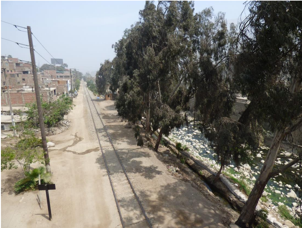
Fotografía 56. Zona crítica 15-009. Erosión fluvial en margen izquierda del río Rímac, se ha colocado sacos terreros, puede afectar vía férrea. Coordenadas UTM 18S E309845; N8676385 (Tomada el 11/09/2023).
