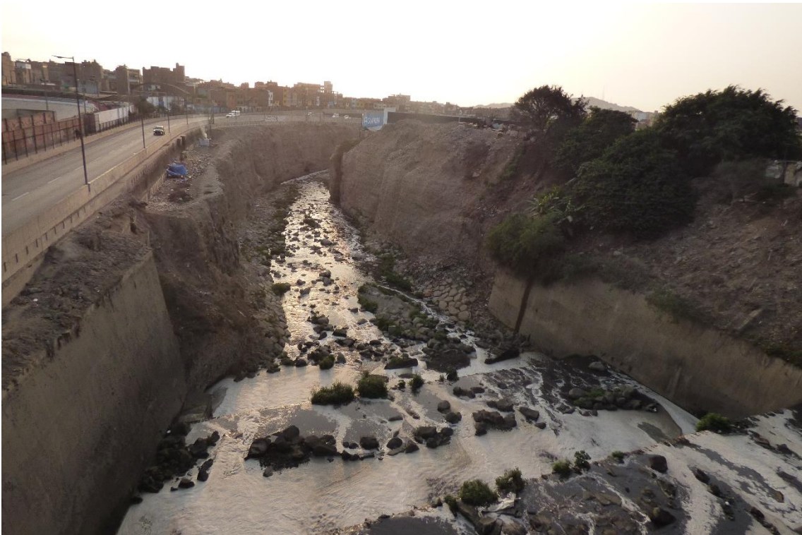
Fotografía 225. Zona crítica 15-081. Presencia de erosión fluvial en ambas márgenes del río Rímac, en la margen derecha el muro perimétrico del estadio Alberto Gallardo se encuentra muy cerca del borde del acantilado. Coordenadas UTM 18S E277370; N8668333. (Tomada el 20/03/2023).
