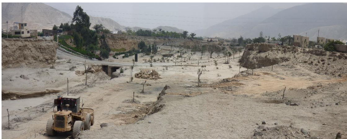
Fotografía 93. Zona crítica 15-025. Vía de acceso al Condominio Las Bahías cruza quebrada Tinajas, se ha colocado un pontón que se encuentra debilitado por el flujo de lodo del 14/03/2023. Coordenadas UTM 18S E308974; N8657792 (tomada el 08/09/2023).
