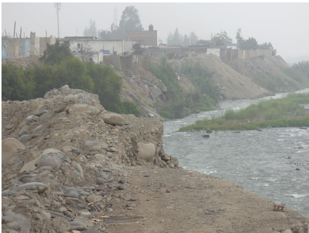
Fotografía 41. Vista de los depósitos de desmante en la margen izquierda del río Rímac. Los depósitos de desmante se encuentran afectados por erosión fluvial.
