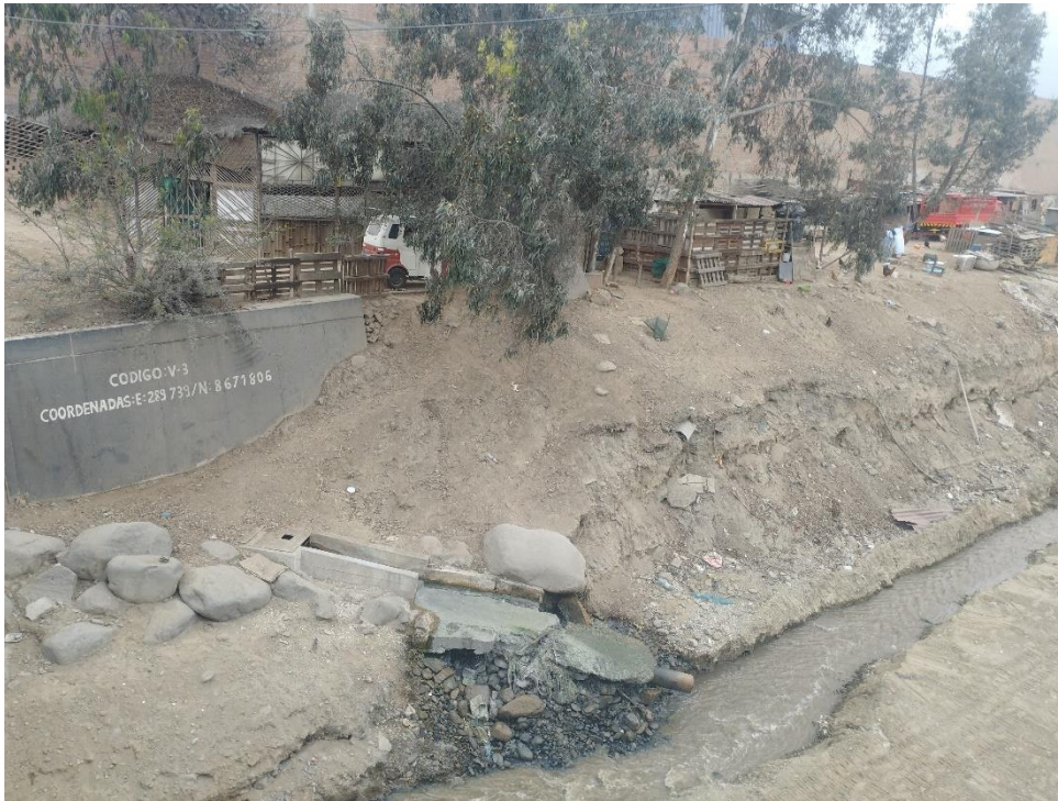
Fotografía 112. Zona crítica 15-029. Puente Santa María de Huachipa el cauce de la quebrada se observa colmatado y viviendas cerca del borde de la quebrada. Coordenadas UTM 18S E289751; N8671806 (tomada el 06/10/2023).
