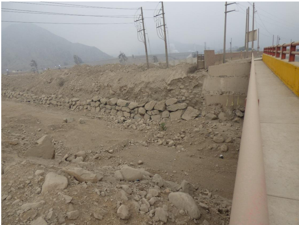
Fotografía 117. Zona crítica 15-031. Estribo derecho debilitado y socavado del puente principal Eje Industrial de Lima (Petramás), sector Refinería Cajamarquilla, de aprox. 25 m. Coordenadas UTM 18S E293933; N8676739 (tomada el 06/10/2023).
