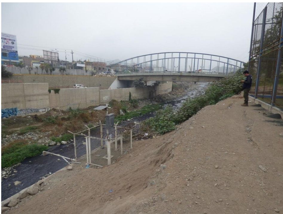
Fotografía 104. Zona crítica 15-027. Presencia de grietas en la margen izquierda del río Rímac al borde del complejo deportivo del sector Bethania y estación hidrométrica de Senamhi. Aguas arriba del puente falta enrocamiento. Coordenadas UTM 18S E283144; N8669667 (tomada el 15/09/2023).
