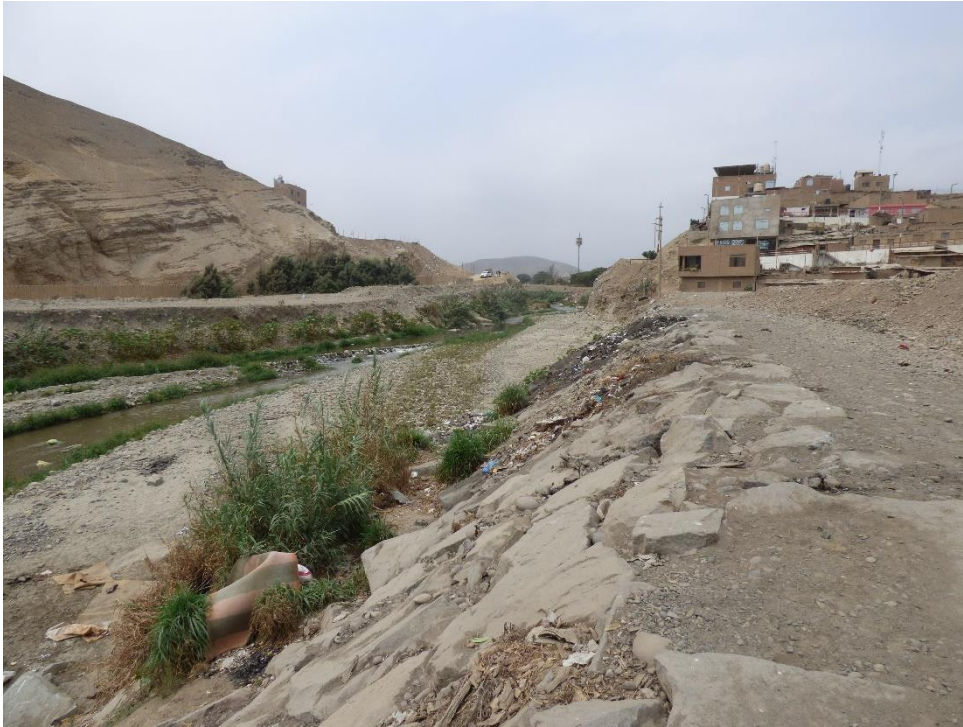
Fotografía 216. Zona crítica 15-077. Vista aguas arriba, vivienda muy cerca del cauce del río Chillón, margen izquierda, el cauce se encuentra colmatado. Aguas abajo, se ha colocado enrocado que necesita mantenimiento. Coordenadas UTM 18S E271270; N8678119. (Tomada el 15/09/2023).
