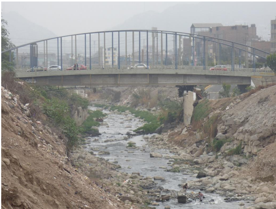
Fotografía 103. Zona crítica 15-027. Puente Las Lomas, se observa las bases debilitadas y cauce del río colmatado con presencia de desmonte y basura en las riberas. Coordenadas UTM 18S E283144; N8669667 (tomada el 15/09/2023).
