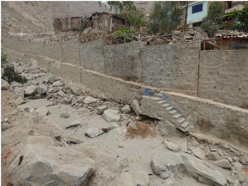
Fotografía 169. Zona crítica 15-052. Bases de los muros de contención se encuentran socavadas en ambas márgenes de la quebrada Santo Domingo, con presencia de humedad. Coordenadas UTM 18S E315549; N8678777 (tomada el 06/10/2023).
