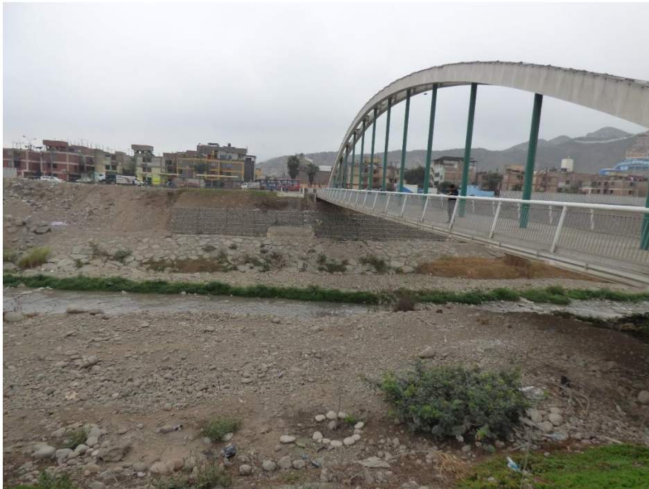
Fotografía 99. Zona crítica 15-026. Nuevo puente Malecón Checa, se ha reforzado con gaviones y enrocado las bases del nuevo puente de reemplazo al puente que se desplomó en el año 2017, el cauce del río Rímac se encuentra colmatado. Coordenadas UTM 18S E283988; N8669731 (tomada el 13/09/2023).
