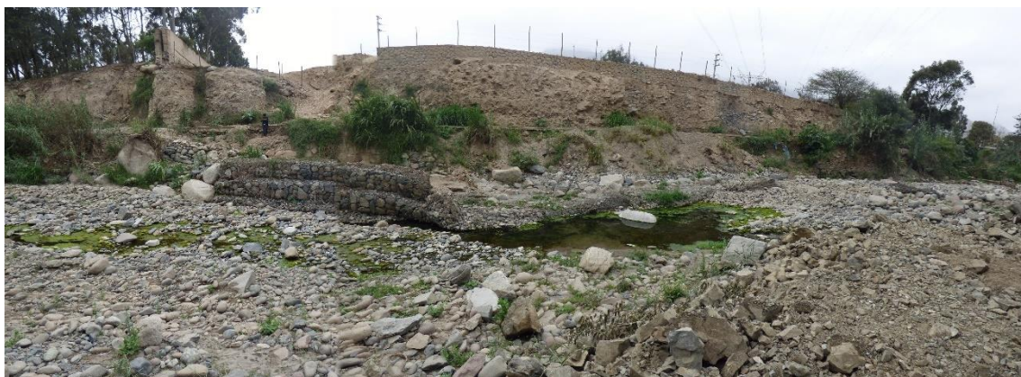
Fotografía 92. Zona crítica 15-024. Colmatación del cauce del río Lurín, gaviones destruidos por huaico de la quebrada Tinajas y erosión fluvial en la margen izquierda del río Lurín. En la margen derecha del río puede afectar vía a Manchay y viviendas. Coordenadas UTM 18S E300643; N8656846 (tomada el 08/09/2023).
