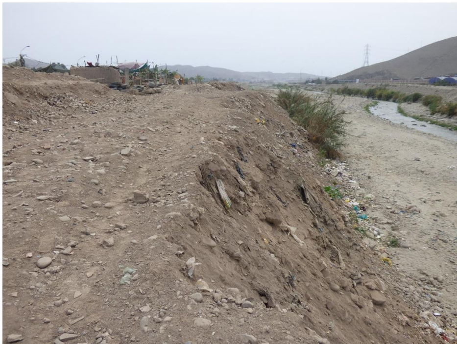
Fotografía 215. Zona crítica 15-077. Erosión fluvial en la margen izquierda del río Chillón, sector Las Lomas de Chillón, se observa viviendas y corrales asentados sobre depósitos de relleno. Coordenadas UTM 18S E271270; N8678119. (Tomada el 15/09/2023).
