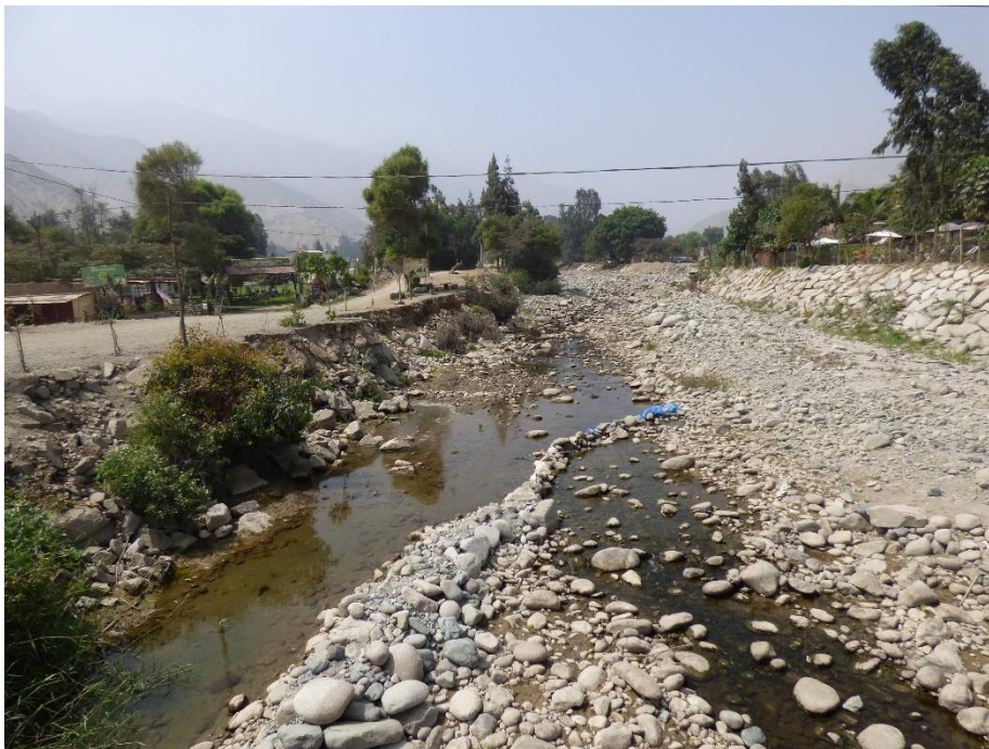
Fotografía 85. Zona crítica 15-021. Erosión fluvial en la margen derecha del río Lurín, sector El Ranchito, puede afectar viviendas, centro recreacional y vías. Coordenadas UTM 18S E307293; N8663797 (tomada el 07/09/2023).
