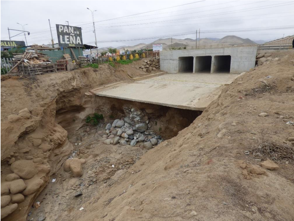
Fotografía 205. Zona crítica 15-072. Plataforma de las alcantarillas socavada. Cruce de la carretera Panamericana Sur y el cauce de la quebrada Cruz de Hueso, viviendas a 2 m del cauce, en la margen derecha. Coordenadas UTM 18S E306368; N8630964. (Tomada el 17/08/2023).
