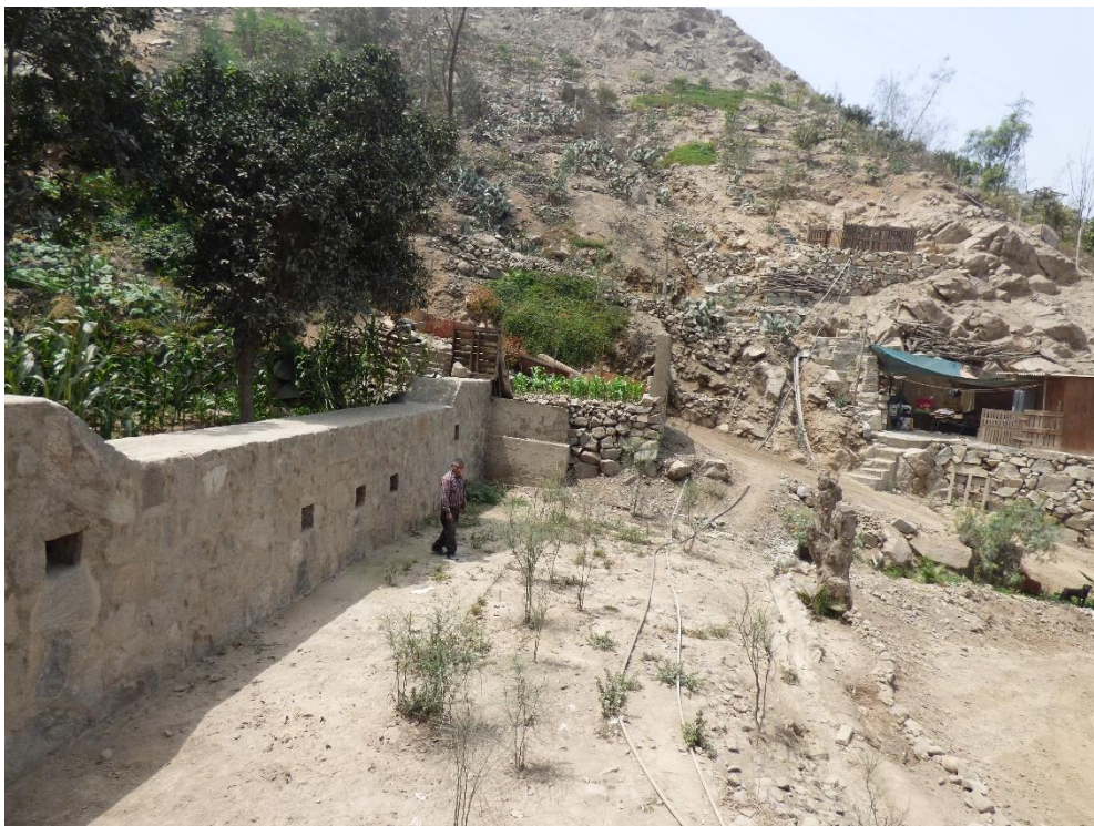
Fotografía 122. Zona crítica 15-036. Dique disipador de energía se observa sembríos de maíz en el cauce de la quebrada. Coordenadas UTM 18S E307118; N8676310 (tomada el 11/09/2023).
