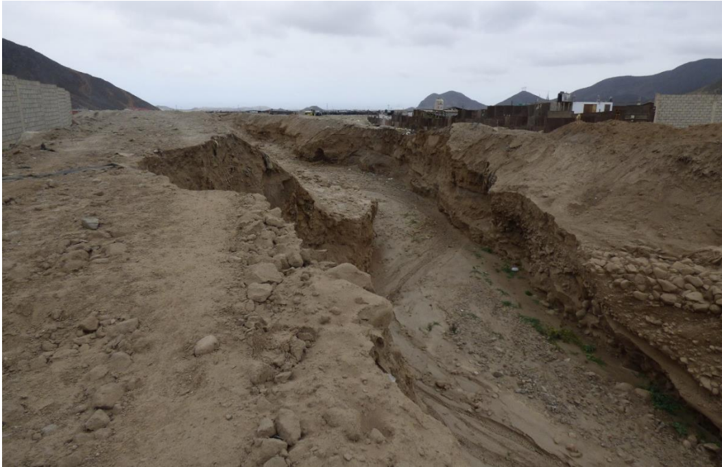
Fotografía 201. Zona crítica 15-070. Vista aguas abajo, viviendas y corrales del sector Santa Rosa de olleros se encuentra muy cerca del cauce de la quebrada Malanche, en el flujo de detritos. Coordenadas UTM 18S E308664; N8640228 (Tomada el 04/09/2023).
