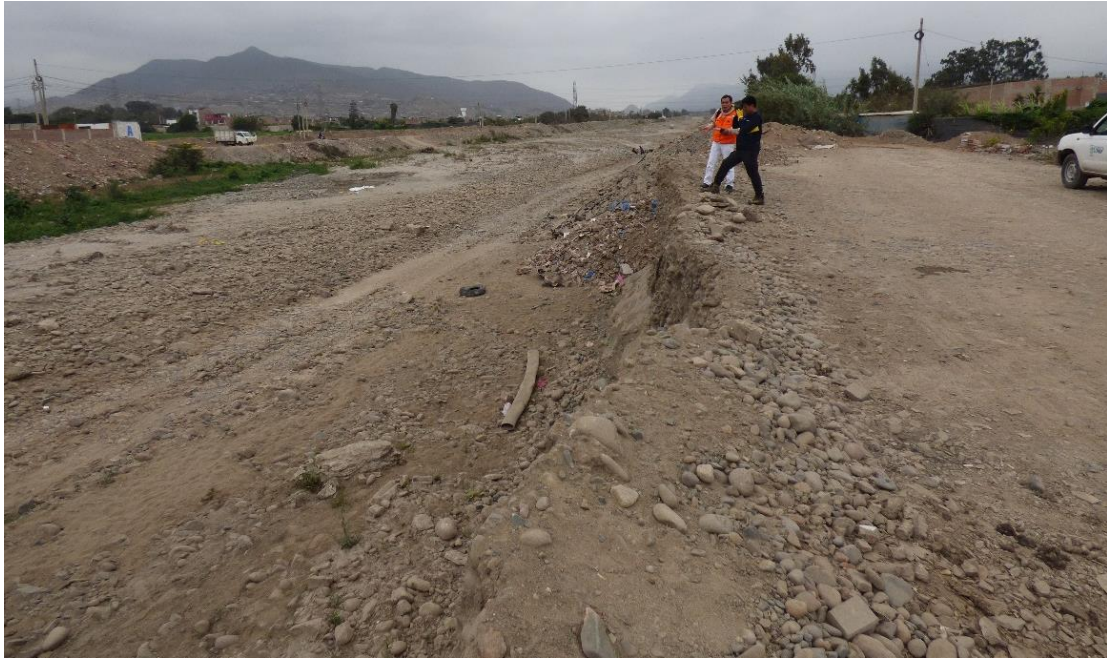
Fotografía 183. Zona crítica 15-060. Erosión fluvial en la margen izquierda del río Lurín, sector Ribera del Río Lurín, afecta vías de acceso, viviendas y terrenos de cultivo. Coordenadas UTM 18S E294186; N8645510 (tomada el 05/09/2023).
