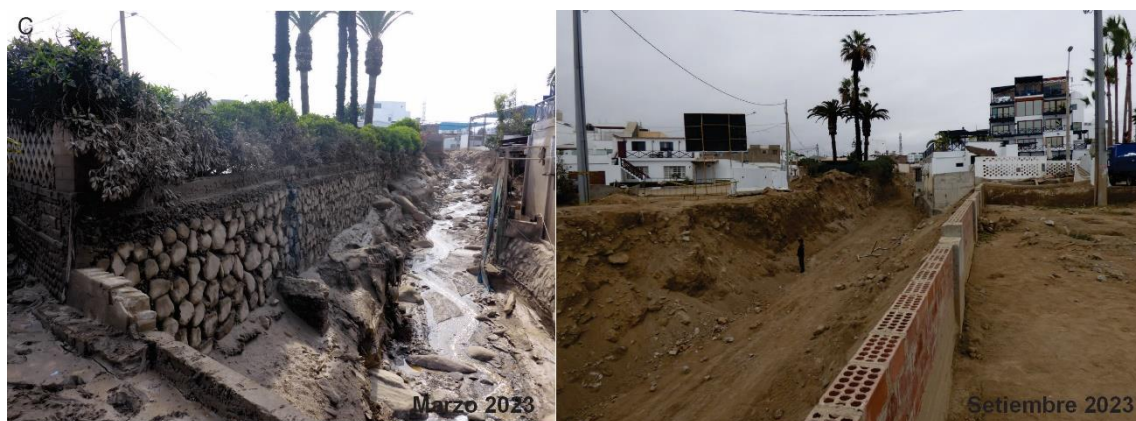
Figura 16. Zona crítica 15-066. Comparación de vistas del 17/03/2023 y 04/09/2023, se observa que se retiró el puente peatonal que une las calles Talara y Goleta del Balneario Punta Hermosa. Coordenadas UTM 18S E301340; N8635527.
