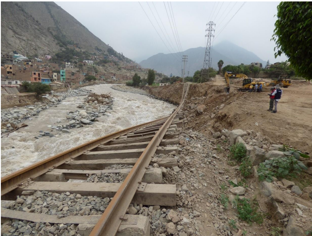
Fotografía 159. Zona crítica 15-048. Erosión fluvial que afectó vía férrea en un tramo de 80 m, sector Cooperativa Pablo Patrón. Coordenadas UTM 18S E316629; N8681042 (Fuente: Ochoa et al., 2017).
