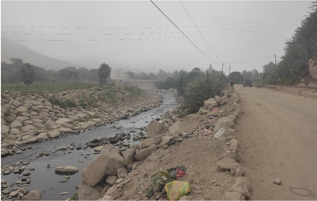
Fotografía 178. Zona crítica 15-056. Erosión fluvial en ambas márgenes del río Rímac, en el Sector California Baja. Coordenadas UTM 18S E311968; N8677951 (tomada el 20/09/2023).
