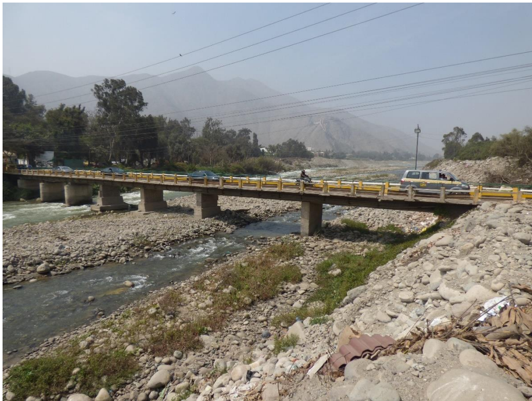
Fotografía 75. Zona crítica 15-016. Columnas del puente Morón debilitadas y cauce colmatado del río Rímac, se arroja desmonte sobre la ribera del río. Coordenadas UTM 18S E305642; N8675278 (tomada el 11/09/2023).
