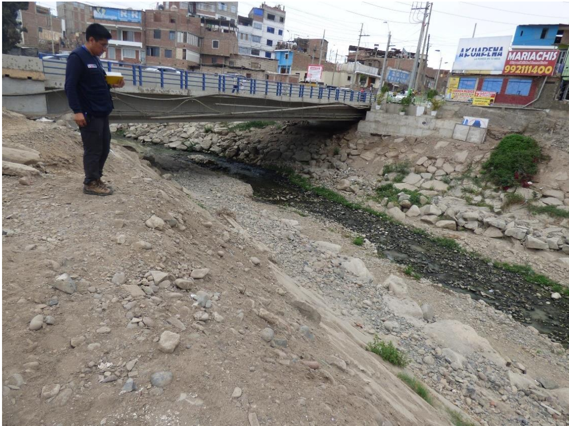
Fotografía 189. Zona crítica 15-063. Estribos debilitados del puente Lurín, el cauce se encuentra colmatado. Coordenadas UTM 18S E293927; N8644790 (tomada el 05/09/2023).
