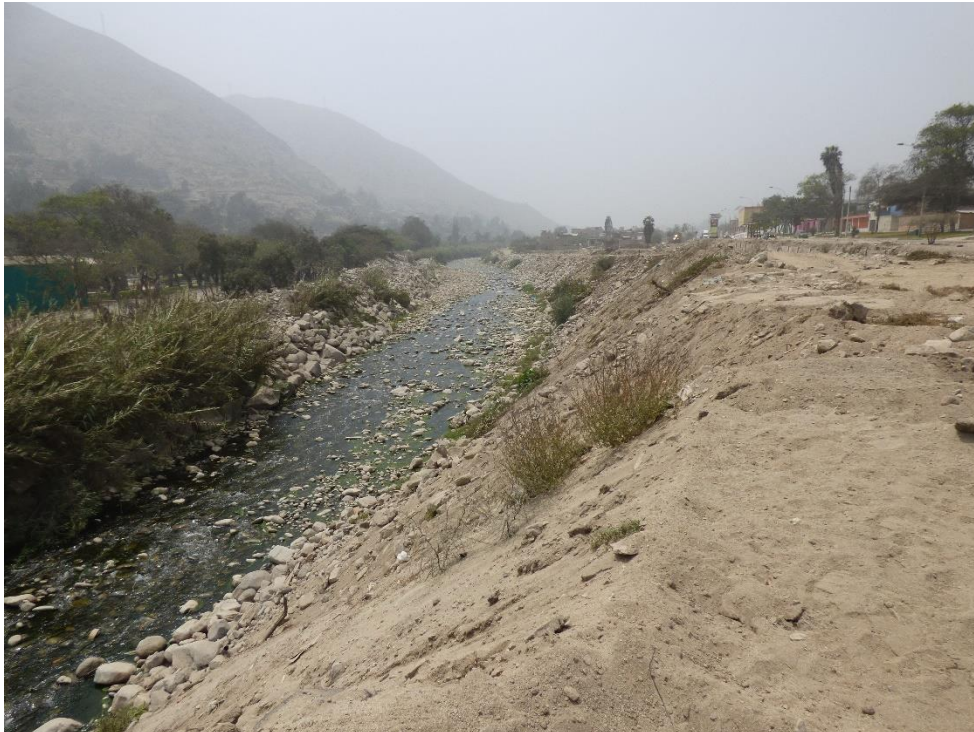
Fotografía 57. Zona crítica 15-010. Erosión fluvial en margen izquierda del río Rímac, se viviendas de la Villa Mercedes que pueden ser afectadas, se ha colocado depósitos de relleno que estrecha el cauce que ya se encuentra colmatado. Coordenadas UTM 18S E307176; N8675651 (Tomada el 11/09/2023).
