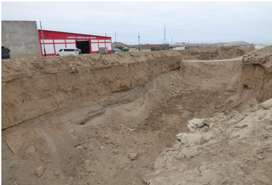
Fotografía 198. Zona crítica 15-069. Vista de la quebrada Malanche, presenta erosión debido a la socavación del flujo de detritos del 14/03/2023, aguas abajo se observa vía que obstruye el cauce. Coordenadas UTM 18S E305142; N8638712 (Tomada el 04/09/2023).
