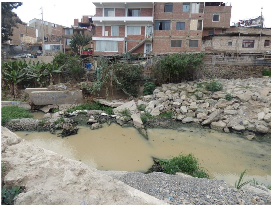
Fotografía 188. Zona crítica 15-063. Aguas debajo del puente Lurín presenta erosión fluvial en la margen derecha del río. Coordenadas UTM 18S E293881; N8644747 (tomada el 05/09/2023).
