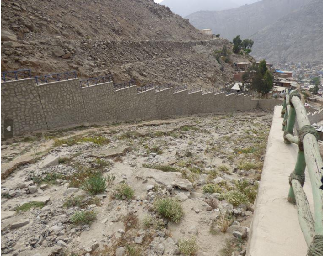
Fotografía 164. Zona crítica 15-050. Cauce de la quebrada Mariscal Castilla se encuentra colmatado. Coordenadas UTM 18S E316482; N8679979 (tomada el 05/10/2023).
