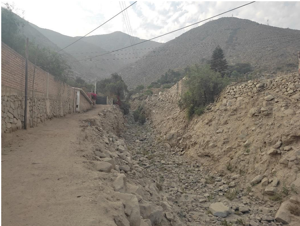
Fotografía 149. Zona crítica 15-046. Cauce colmatado de la quebrada Corrales, viviendas se encuentran cerca del cauce no cuenta con defensa ribereña. Coordenadas UTM 18S E316952; N8681426 (tomada el 20/09/2023).
