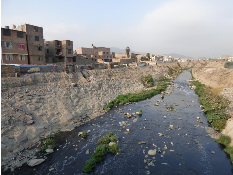
Fotografía 220. Zona crítica 15-079. Erosión fluvial en la margen derecha del río Rímac, se observa viviendas de la Alameda Rímac (Jr. Tacna) que se encuentra muy cerca del borde del arriba del río. Coordenadas. UTM 18S E273586; N8668664. (Tomada el 20/03/2023).
