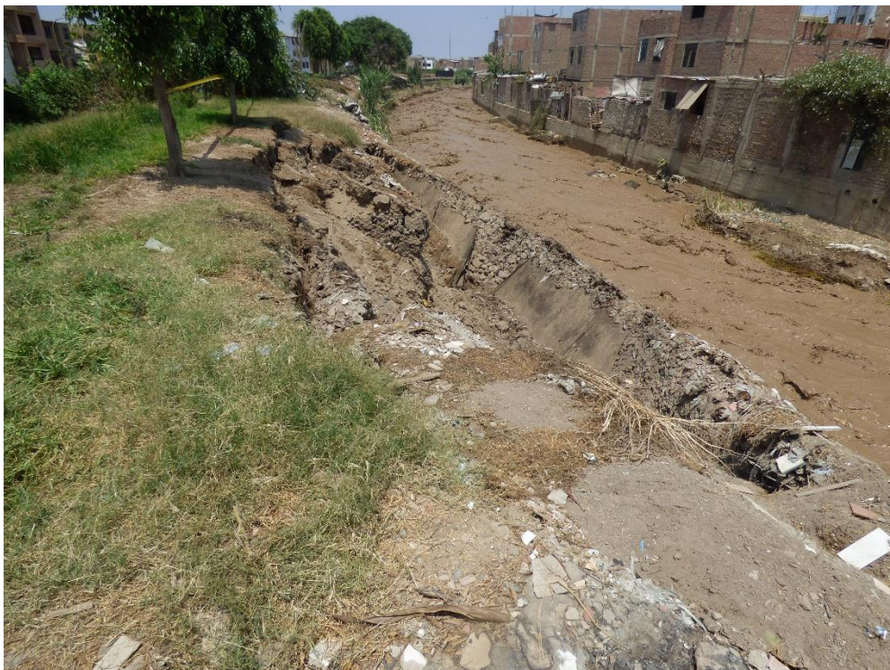
Fotografía 219. Zona crítica 15-078. Derrumbe en la ribera izquierda del río Chillón por socavación de las avenidas, aguas abajo del Puente Milton, en la margen derecha se observa viviendas del A.H. Fortaleza de Kuelap. Coordenadas UTM 18S E273774; N8680569. (Tomada el 20/03/2023).
