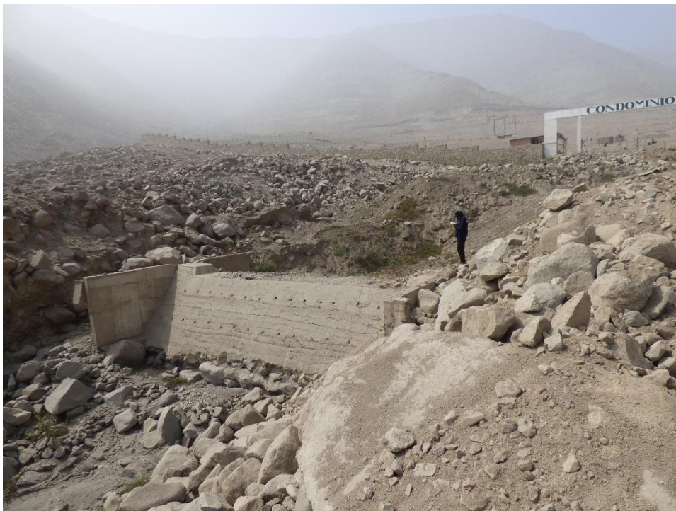
Fotografía 69. Zona crítica 15-014. Dique quedó debilitado con las bases y extremos socavados por el flujo de detritos en el ingreso al Condominio La Planicie. Coordenadas UTM 18S E306229; N8673658 (tomada el 12/09/2023).
