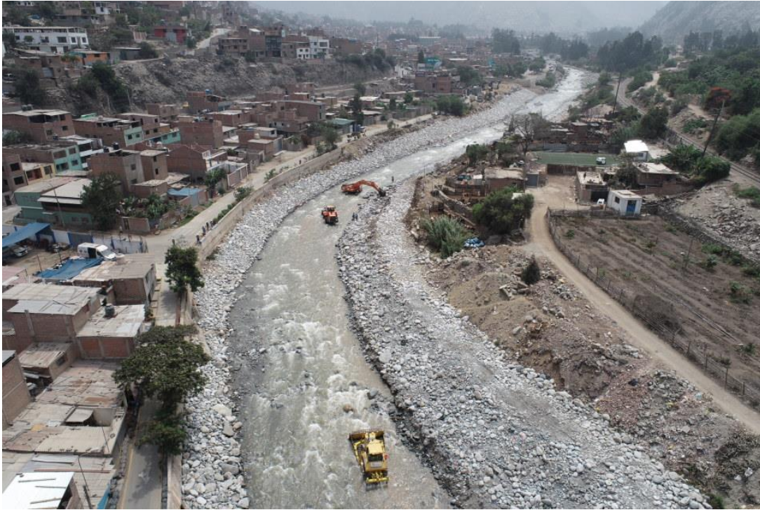
Fotografía 158. Zona crítica 15-048. Se viene realizando limpieza de cauce y el material se arrima en las márgenes a manera de plataformas, en el sector Cooperativa Pablo Patrón. Coordenadas UTM 18S E316629; N8681042 (tomada el 06/10/2023).
