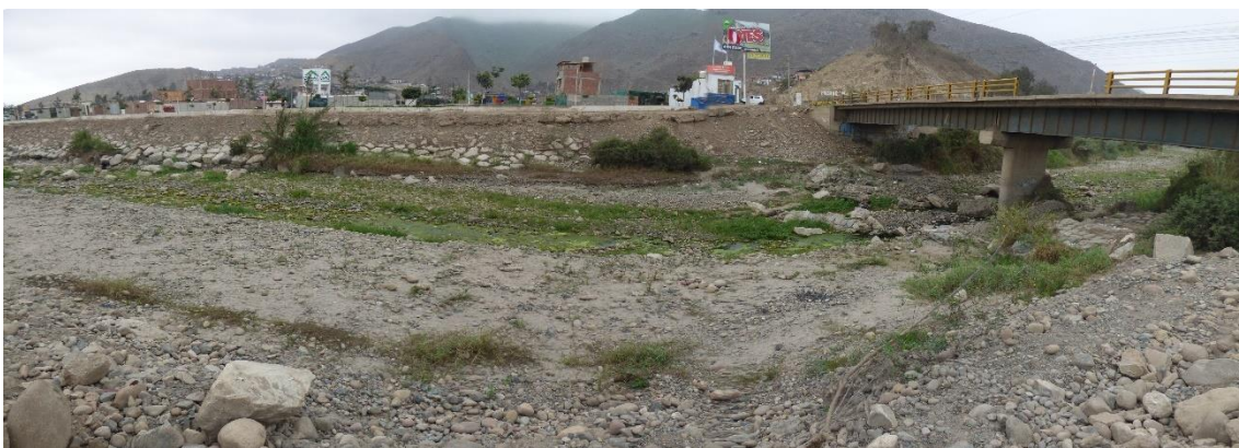
Fotografía 191. Zona crítica 15-065. Erosión fluvial en margen derecha del río Lurín, estribos del puente debilitado, en la margen derecha el enrocado se encuentra destruido por tramos. Coordenadas UTM 18S E296497; N8649309 (tomada el 05/09/2023).
