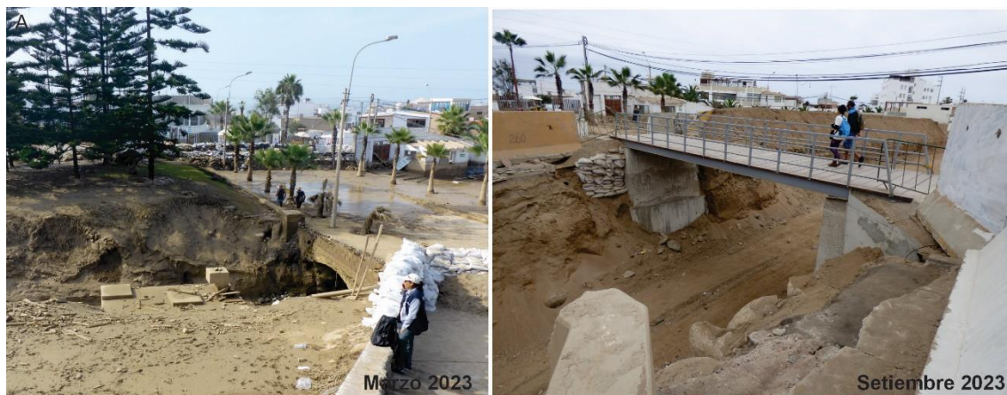
Figura 15. Zona crítica 15-066. Comparación de vistas del 17/03/2023 y 04/09/2023, se observa que se amplió y elevó el puente peatonal de la Av. García Rada del Balneario Punta Hermosa. Coordenadas UTM 18S E301540; N8635545.
