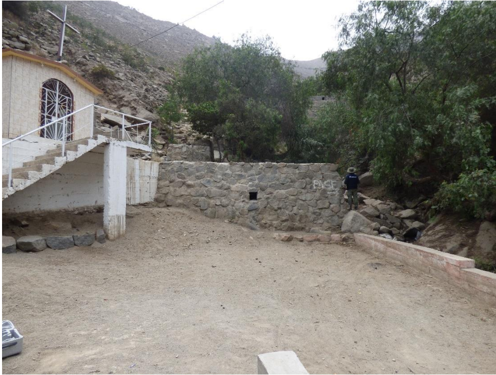
Fotografía 143. Zona crítica 15-043. Colapso de una parte del dique disipador en la quebrada La Libertad. Coordenadas UTM 18S E315366; N8680644 (tomada el 05/10/2023).
