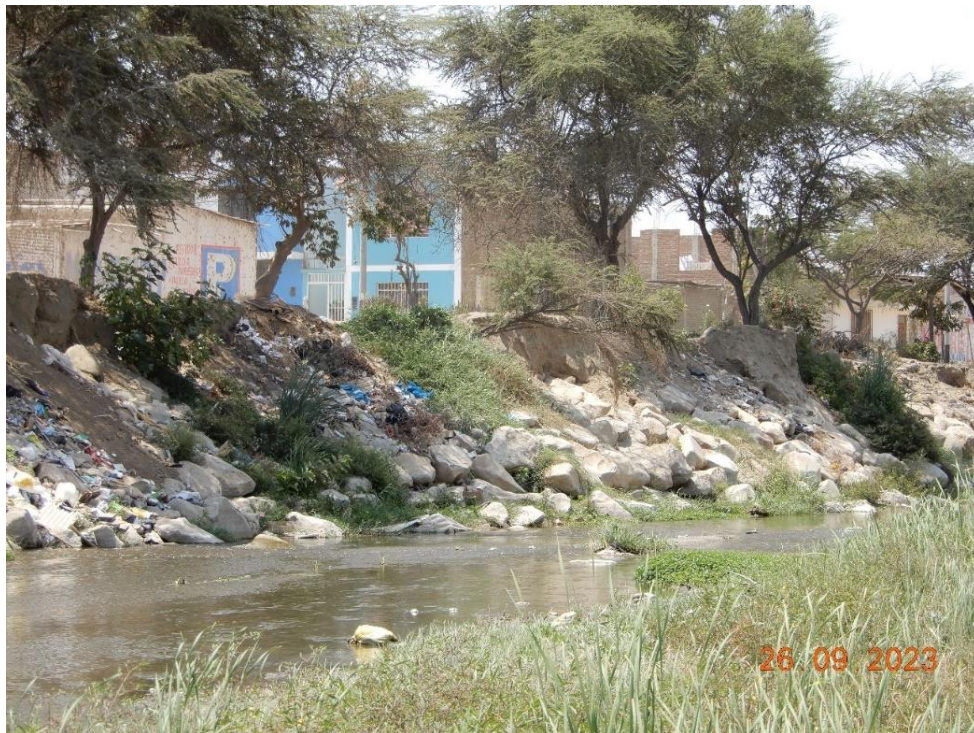
Fotografía 80. Zona crítica 13-043. Defensa ribereña en el río Loco de Chamán en el sector del área urbana del distrito de Pueblo Nuevo. Coordenadas UTM: 664182 / 9204961, Zona 17. Tomado el 26-09-2023.
