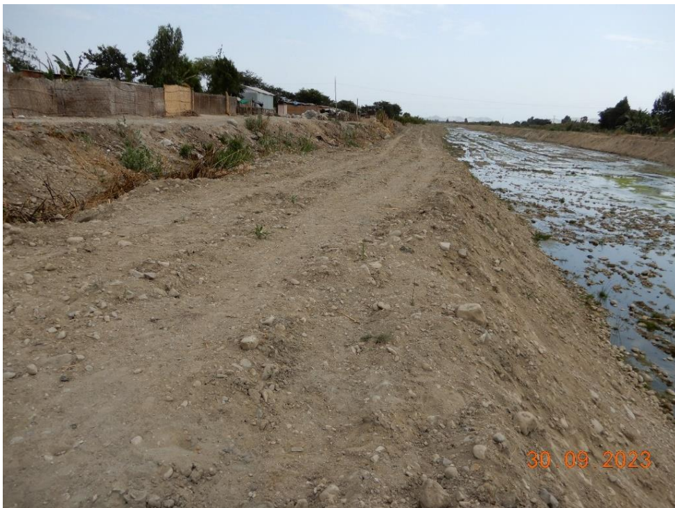
Fotografía 132. Zona crítica 13-077. Viviendas del sector El Inca ubicadas en la margen izquierda del río Cerroblanco que pueden ser afectadas por erosión fluvial (distrito de Chao)
