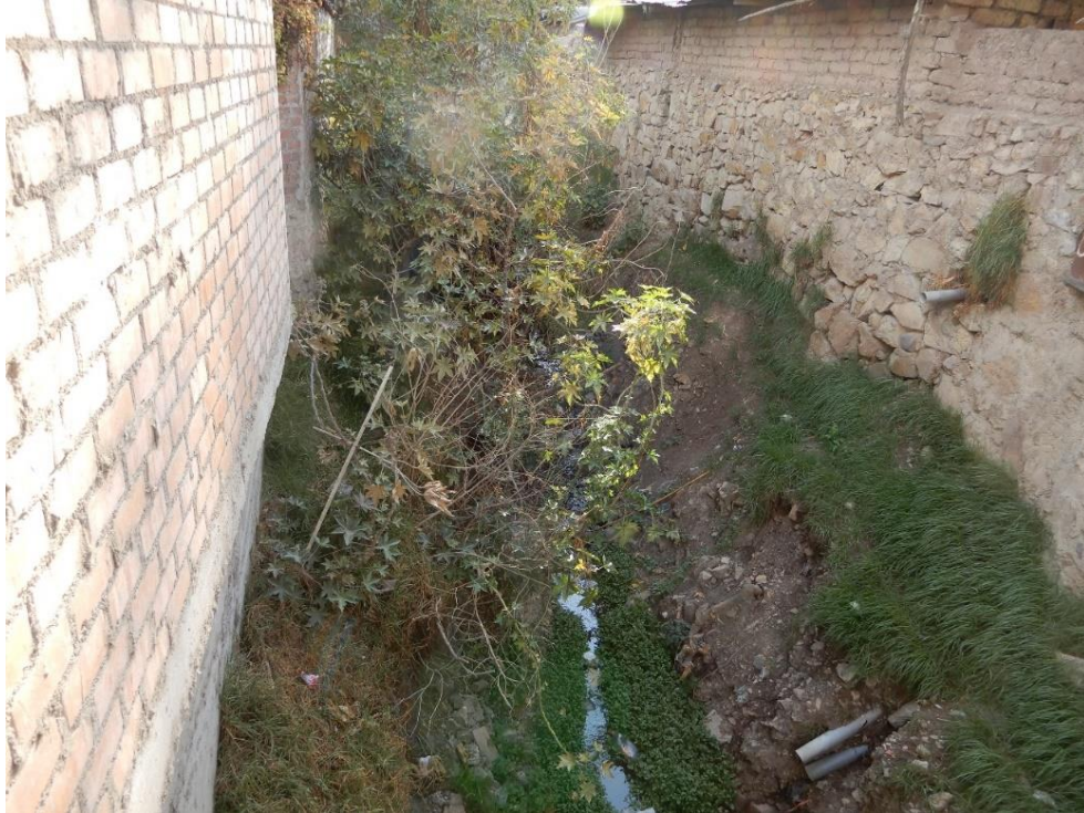
Fotografía 86. Zona crítica 13-046. Cauce de quebrada La Retama obstruida por la construcción de viviendas (distrito de Otuzco) Coordenadas UTM: 768502 / 9124697, Zona 17. Tomado el 19-09-2023.
