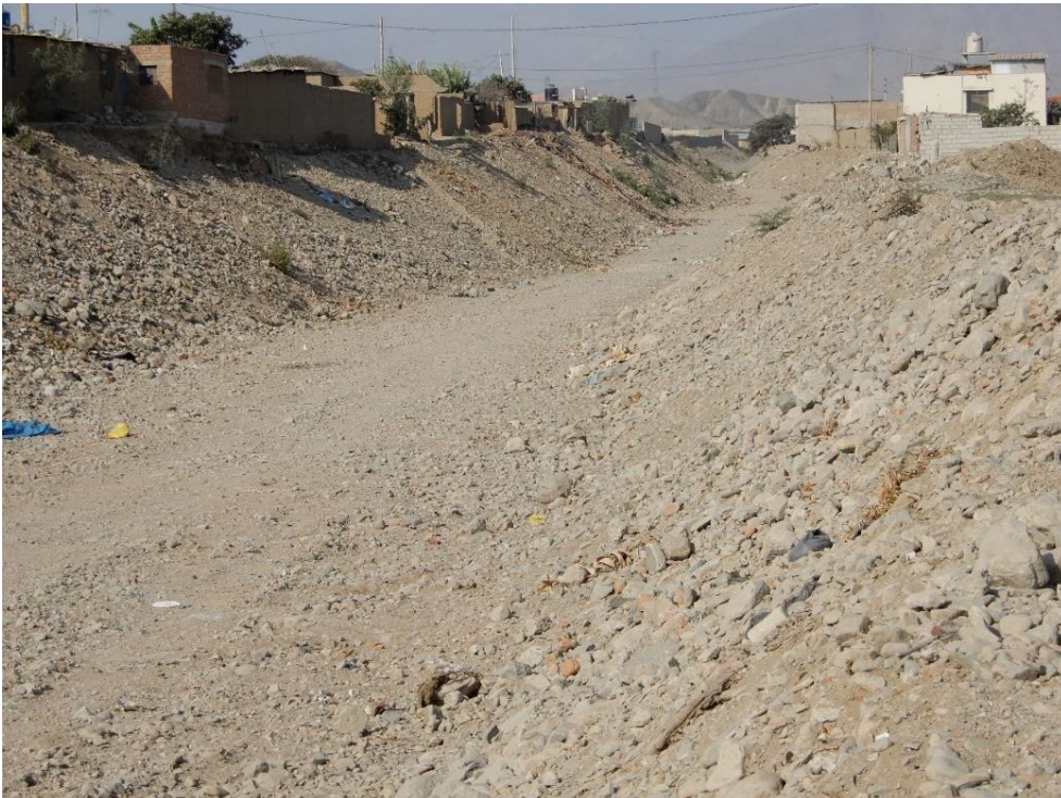
Fotografía 10. Zona crítica 13-004. Vista de canal sin revestimiento en el sector del A. H. Virgen del Socorro, distrito de Huanchaco. Coordenadas UTM: 713545 / 9110690, Zona 17. Tomado el 12-09-2023.
