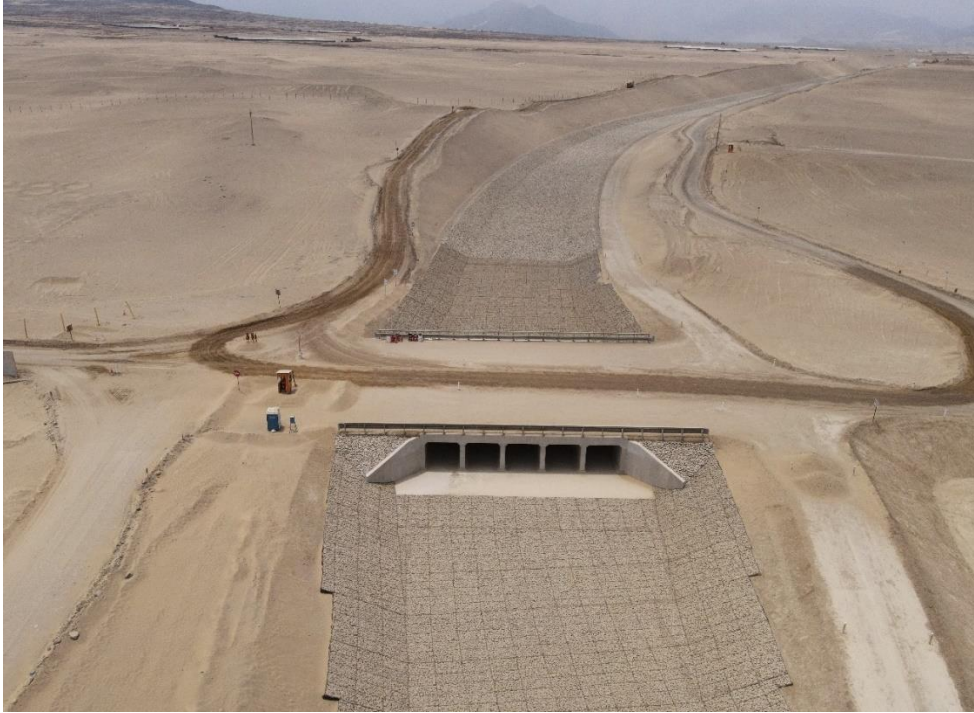
Fotografía 13. Zona crítica 13-005. Canal del proyecto Quebrada Del León construido sobre mantos eólicos en el distrito de Huanchaco. Además, se observa la construcción de alcantarilla para el pase de vehículos motorizados. Coordenadas UTM: 716423 / 9114475, Zona 17. Tomado el 13-09-2023.
