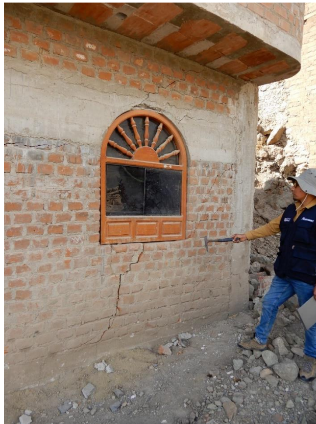
Fotografía 89. Zona crítica 13-047. Viviendas fisuradas en el Barrio Ramón Castilla parte alta a causa del deslizamiento rotacional (distrito de Otuzco). Coordenadas UTM: 769085 / 9125941, Zona 17. Tomado el 19-09-2023.
