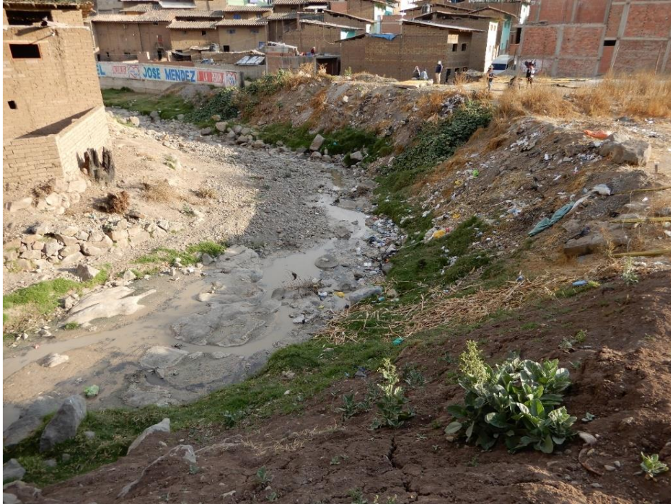
Fotografía 84. Zona crítica 13-046. Viviendas asentadas en el borde del cauce del río Huangamarca (distrito de Otuzco) Coordenadas UTM: 768502 / 9124697, Zona 17. Tomado el 19-09-2023.
