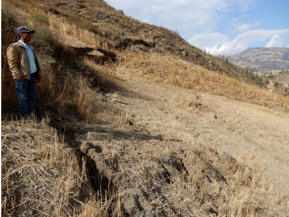
Fotografía 88. Zona crítica 13-047. Escarpa principal del deslizamiento rotacional ubicado en el Barrio Ramón Castilla parte alta (distrito de Otuzco). Coordenadas UTM: 769085 / 9125941, Zona 17. Tomado el 19-09-2023.
