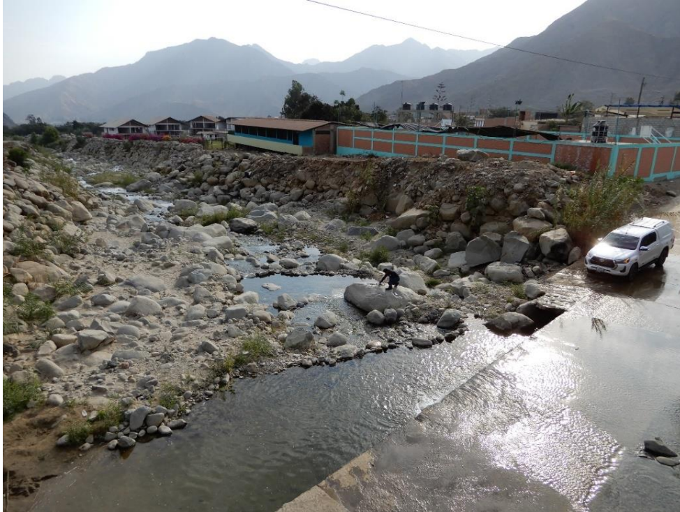
Fotografía 39. Zona crítica 13-019. Defensa ribereña de la margen derecha del río La Cuesta en el Caserío Pedregal (distrito de Simbal). Coordenadas UTM: 739865 / 9114280, Zona 17. Tomado el 15-09-2023.
