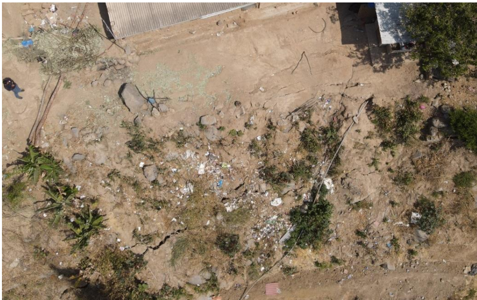
Fotografía 97. Zona crítica 13-053. Presencia de agrietamiento en el cuerpo del deslizamiento rotacional en el sector de Plaza Pampa (distrito de Salpo)
