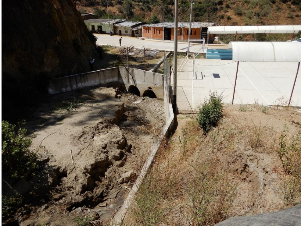
Fotografía 92. Zona crítica 13-050. Cauce de quebrada colmatado en la entrada a la población de La Cuesta (distrito de La Cuesta). Coordenadas UTM: 753092 / 9124019, Zona 17. Tomado el 15-09-2023.
