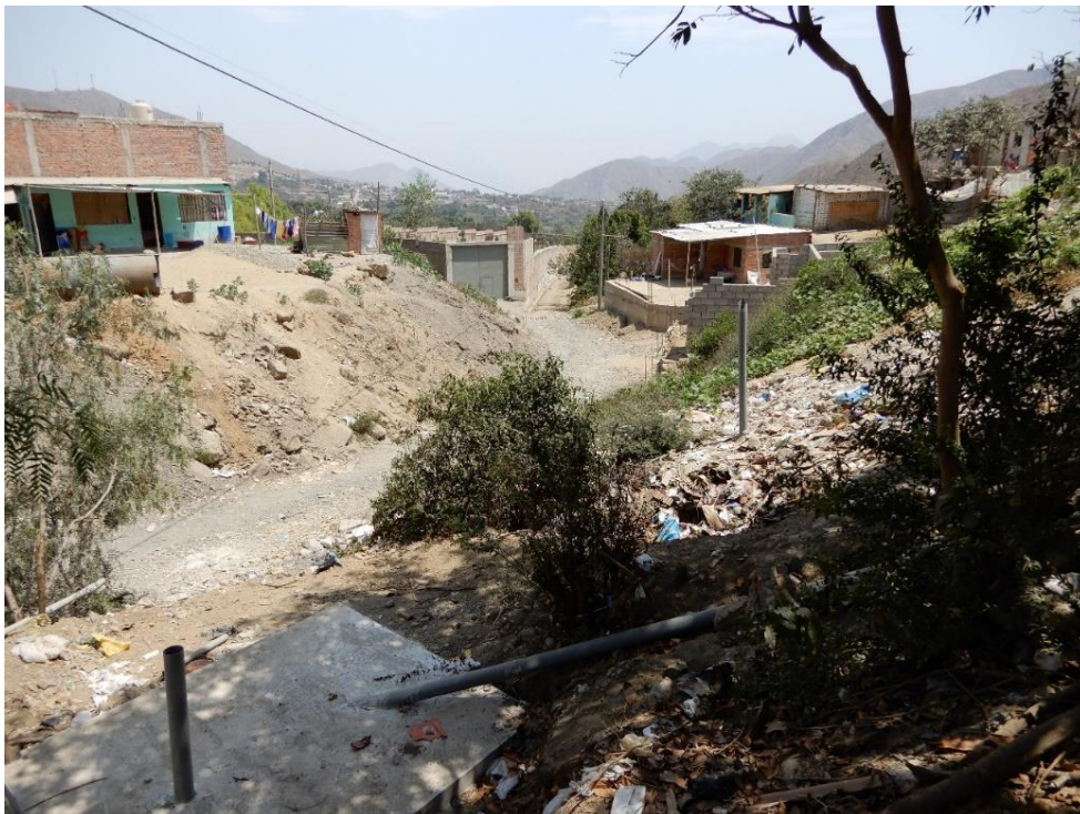
Fotografía 32. Zona crítica 13-015. Vista de una de las torrenteras que cruza por medio del área urbanizada del centro poblado de Cajamarca (distrito de Simbal). Coordenadas UTM: 741476 / 9119057, Zona 17. Tomado el 15-09-2023.
