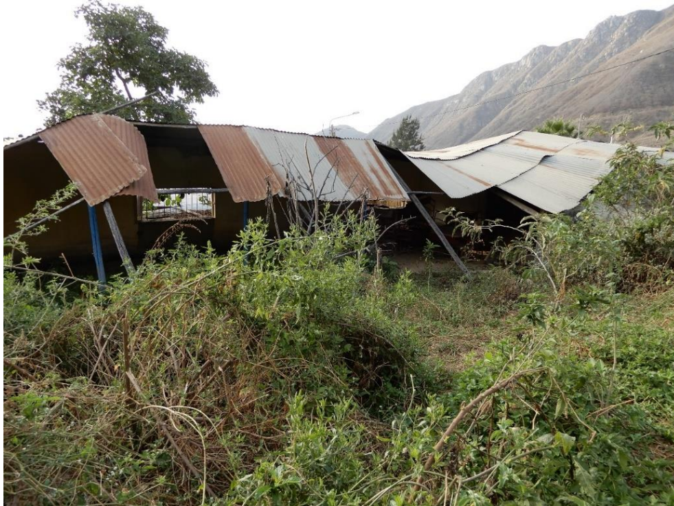
Fotografía 27. Zona crítica 13-013. Iglesia destruida por el flujo de detritos en el Caserío Huayabito (distrito Poroto). Coordenadas UTM: 749341 / 9108017, Zona 17. Tomado el 14-09-2023.
