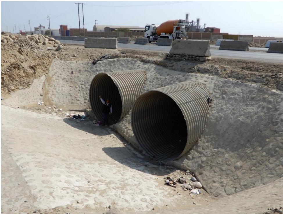
Fotografía 8. Zona crítica 13-003. Alcantarillas circulares instaladas para pase de flujo de agua en la carretera Panamericana Norte, sector A. H. Virgen del Socorro, distrito de Huanchaco. Coordenadas UTM: 711040 / 9110183, Zona 17. Tomado el 13-09-2023.
