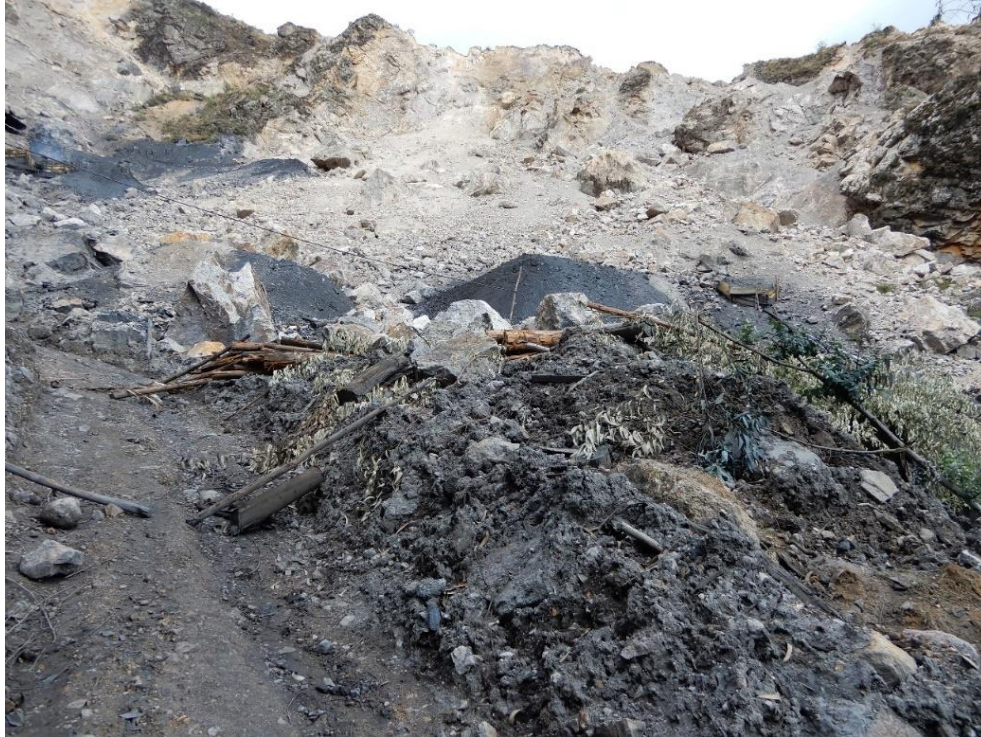
Fotografía 110. Zona crítica 13-060. Material suelto acumulado en la cabecera de la quebrada que puede alimentar a la quebrada con material suelto, que en tiempos de lluvia podría originar flujos de detritos y afectar las viviendas del caserío Llaray (distrito de Quiruvilca).
