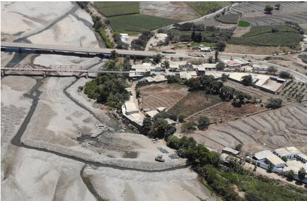
Fotografía 115. Zona crítica 13-064. Viviendas del caserío Punta Moreno ubicada en la margen derecha del río Chicama que pueden ser afectadas por erosión fluvial. (distrito de Cascas). Coordenadas UTM: 732944 / 9159920, Zona 17. Tomado el 22-09-2023.
