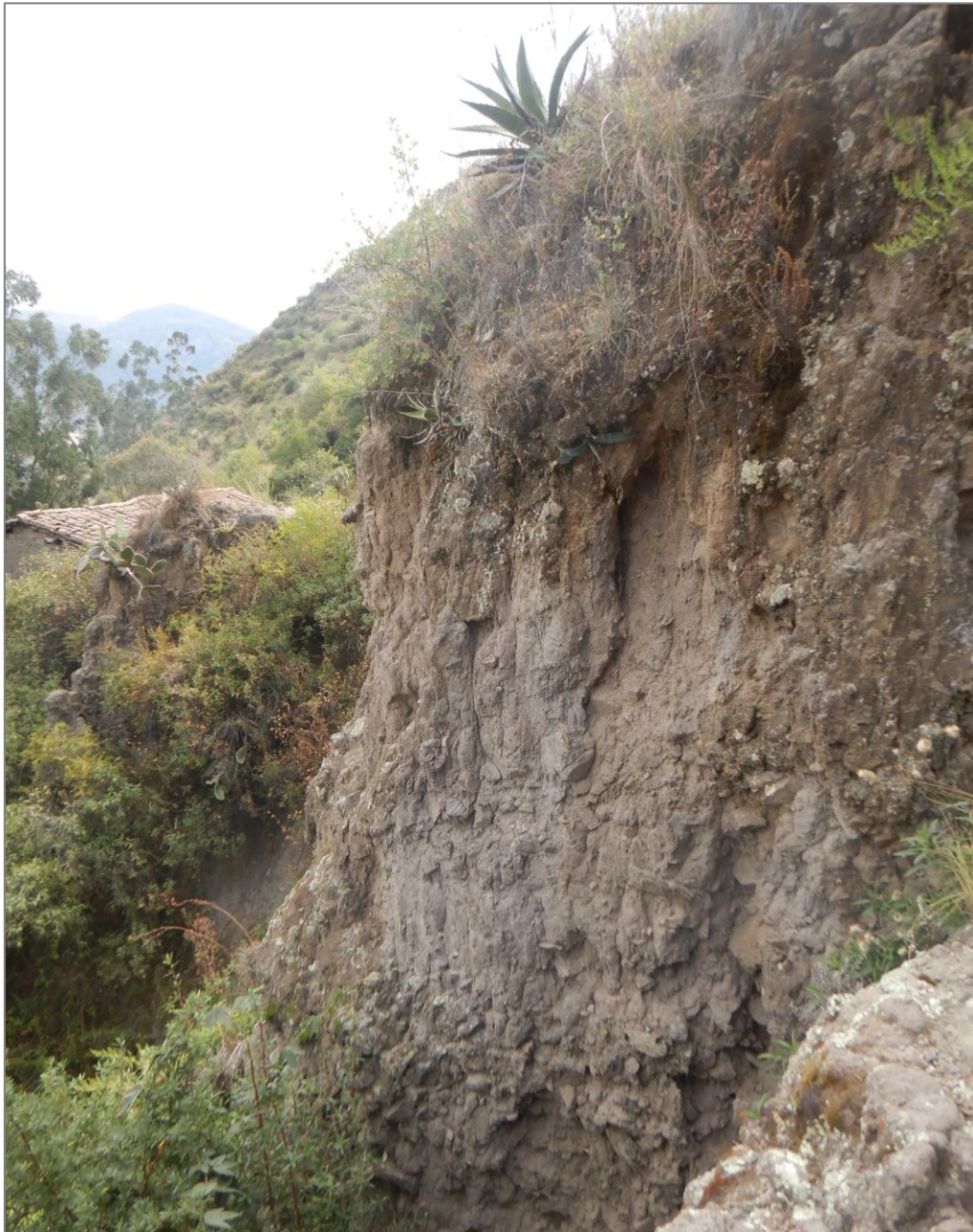
Fotografía 1. Depósito coluvio- deluvial, compuesto por bloques de formas angulosas a subangulosos con diámetros de hasta 60 cm, envueltos en una matriz de areno – limoso color gris oscuro, con poco contenido de arcilla.
