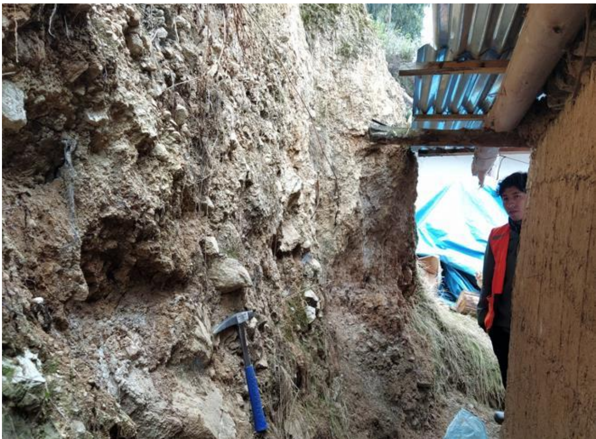
Fotografía 10. Corte de ladera muestra material detrítico en la ladera por debajo de la zona deslizamiento - vivienda 2.
