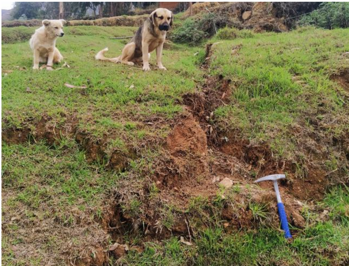
Fotografía 8. Agrietamientos en la parte más distante a la escarpa principal de deslizamiento.
