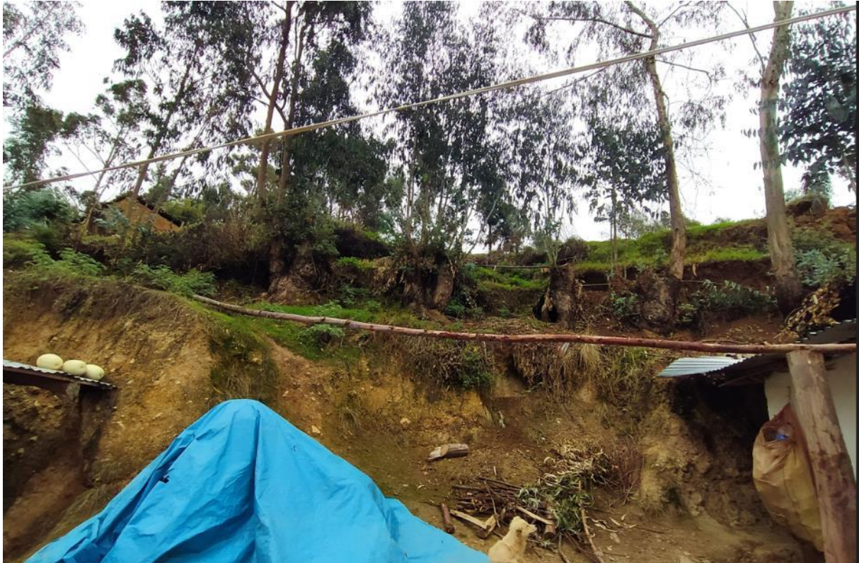
Fotografía 9. Se observa el material detrítico de deslizamiento sobre el corte de talud de la vivienda 2.
