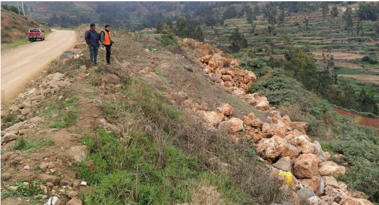
Fotografía 13. Muestra el área evaluada propuesta por la Municipalidad de Tapo, con pendiente pronunciada y bloques de relleno.
