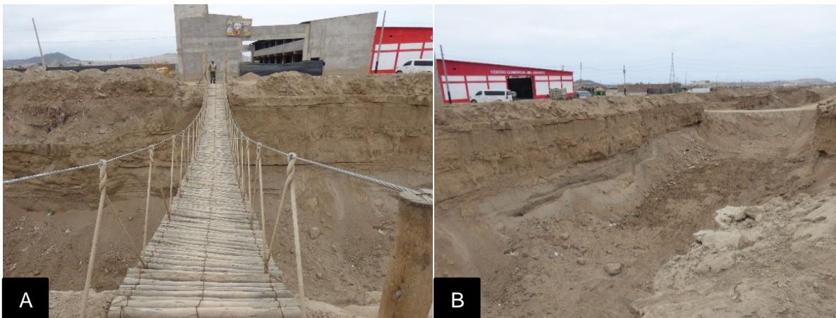
Fotografía 4. A. Puente colgante de 18 m de longitud y una altura 6 m de afectado durante el paso del flujo de lodo en marzo del 2023, a 10 m agua arriba se produjo un desborde que discurrió por la vía de acceso. B. Aguas abajo del puente, se observa el cauce en proceso de limpieza y una vía alterna que cruza el cauce, obstruyendo la quebrada.
