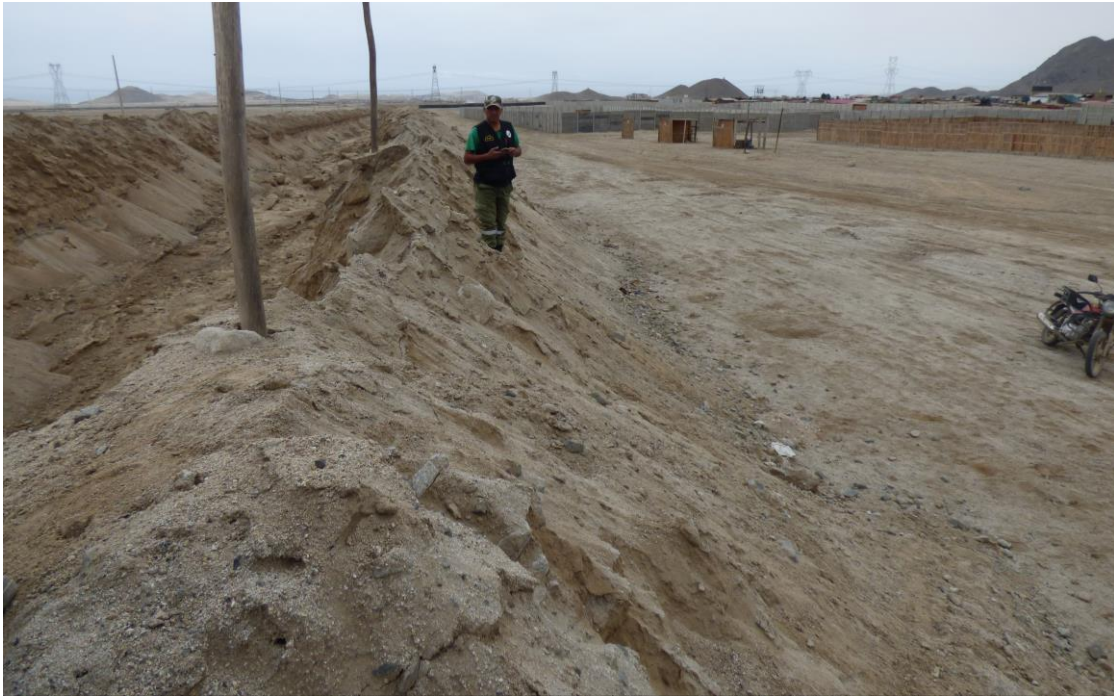
Fotografía 8. El flujo del marzo del 2023 discurrió por el brazo de la quebrada (izquierda), sin embargo, el estado colmatado y disminución de la altura provocaron un desborde en este punto, las aguas solo afectaron levemente viviendas aledañas.
