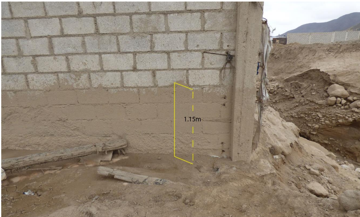
Figura 15. Muro de la granja avícola Malanche, construido en plano cauce, el flujo de marzo del 2023 se obstruyó temporalmente a causa de este muro, provocando desborde en el área y recuperación de su curso con mayor fuerza. Sector Santa Rosa.
