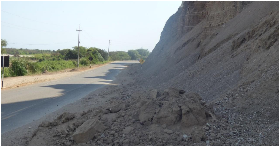
Fotografía 34. Derrumbes en el sector Cerros Hinchados en Vichayal (ZC 20-023); se observan bloques caídos al pie de la vía principal.
