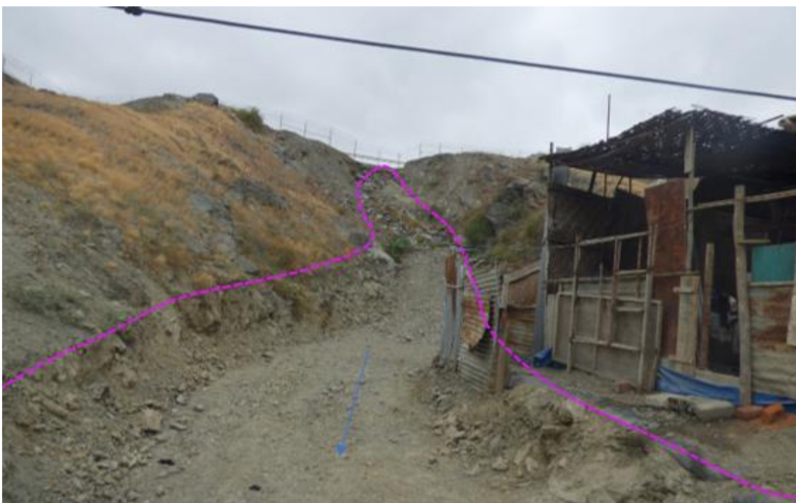
Figura 109. Zona crítica 20-050 Sector sujeto a flujo de detritos y derrumbes por el fracturamiento y meteorización de las filitas. Las viviendas se encuentran sobre depósitos proluviales cercanos a los márgenes. En algunos casos se observan viviendas dentro del cauce de los flujos.
