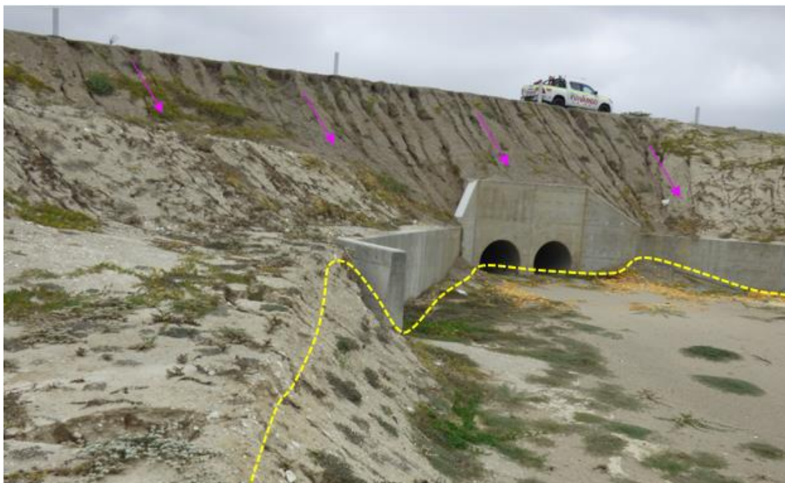
Figura 112. Zona crítica 20-053 - Km 38 + 200 (9346681;516888). Alcantarilla por donde discurre flujos de lodo. Presenta erosión de ladera sobre muro de alcantarilla y márgenes de quebrada. La quebrada presenta un ancho de 40 m. y se estrecha en las alcantarillas.
