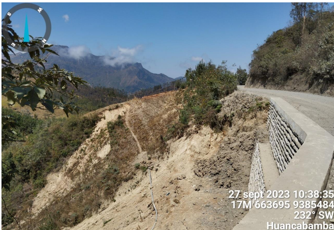
Figura 234. Zona crítica 20-172 Se identificaron deslizamiento, erosión de laderas y pequeños flujos en laderas con pendientes moderadas en las inmediaciones del área evaluada.
