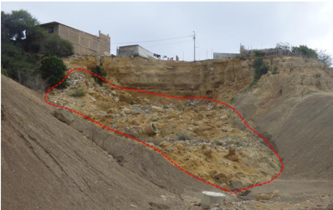
Figura 98. Zona crítica 20-039. AA.HH. Nueva Esperanza, en el sector estas condiciones favorecen a la ocurrencia de derrumbes y deslizamientos de las laderas, además de flujos por erosión de ladera. También se presenta depósitos coluvio-deluviales y proluviales. (N: 9437268, E: 488056, 29/08/2023).
