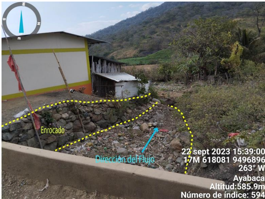
Figura 158. Zona crítica 20-096. Área urbana del anexo Sarayuyo se ubica en la margen izquierda del río Suyo, esta terraza se afectada por flujos que provienen de tres quebradas que descienden de sur a norte. (N: 9496896 E: 618081 22/09/23).
