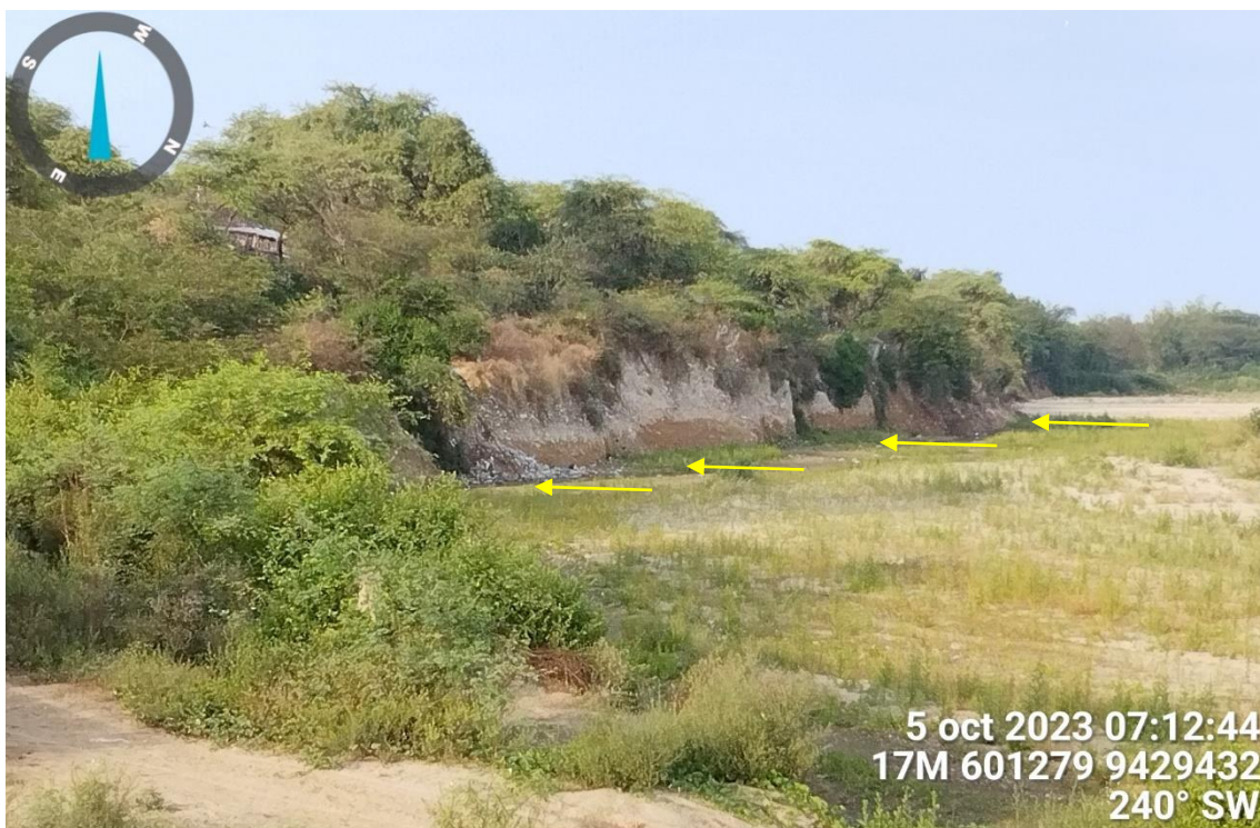
Figura 194. Zona crítica 20-132 Existen procesos de erosión fluvial en la margen izquierda de la quebrada La Bocana, sobre esta terraza se ubica el área urbana del centro poblado del mismo nombre. (N: 942932, E: 601279, 05/10/23).
