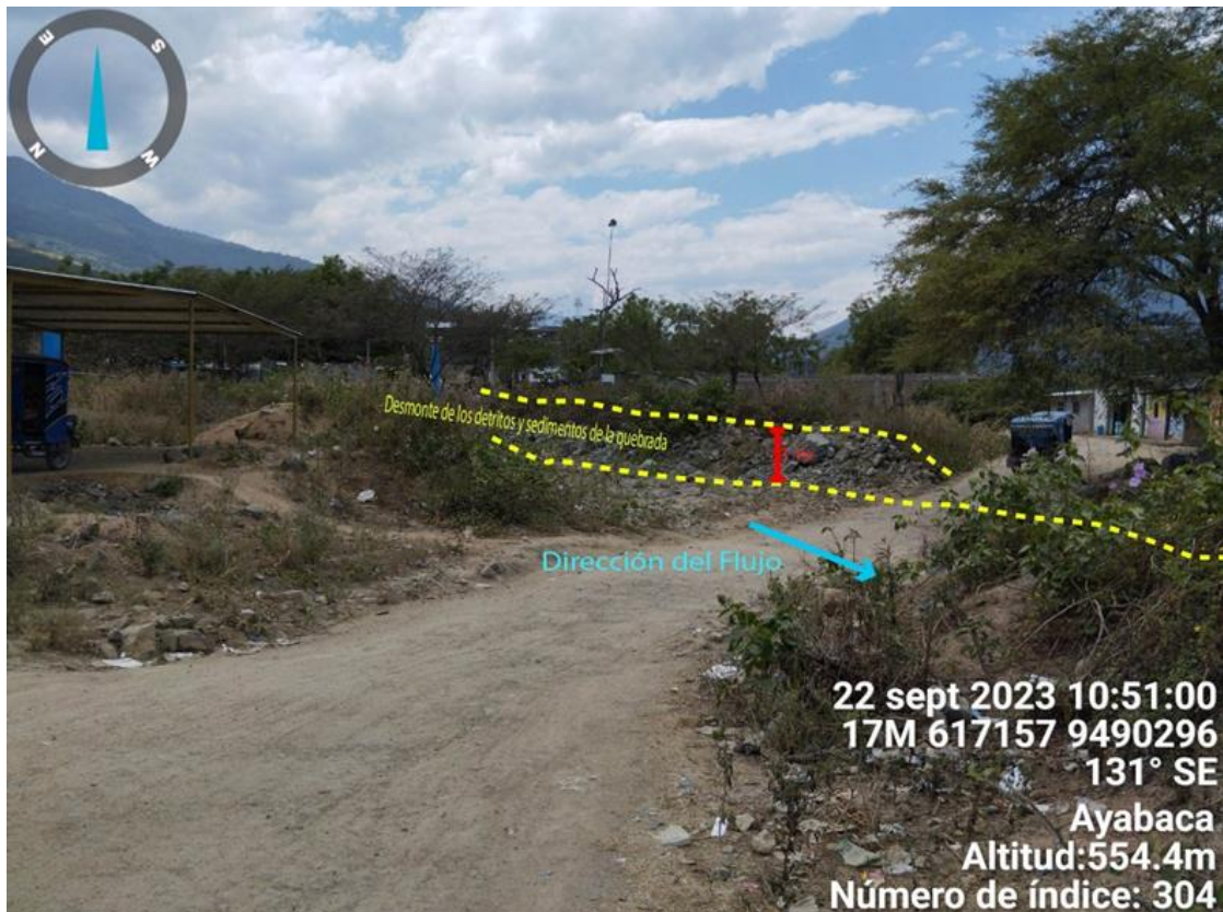
Figura 166. Zona crítica 20-104. Flujos de detritos que descienden por la quebrada Jambur, afectando viviendas, vías de acceso y terrenos de cultivo ubicados aguas abajo del área urbana. (N: 9490296, E: 617157, 22/09/23).
