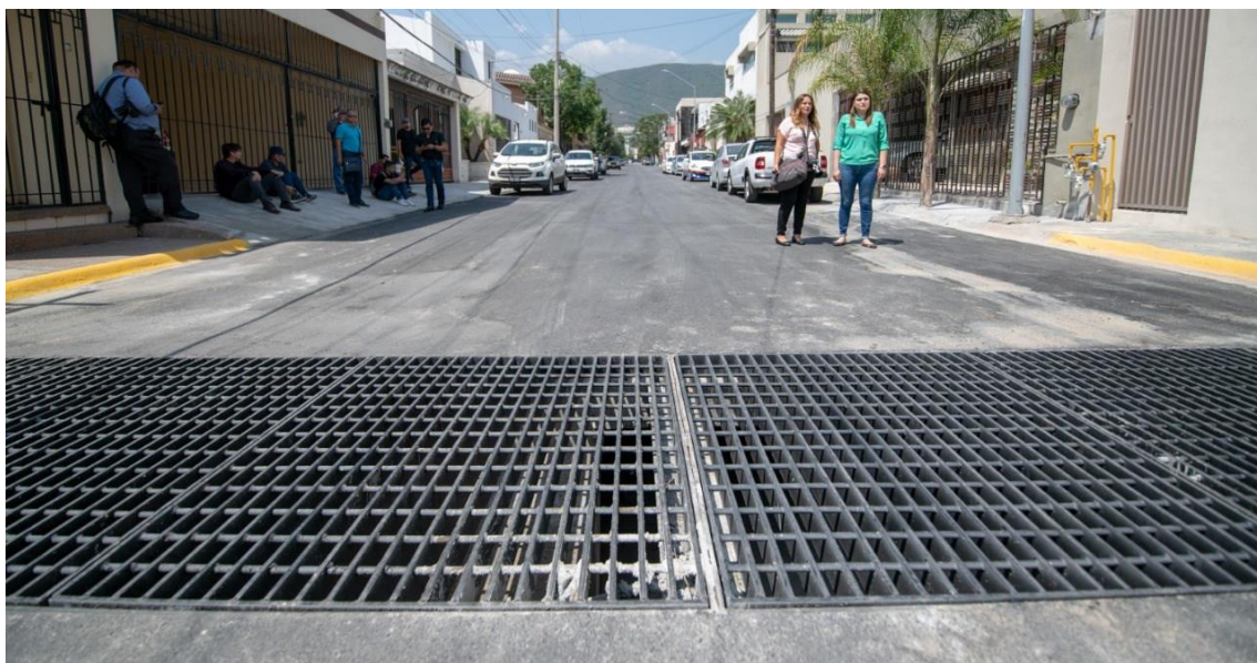
Fotografía 40. Sistema de drenaje pluvial por medio de alcantarillas en un sector urbano.
