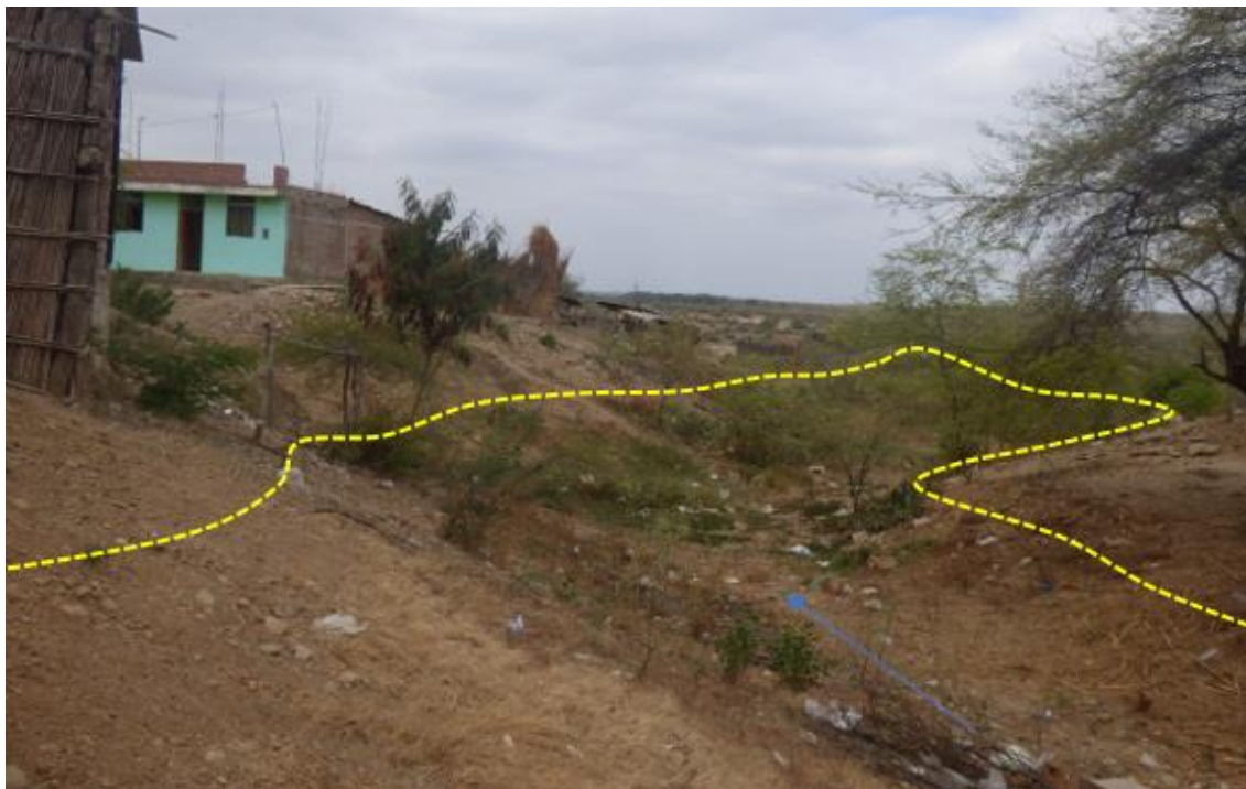
Figura 125. Zona crítica 20-064. En el centro poblado Sojo, la quebrada La Lora sujeta a procesos de erosión en cárcavas, que originan quebradas, su cauce llega a medir un ancho de hasta 40 m.
