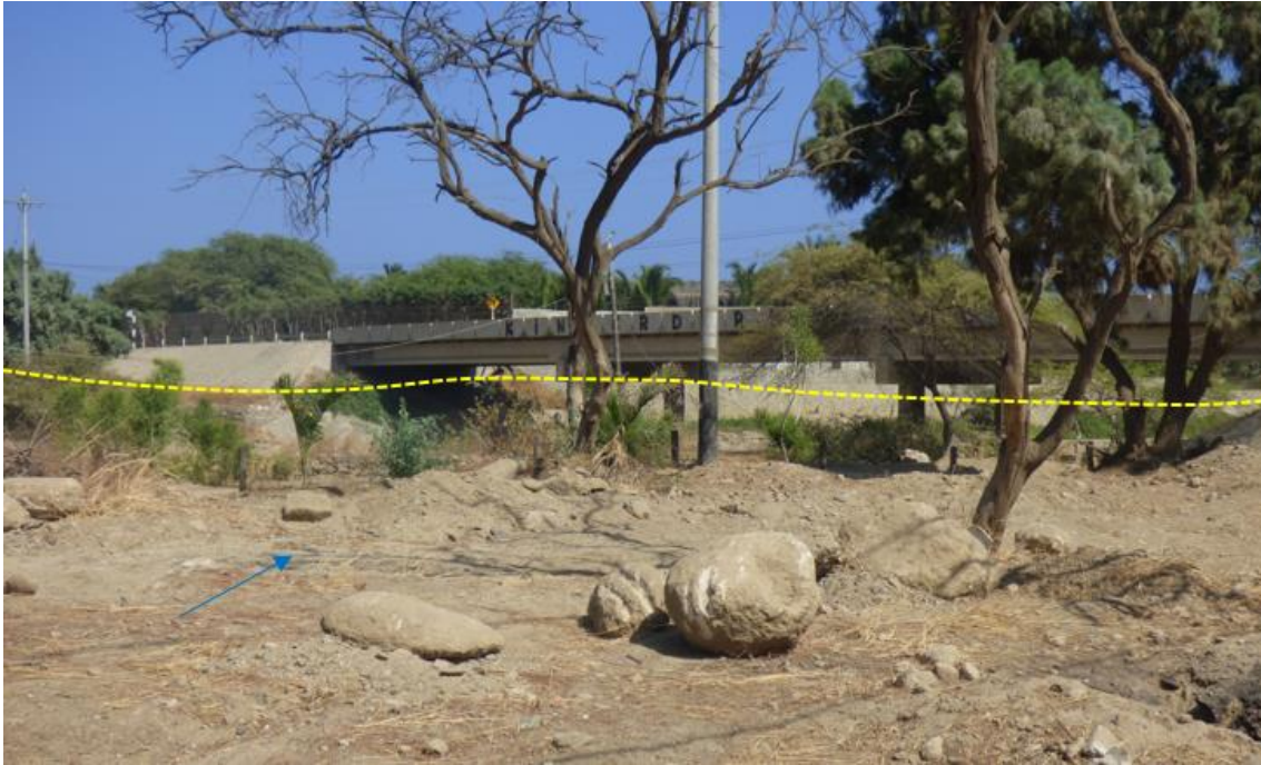
Figura 62. Zona crítica 20-003. Sector afectado por flujo de detritos, la quebrada Cabo Blanco de cauce muy amplio, en su lecho presenta material suelto con arenas, gravas, cantos y bloques de hasta 1 m de diámetro de diferente composición. (N: 9545986, E: 493380, 29/08/2023).
