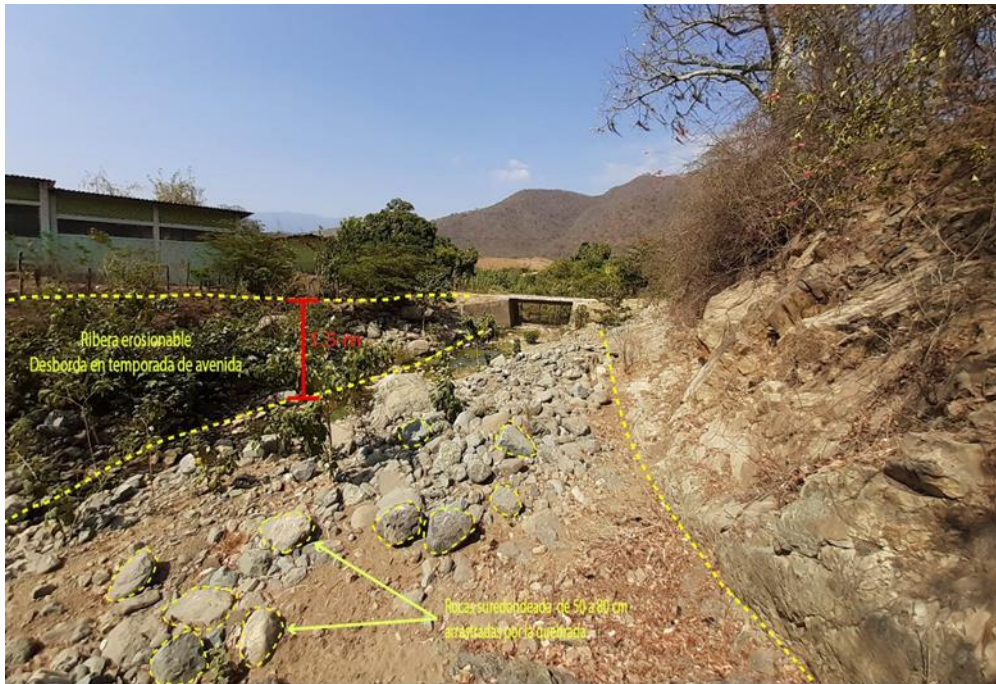
Figura 160. Zona crítica 20-098. Viviendas del sector Cucuyas Bajo, afectadas por flujos de detritos y lodos que se activaron durante períodos de lluvias excepcionales y fenómenos de El Niño. (N: 9505938 E: 628131 23/09/23).
