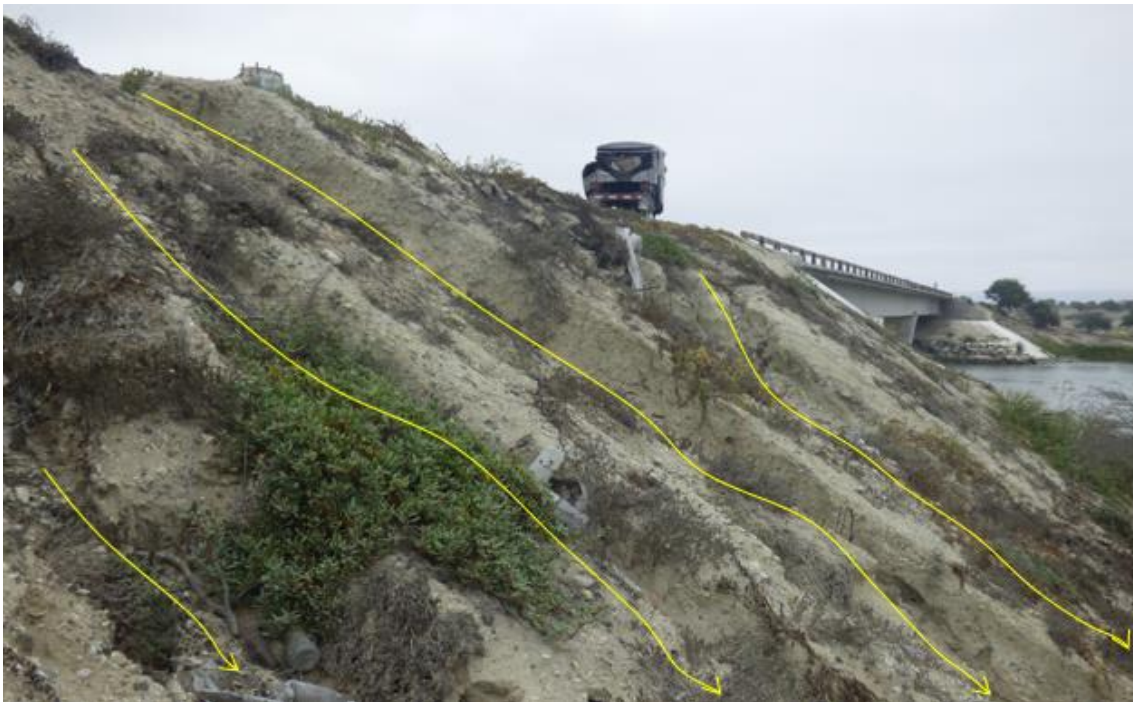
Figura 111. Zona crítica 20-052 Puente Virrela de 160 m. de largo afectado por erosión fluvial en las bases; y en los márgenes de la vía, por erosión en surcos.
