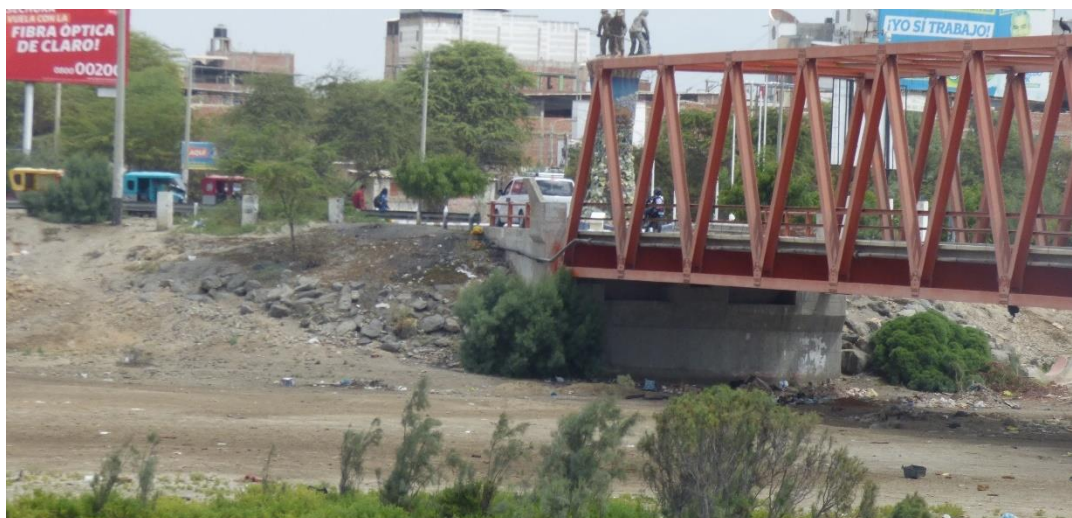
Fotografía 26. Erosión fluvial en el Puente Sechura (ZC 20-048), donde el río del mismo nombre ambas márgenes y parte del estribo del puente.
