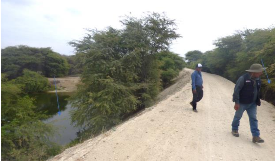
Figura 106. Zona crítica 20-047 Zona propensa a inundación fluvial y posterior desborde de la laguna Crisóstomo. Se observa un dique de tierra de 10 m. de alto por 10 m. de ancho a la base y 5 m. en la parte alta, por casi 5 km de longitud.
