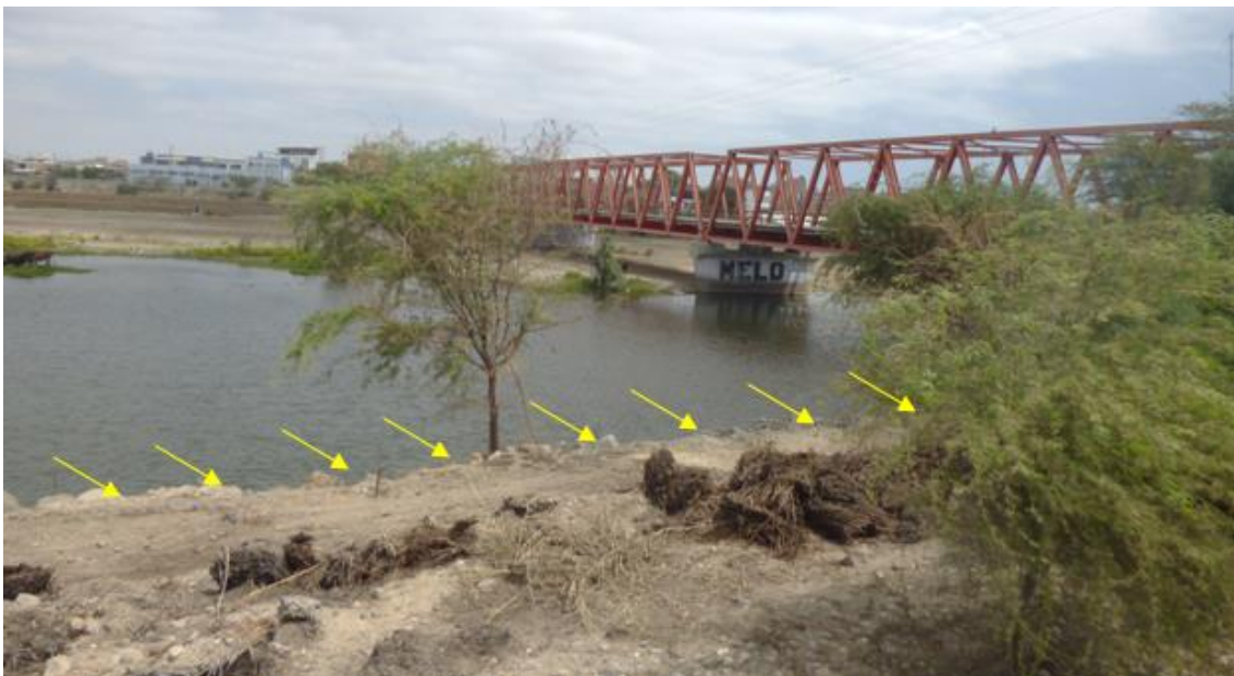
Figura 107. Zona crítica 20-048 Sector sujeto a inundación de terrazas con afectación de estribos de puente Sechura. La estructura presenta defensas ribereñas con gaviones parcialmente dañadas con las crecidas del río.
