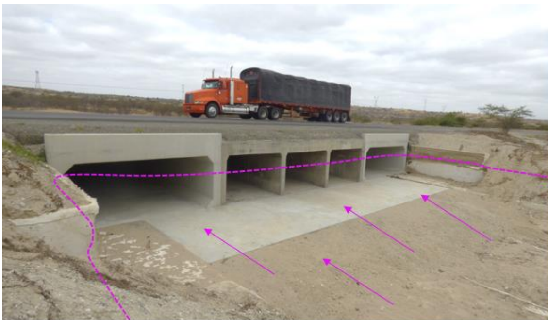
Figura 113. Zona crítica 20-054 La vía Panamericana Norte entre el tramo comprendido Piura - Limite Lambayeque, se encuentra afectado por flujos de lodo, detritos, erosión fluvial y de laderas hacia las márgenes afectando infraestructura vial importante.
