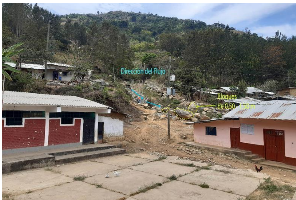
Figura 171. Zona crítica 20-109. Se identificaron deslizamientos antiguos y recientes en la parte alta del cerro Sicacate, estos presentaron reactivaciones en el mes de marzo del 2020 y 2022. Además de la ocurrencia de flujos de detritos en la quebrada del mismo nombre. (N: 9486236, E: 632399, 22/09/23).
