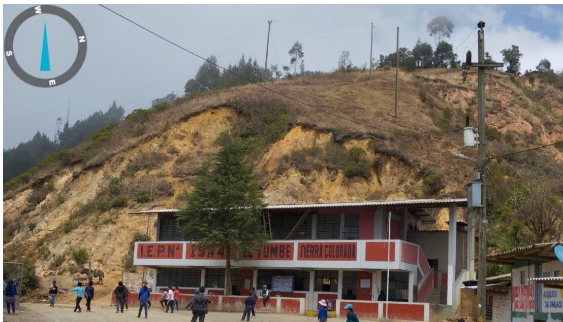
Fotografía 31. Deslizamiento rotacional que afecta a la infraestructura de la escuela.
