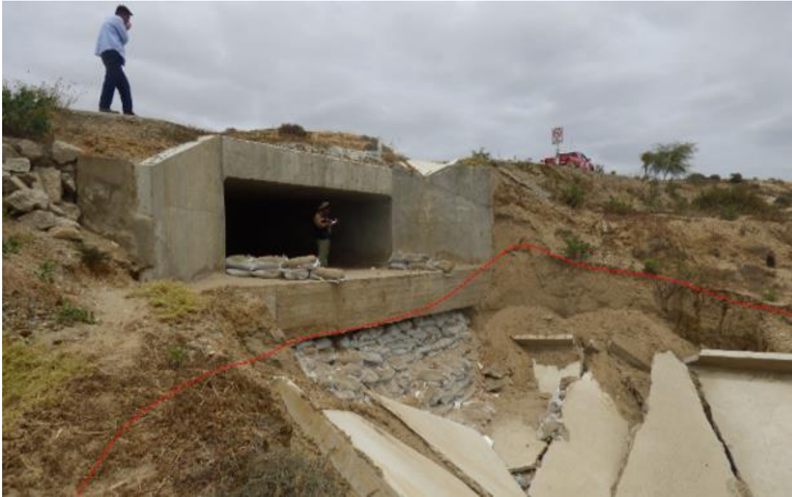
Figura 83. Zona crítica 20-024. Vía Costanera - El Arenal, afectada por flujos de lodo. Los flujos cruzan la vía a través de alcantarillas con ancho y alto de 5 m y largo de 13 m. (N: 9459835, E: 496611, 29/08/2023).
