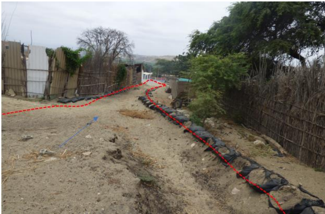
Figura 84. Zona crítica 20-025. Quebrada Sandoval, sector afectado por flujos provenientes de erosión de laderas. En las torrenteras se pueden observar material suelto compuesto de arenas y cantos, que discurren hacia las viviendas que se encuentran abajo, para luego continuar por un sistema de drenajes que el distrito posee. (N: 9459984, E: 496873, 29/08/2023).
