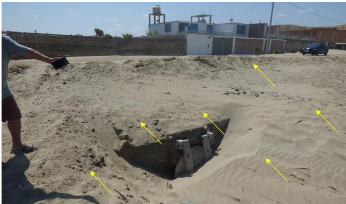
Figura 101. Zona crítica 20-042. Playa Los Cangrejos, zona afectada por flujos, inundación lagunar, arenamiento y erosión marina. El arenamiento alcanza a cubrir más de un metro de altura a las viviendas que se hallan frente al litoral, así como también postes, vía y veredas. Además de bloquear alcantarilla de desfogue de flujos y de laguna. (N: 9430832, E: 481114, 09/09/2023).
