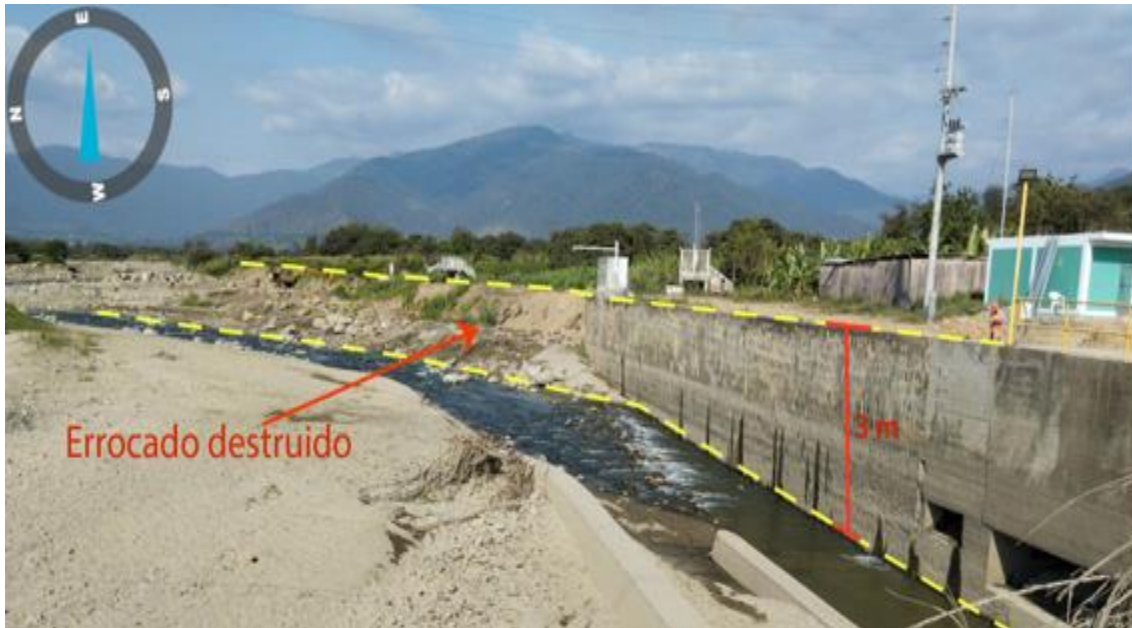
Figura 129. Zona crítica 20-068. Se evidencia que la Bocatoma Chipillico fue seriamente afectada en la margen izquierda, el enrocado fue destruido en un tramo de 70 m. El muro de concreto de 3 m de alto fue rebasado por las inundaciones registradas en el 2017 (N:9478847 E:597753 23/09/23).
