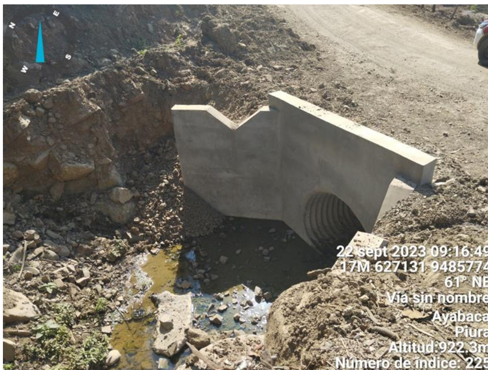
Figura 169. Zona crítica 20-107. Flujos de detritos que se enmarcan en el cauce de la quebrada Pueblo Nuevo. Los flujos se activan durante períodos de lluvias excepcionales y fenómenos de El Niño. (N: 9485774, E: 627131, 22/09/23).
