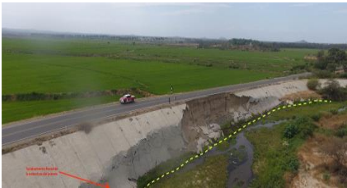
Figura 121. B. Zona crítica 20-060. El terraplén que conecta con el puente se encuentra en mal estado, es afectado por erosión fluvial con un tramo de 75 m. Ambas márgenes tienen zonas susceptibles a inundación por desbordamiento hasta un total de 15 ha (N: 9478766 E:554190, 16/09/2023).
