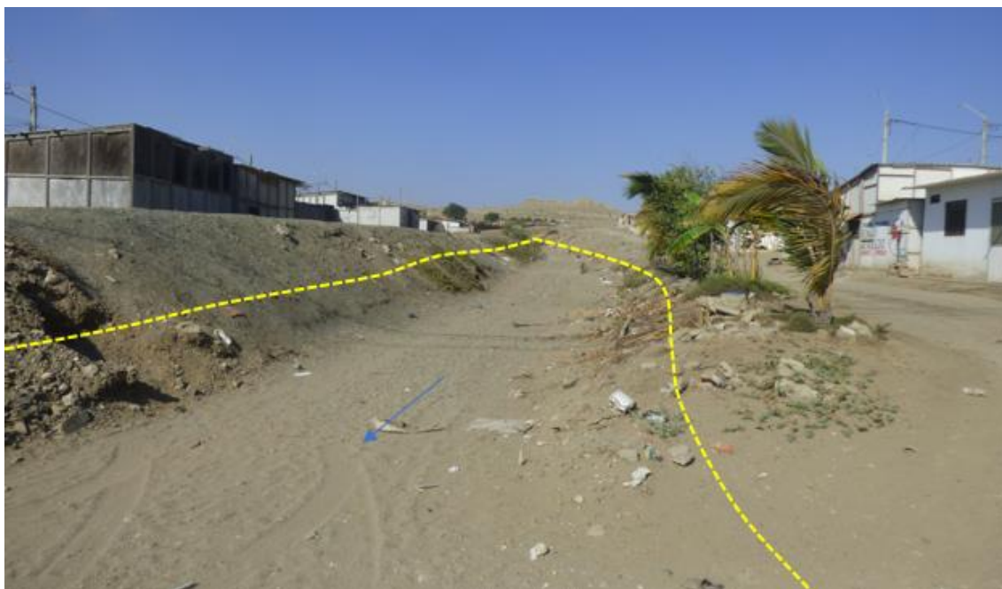
Figura 79. Zona crítica 20-020. AA.HH. Nueva Villa, área sujeta a flujos de lodo. En el cauce de la quebrada se presenta material suelto conformado por arenas y limos. La quebrada principal presenta un ancho de 8 m, se encuentra canalizada con material de arrimado, se aprecia desechos sólidos y desmonte. Atraviesa vía Lobitos - Vichayal mediante un badén. (N: 9484345, E: 465973, 29/08/2023).
