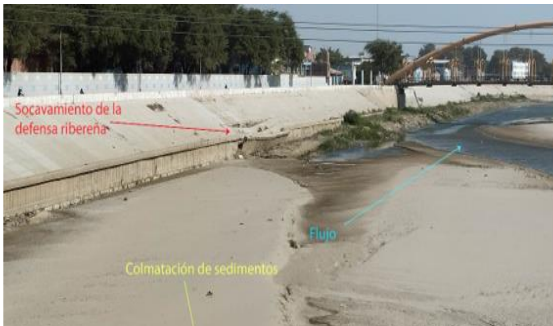
Figura 138. Zona crítica 20-076, Erosión en la margen izquierda del río Piura, en tiempos de crecida máxima se inundan las infraestructuras colindantes como parques, avenidas, (15/09/23).
