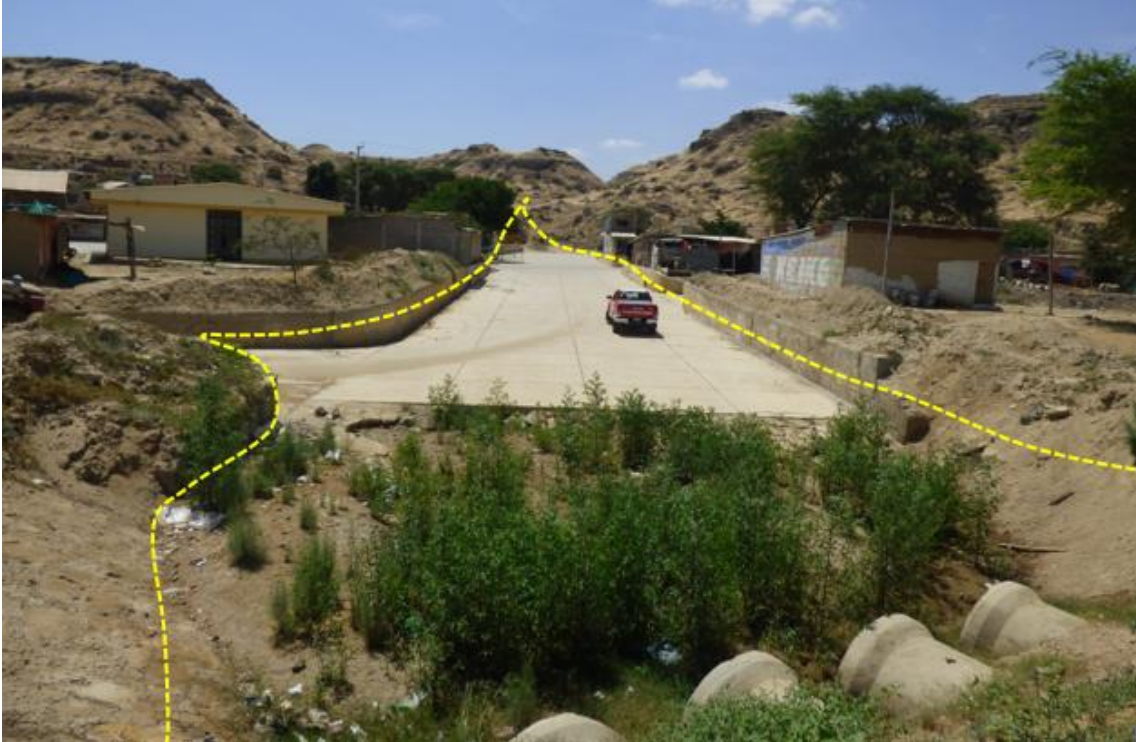
Figura 87. Zona crítica 20-028. C.P. El Tambo, sector sujeto a flujos de lodo provenientes de la intensa erosión de laderas alimentando la quebrada El Pilar. La quebrada presenta canalización. La alcantarilla se encuentra colmatada con material arrastrado durante el fenómeno Yaku (2023). (N: 9459806, E: 499690, 29/08/2023).
