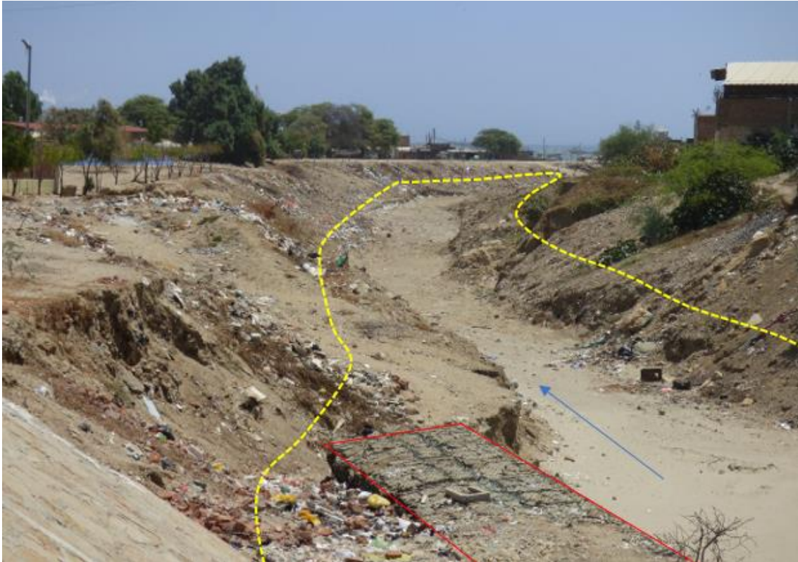
Figura 74. Zona crítica 20-015. Barrio Particular, sector afectado por flujo de lodo. Presenta una quebrada con cauce de ancho 50 m, en su lecho presenta arena limosa, además de abundante residuos sólidos y desmote. La quebrada se encuentra canalizada, se ha realizado limpieza del canal, hacia las márgenes se tiene arrimado de material. (N: 9494558, E: 470296, 29/08/2023).
