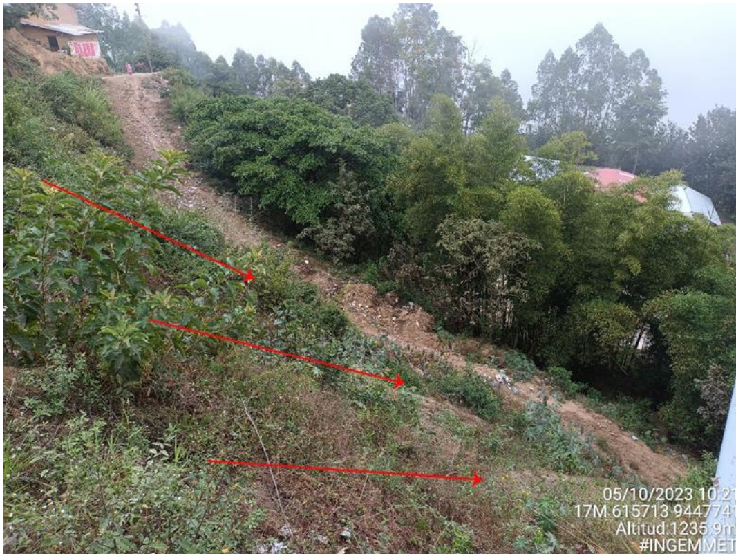
Figura 182. Zona crítica 20-120. Se identificó un deslizamiento de 42 m de largo, que afectan 40 m de una vía afirmada principal acceso, los materiales se desplazan ladera abajo hacia la escuela Niño Jesús 14327 de nivel primario. (N: 9447741, E: 615710, 05/10/23).
