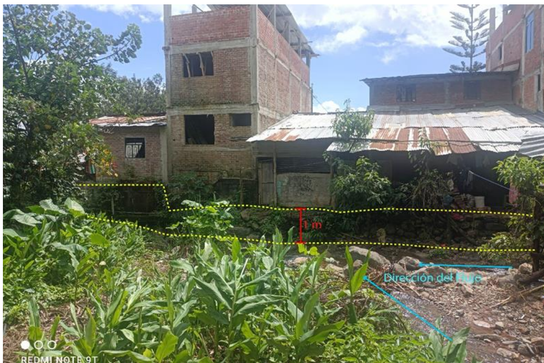
Figura 163. Zona crítica 20-101. Se identificaron flujos de lodos y detritos que descienden desde la parte alta de la quebrada Jililí. Las viviendas son afectadas por flujos de detritos y lodos, además de, inundaciones por desborde de las quebradas. (N: 9493040, E: 633427., 22/09/23).
