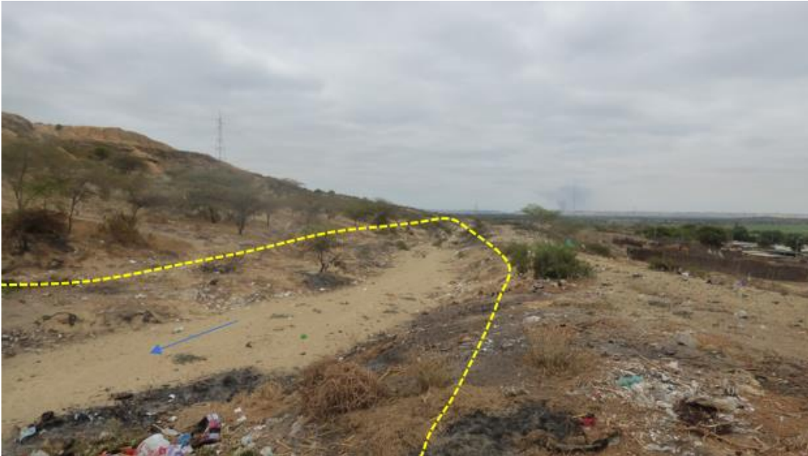
Figura 93. Zona crítica 20-034. La quebrada La Zorra es la que presenta mayor ancho: 25 m. que se estrecha aguas abajo en una alcantarilla de 4 m. de ancho y 2 m. de alto., con muro de gaviones hacia las márgenes cercanas a las viviendas, se encuentra colmatada por material de flujos arrastrados anteriormente, basura y desmote. (N: 9455582, E: 508534, 29/08/2023).
