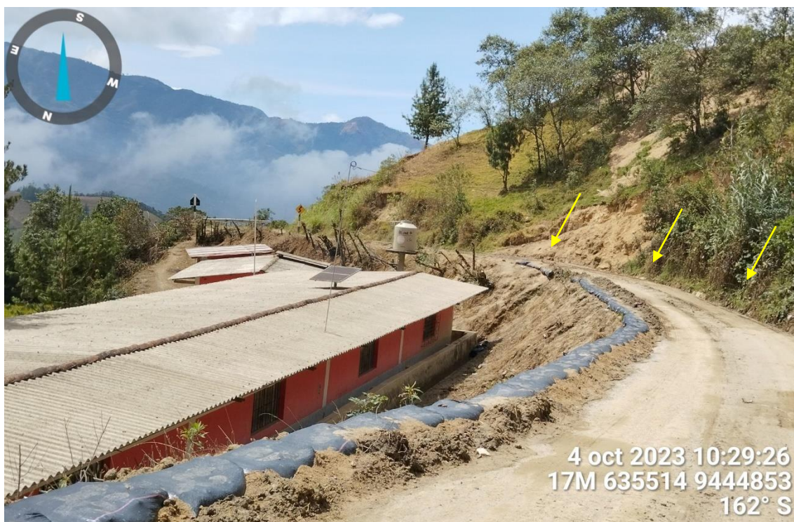
Figura 190. Zona crítica 20-128. Se identificaron deslizamientos en varios tramos de la carretera, cuando se activan los eventos interrumpe el normal tránsito. (N: 9444853, E: 635514, 04/10/23).
