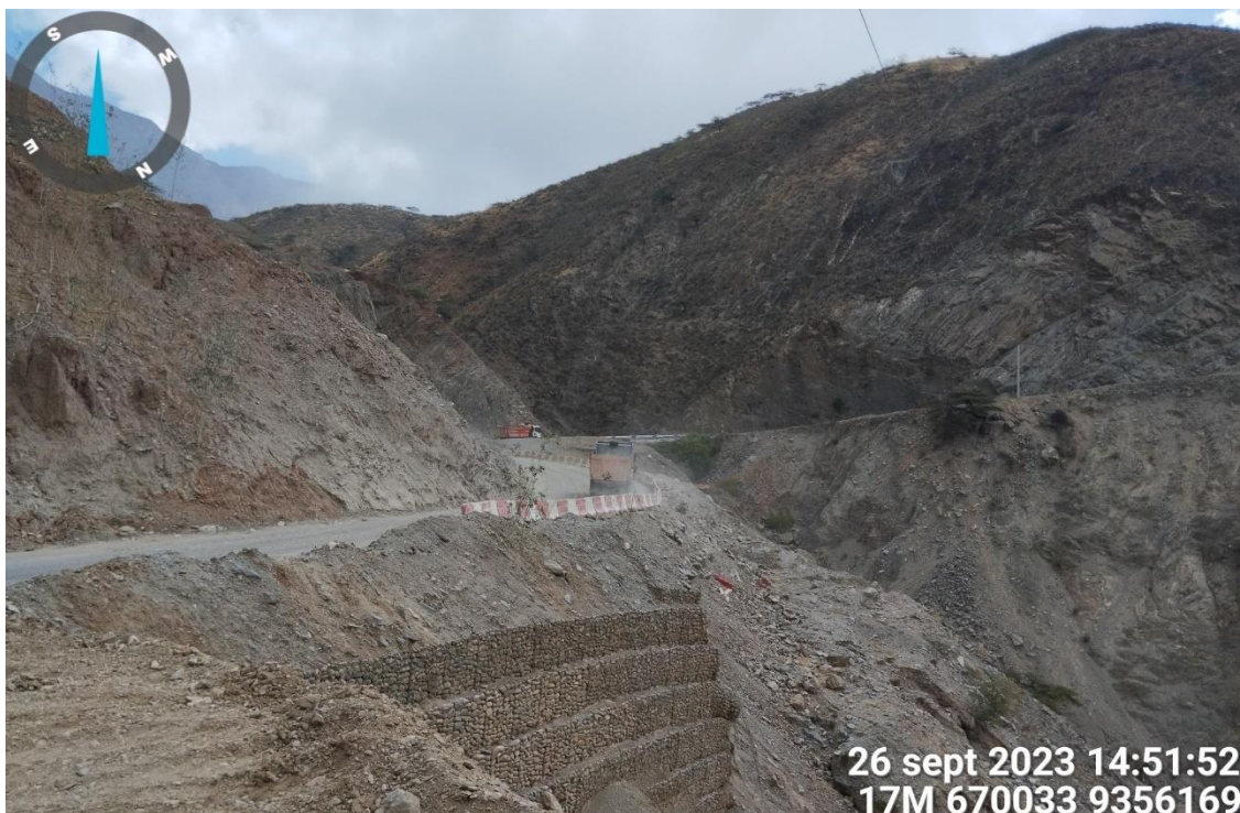
Figura 236. Zona crítica 20-174 Entre los sectores mencionados afloran rocas muy meteorizadas y diaclasadas cubiertas por depósitos coluvio deluviales susceptibles a movimientos en masa. Se identificaron derrumbes y erosión de laderas que está condicionada por el grado de fracturamiento de los afloramientos.
