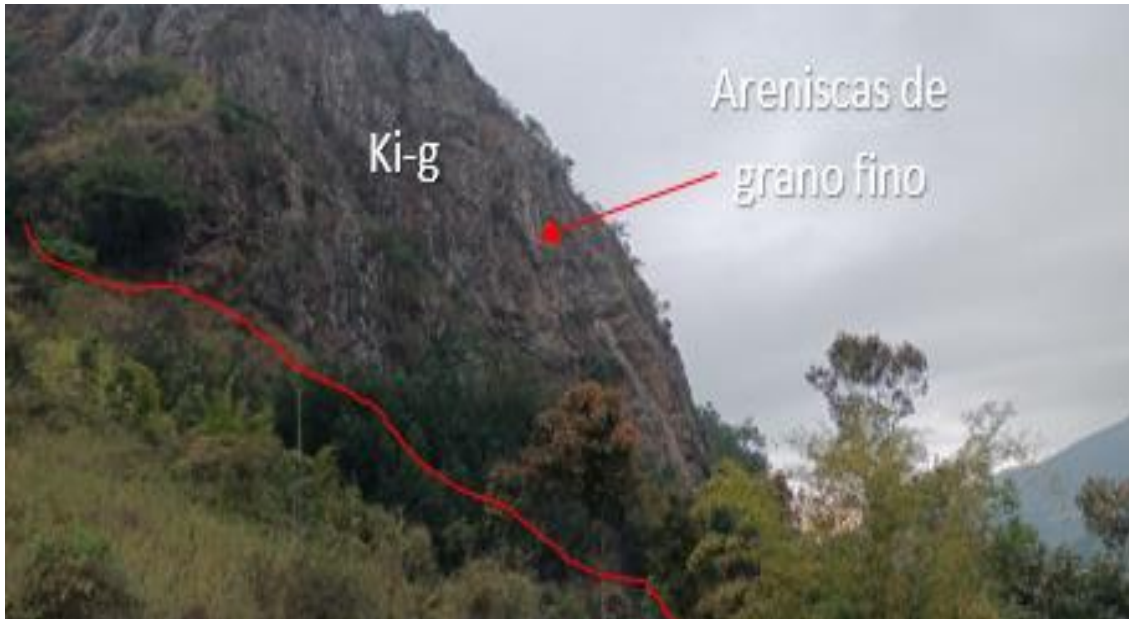
Figura 11. Estratos de areniscas de grano fino con patinas de óxido de hierro, además se observa un depósito coluvial de una antigua avalancha. Coordenadas: E: 652412; N: 9425378 (03/10/2023).
