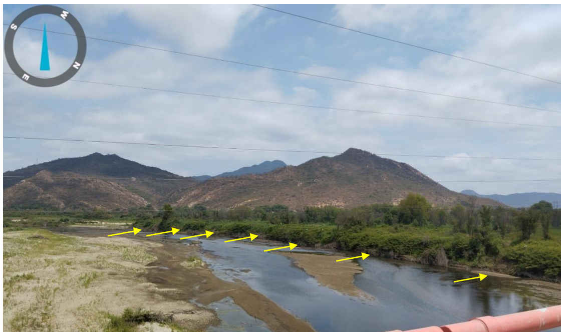
Figura 198. Zona crítica 20-136. Procesos de erosión fluvial en ambos estribos del puente Carrasquillo, el margen izquierdo presenta meandros que incrementan la erosión 500 m aguas arriba. Hacia el margen derecho se observan planicies inundables sobre conglomerados con clastos redondeados de composición polimíctica. (N: 9423934, E: 609009, 17/09/23).
