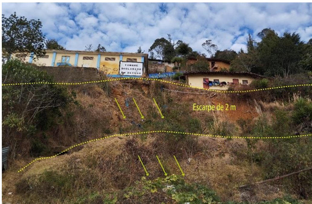
Figura 172. Zona crítica 20-110. Se identificaron deslizamientos antiguos en el cerro El Calvario, estos presentaron reactivaciones en marzo del 2017, 2019, 2020 y durante el Yacu. Además de la ocurrencia de derrumbes. (N: 9486990, E: 642316, 22/09/23).
