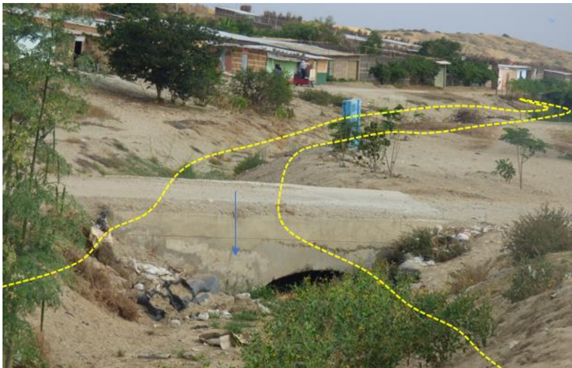
Figura 95. Zona crítica 20-036. Pueblo Nuevo Colán, sector afectado por flujos de lodo que erosionan y socavan calles en el sector. Presenta un dren que luce colmatado además de ser insuficiente para el volumen de material arrastrado durante la activación en eventos de fenómeno de El Niño y lluvias excepcionales. (N: 9457438, E: 494230, 29/08/2023).
