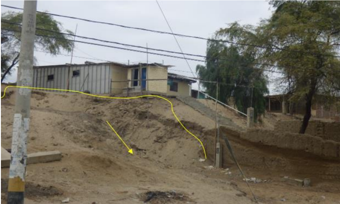
Figura 151. Zona crítica 20-089. Sector Nuevo Tamarindo afectado por erosión de laderas, estos procesos originan flujos de lodo que discurren hacia cuencas ciega. (N: 9407244, E: 530361, 15/09/23).
