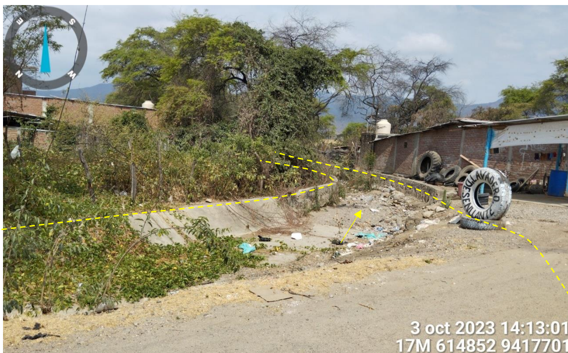
Figura 208. Zona crítica 20-146 El tramo entre el caserío Pedregal y Buenos Aires es afectado por inundación fluvial ante la crecida del caudal del río Piura y la quebrada Buenos Aires. Durante el Yacu del presente año, en el mes de marzo se inundaron varias viviendas y se interrumpió el normal tránsito entre ambos sectores. (N: 9417701, E: 614852, 03/10/23).
