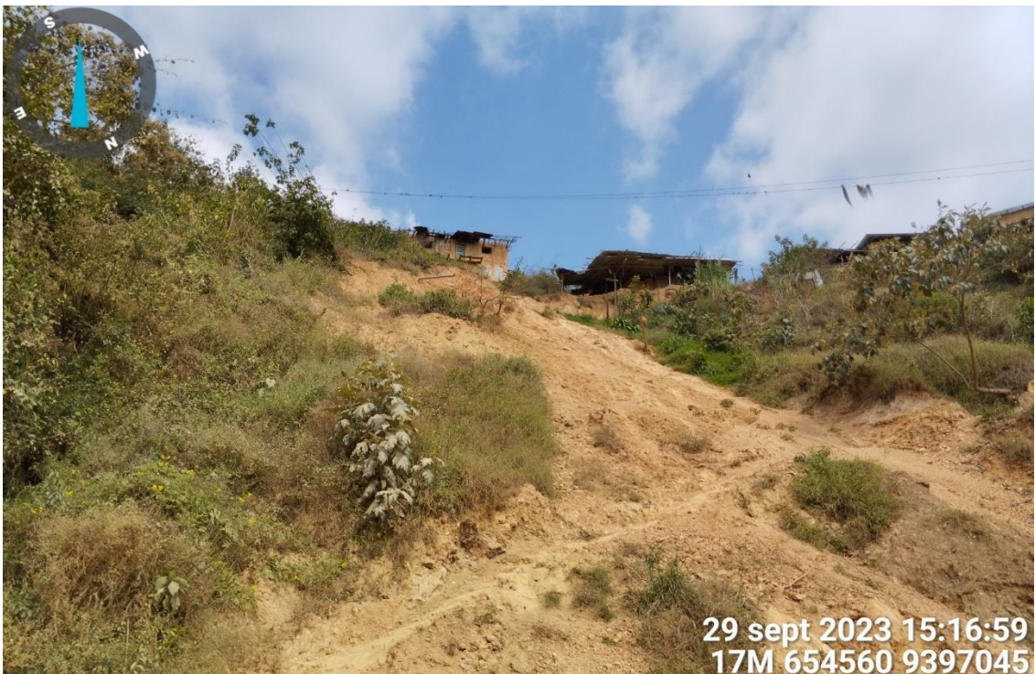
Figura 223. Zona crítica 20-161 El área evaluada se ubica en facies de pizarras y filitas con bandas de cuarzo de segregación; arenas sueltas y limos, estos materiales forma depósitos coluvio deluviales de naturaleza arcillosa muy susceptibles a movimientos en masa. Se identificaron derrumbes y deslizamientos que afectan viviendas y varios tramos de carretera (trochas carrozables).
