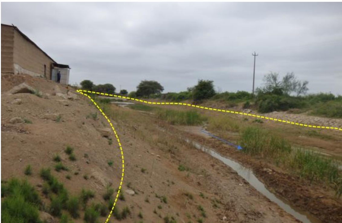
Figura 89. Zona crítica 20-030. Quebrada Sechurita, el canal presenta un mal diseño de canalización porque provoca inundaciones en viviendas contiguas a los canales de drenaje. En algunos sectores se observan viviendas y corrales de ganado en el cauce de la quebrada. (N: 9460467, E: 502623, 29/08/2023).
