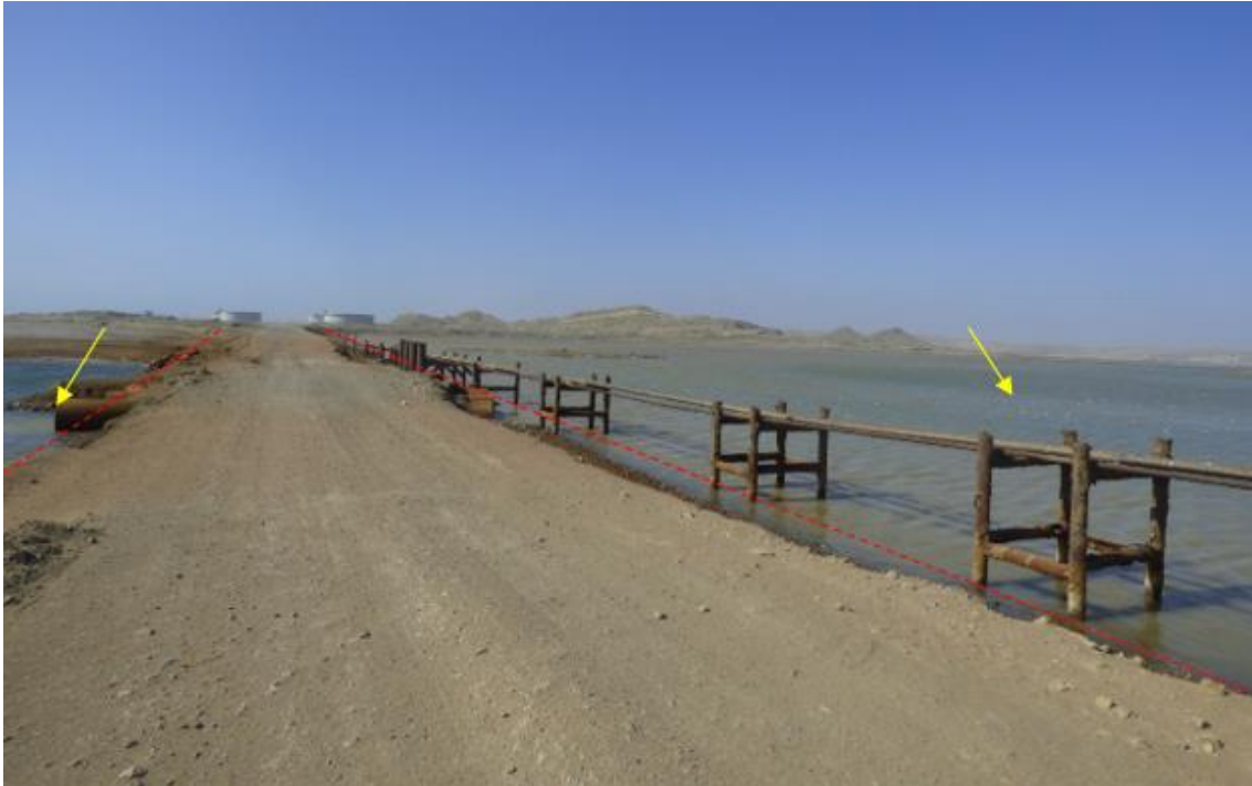
Figura 80. Zona crítica 20-021. Vía Negritos – Vichayal, carretera afectada por inundación lagunar. El volumen de agua de la laguna aumentó considerablemente luego del Ciclón Yaku 2023. Esto generó hundimiento en la vía y colapso de ambas márgenes en ciertos tramos haciéndolas casi intransitables. Además de afectar tubos y pozos petroleros. (N: 9479473, E: 470703, 29/08/2023).
