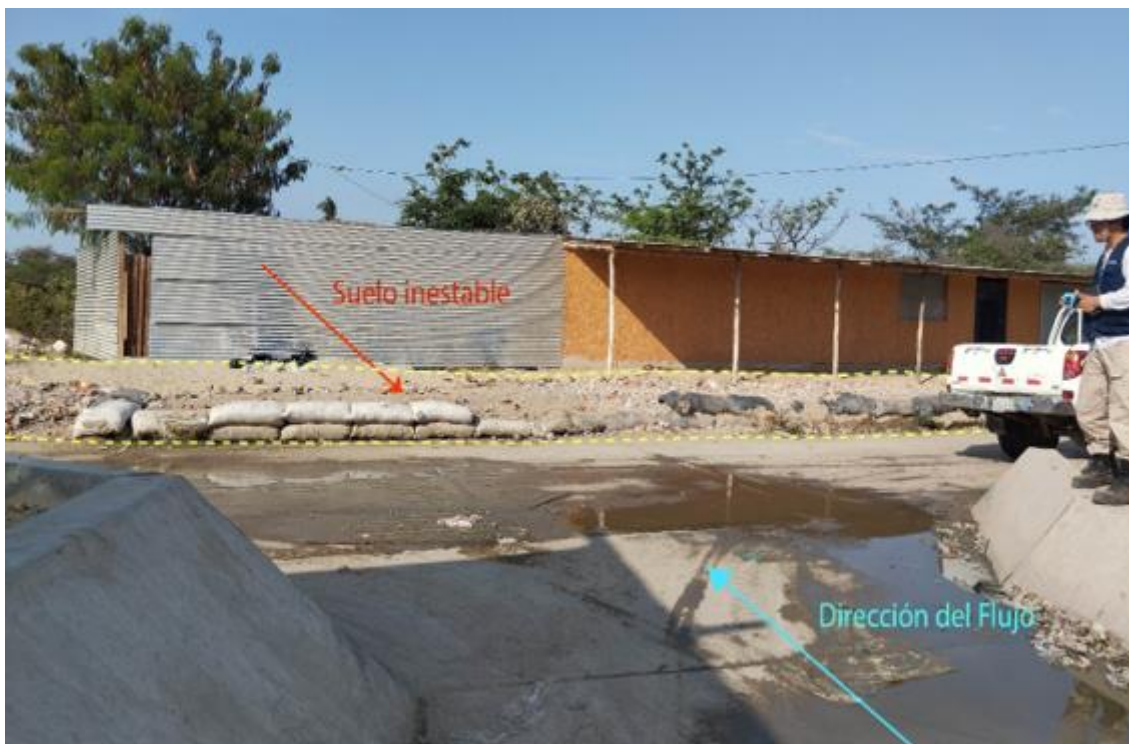
Figura 123. Zona crítica 20-062. El drenaje de la ciudad de Sullana se encuentra en mal estado, protegiendo al cauce del río se aprecia sacos de arena donde antes había concreto. En esta intersección de generarse lluvias extraordinarias, el agua va seguir erosionado y posiblemente rebalse hacia las márgenes y afecta viviendas aledañas. Coordenadas N:9460665, E:536428.
