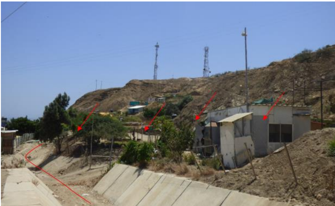
Figura 75. Zona crítica 20-016. Sector Aproviser, sujeto a flujo de lodo, erosión de laderas y derrumbes. La erosión de laderas origina flujos que discurren a través de un canal sobre el sector Aproviser. Las márgenes del canal presentan erosión de laderas y generan flujos, que discurren hacia la zona urbana. (N: 9493327, E: 471048, 29/08/2023).
