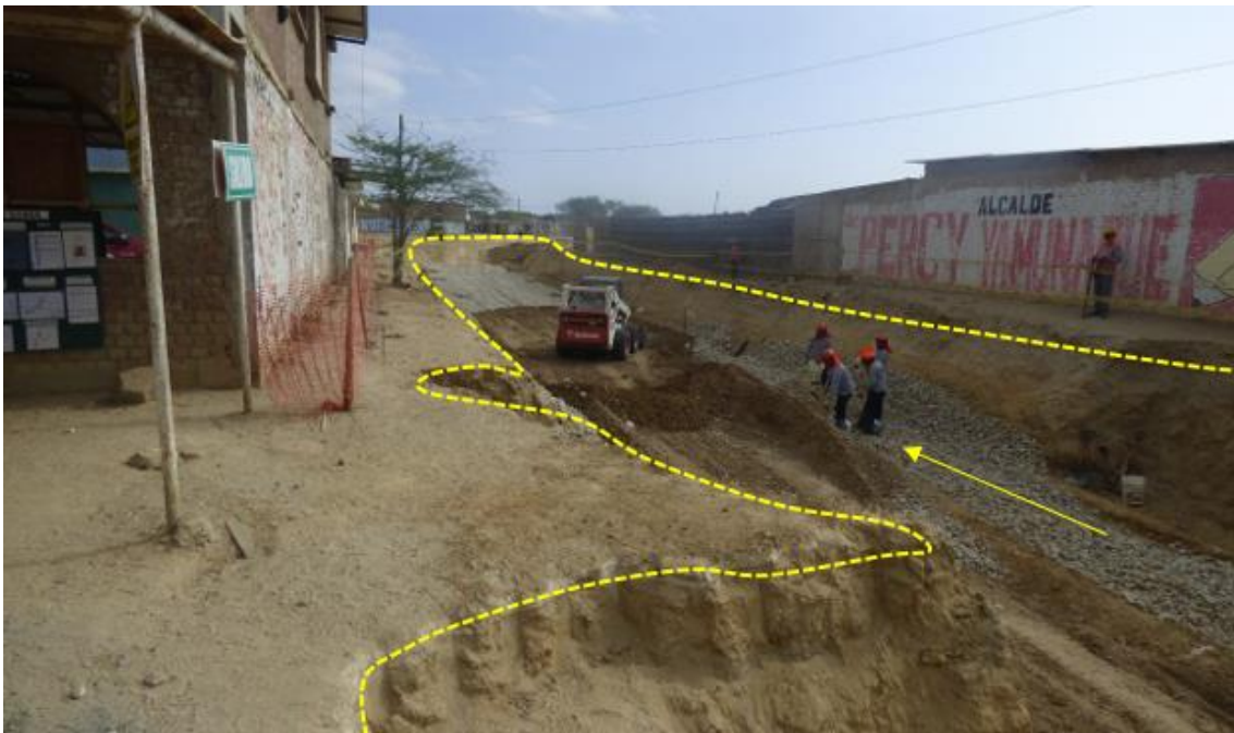
Figura 152. Zona crítica 20-090. Sector Tablazo Sur afectado por flujos de lodo provenientes de erosión de ladera. Estos discurren entre las viviendas y calles generando socavamiento y profundidad del canal. (N: 9407244, E: 530361, 15/09/23).
