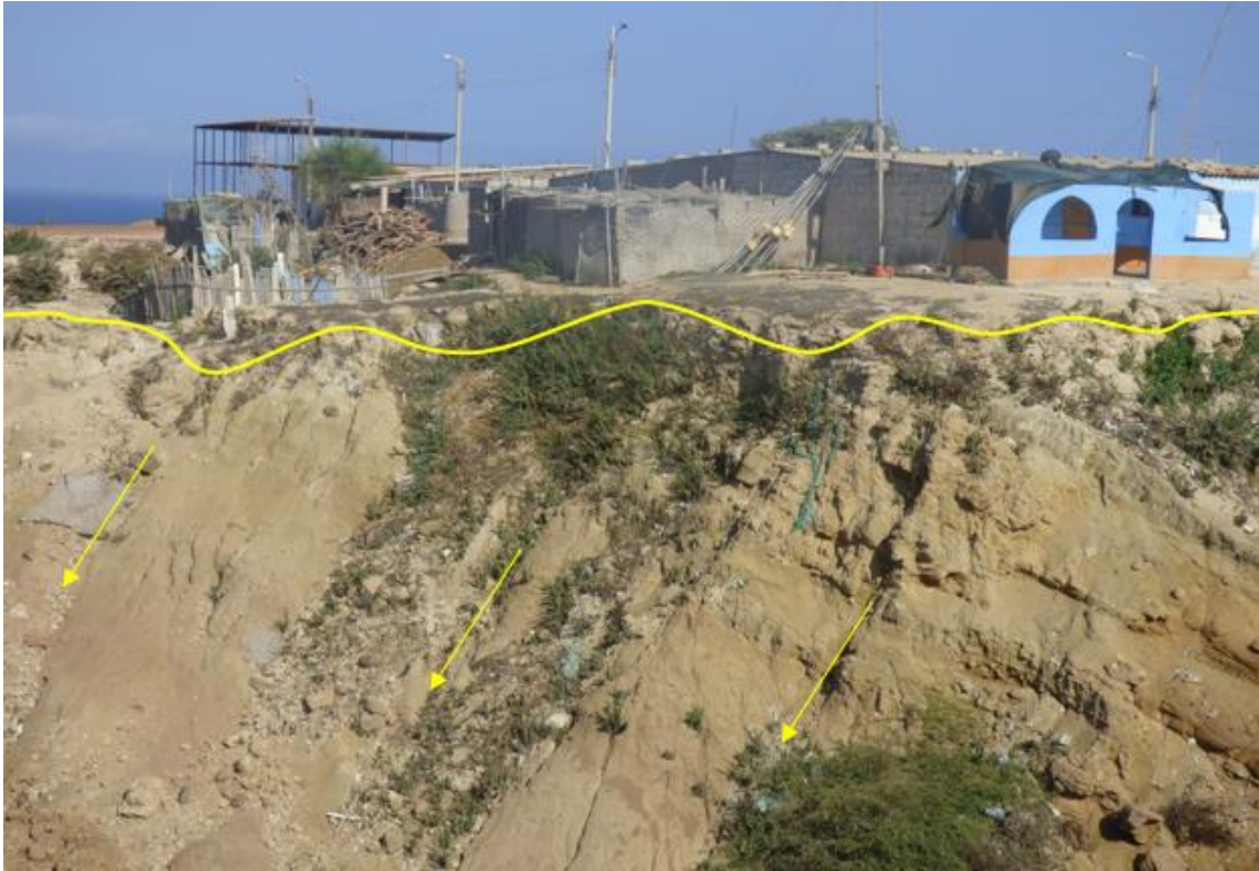
Figura 103. Zona crítica 20-044. C.P. La Tortuga, afectan a viviendas y vía hacia Paita, que se encuentran al borde de taludes. Presentan un avance retrogresivo, con estrechamiento de cauce aguas abajo. (N: 9416406, E: 486263, 09/09/2023).
